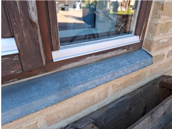
Afskallende maling på oprindeligt trævindue
