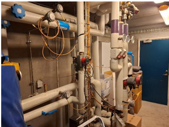
CTS på anlæg.
