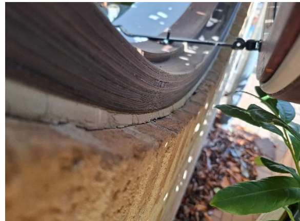
Fuge med manglende vedhæftning på rundt vindue uden sålbænk kan medføre fugtskader.
