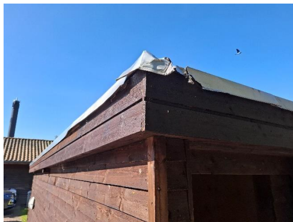
Beskadiget løskant på skur.
