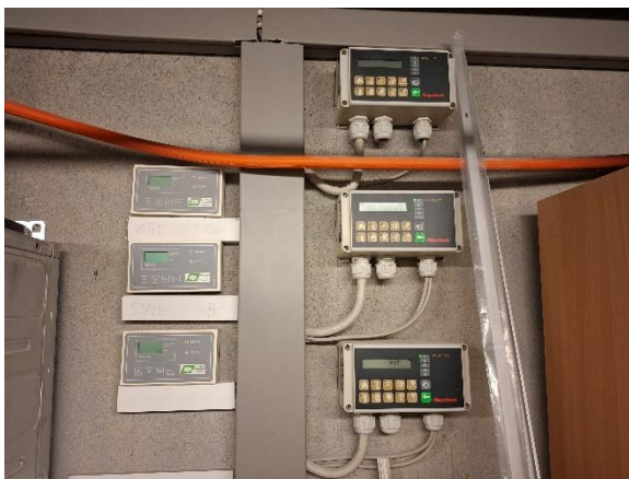
Ventilations- og varmestyring af ældre dato
