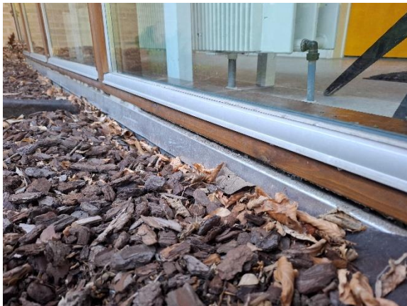
Manglende fuge under vindue under indgangsparti.
