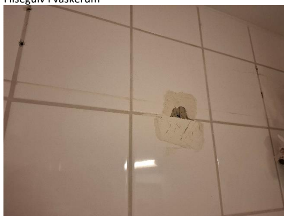
Der ses enkelte skader på flisevægge i badeværelser.
