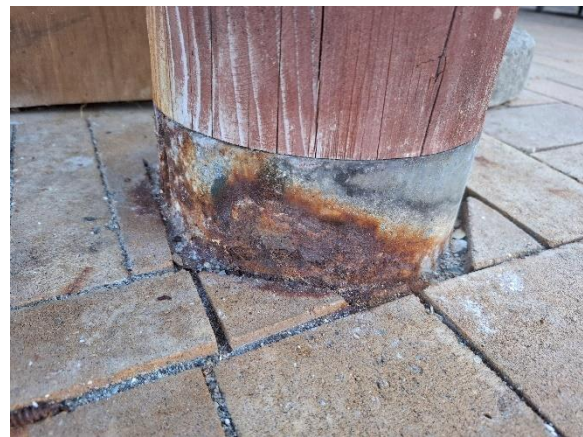
Søjlefødder med korrosion i overfladen.
