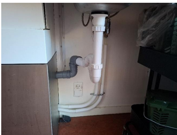
Afløbsinstallation i køkken
