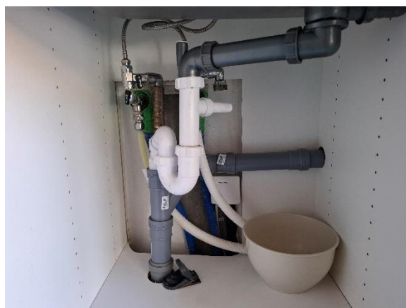
Afløbsinstallation i køkken
