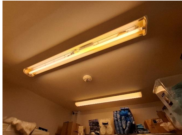
HF-armaturer i rengøringsrum
