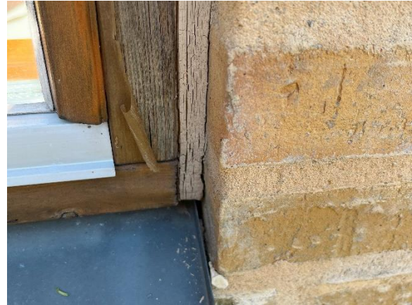
Afskallende maling på trævindue og krakeleret fuge.
