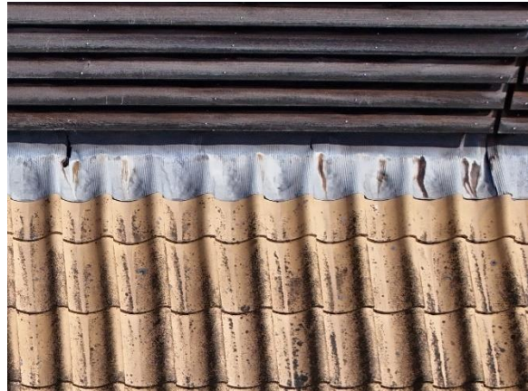
Fleksibel inddækning på sydfløjen med gennemtæring
