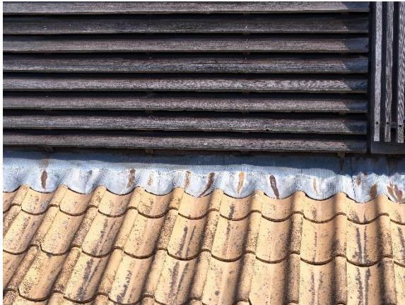
Korrosion i fleksibel zinkinddækning på østfløjen
