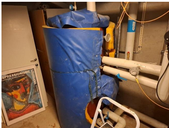
Varmtvandsbeholder med isoleringskappe faldet delvist af.
