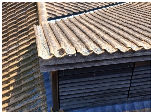
Løs sten på vestfløjen.
