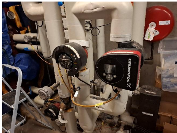
Varmevekslere og varmfordelingspumper.
