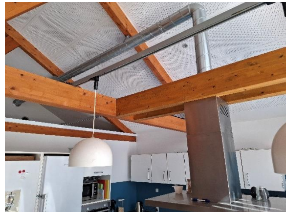
Emhætte og kanal
