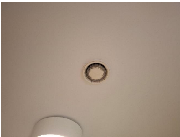
Udsugningsventil i vaskerum trænger til rensning.
