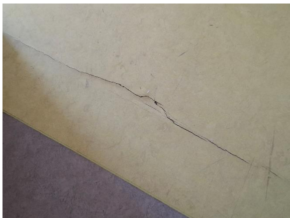
Linoleumsgulv med revne
