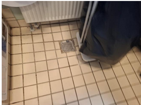
Gulvafløb i vaskerum
