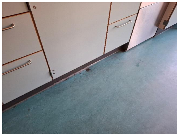
Skader på linoleumsgulv i køkken
