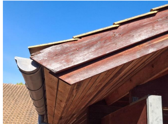
Vindskeder har generelt begyndende nedbrud ved tagfod.
