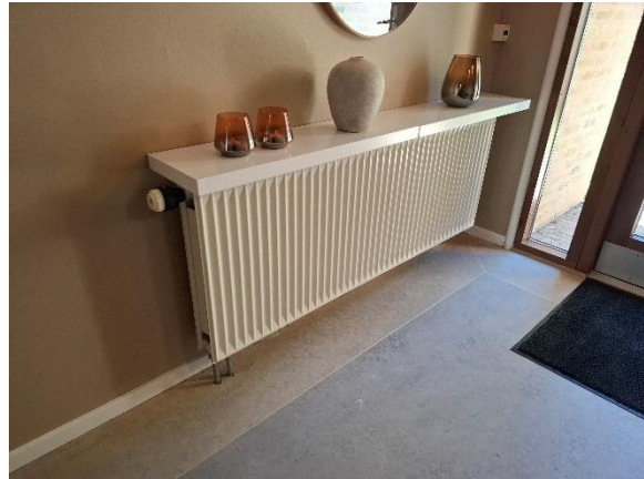
Radiator med termostatventil
