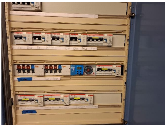
Tavle mangler afdækning
