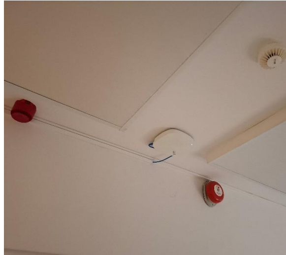
Røgdetektor og alarmklokke
