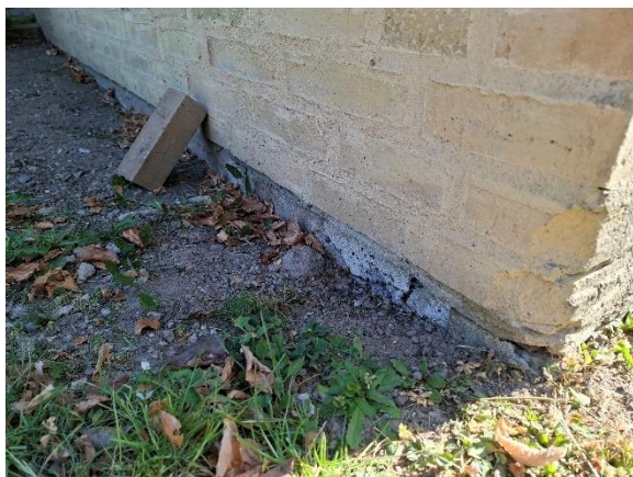
Sokkel med afskallende puds.
