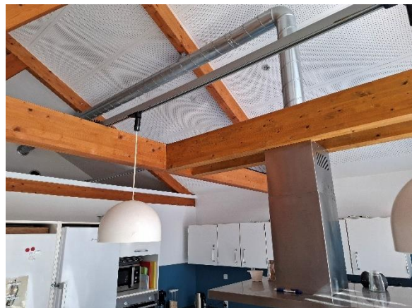
Udsugningskanal til emhætte i køkken
