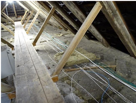
Loft isoleret med 200 mm
