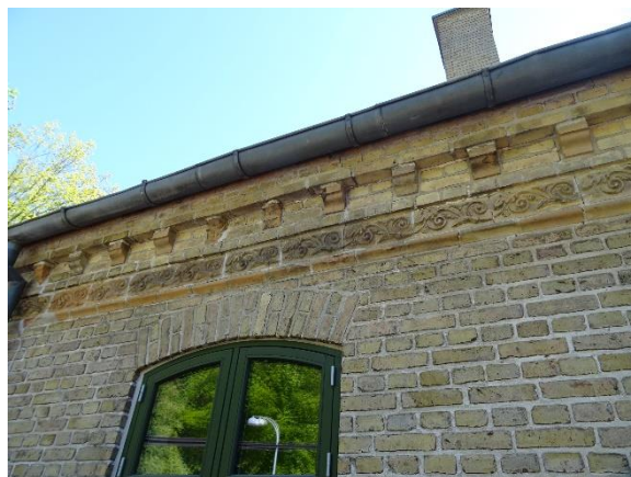
Gesims, revner og flere ødelagte sten
