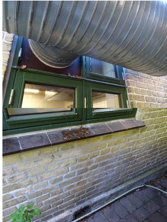
Fedtstof der drypper fra fedtfyldt kanal
