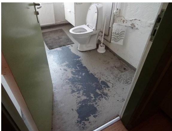
HC toilet med slidt malet gulv
