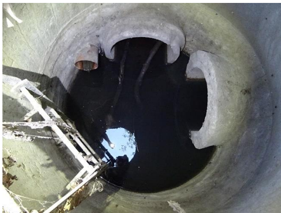
Rødder vokser igennem kloakrør.
