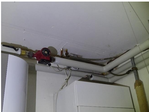
Varmefordelingspumpe, ældre trinstyret UPS 25-40 180
