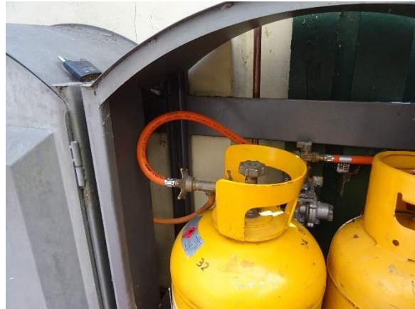
Gasflasker, slanger og regulatorer
