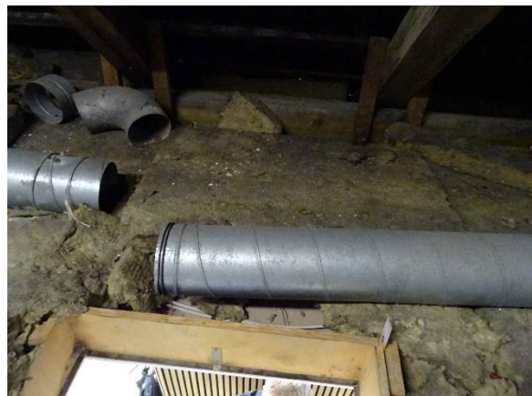
Uafsluttede kanaler i lofttrum
