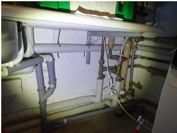
Galvaniserede rør i fyrrum
