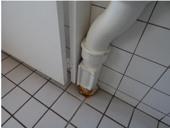
Ældre støbejerns faldstamme med tydelig tæring.
