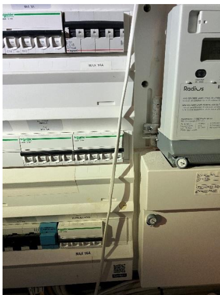
Løst kabel som hænger i en bue.
