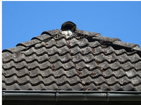
Grater og rygning fra vest, mindre reparation krævet
