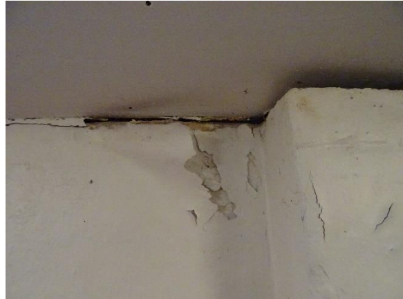
Afskalninger pga. fugt ved loft
