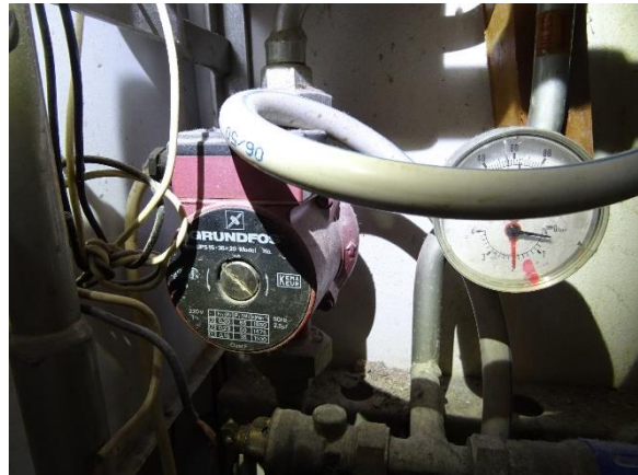
Pumpe i fjernvarmeunit
