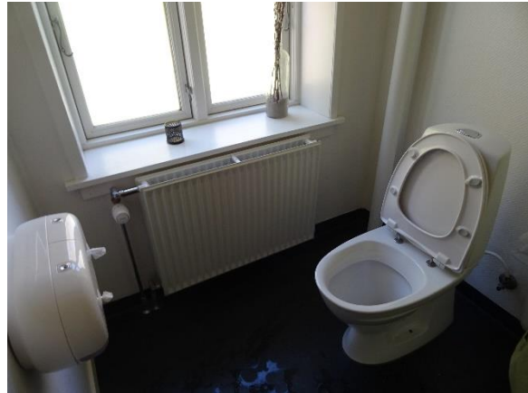
Alle radiatorer er nyere og monteret med termostatventil
