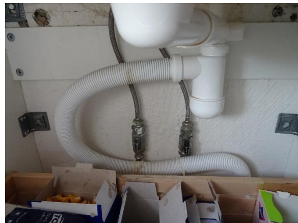
Afløb under vask på toilet
