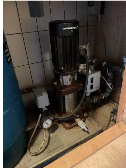
Hydrofor anlæg til tennisbanerne
