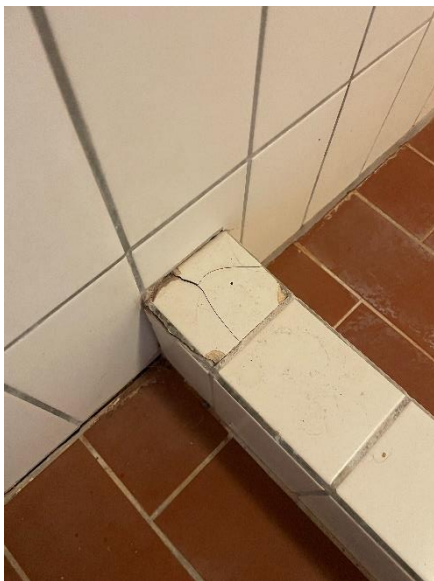
Skadet klinke ved badeområdet i herreomklædningen Elastisk fuge har sluppet mellem gulv og væg
