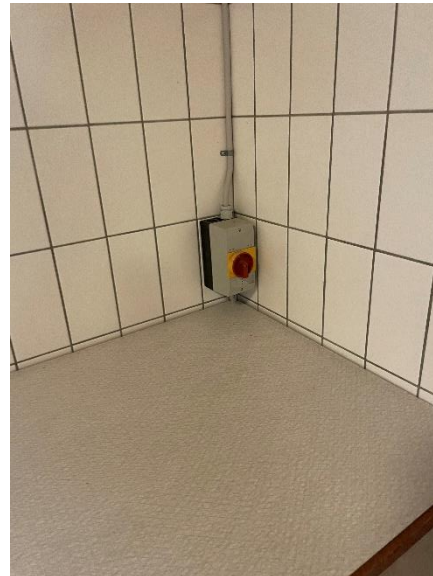
Sikkerhedsafbryder til Hydrofor anlæg
