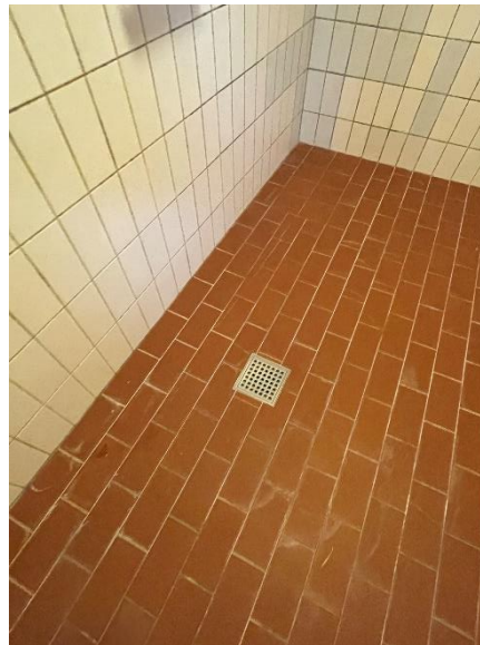
Afløb ved bad
