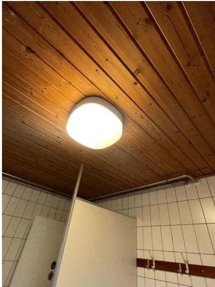
Belysning i omklædning.
