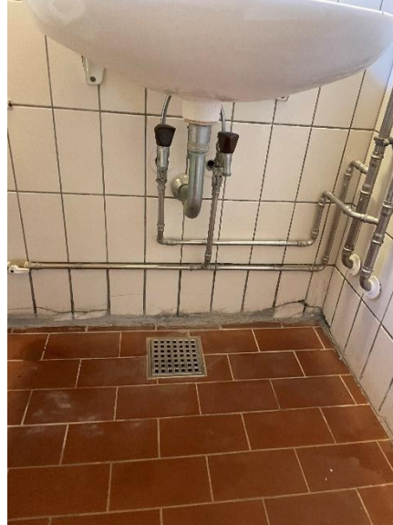
Afløb under håndvask på toilet
