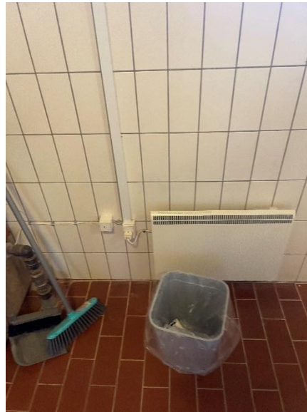
Radiator i herrerens omklædningsrum
