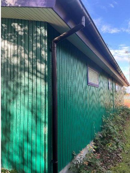
Tagenedløb på bagsiden af bygningen
