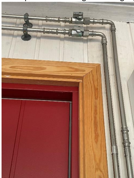
Synlig rørledning med afspærrings ventiler til køkkenvask.
