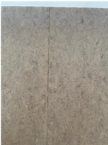
Revne i linoleums svejsning
