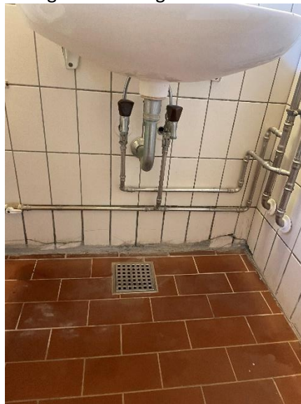
Rørledninger under vask i toilet.
