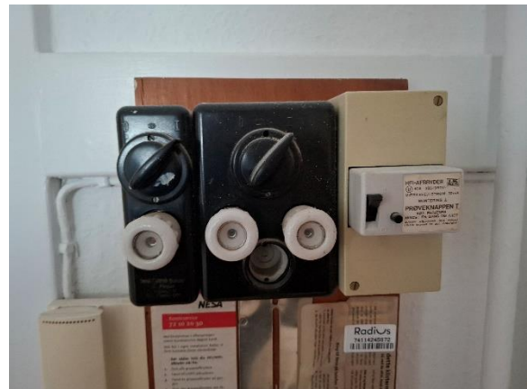
Tavle i bolig med HFI-relæ
