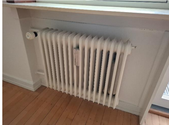
Radiator i bolig
