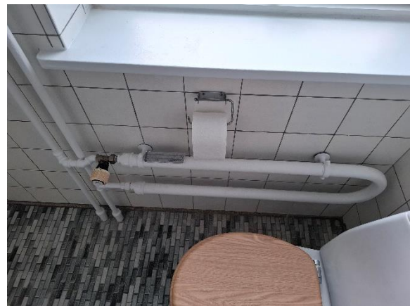
Radiator i badeværelse
