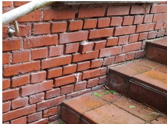
Manglende fuger og løse sten ved kælderhals
