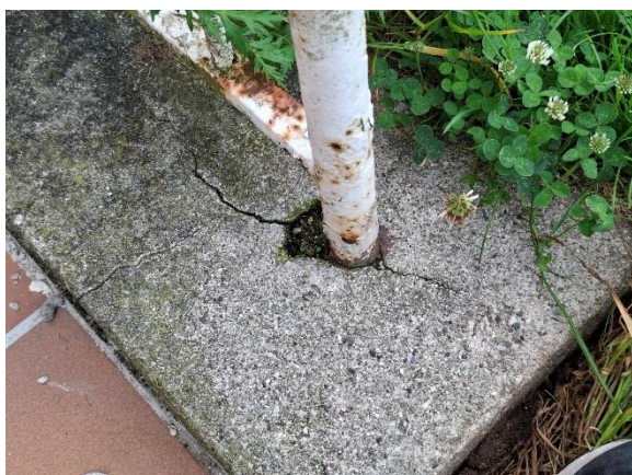
Revnedannelser ved montering af rækværk til kælderhals
