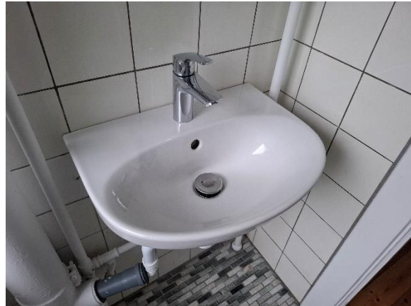
Håndvask og armatur i bolig
