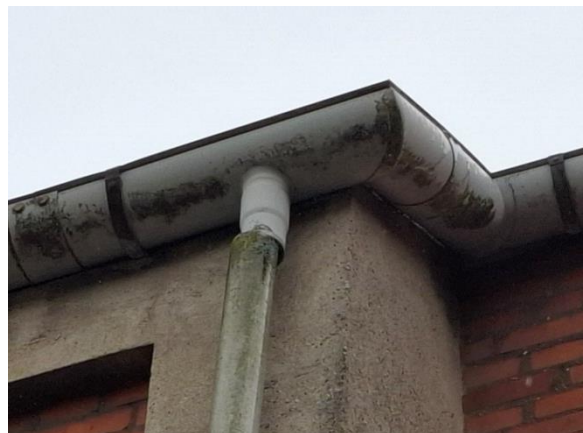
Nedløbsrør er gået fra i bygning 2
