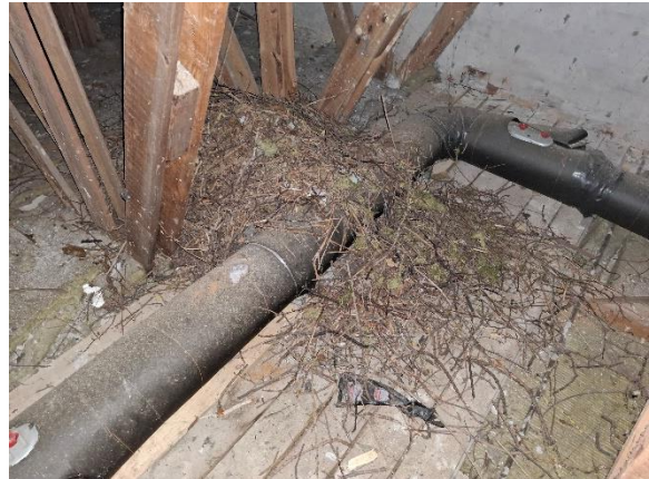
Der ses større fuglerede i bygning 1
