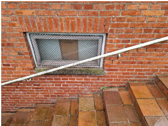
Manglende fuger ved kælderhals
