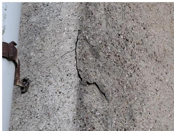
Afskallende puds mod nord
