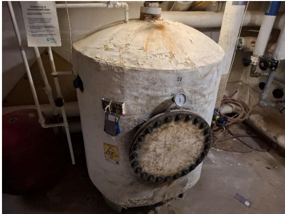
Uisolerede tilslutningsrør til varmtvandsbeholder.
