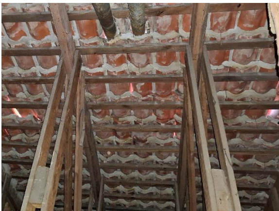
Nedfalden understrygning i bygning 2
