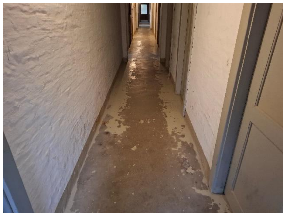
Overflader i kælder
