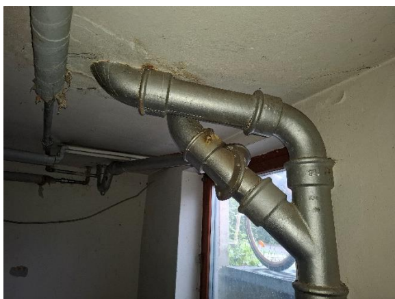
Ældre faldstamme i støbejern
