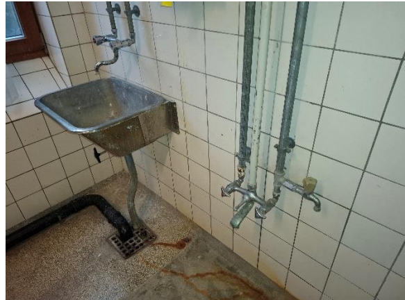
Vandinstallation i kælder
