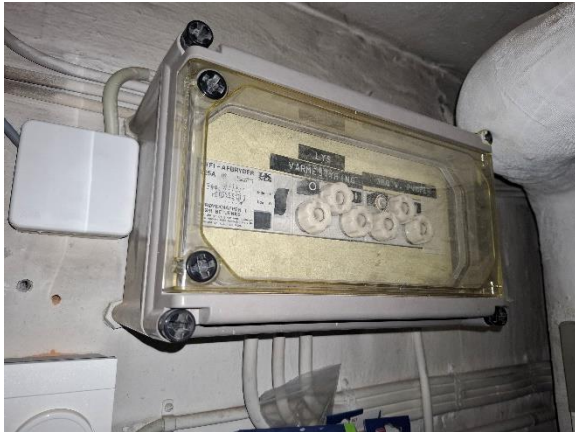
Tavle til varmecentral.
