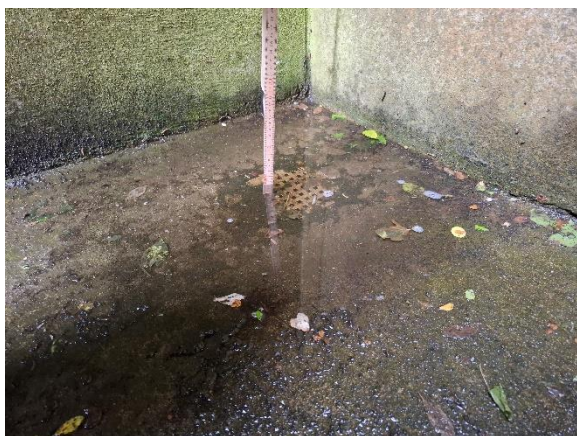
Tilstoppet afløb i kælderhals i bygning 1. Der blev konstateret stående vand med en dybde på 35 mm.
