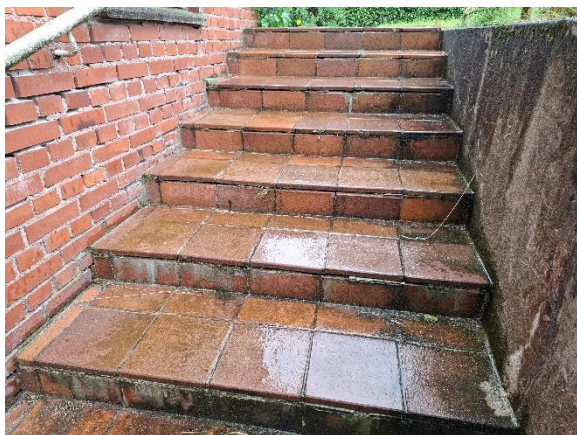
Trappeløb i kælderhals med udfaldne fuger
