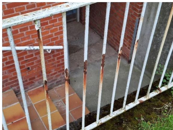
Gelænder og rækværk på kælderskakt. Der ses gennemtæringer i malede overflader
