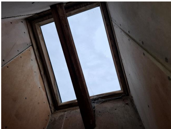
Ovenlys i trappeskakt
