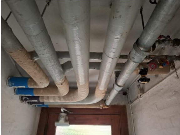
Varmerør i kælder
