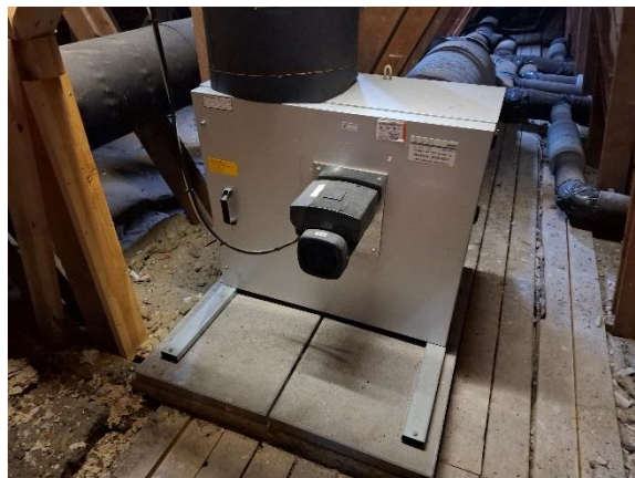
Ventilator i bygning 2 fra 2004
