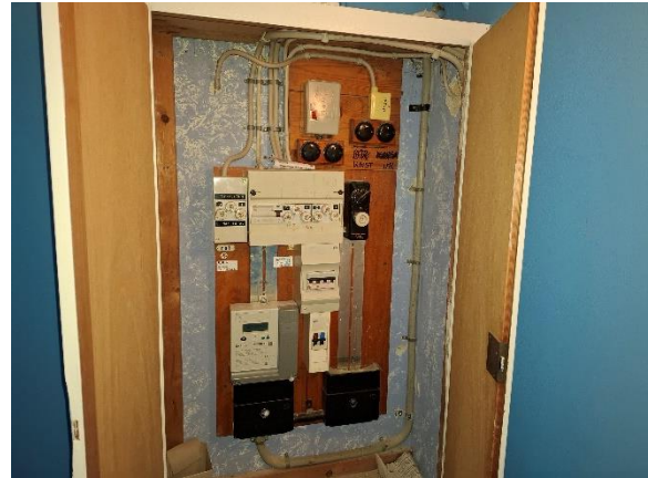
Hovedtavle i opgang bygning 1
