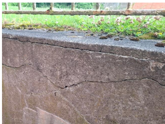
Revner og afskalninger i betonkælderhalse
