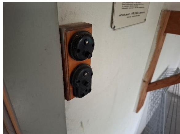
Ældre afbryder og stik i kælder
