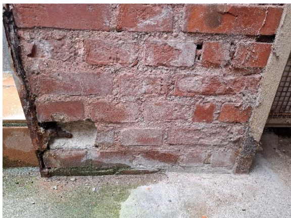
Manglende fuger ved kælderhals. Hjørneforstærkning korroderet
