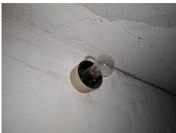
Ældre fatning i kælder med halogenpære
