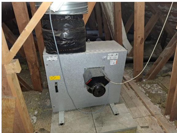
Ventilator i bygning 1 fra 2010
