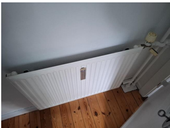
Radiator i køkken
