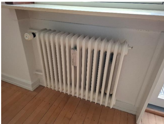
Radiator i bolig
