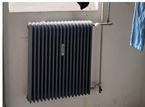
Radiator i tørrerum i kælder
