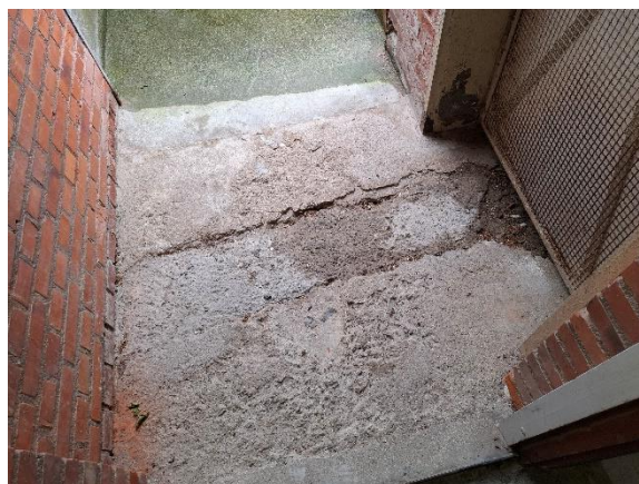
Udsparing i betongulv med afskallende beton.
