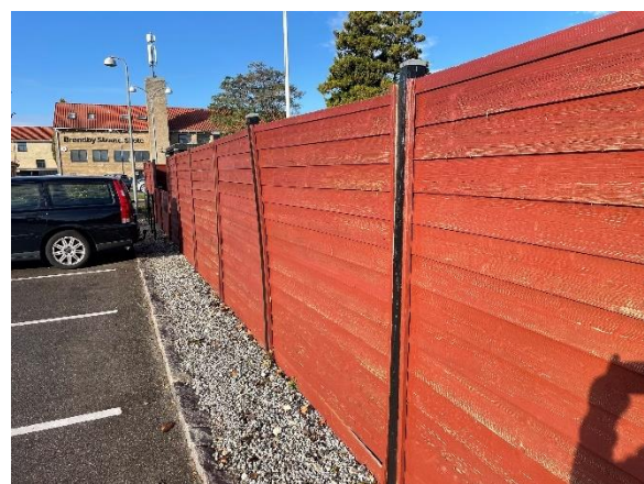
Plankeværks sektion hælder ud af
