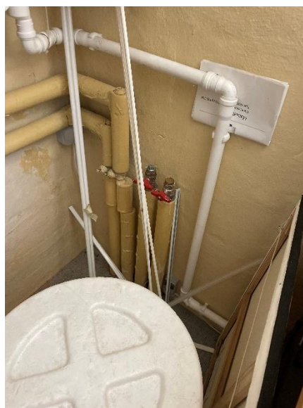
Rørledning i værksted/opbevaring
