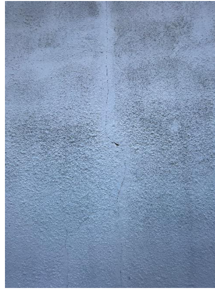
Revnedannelse i facaden
