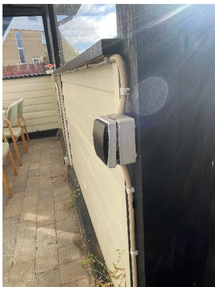
Skadet installations materiel i overdækket terrasse
