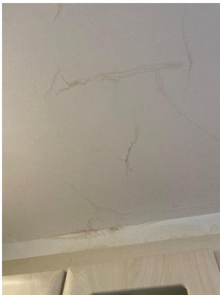
Revner i loft pudslag i værksted/opbevaring
