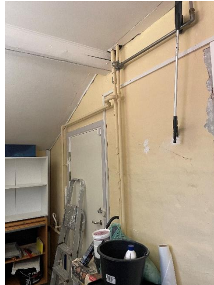
Skader på væg i værksted/opbevaring
