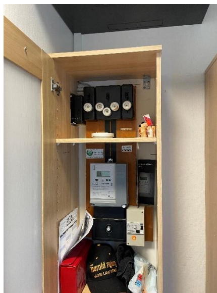
Ældre installationstavle i skab ved entre.
