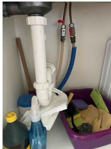
Vandinstallation under køkkenvask
