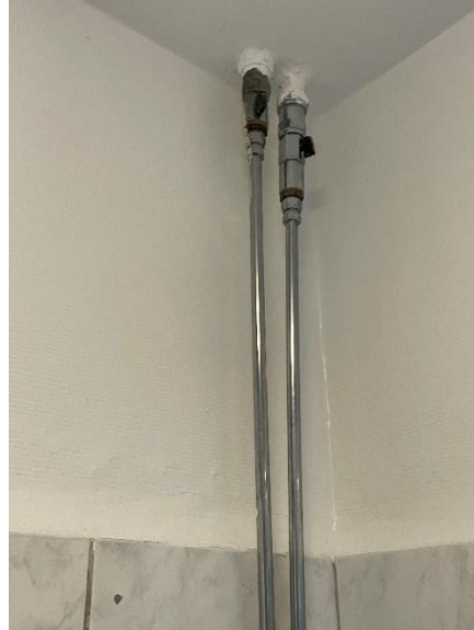
Vandrør med afspærrings ventil
