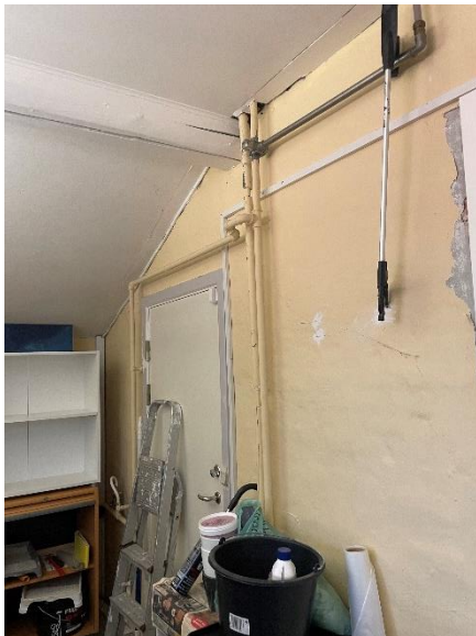
Vandrør i værkstedet/opbevaring
