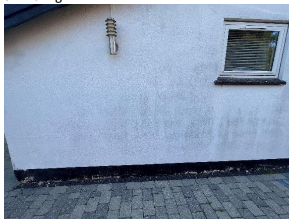
Endegavl med revne dannelse af facade samt afskalning på sokkel
