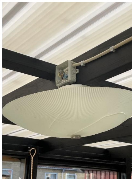
Manglende dæksel på samledåse i overdækket terrasse.
