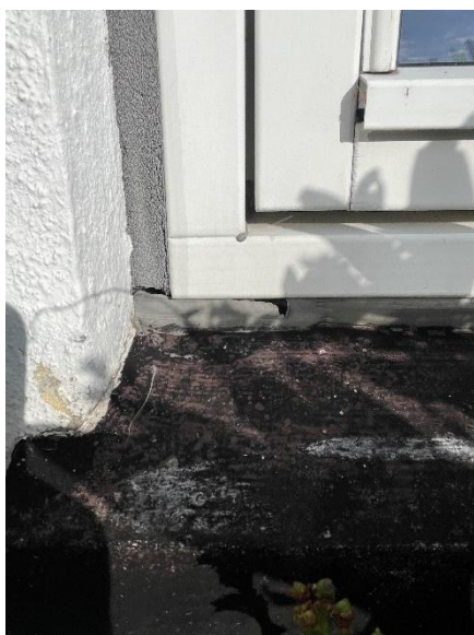
Skader på fuger
