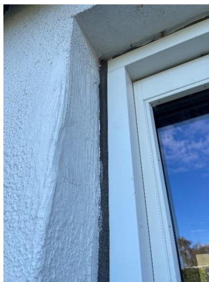
Vinduesfuger ved indgangspartiet
