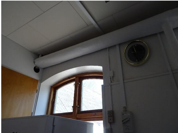
Brugsvandsfordeling i køkken
