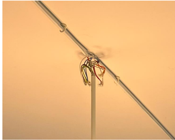
Lamper ophængt uden aflastning. Hænger direkte i ledninger.
