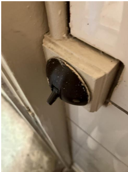
Bakelit kontakter på 1. sal. Det kan forventes at der er stofledninger fremført.
