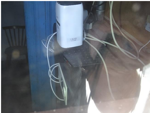
ECL styring med router set gennem vindue
