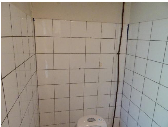
Vandforsyning til toilet i kobber
