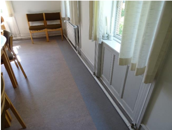
Panelradiator på et-streng
