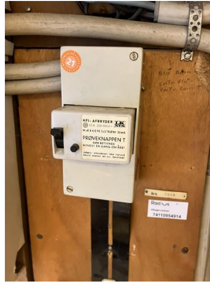
HFI relæ – bør udskiftes til HPFI.
