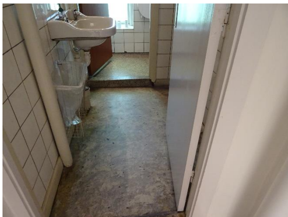
Gulv og vægge toilet i stuen nord
