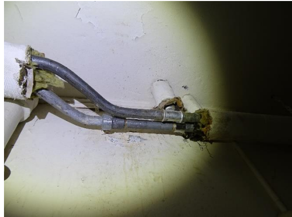
Mulige rørudskiftninger i galvaniseret stål
