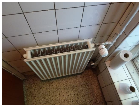
Panelradiator på toilet ved 1-lags vindue
