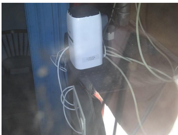
Fjernvarme unit set udefra
