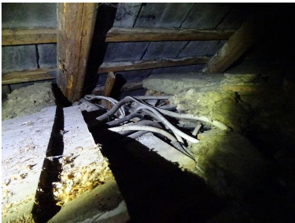
Kabler og rør på loft
