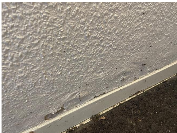
Fugtskader ved fodpanel gang.
