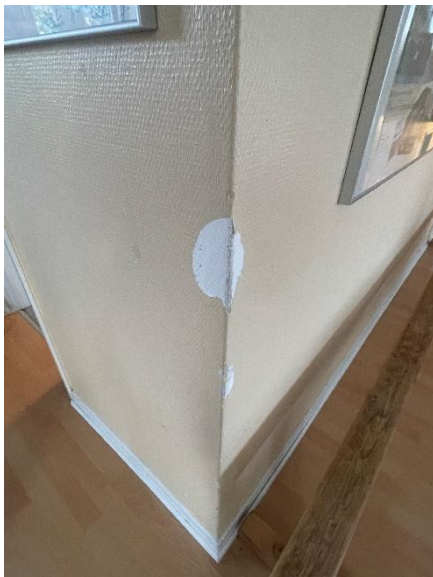
Skader på malingen i stuen
