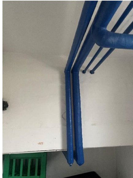
Parallel føring af vandrør og varmerør i kælder
