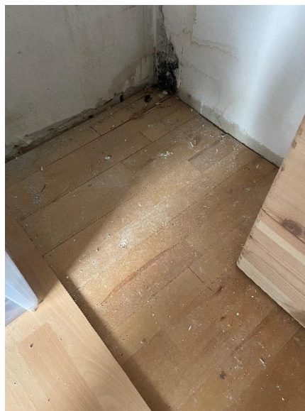
Oprindelige parketgulv under laminatgulv i det vandskadede område af østenden.
