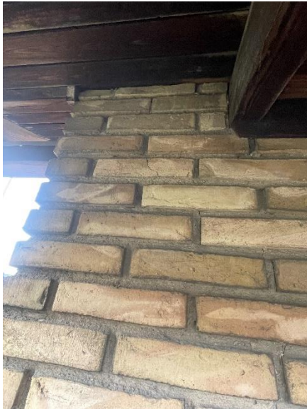
Revnet sten og fugesætning
