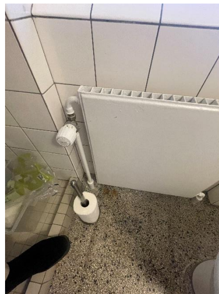
Radiatorventil på toilet
