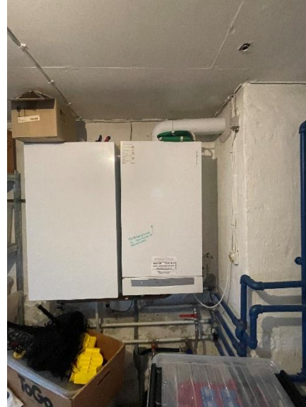
Gaskedelinstallation i kælderen
