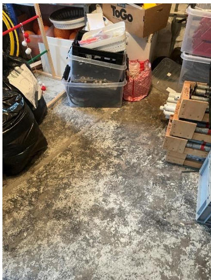
Gulvet i kælderen, opstigende fugt
