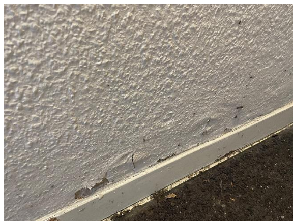
Vand/mugskader i kælder efter opfugtning.
