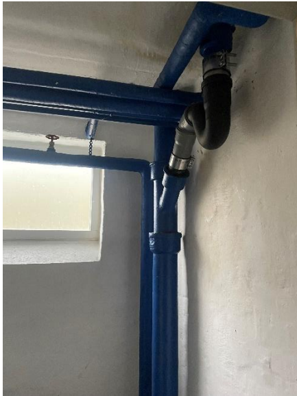
Afløbsrørene fra toilettet. I støbejern
