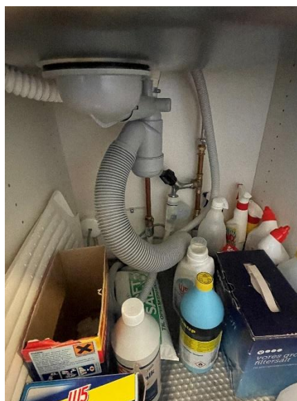
Afløbsinstallation under håndvask køkken
