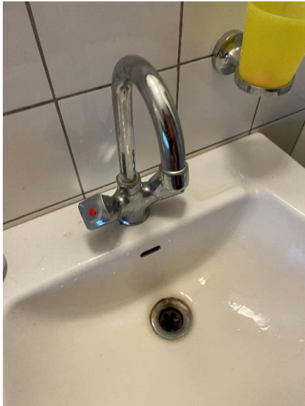
Håndvask med ældre vandarmatur
