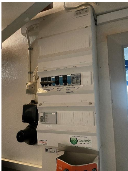
El-tavlen er placeret under trappe til hævet stueetage
