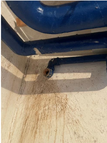
Uafsluttet vandrør i kælderens fyrrum
