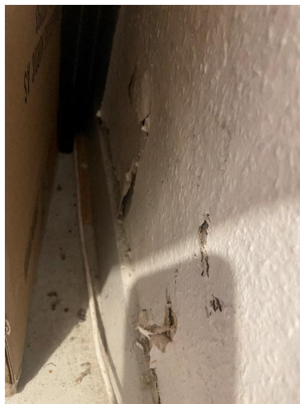
Skader på væg i kælderen.
