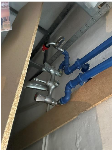
Vandhane og en blandingsarmatur i kælderrum
