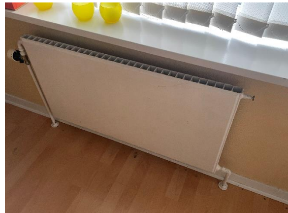
Radiator i stueetagen.
