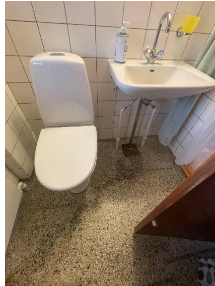
Toilet og håndvask, vandspor fra utæt radiator ses på gulvet
