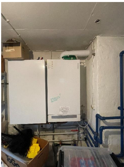
Gas kedel med varmtvandsbeholder
