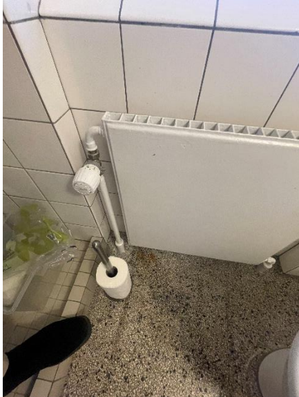
Utæt radiator på toilet
