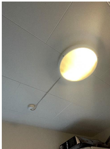
Belysningsarmatur med LED i entre
