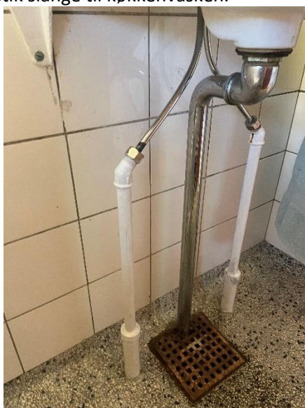
Afløb under håndvask og en gulvafløb på toilet
