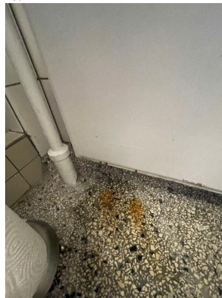
Terrazzogulv med rustspor fra utæt radiator
