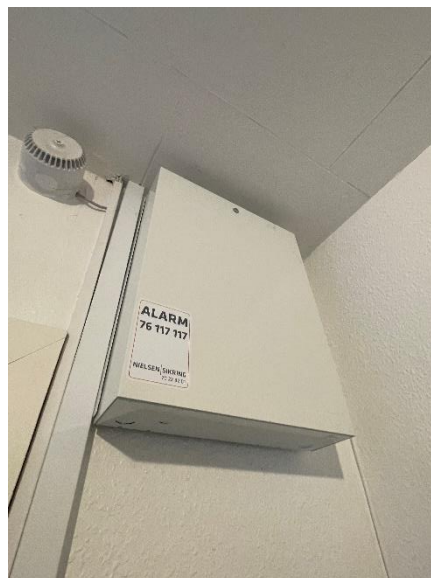
Boks til alarmcentral
