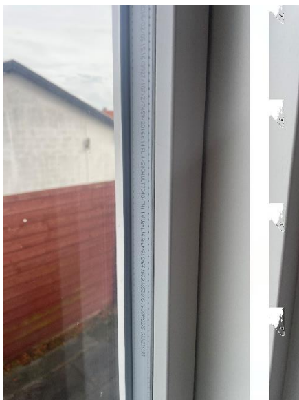
Vindue på toilet
