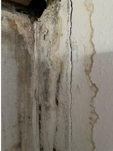
Fugtskader på vægge og lofter i den hævede stueetage del af bygningens østlige ende.
