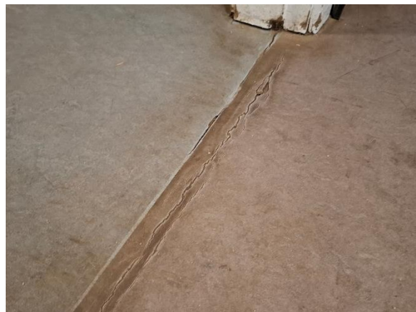
Linoleumsgulv i tilbygning og gangareal mod øst i hovedbygning er med krakeleret overflade.
