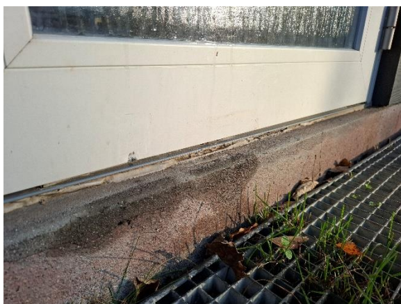
Utæt fuge under dør mod syd
