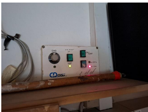
Ældre styringspanel til ventilation
