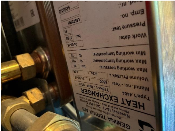
Veksler til varmt brugsvand i hovedhuset.
