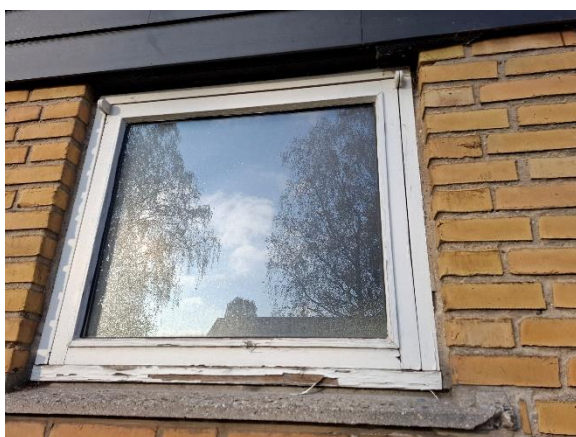
Vindue i hovedbygningen i toilet mod øst er med afskallende maling og mangelfulde fuger.
