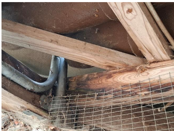
Kaninhuset er med råd i tagkonstruktionen omkring utætheder, som her ved gennemføring af holder til kameraovervågning.
