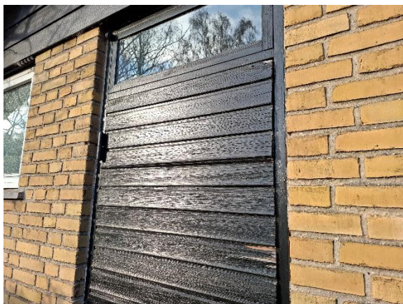
Oprindelig dør mod øst med løstsiddende beklædning og afskallende maling
