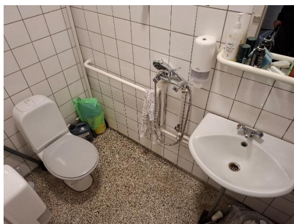
Toilet- og baderum med 2-grebs armaturer til håndvask og brusebatteri.
