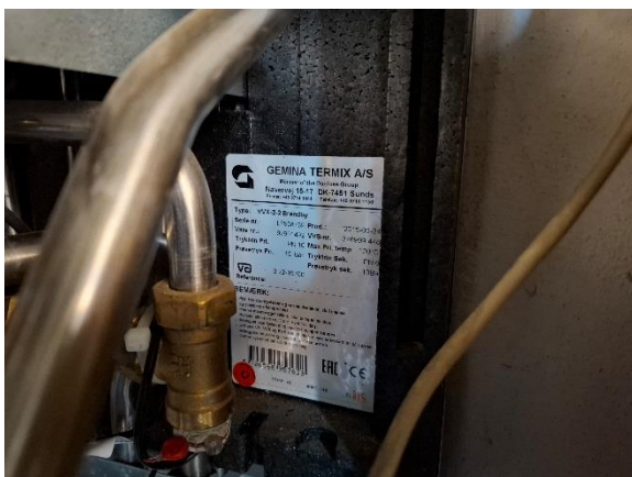
Varmeveksler i hovedhuset fra 2015
