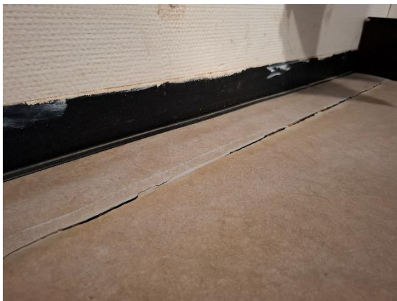
Linoleumsgulv i tilbygning er med revner og utætte svejsesfuger.
