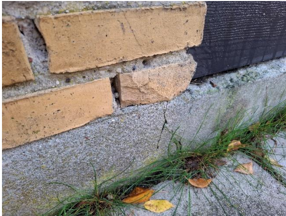
Revne i sokkel mod vest
