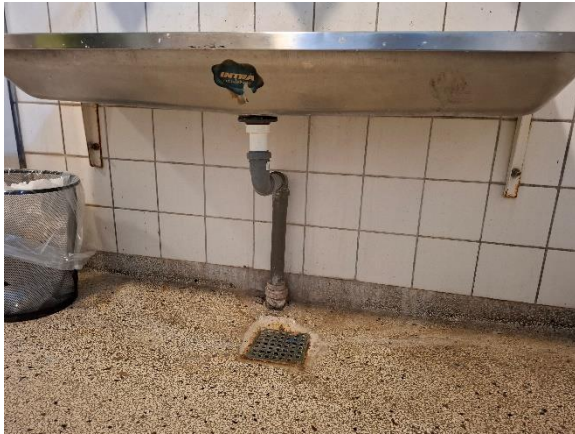
Afløb under håndvask i drengetoilettet
