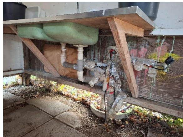
Vandinstallation i kaninhus
