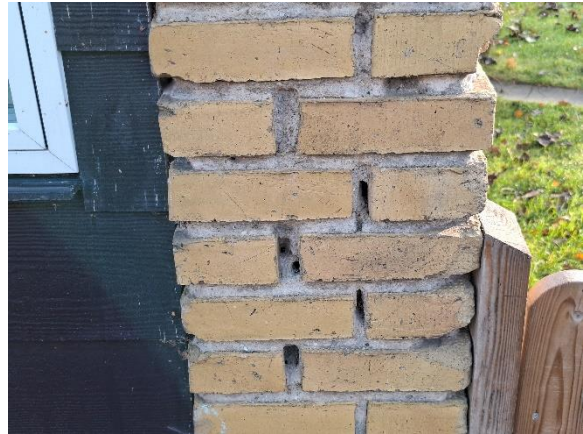
Manglende fuger i murværk mod vest.
