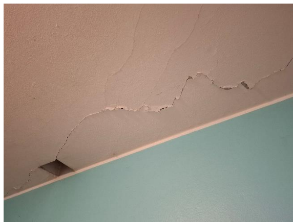
Revne i loft i toiletrum
