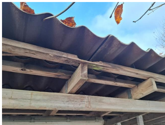
Kaninhuset er med råd i tagkonstruktionen omkring utætheder.
