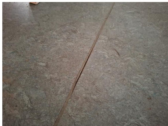
Linoleumsgulv i fællesrum mod vest er med revner i svejsesfuger.
