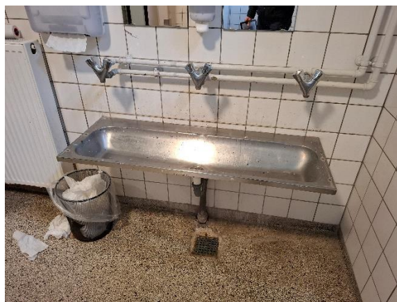
Håndvask med 2-grebs armaturer
