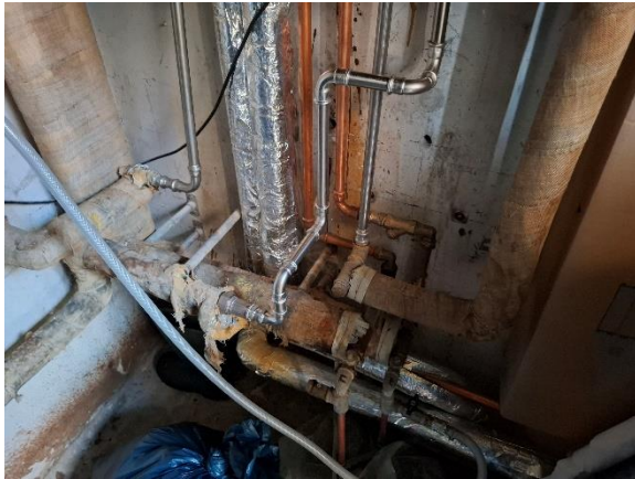
Tilslutningsrør til ny unit mangler isolering
