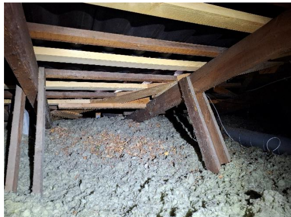
Manglende skumbølgeklodser ved skotrender betyder at blade, fygesne, fugle og dyr kan komme ind i loftsrummet.
