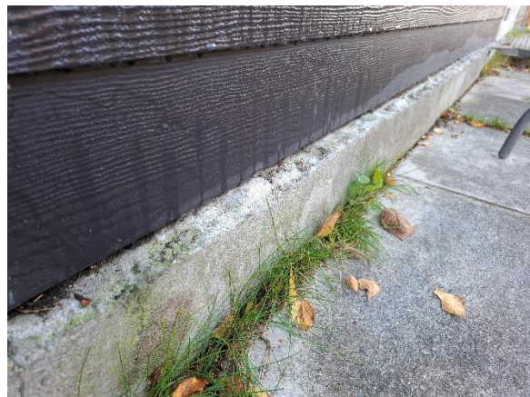
Manglende afdækning over sokkel (sålbænk) under let ydervæg mod vest.
