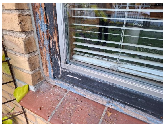
Vindue til kontor mod syd er med utætte og møre glasbånd og afskallende maling udvendigt.
