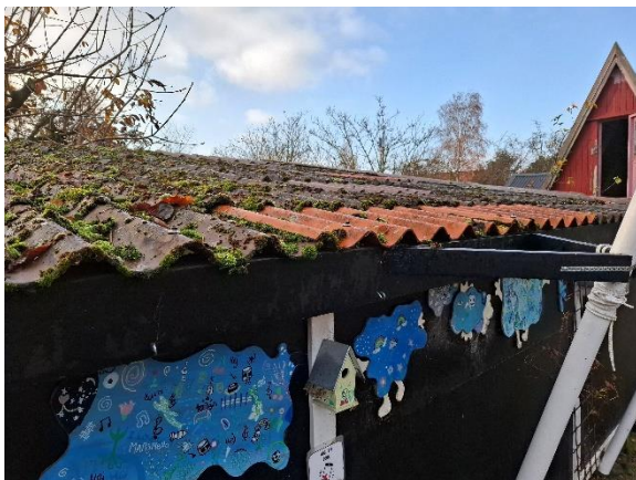
Kaninhuset er med slidt tagbelægning og flere udskiftninger af plader.
