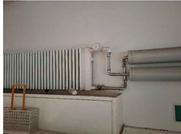
Radiator i fællesrum
