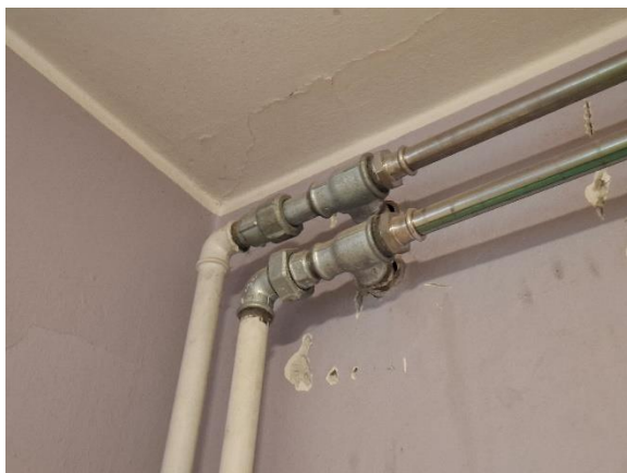
Nyere udskiftning af rør. Rustfri rør skruet på efter galvaniserede
