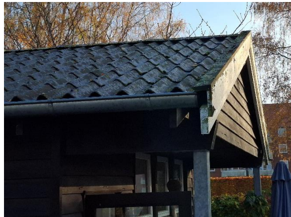
Tag på tilbygning med afskallende maling og råd i vindske.
