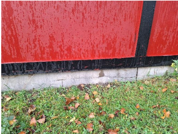
Sokkel i eternitplader er revnet enkelte steder på høladden.
