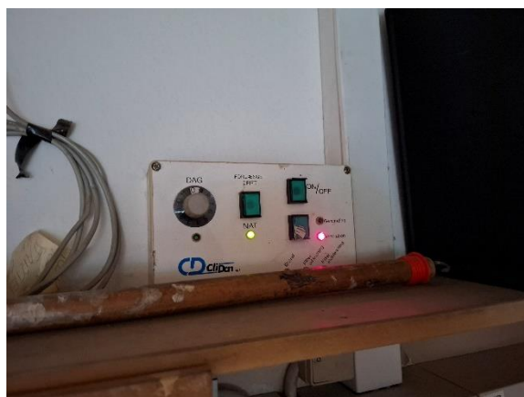
Ventilation styring fra anlæggets etablering
