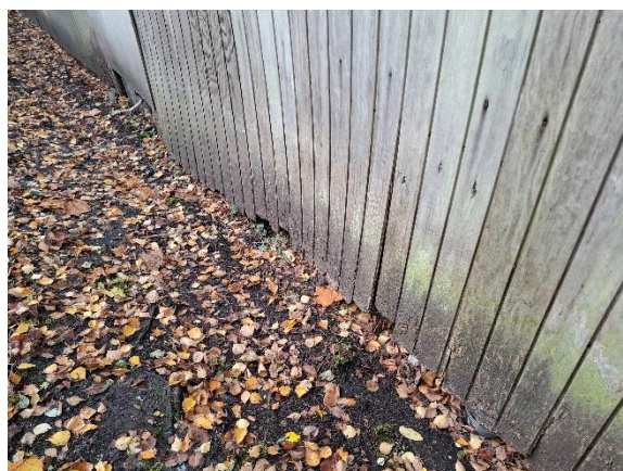
Råd i facadebeklædning på sløjdbygningen.
