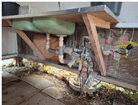
Vandinstallation i kaninhus
