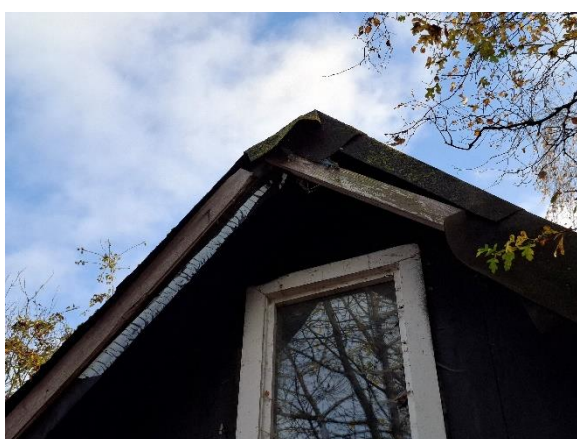
Manglende afslutning af tagpap ved vindskeder på rollespilsbygningen.
