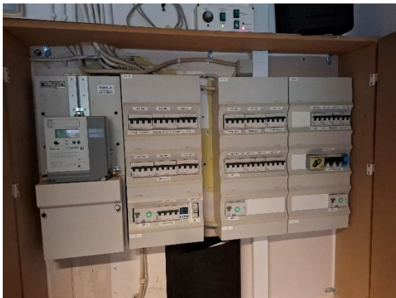
Tavle er uden større mangler. Der mangler afmærkning på enkelte grupper.
