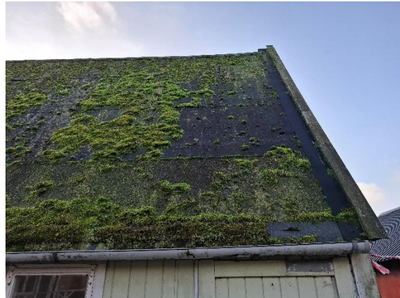
Legehuset er med utæt og hullet tag med mosbegrøninger mod nord.
