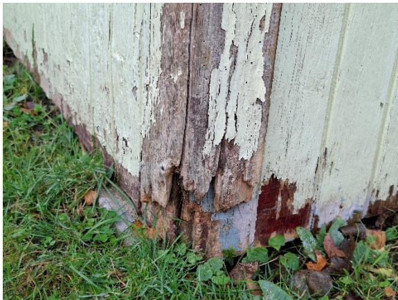
Legehus er med råd udvendig træværk flere steder.
