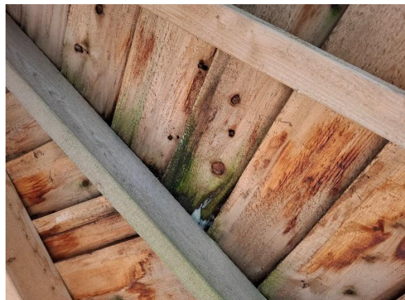
Overdækning til bålplads er med begyndende råd i planker på taget.
