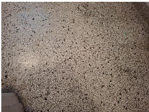
Revne i terrazzogulv i toiletrum.
