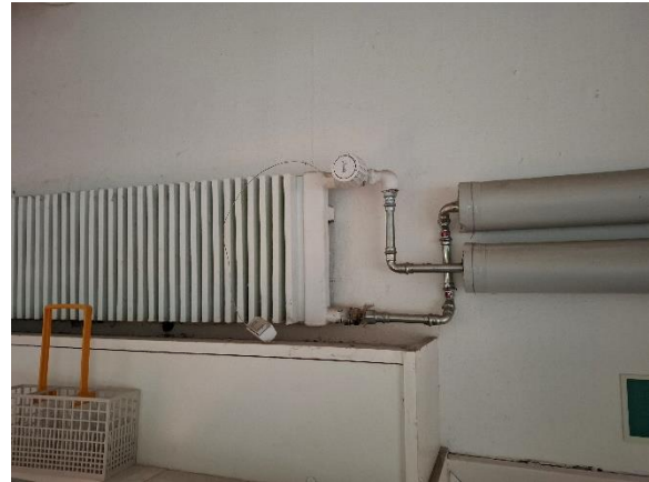
Radiator i fællesrum
