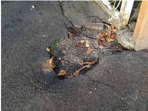
Asfaltbelægning på boldbanen er med enkelte huller.
