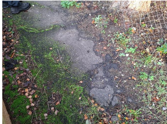
Asfaltbelægning omkring boldbane er revnet og krakeleret og trænger til udskiftning.
