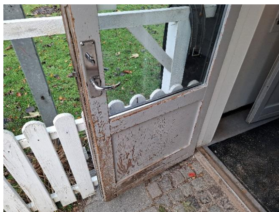
Slidt hoveddør i tilbygningen.
