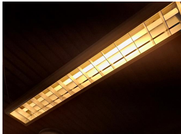
HF-armatur i fællesrum
