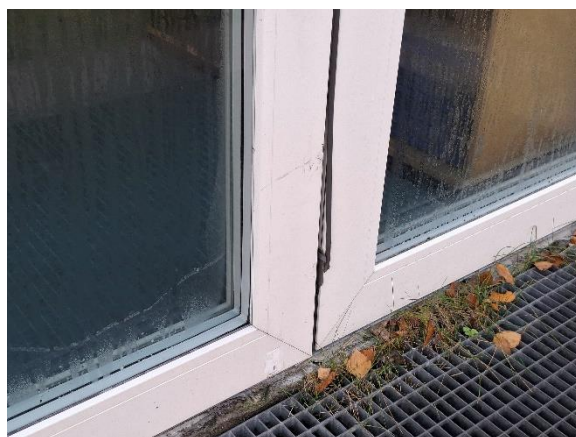
Tætningslister er løse på dobbeltdøre mod vest.
