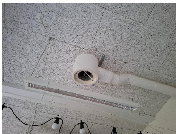
Armaturn i fællesrum mangler rist.
