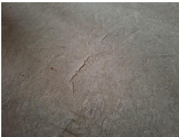
Linoleumsgulv i fællesrum mod vest er med revner
