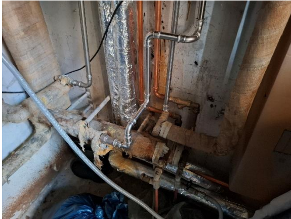
Tilslutningsrør til ny unit mangler isolering
