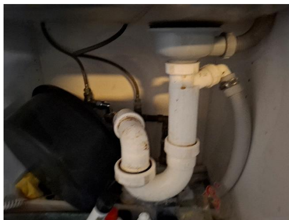
Afløb under køkkenvask
