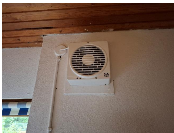
Lokal udsugning på kontor.
