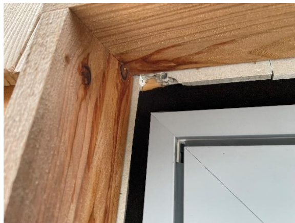
Vindspærre beskadiget over dør.
