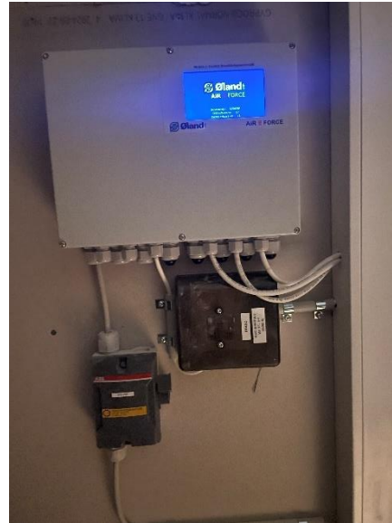
Brandsikringsautomatik til ventilationsanlæg
