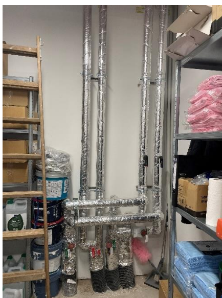
Varmerør i opbevaringsrum
