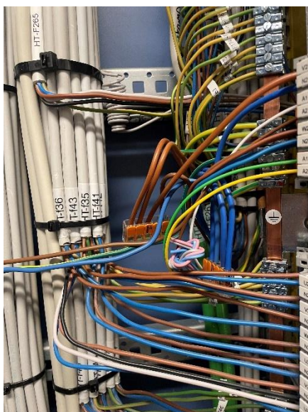
Løse ledninger med samlemuffe i kabelfelt i tavlen, ikke lovligt.
