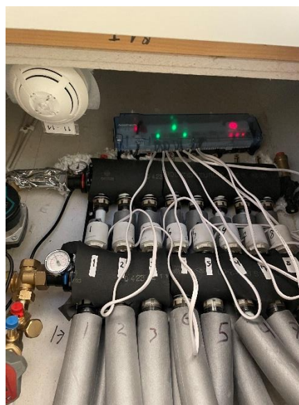
Gulvarmecentral for en sektion af bygningen
