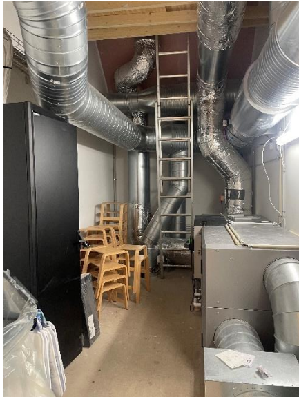
Ventilationsanlæg placeret i teknikum på 1.sal
