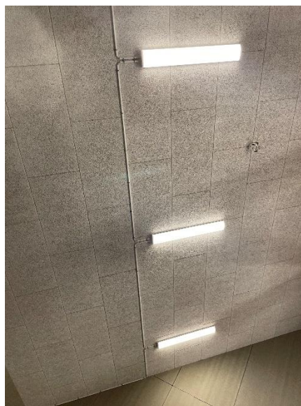
LED armaturer i liggehallen
