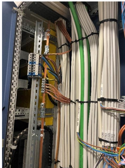
Løse og blottet ledninger i kabelfelt i tavlen, ikke lovligt.
