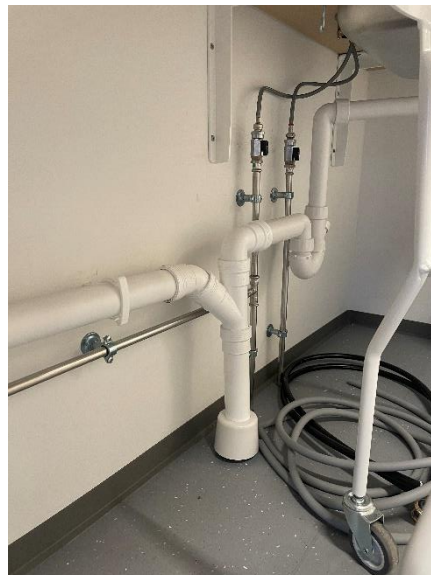
Rørinstallationer under vaske i toilet.
