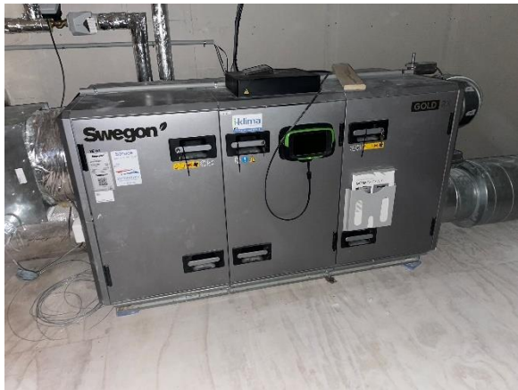
Aggregat for ventilationsanlæg VE01
