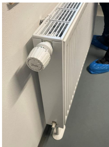
Radiator koblet på to strengs system
