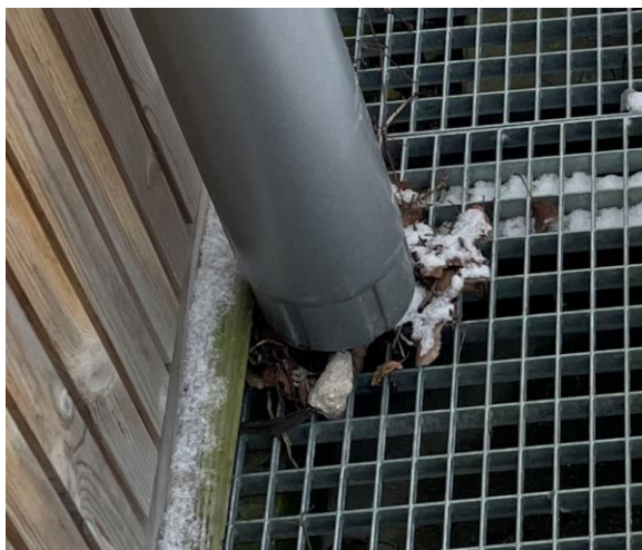
Skidt fra tagrender fanges i nedløbsrør på rist over sokkelaffugter
