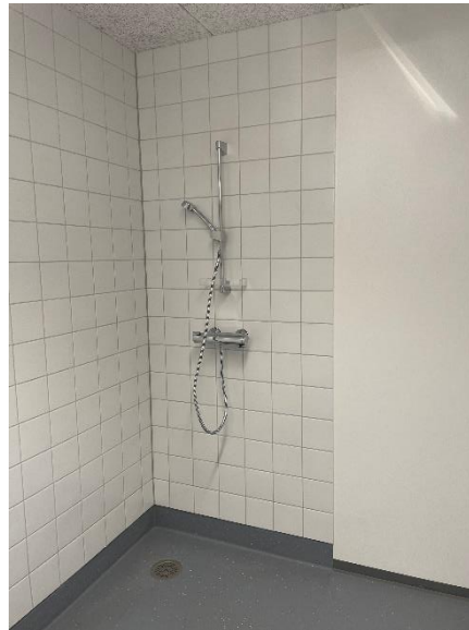
Ved brusearmaturer er der afløb og vægge beklædt med fliser. Der mangler skærmvæg for beskyttelse af den malede væg.
