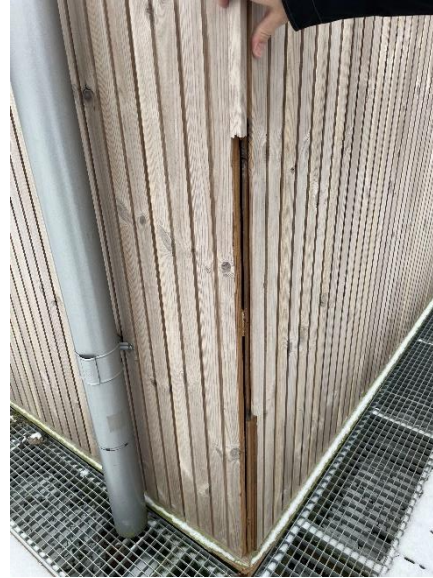
Beskadiget hjørne af facade i gård
