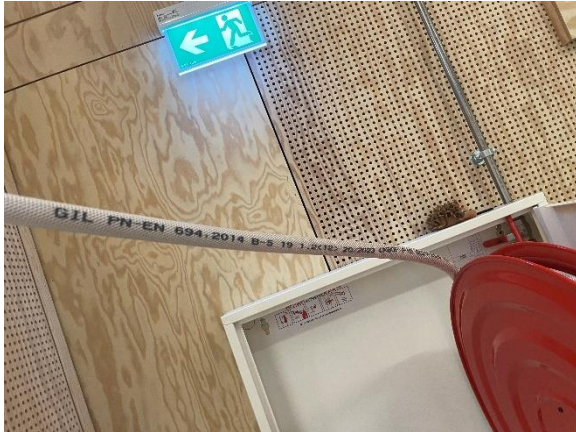
Brandslange tilkoblet bygningens brugsvand
