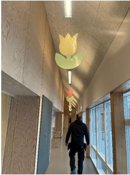
LED armaturer på gang samme som resten af bygningen
