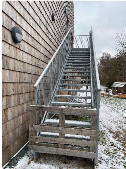
Den udvendige brandtrappe med improviseret låge af en europalle monteret med strips
