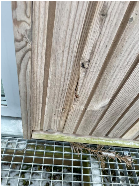
Flækket bræt og revne ind i facaden. Træ afvander på træ ved sokkel.
