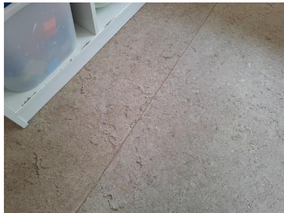
Linoleumsgulv med slidmærker og sluppet svejsefuge.
