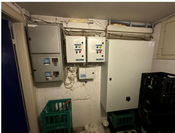
Automatiskskab ved pumpestyringer
