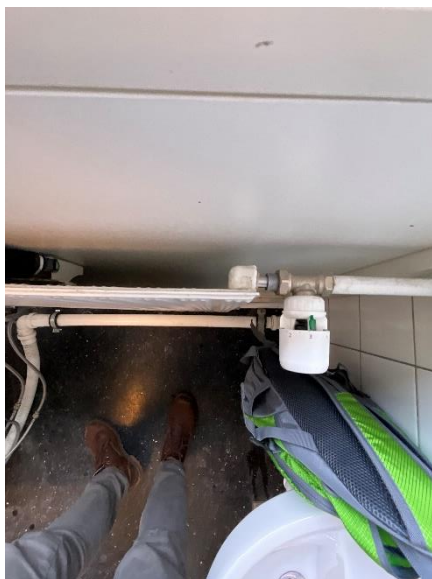
1-lags radiator fra opførelsen af den oprindelige bygning
