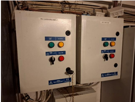
Nyere styring til grundvandspumper
