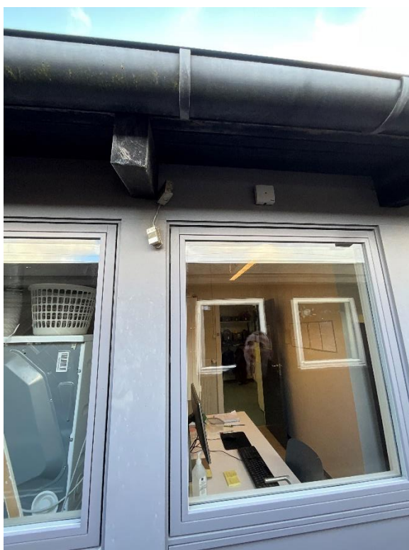
Udeføler til gammel fjernvarme unit ej demonteret
