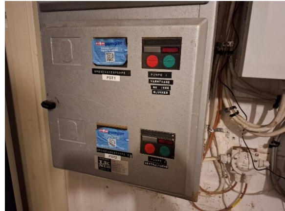
Ældre styring til grundvandspumper i teknikrum
