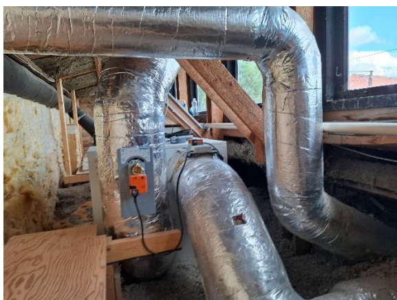
Kanaler på loft med lamelmåtte
