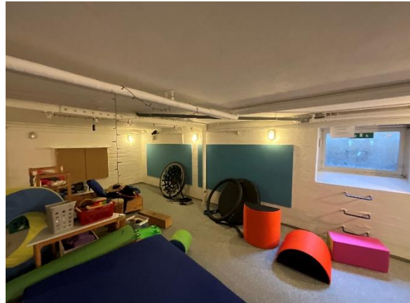
Varmerør i kælder
