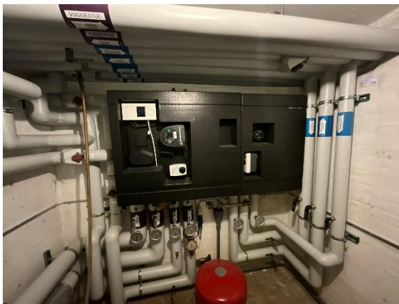
Fjernvarme unit fra 2023
