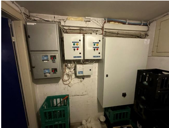
Automatiskab ved pumpestyringer
