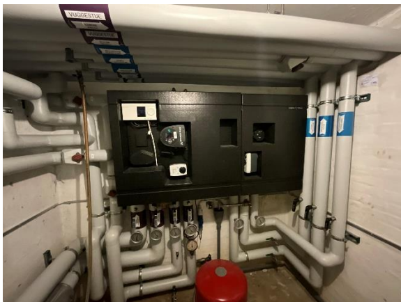
Fjernvarmeunit med brugsvandsveksler
