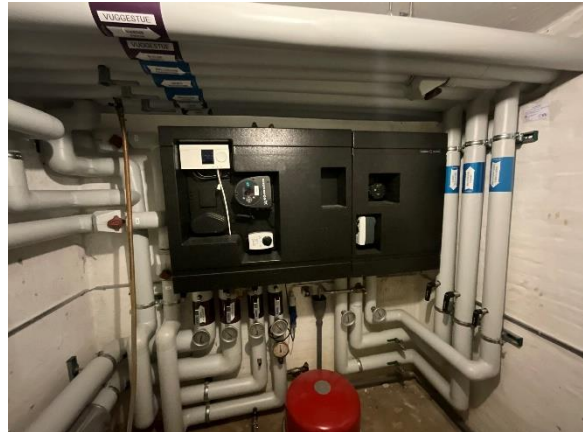
Gennemstrømningsveksler ved fjernvarmeunit
