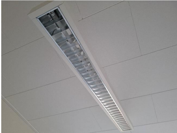
HF-armatur på stue
