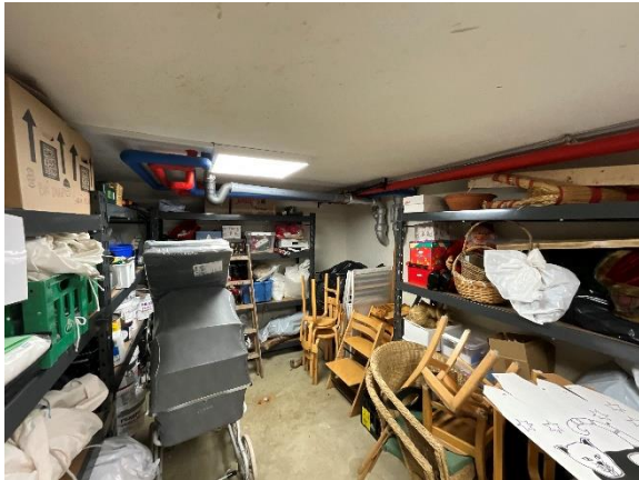
Varmerør i kælder
