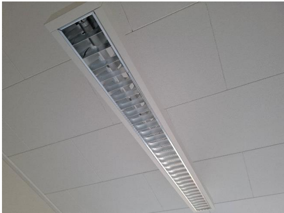
HF-armatur på stue
