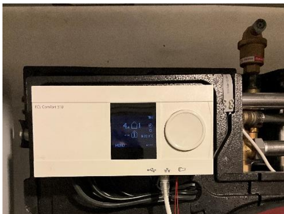
Varme klima styring
