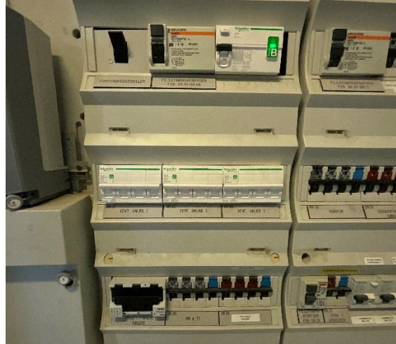
Mindre mangler ved afdækning.
