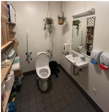
Personale- og gæstetoilet med to-grebs håndvask batteri
