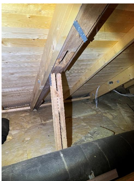
Vestfløj, lofttrum isoleret med 300 mm glasuld
