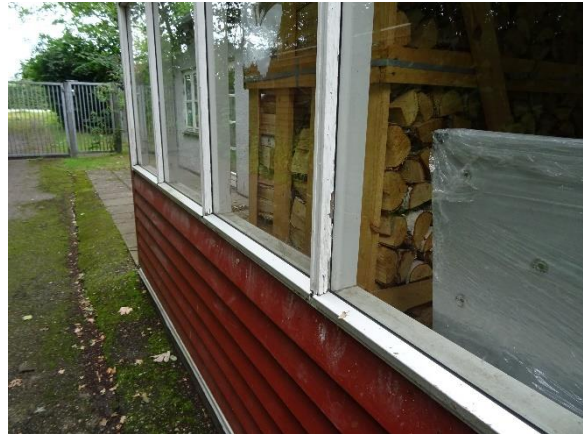
Råd i glaslister på karnapbygning, 1996 vinduer
