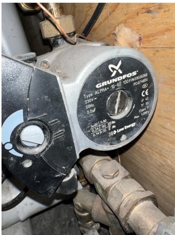
Gulvvarme pumpe fra 2007
