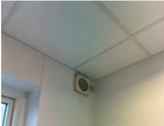
Lokal mekaniske udsugningsventilator
