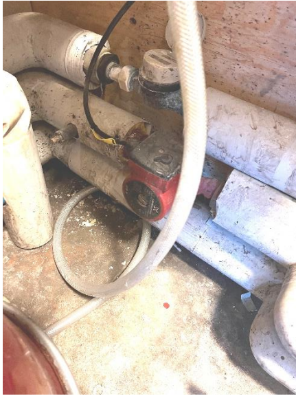
Trinstyret varmfordelingspumpe i varmecentral
