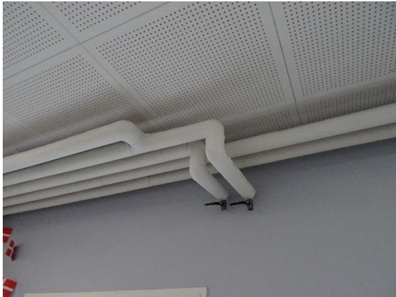
Døde ledninger efter nedlagt tapsted, ventiler bør afpropes!
