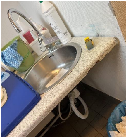
Beskadiget laminat på bordplade
