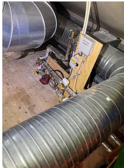
Trinstyret pumpe ved ventilationsanlæg
