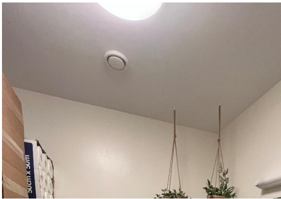
Udsugnings ventil på Toilet
