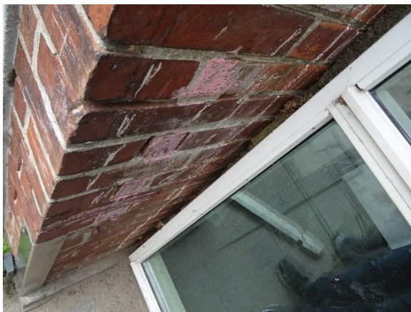
Fugebånd er faldet helt ud og isolering blottet
