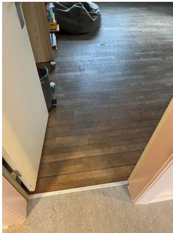
Ældre parketgulv, med skade på stav
