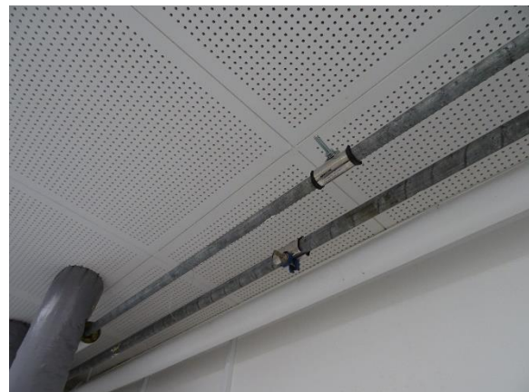
Synlig rørføring i galvaniseret, bandager efter tæring
