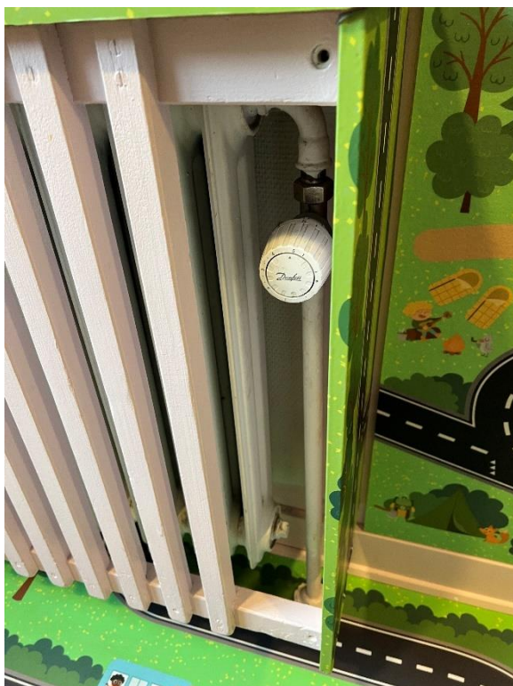
Søjleradiator og termostat bag skjuler
