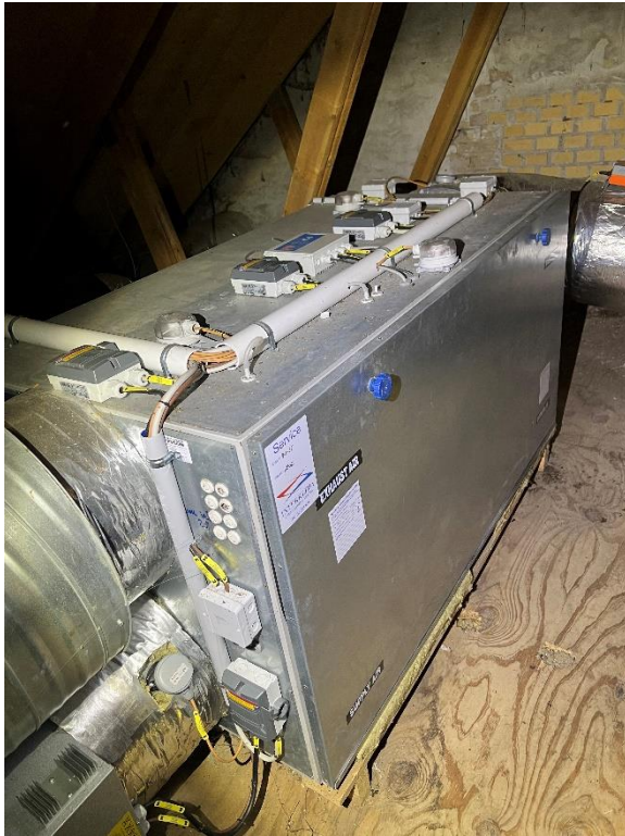
Aggregat og kanaler på loft
