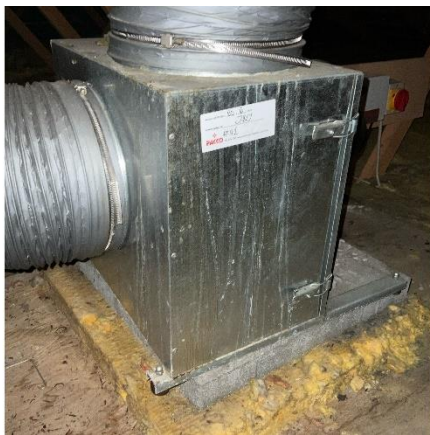
Udsugningsanlæg placeret på loft
