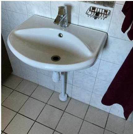
Afløbsrør i plast
