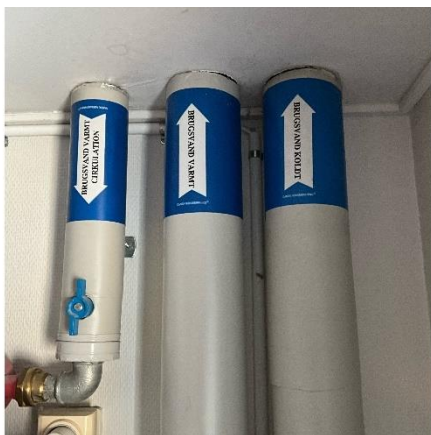
Brugsvands- og cirkulationsrør
