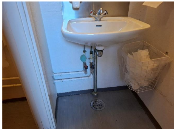
Afløbsinstallation under håndvask
