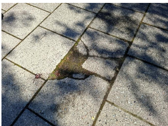
Revne fliser ved cykelparkering
