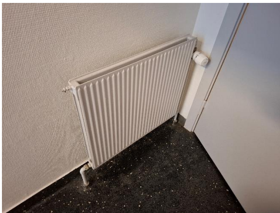
Radiator i toiletrum i vestfløj
