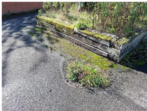
Bevoksning i revnet asfaltbelægning
