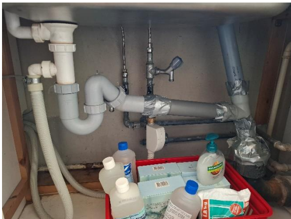
Afløbsinstallation under køkkenvask i lærerværelsets køkken er tætnet med gaffatape.
