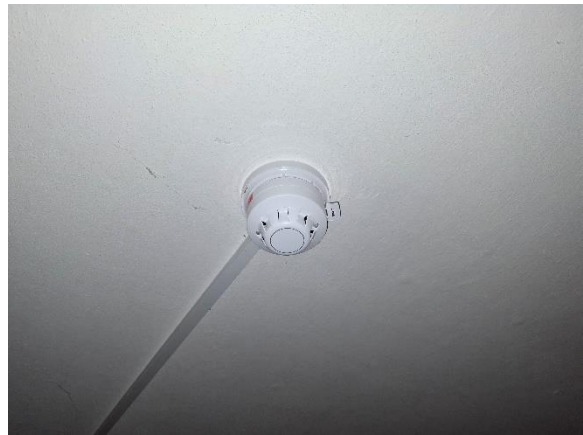
Røgmelder i kælderlokale
