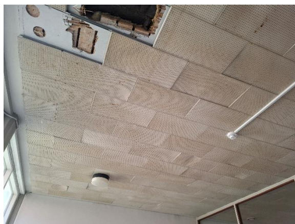
Løfter i omklædning er gulnet og med slagmærker på alle plader.
