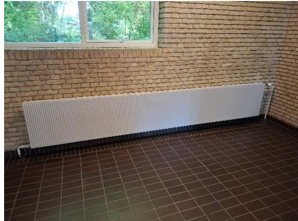
Radiator med termostatventil i trappeopgang i nordfløj
