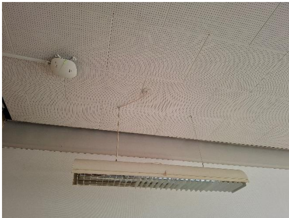
Ældre belysning med HF-armatur i klasselokale
