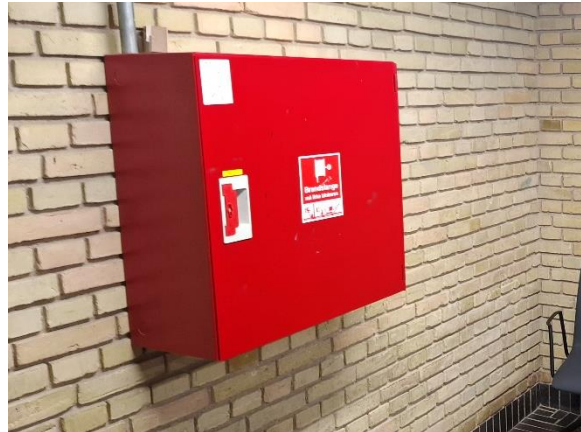
Slangevinder i kælder
