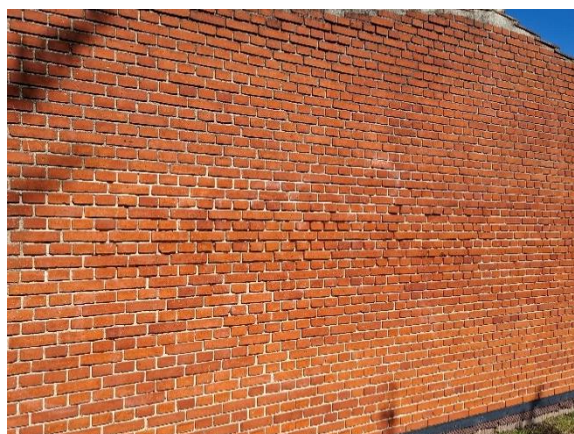
Manglende murværksfuger på fysikbygningen.
