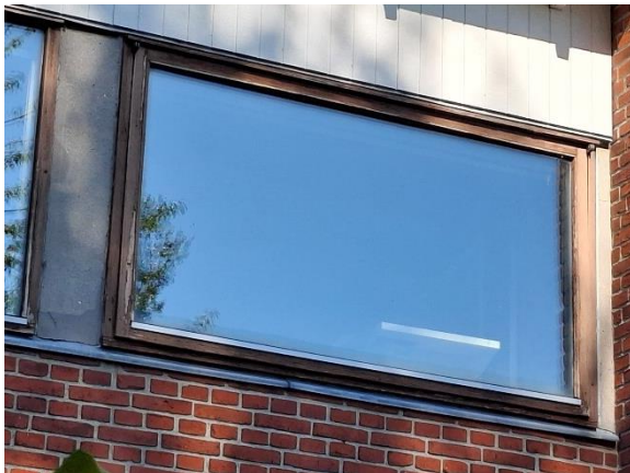
Vindue til sal er med afskallende maling
