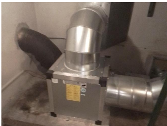
Boksventilator i vestfløj
