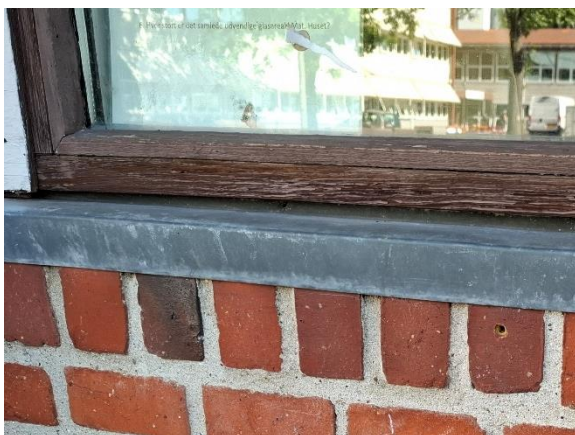
Begyndende afskallende maling på vindue til matematikbygningen
