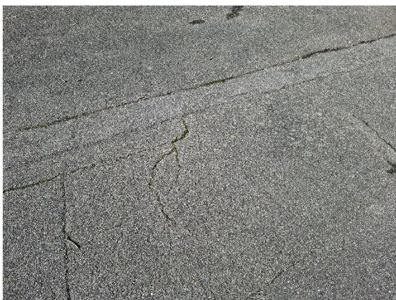
Revner i asfaltbelægning.
