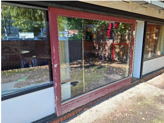
Skydedør i matematikbygningen er med afskallende maling.
