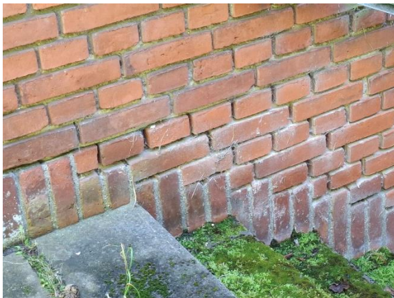
Manglende fuger ved trappe til kælder
