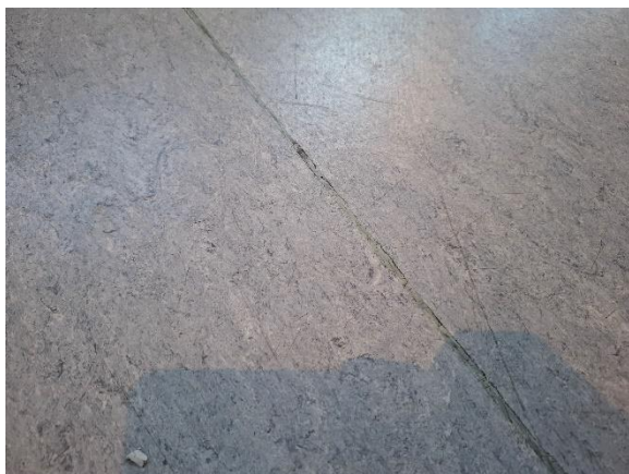
Løs svejsefuge i linoleumsgulv i lærerværelse.
