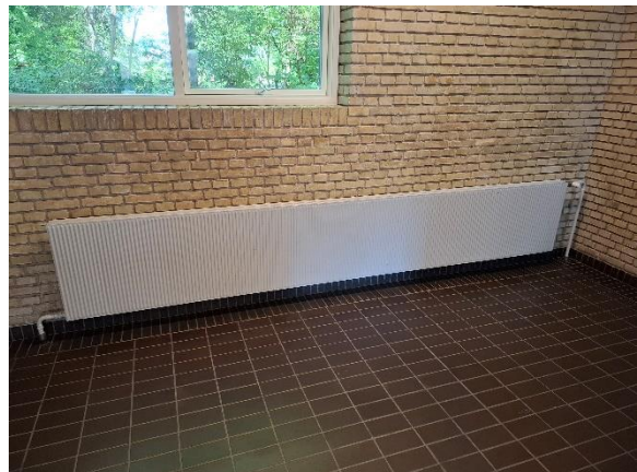
Radiator med termostatventil i trappeopgang i nordfløj
