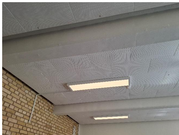
Ny LED belysning i skolekøkken.
