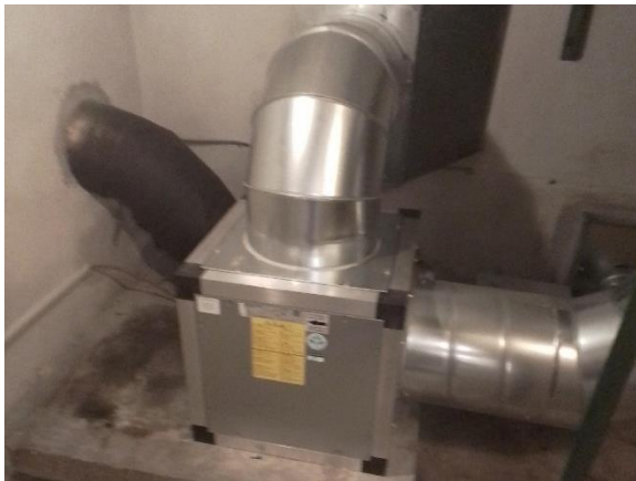
Boksventilator i vestfløj
