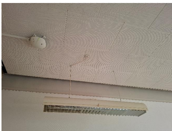
Ældre belysning med HF-armatur i klasselokale
