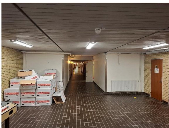
Overflader i kælder i nordfløj
