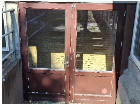
Dør til mellemgangen til teatersalen mangler flere alukapsler udvendigt.
