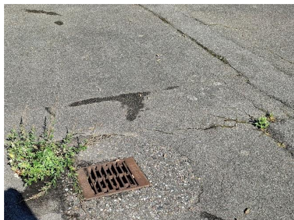
Bevoksning i revnet asfaltbelægning
