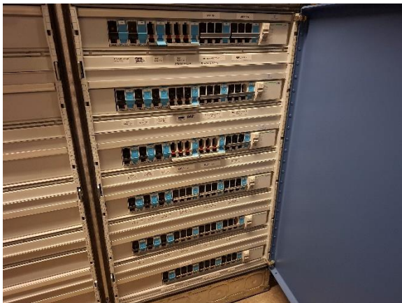
Hovedtavle i kælder fra 2012
