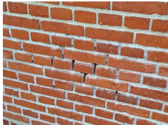
Manglende fuger på ydervæg
