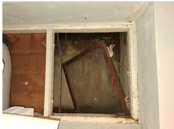
Kældervindue er faldet af.
