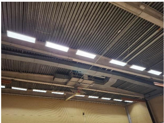
Anlæg ikke muligt at tilgå under besigtigelse.
