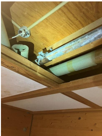
Repklemmer var anvendt flere steder i ejendommen. Brugere klagede over at det skete ofte at der dryppede fra installationen.
