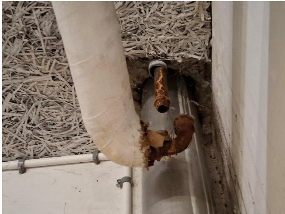
Tæret vandinstallation taget ud af drift.
