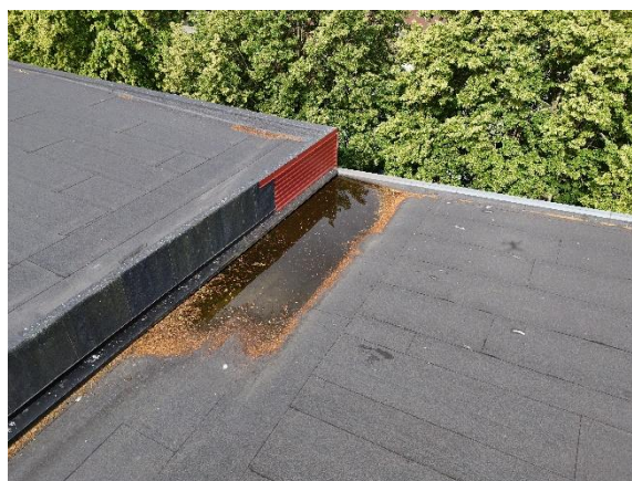
Stående vand ved afløbsbrønd mod sydvest på sportshallen.
