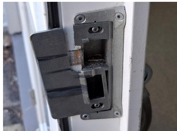
Ødelagt låseblok på dør til indre gård.
