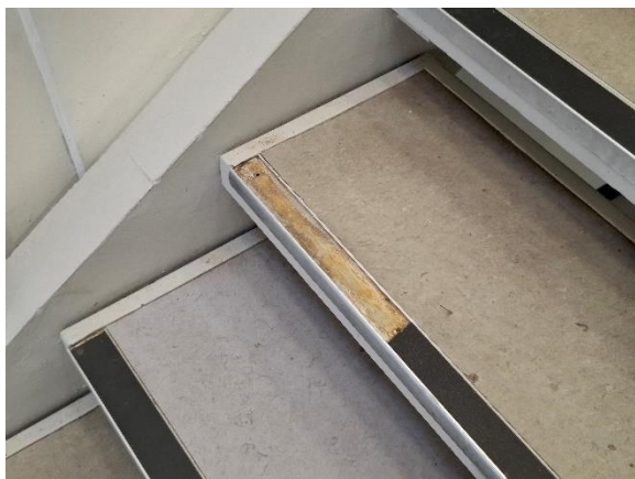
Hovedtrappe i skolen, manglende skinne ved trinforkant
