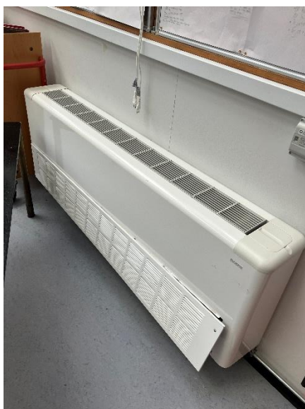
Fancoil-radiatorer i bibliotek
