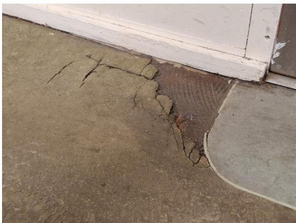
Linoleumsgulv i bygning Rød er krakeleret med blotlagt klæber.
