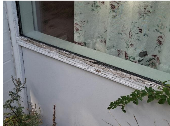
Rådden glasliste under fastkarmsvindue i facadeparti.
