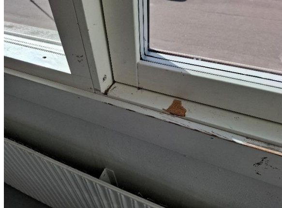
Slidte karme på vindue i gang.
