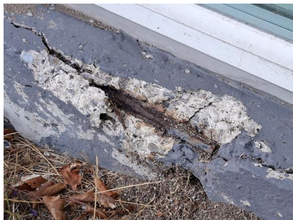
Afskalning med korroderet jern på sokkel.
