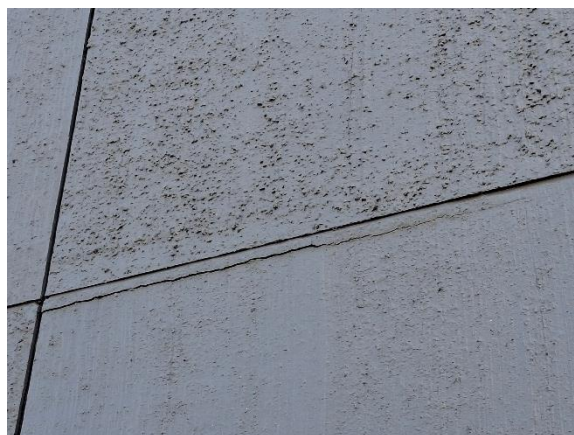
Betonelementer er revnet i overkant ved vandret element-samling enkelte steder.
