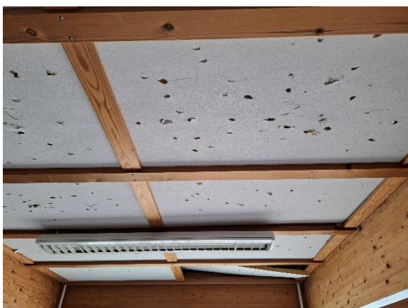
Hullede lofter i FSO med løse plader.
