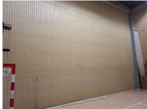
Kuldebroer ved lægter og skråstivere er synlige efter mange års aflejring af skidt på de kolde fugtige overflader.
