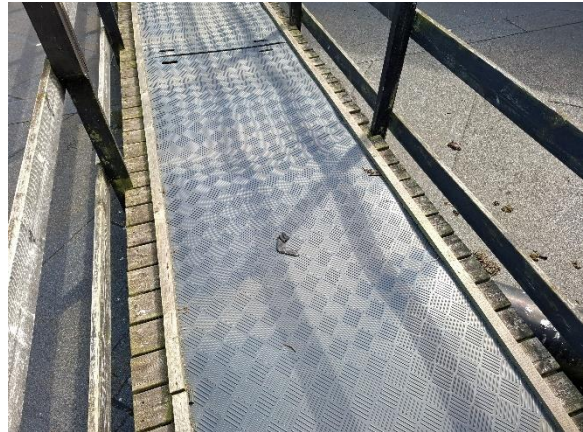
Bølgende belægning på gangbro til sportshal giver faldrisiko.
