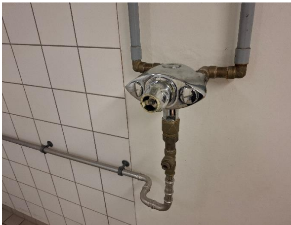
Lokalstyret temperatur, forsynet via galvaniseret, fordelt via presfit
