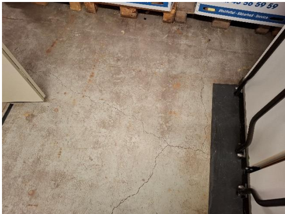
Mindre revner i betongulv i kælder.
