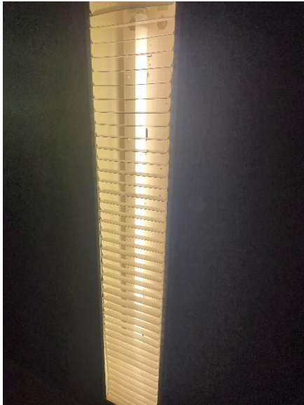
Belysning med lysstofrør
