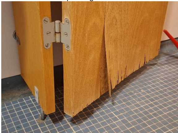
Spanske vægge i rengøringsrummets toilet- og baderum er med afskallende finer.
