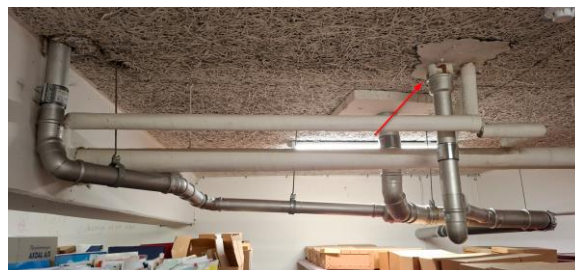
Dele af afløb udskiftet. Men tydelige tæringstegn på resterende.
