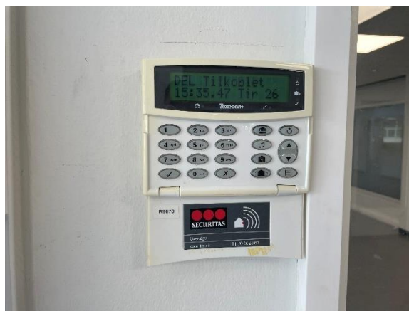
Alarm panel på skolen ved hoveddøren
