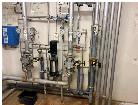
Rørinstallationer til varmeanlægget
