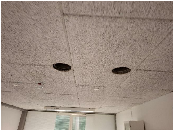
Manglende ventilationshætte og dermed manglende indregulering.
