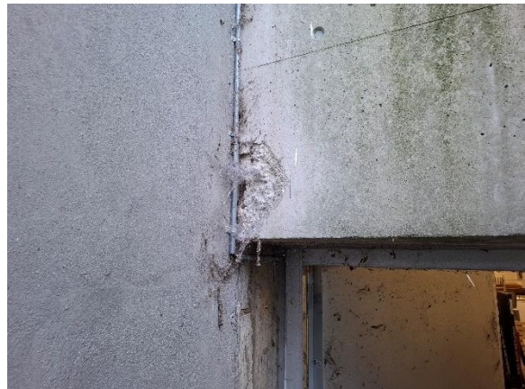
Afslag i betonen over kælderdoor.
