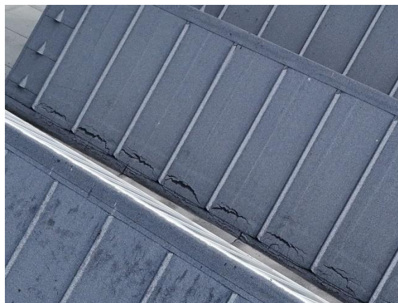
Belægning på tagpap er gledet ned på rytterlys mod nord, bygning gul
