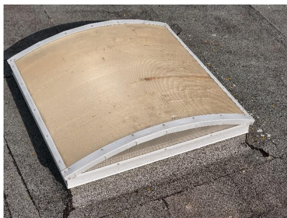
Ovenlys på bygning gul med revner.
