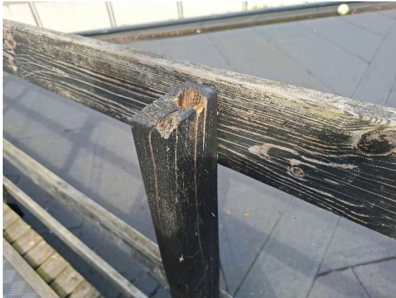
Råddent træværk gangbro sportshal
