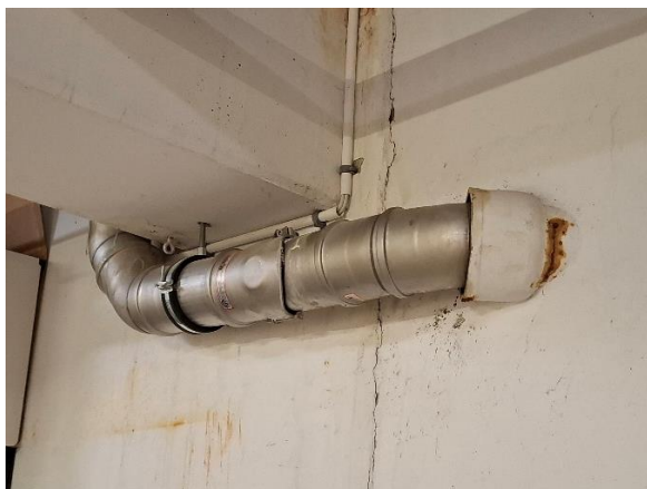
'Synlig' installation skiftet, installation i væg med tegn på mikrorevner/utætheder
