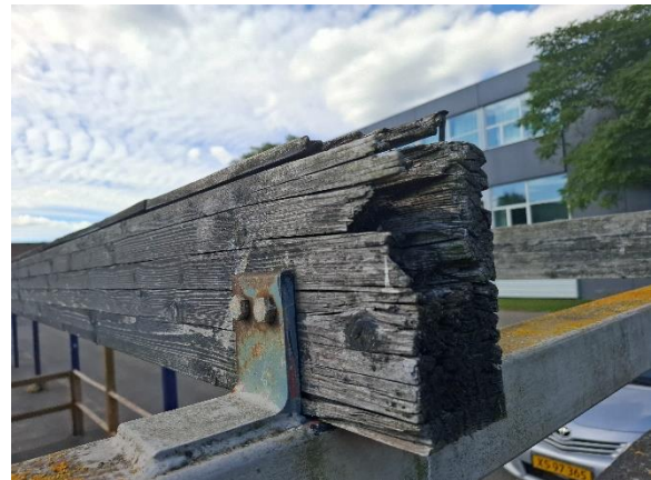
Træbjælker i forbindelse med affaldsskur syd for skolen er nedbrudt og anbefales udskiftet.
