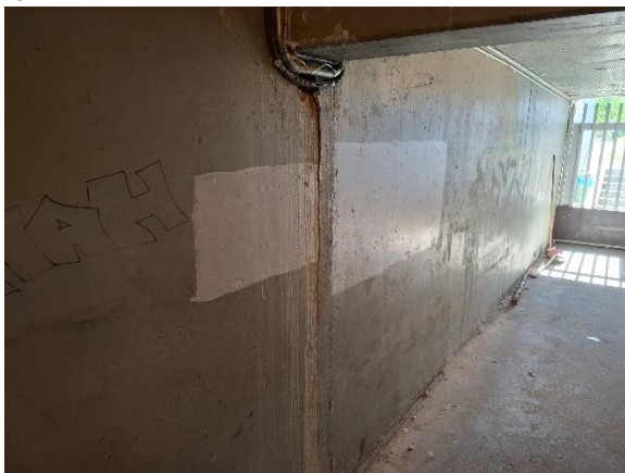
Større afslag og korroderede blottagte jern under bjælke i cykelkælderen.
