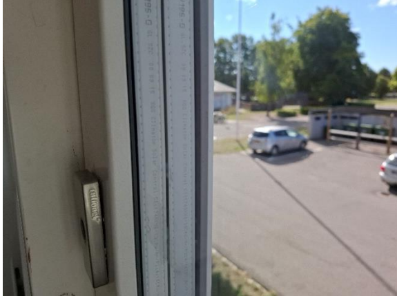
Demonteret greb efter dreje/kip-funktionen er gået i stykker på vindue i gang.
