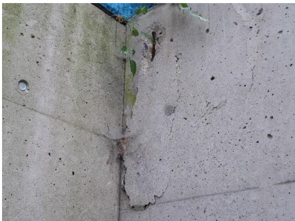
Afslag i betonen og blottet korroderet jern over dør
