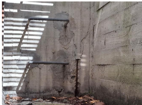
Blottet jern og afslag i betonen i lyskasse ved rengøringsrum.
