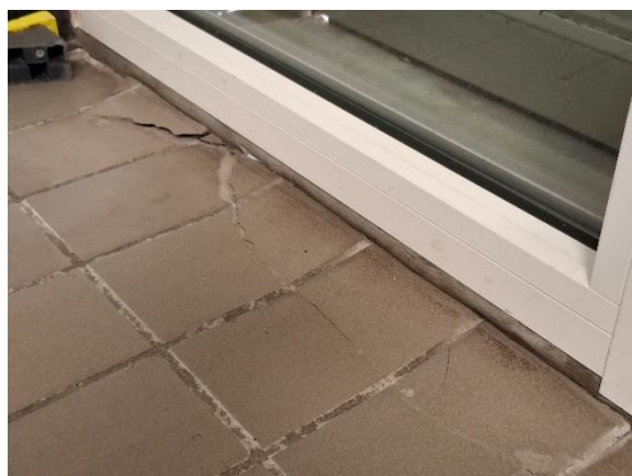
Revnet flisebelægning mod adgangsdør i klubben
