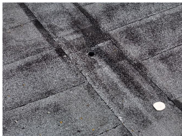
Tagbrønd bygning Rød mangler bladfang
