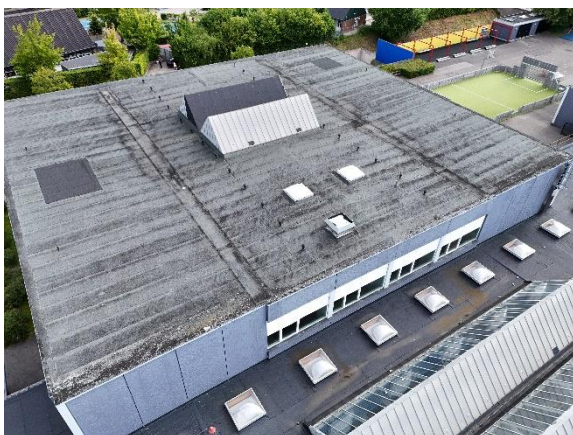
Tagflader bygning Rød med lapninger af tagpapbelægning og rytterlys.
