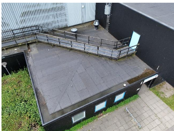
Stående vand i tagrende over drengeskolebygningen til sportshallen.
