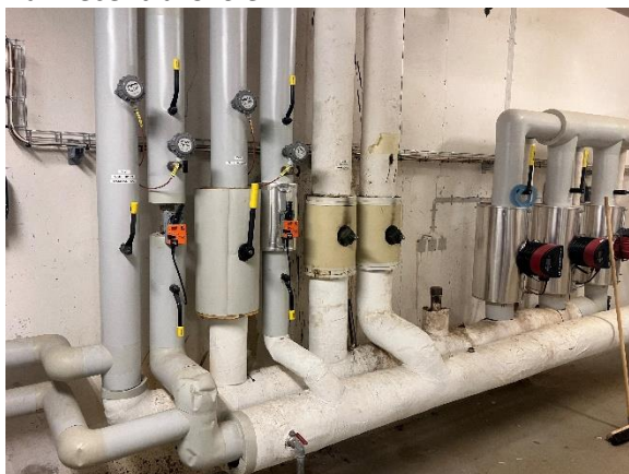
Original installation delvist udskiftet ved tilkobling på fjernvarme
