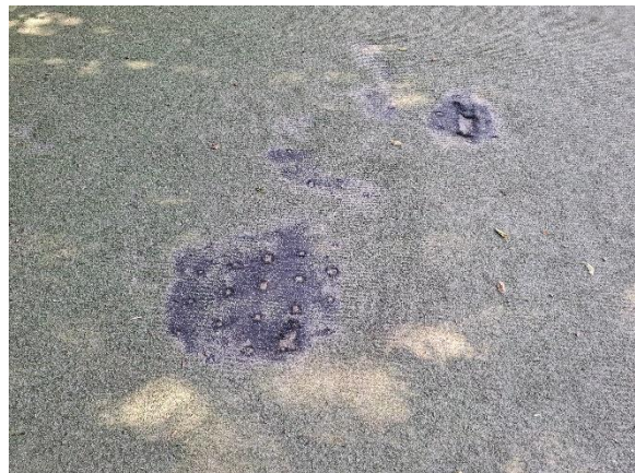
Nedslidt kunstgræsbelægning på boldbanen til SFO
