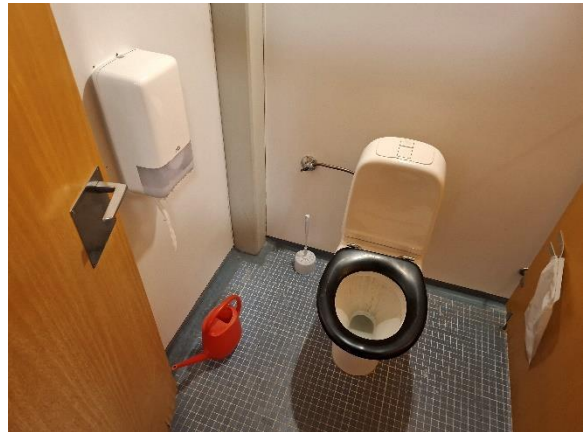
Gammelt toilet i rengøringsrum i kælderen
