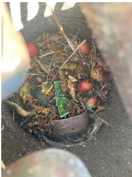
Kloak afløb i terræn er fyldt med skidt.
