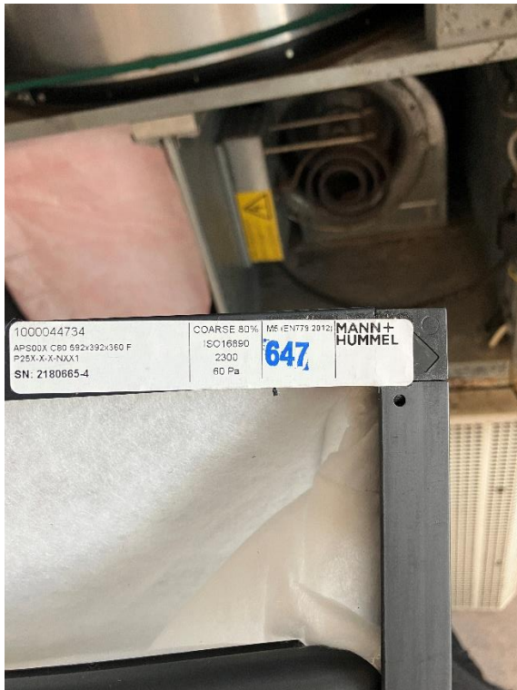
Ventilations filter som nyt
