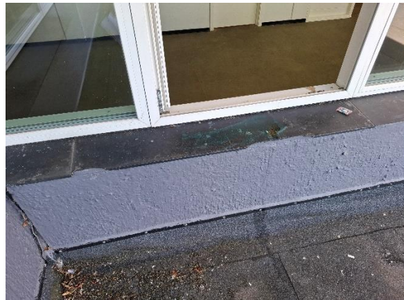
Beskadiget sålbænk under vindue som anvendes til adgang til tagflader.
