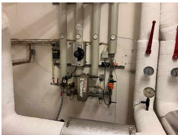
Rørinstallationer til varmeanlægget
