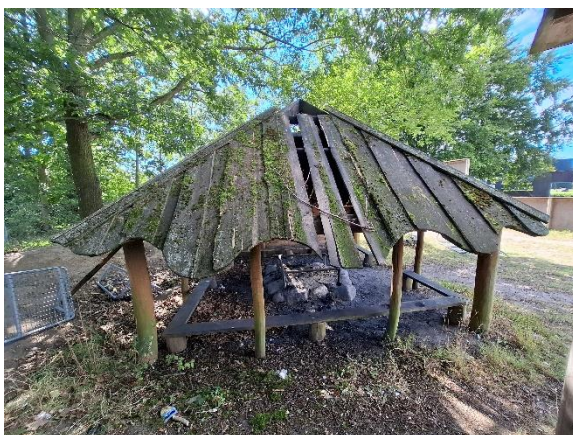
Overdækning til SFO er med råd og manglende planker. Taget er udskiftningsklart.
