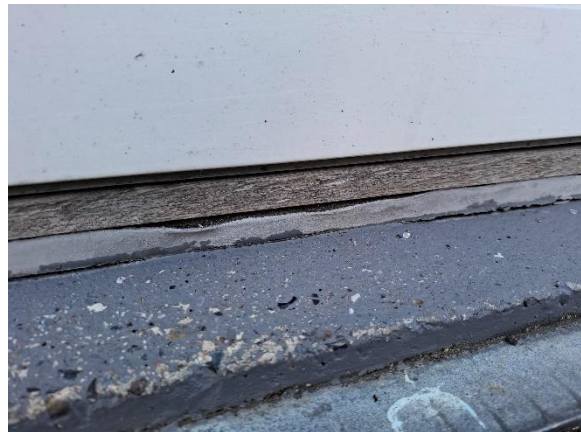
Fuge med dårlig vedhæftning på dør, skolen
