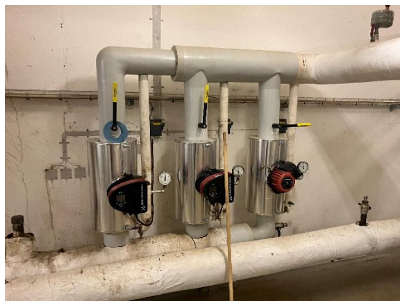
Pumper til varmeanlægget
