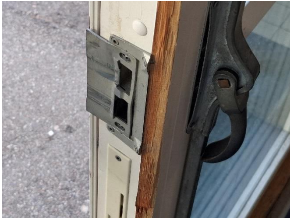
Flækket liste og skadet låsetøj på dør til legeplads, skolen
