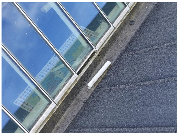
Alu-liste er faldet af på rytterlys mod nord, bygning gul
