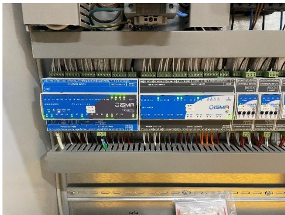
Varmeinstallations styring til idrætshal
