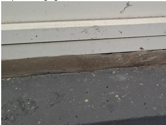
Fuge under vinduesparti mod indre gård er med begyndende krakelering.
