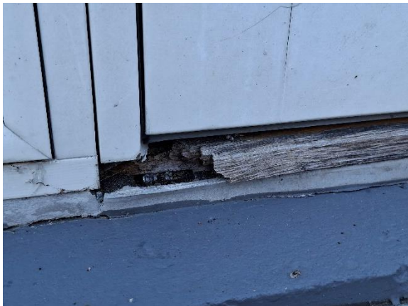
Skadet bundstykke på yderdør træ, skolen
