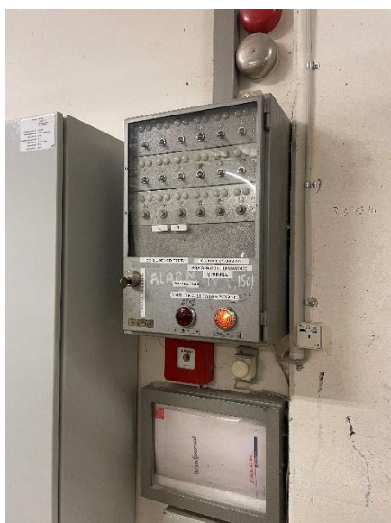
Ældre sprinkler central i kælder
