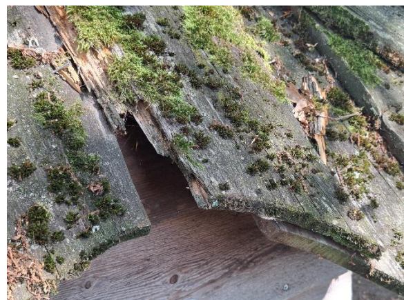
Nedbrudt træ i overdækning til SFO
