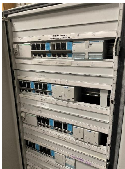
Sektionstavle mangler tavleafdækning
