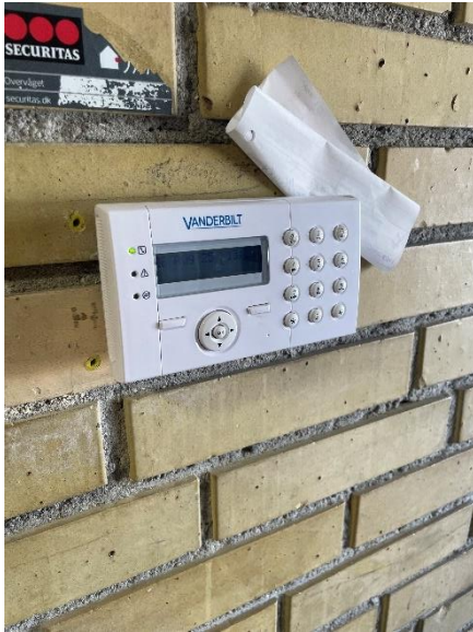
Vanderbilt alarm panel ved idrætshal
