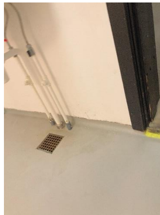
Afløbs rist under håndvask
