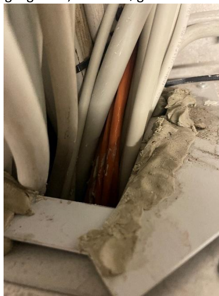
Ukorrekt kabelgennemføring i hovedtavle
