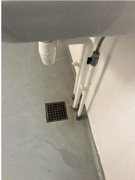
Afløbs rist under håndvask
