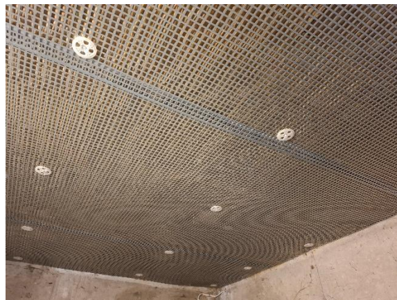
Akustikregulering i affaldsrum
