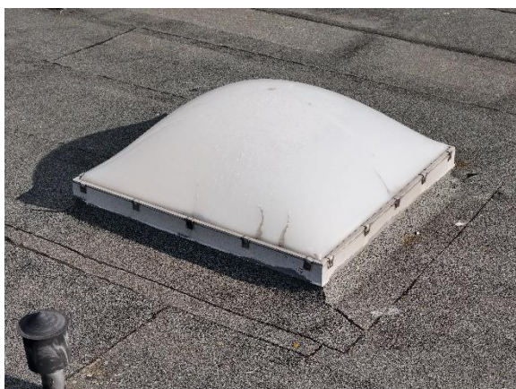
Ovenlys på bygning gul med revner.
