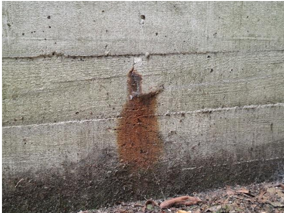
Afslag i betonen med rustløber i lyskasse ved rengøringsrum.
