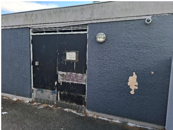
Døre på affaldsskur syd for skolen er meget slidt og trænger til udskiftning.
