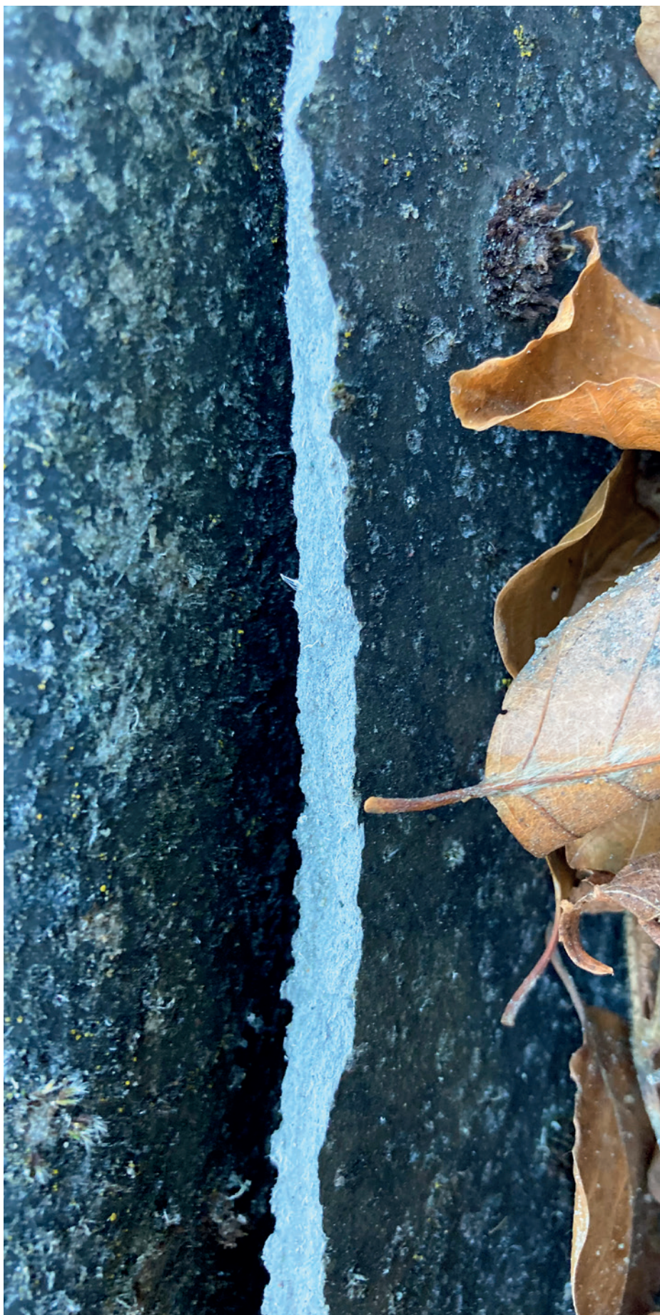
Kigger du meget nøje efter, kan du se de små, hvide asbestfibre der, hvor tagpladen er knækket.
