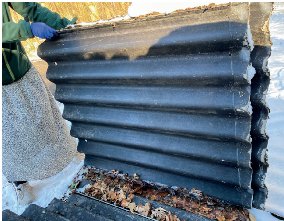
Her ses en asbestholdig tagplade.
