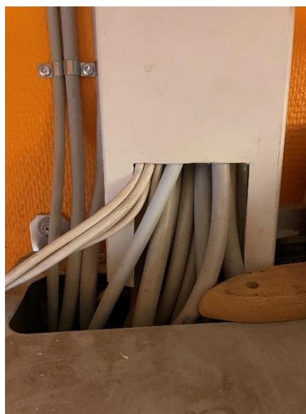
For stor gennemføring til kabler i tavlen
