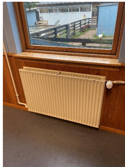
Eksempel på radiator til to strengs system i bygningen
