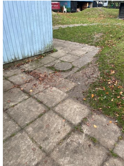
Belægning og dæksel sunket i en lille lunke ved den vestlige ende af bygningen.
