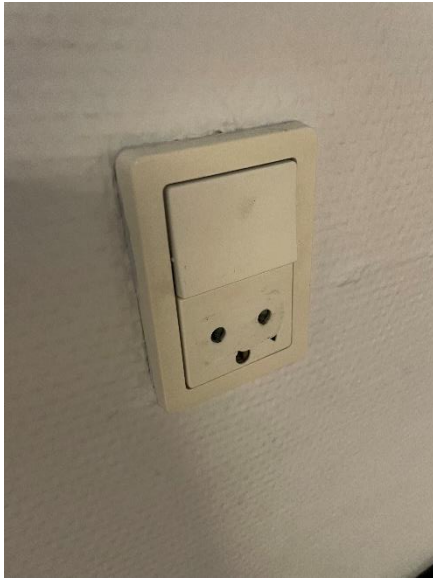
Stikkontakt fra bygningens opførelse.
