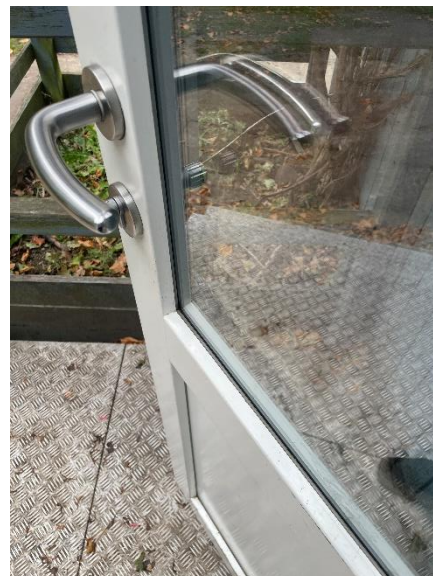
Energirude i tilbygningen
