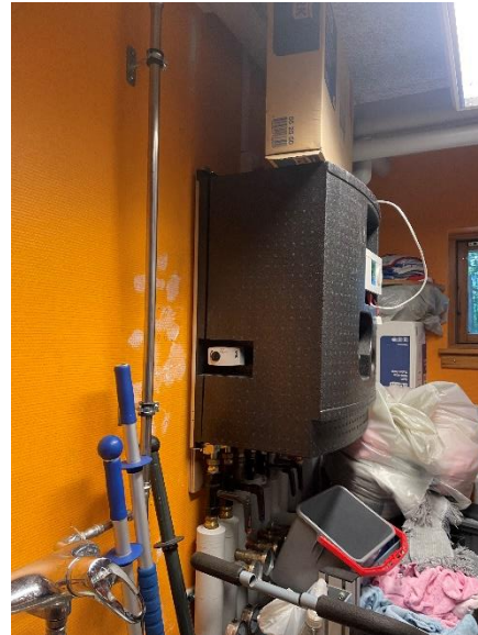
Varmecentral med varmtvandsveksler
