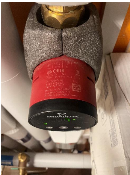
Pumpe til varmeinstallationen
