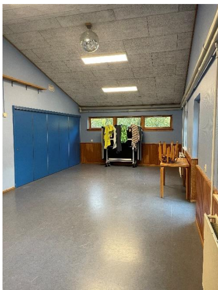
LED belysningsarmatur i det østligste rum
