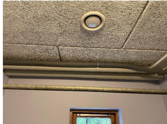
Ventilations udsugning i teknikrum
