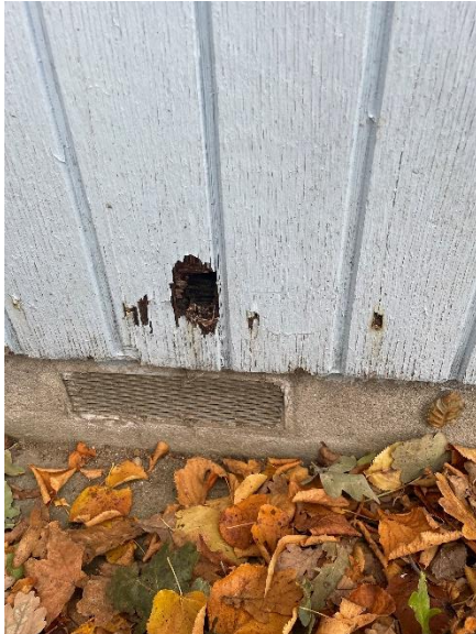
Rådeskade på træbeklædningen på facaden
