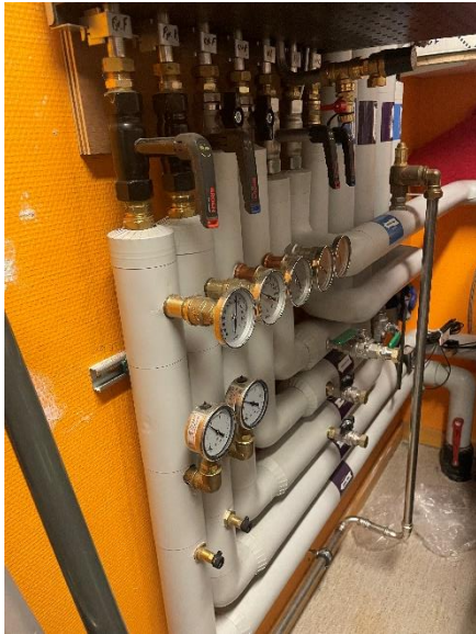
Varmerør ved centralen i teknikum
