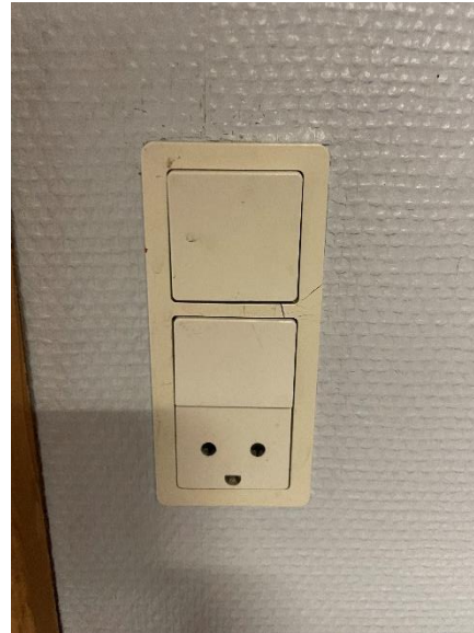
Knækket ramme på installationsmateriel
