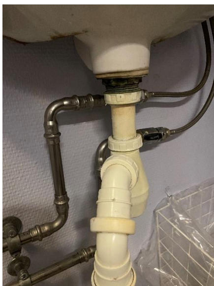
Afløbsrør med tilknyttet vandlås på toilet
