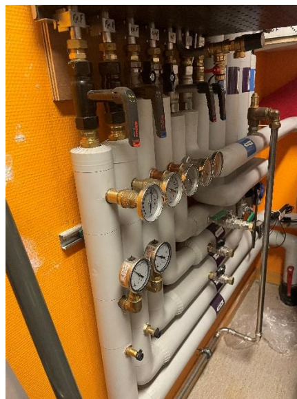
Varmeinstallationen i teknikrummet
