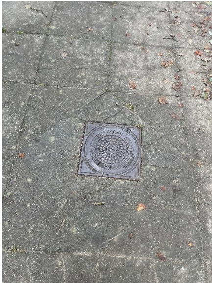
Revner i belægningen omkring kloakdæksel på forpladsen
