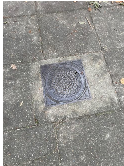
Nedløbsbrønde med dæksel på forpladsen
