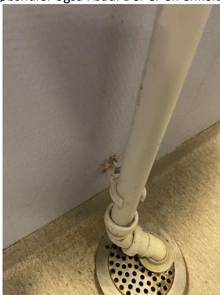
Afløbsrør i plastik med tilhørende gulvafløbs med rist på toilet
