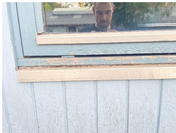
Råd og slid på vinduesramme og dårlige fuger
