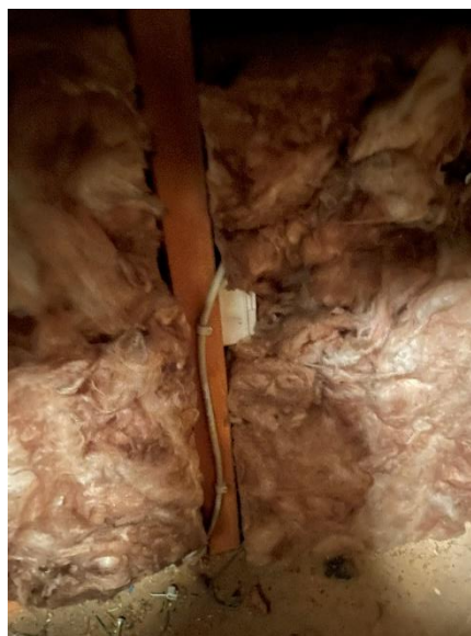
Dåse skjult i isolering på loftet
