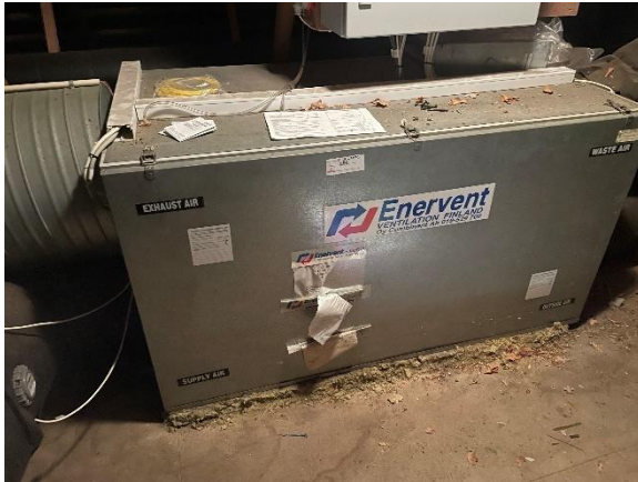
Ventilations ventilator på loft
