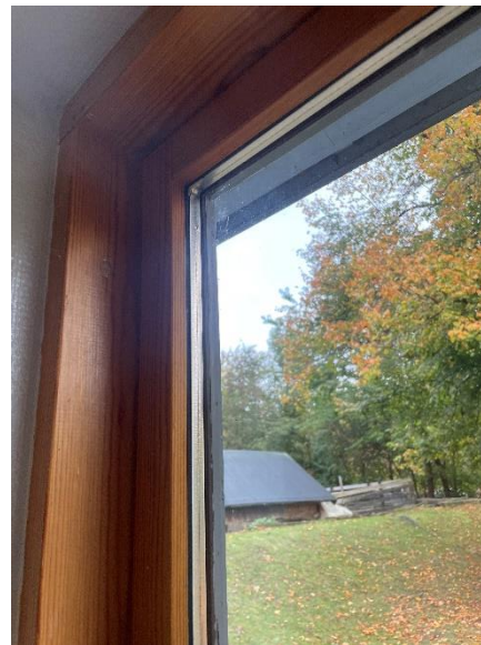
Termorude i den oprindelige bygning
