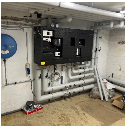
Fjernvarmeunit i kælder
