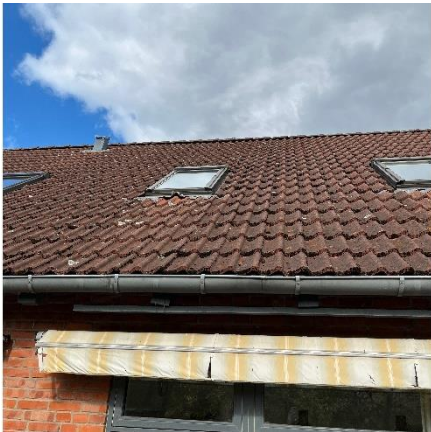
Utæt taginddækning ved ovenlys
