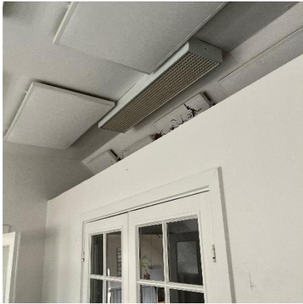
Ældre lysstofrør m. konventionelle forkoblinger
