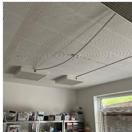
Ældre armaturer m. 4-rør og konventionelle forkoblinger
