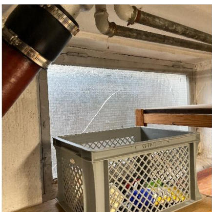
Revnet kælder vindue
