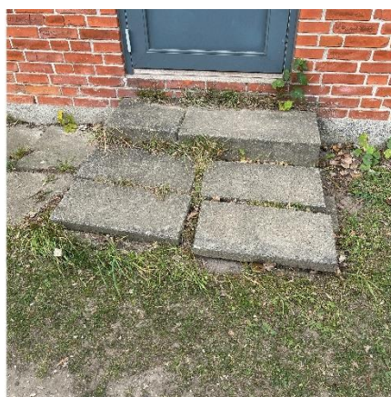
Ujævn flisebelægning ved bagindgang
