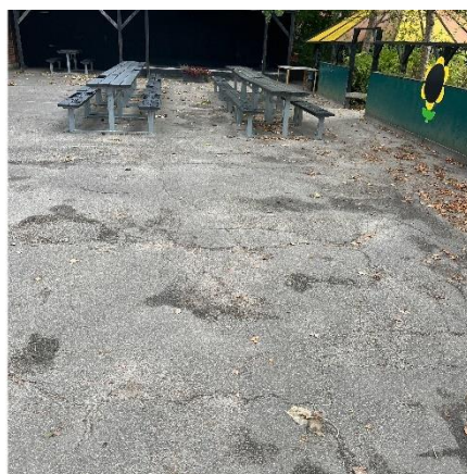
Ujævn belægning m. svindrevner og sætningsskader
