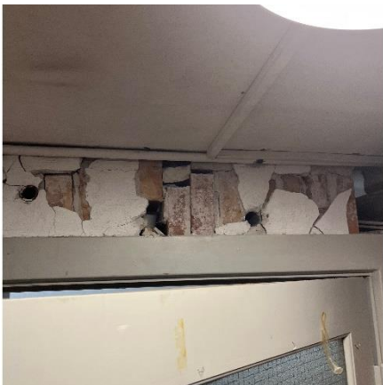
Ødelagt skillevæg i kælder
