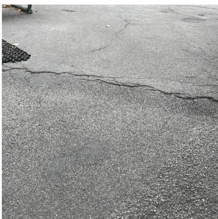
Sætningsskade i gårdbelægning
