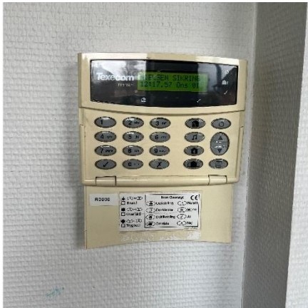
Texecom alarmsystem fra 2003
