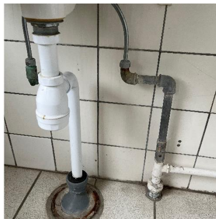
Afløbsrør i plast m. rustet metalkrave/flange
