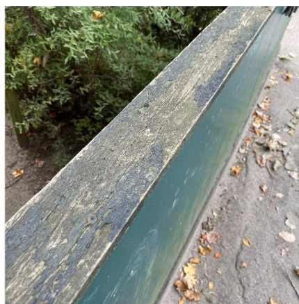
Afskallet maling på rækværk
