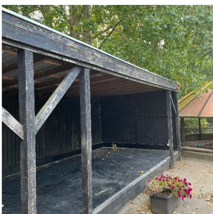
Misvedligeholdet overdækket areal
