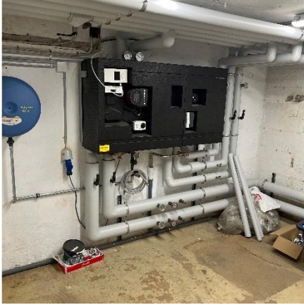
Fjernvarmeunit i kælder
