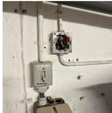
Manglende afdækning universalslåse
