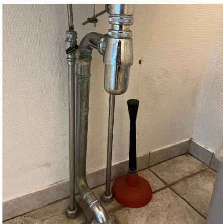
Afløbsrør i stål m. misfarvninger
