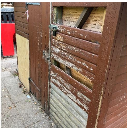
Manglende vedligehold af træfacade til udhus
