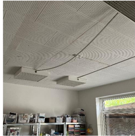
Ældre armaturer m. 4-rør og konventionelle forkoblinger
