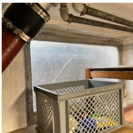
Revnet kælder vindue
