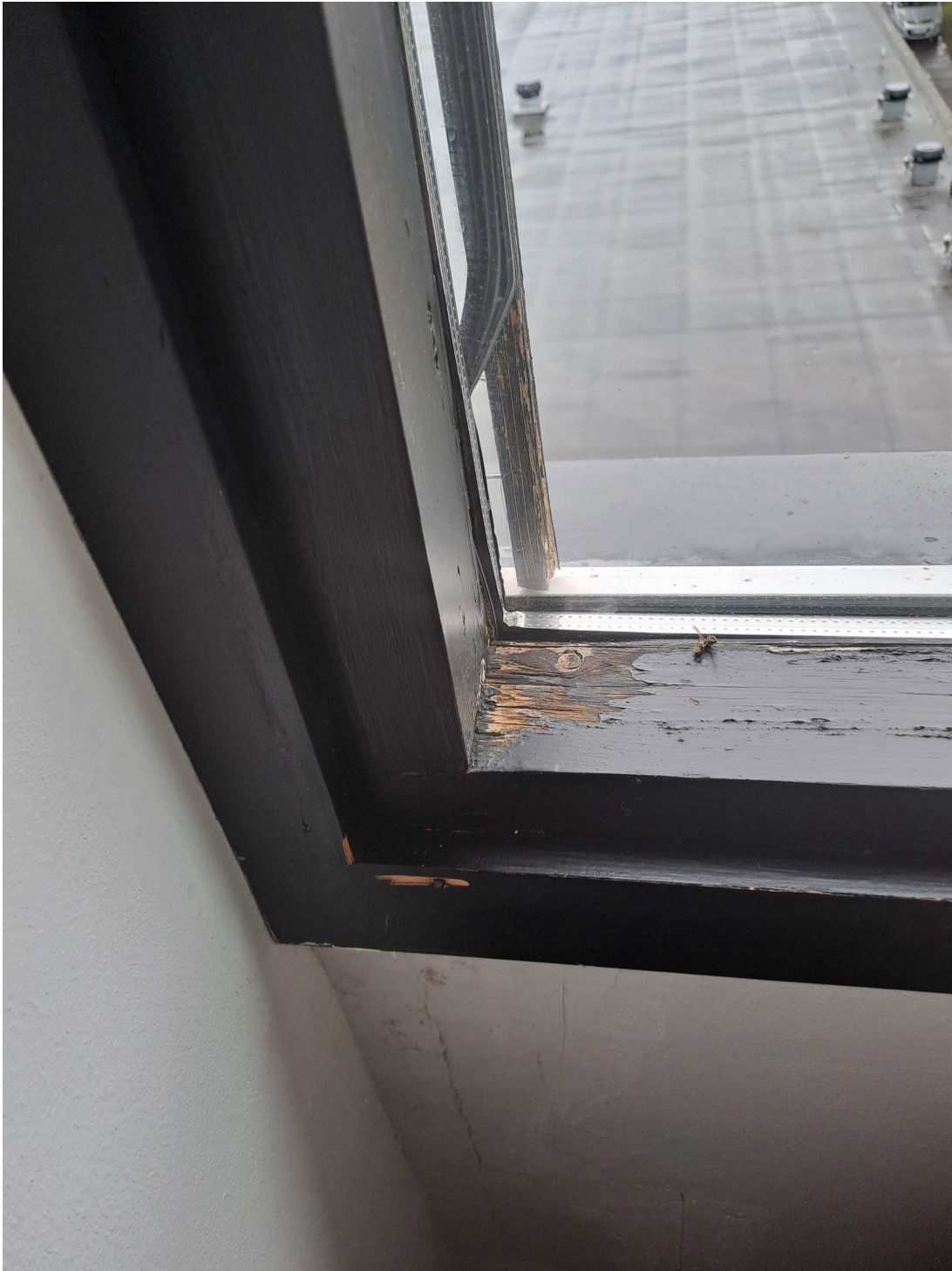
På billedet ses hjørnet af et vindue på et kontor, hvor der er utætheder og vandskader.
