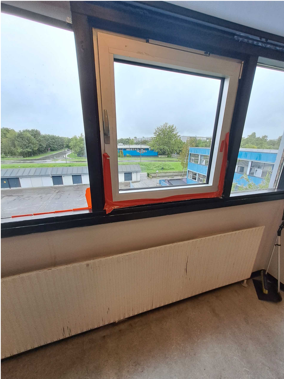
På billedet ses et vindue på et kontor, hvor ansatte har forsøgt at isolere for kulde og træk med tape.
