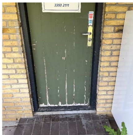
Manglende maler vedligehold af dør til overdækket terrasse i sekretariat
