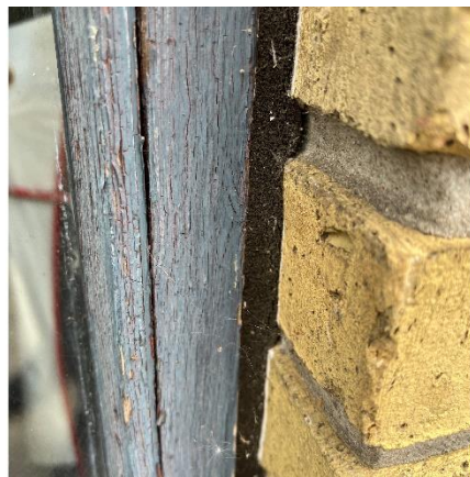
Manglende malervedligehold af vinduer
