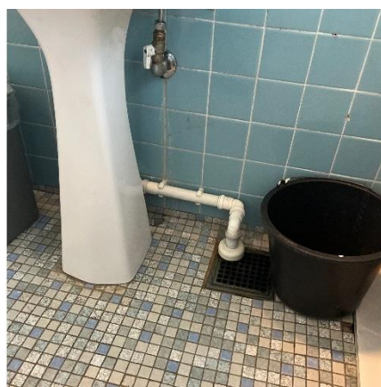
Afløb i plast til toiletvask i sekretariat
