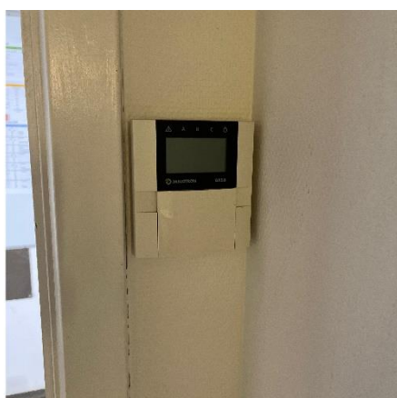
Alarminstallation placeret i omklædning i Klubhus og Café
