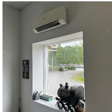
Luft/luft varmepumpe i café
