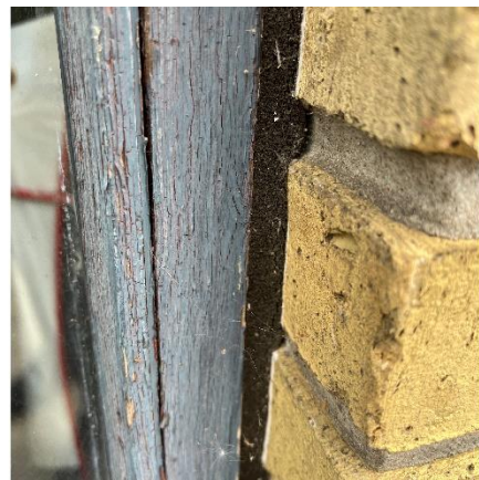
Manglende malervedligehold af vinduer
