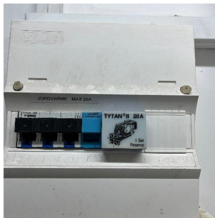
Tavle til jordvarme, greenkeepergård
