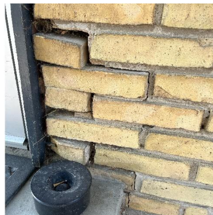
Beskadigede teglsten ved bagindgang
