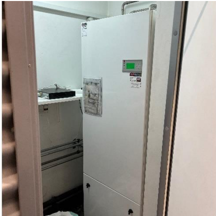
Jordvarmepumpe til greenkeepergård
