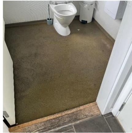
Slidt vinylgulv på toilet
