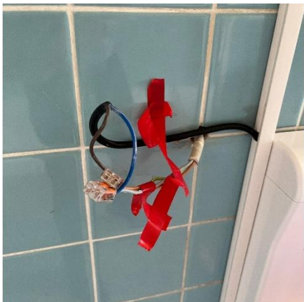
Ulovlig elinstallation på toilet i sekretariat
