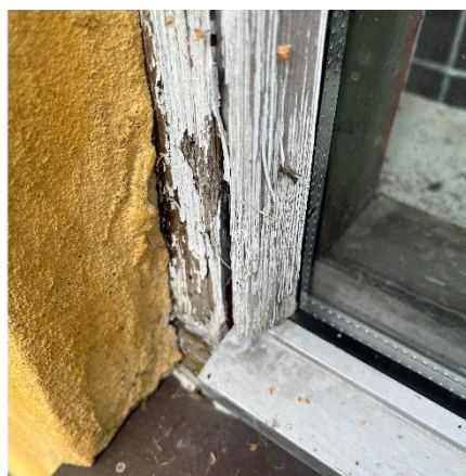
Nedbrudt træ i vinduesramme
