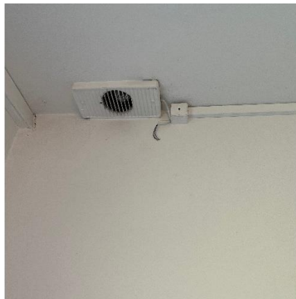
Frithængende ledning til ventilator på toilet i sekretariat
