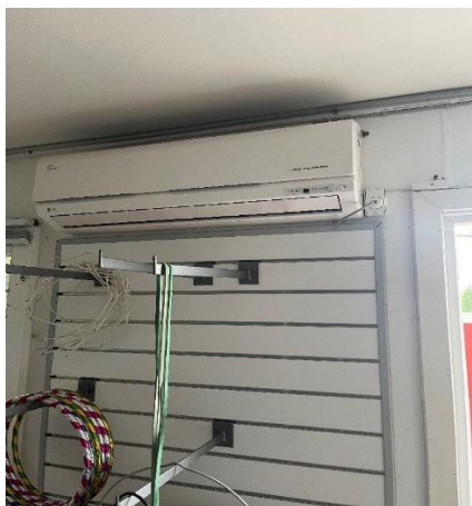
Luft/luft varmepumpe i udhus
