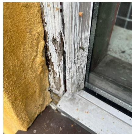
Nedbrudt træ i vinduesramme
