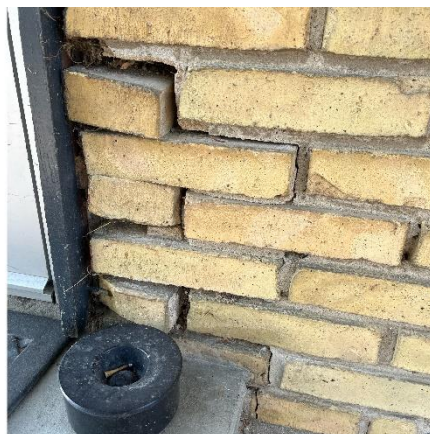
Løse mursten ved bagindgang, hul til hulrum i murværk til sekretariat
