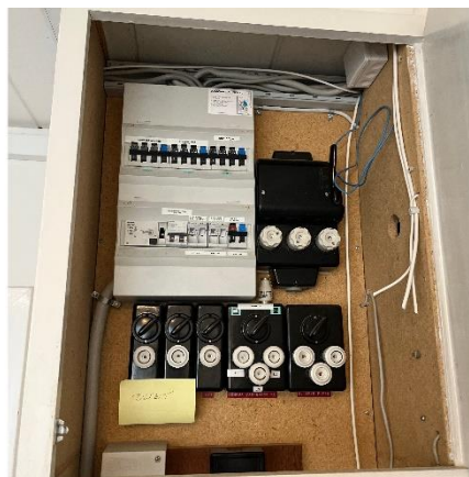
Nyere eltavle og ældre smeltesikringer og drejeknapper i depot. Frithængende hvide ledninger, sekretariat
