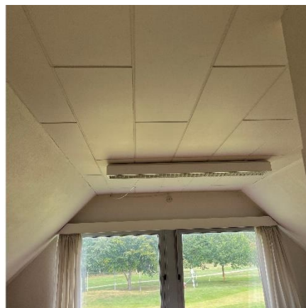
Belysning på 1. sal med ældre T8 rør m. konventionelle forkoblinger
