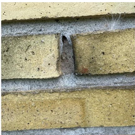
Murbier og porøs mørtel i facade til sekretariat
