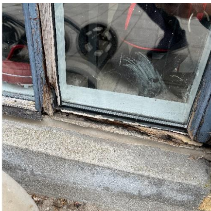
Nedbrudt træ i vinduesparti i indgang
