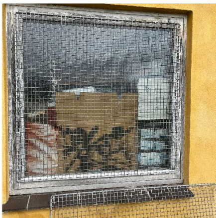
Manglende malervedligehold af trævinduer
