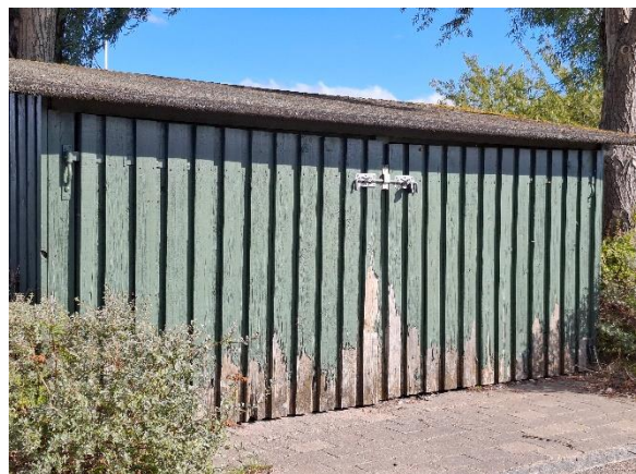
Afskallende maling på affaldsskur.
