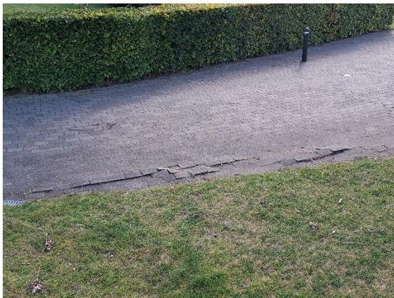
Ujævn flisebelægning på adgangsvej.
