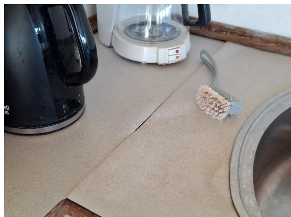
Bordplade omkring vask er svulmet op som følge af opfugtning.
