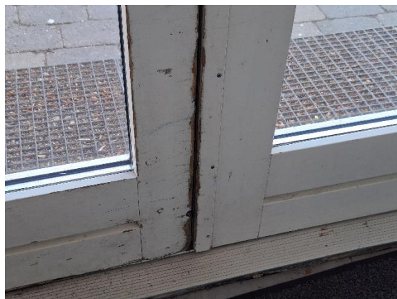
Slid på hovedindgangsdør
