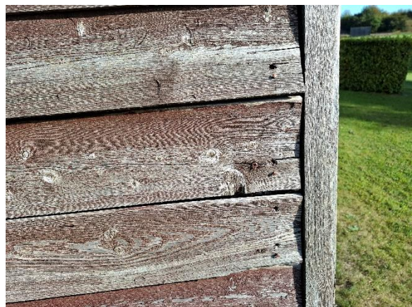
Træværk og underliggende afstandslist er konstateret med råd.
