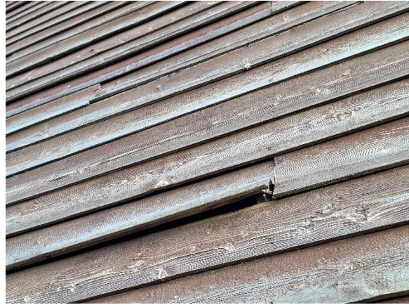
Klinkbeklædning mod syd er tørret ud og har slået sig så brædder ikke er tætsluttende
