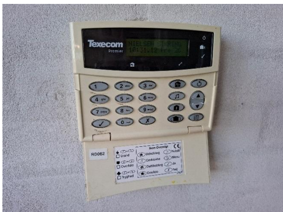
AIA fra Texecom
