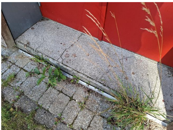
Sokkelpuds mod syd er revnet.
