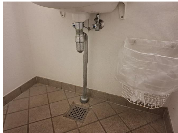
Afløb under håndvask i toilettrum
