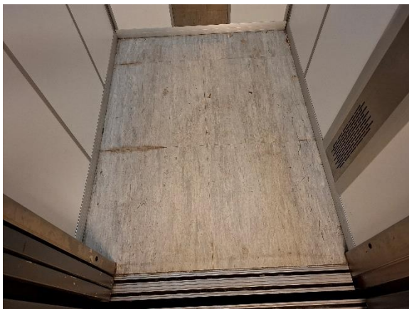
Gulv i elevatorstol er slidt og trænger til udskiftning.
