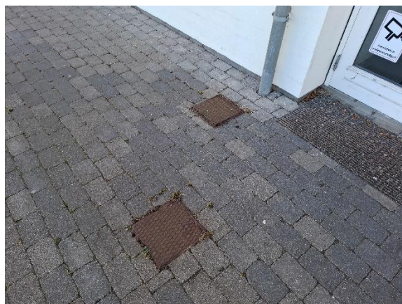
Adgangsdæksler til brønde
