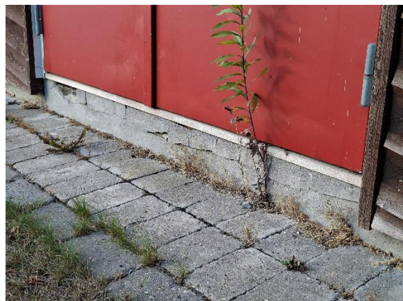
Sokkel under dør mod øst er med afskallende puds.
