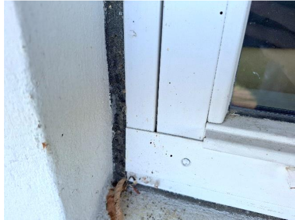
Fugebånd er faldet ud og mangler helt flere steder.
