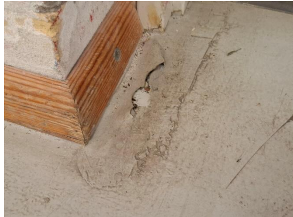
Begyndende afskalning på PU-gulv i sportshal
