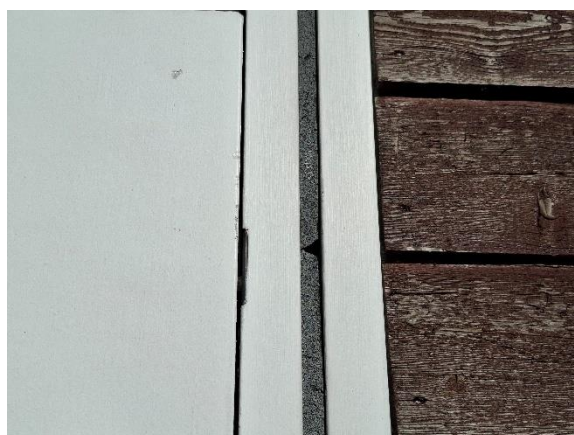
Fugebånd er med utætheder flere steder.
