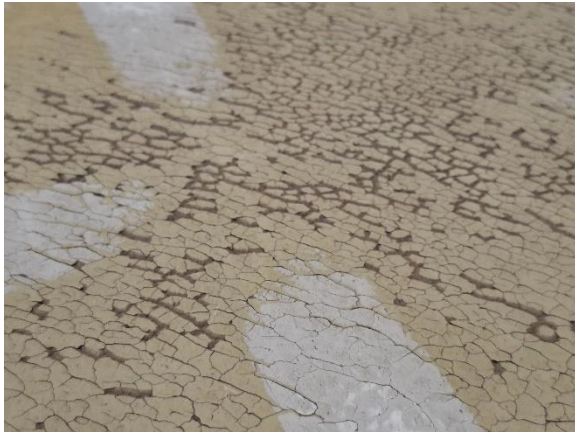
Krakeleret overflade på PU-gulv i sportshal
