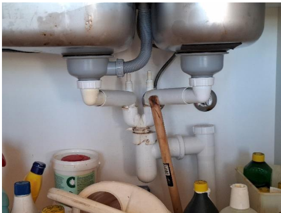
Afløb under køkkenvaske
