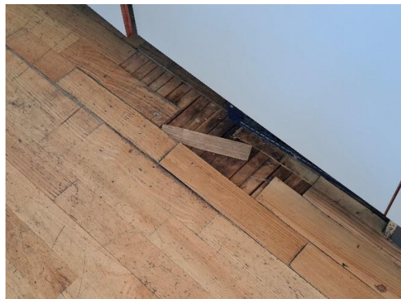
Løse stave på parketgulv på 1. sal.
