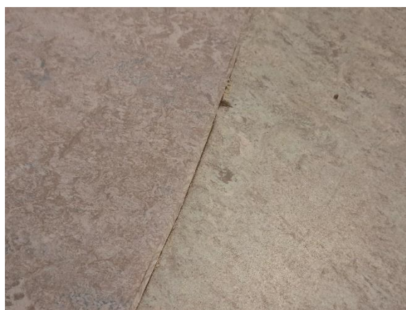
Svejsefuger er utætte i samling mellem nyere og ældre gulvflader.
