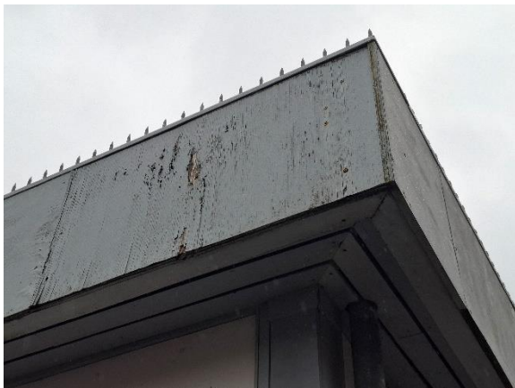
Afskallende maling på sternplade.
