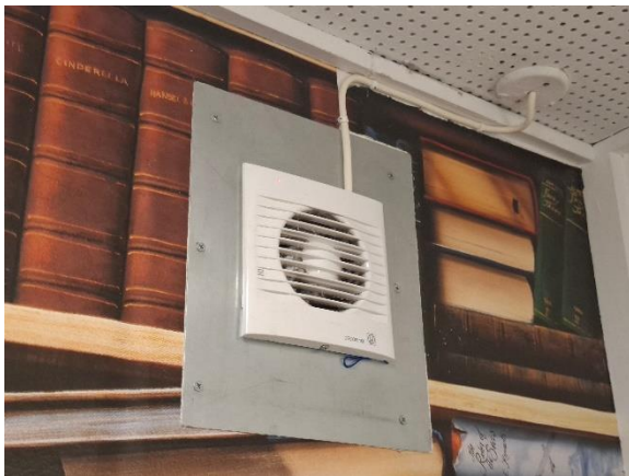
Ventilator i toiletrum
