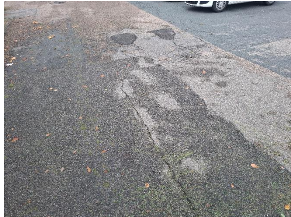
Asfaltbelægning på parkeringsplads er generelt med lapninger og revner.
