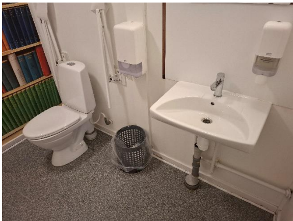
Toilet og håndvask med hhv. 2 skyl og 1 greb.
