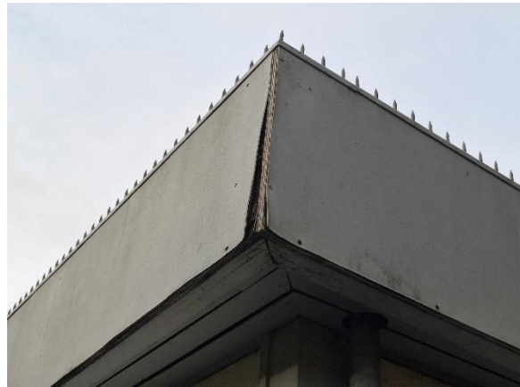
Delaminering af sternplader som følge af opfugtning.
