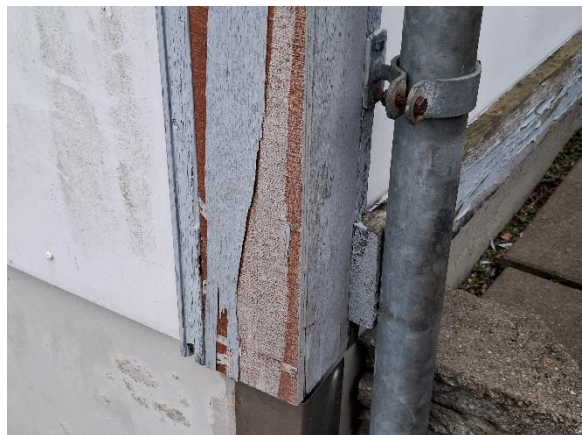
Afskallende maling på hjørneforstærkning i krydsfiner.
