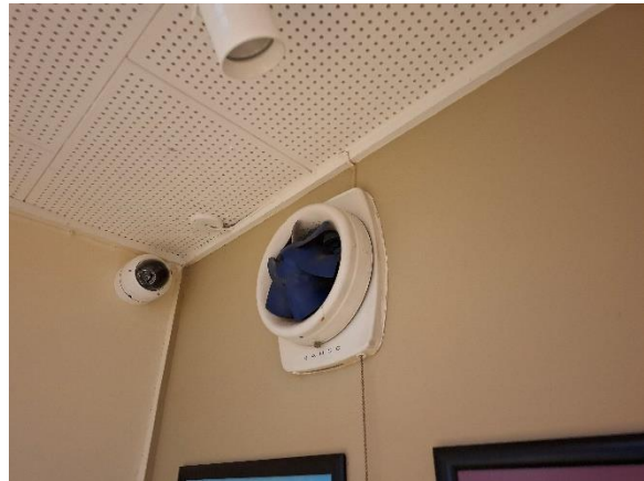
Ventilator i læseniche
