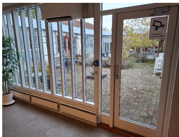
El-radiatorer og inde del til varmepumpe
