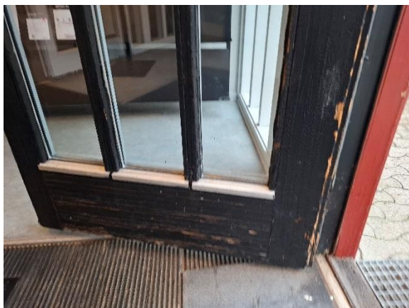
Dørblad på hovedindgangsdøren er slidt og med afskallende maling.
