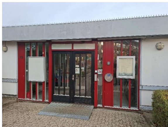
Hovedindgangsparti med side- og overpartier er generelt med afskallende maling.
