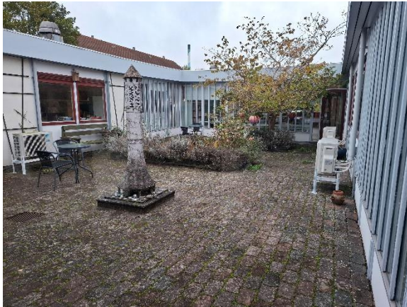
Flisebelægning i gård er med algebegroninger
