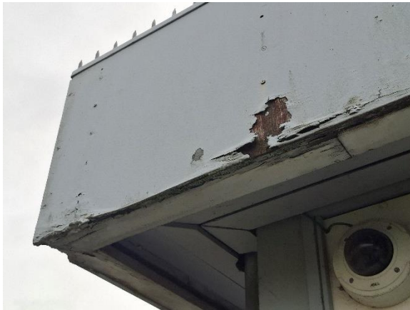
Opfugtede og delaminerede sternplader med afskallende maling.
