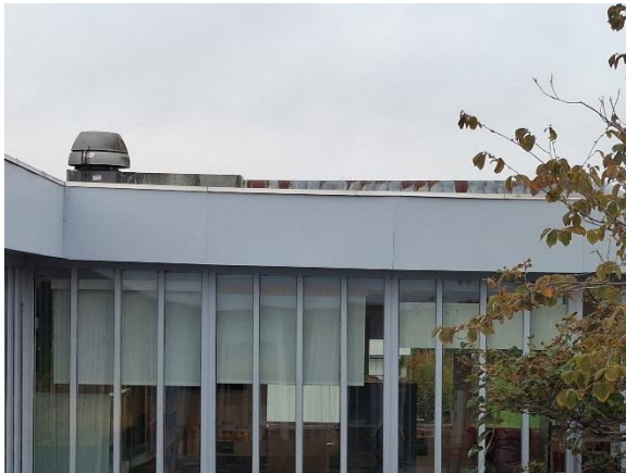
Udsugningsventilatorer på taget.
