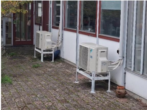
Varmepumper – udedele i gård.
