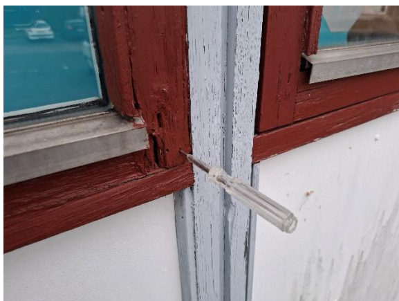
Vindue med råd i ramme og karm.
