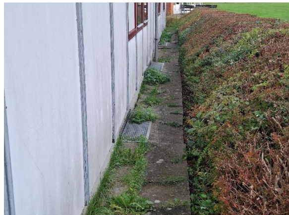
Belægninger mod øst ligger ujævnt og er med bevoksning i flisefuger.
