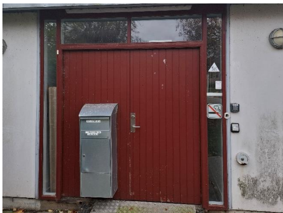
Indgangsparti med massive døre. Der ses afskallende maling.
