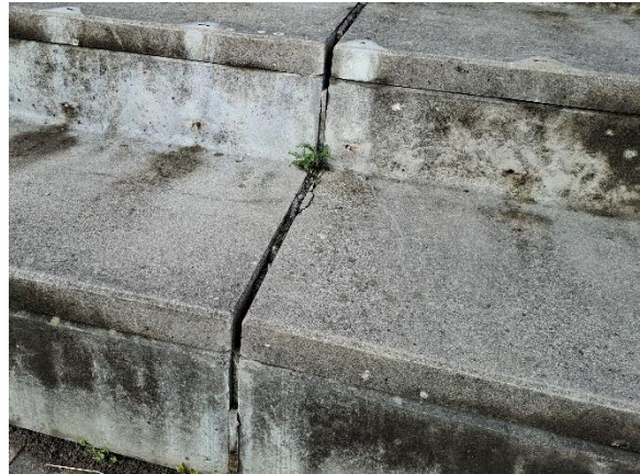
Fuger mellem elementer på tribuner er faldet ud.
