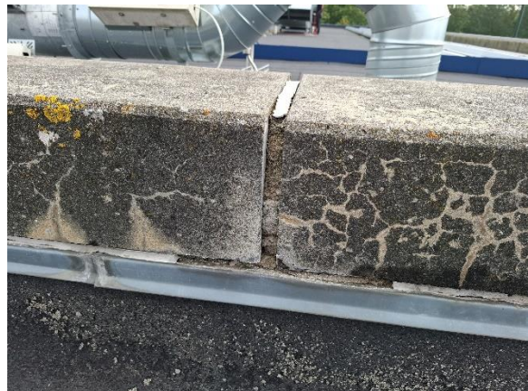
Krakelerede betonelementer over tag. Fuger er faldet ud.
