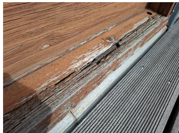
Nedbrudt træværk på vinduespartier i kantine blev konstateret gennemvædet ved gennemgangen.
