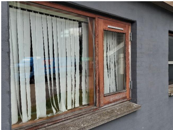
Oprindelige vinduer fra 1982 er slidt i malingen og hængsler.
