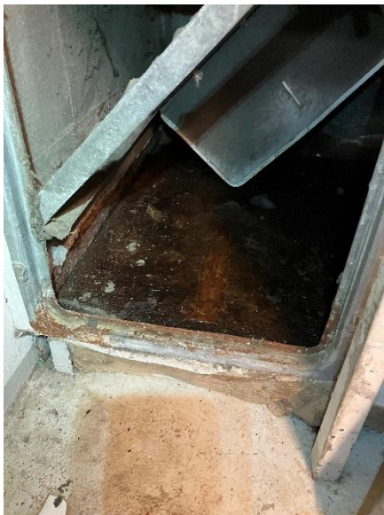
Stueanlæg; #3 hos PACCO. Kanal helt våd indeni og vurde- res tæt på gennemtæring.
