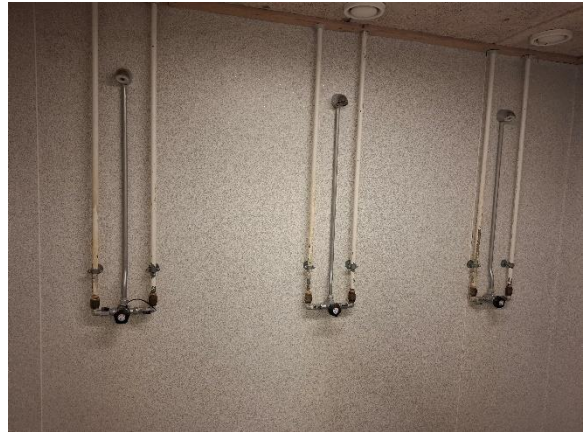
Ældre brusearmaturer i baderum til omklædning i oprindelig bygning.
