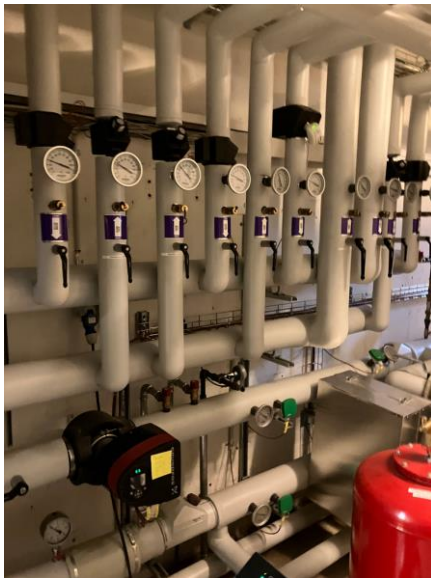
Varmeanlæg i oprindelig bygning
