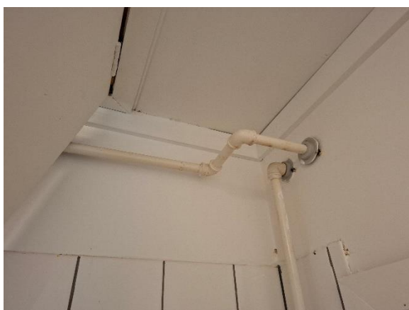
Der ses tæring gennem maling.
