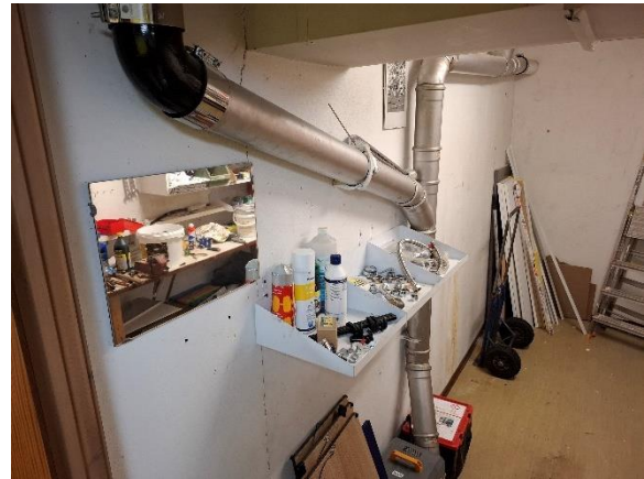
Afløbsledninger i rustfri installation
