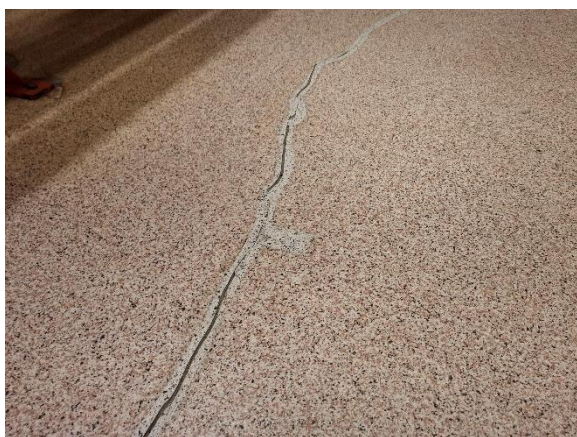
Epoxybelægning i oprindelig bygning er i alle omklædning med større revnedannelser.
