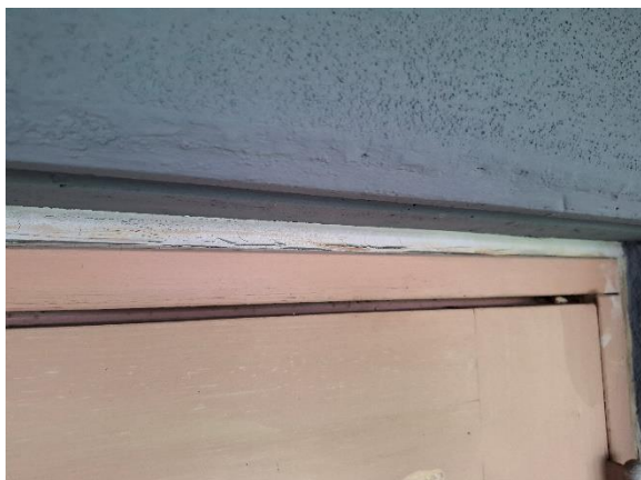
Fuger på oprindelige vinduer er krakeleret og mangler vedhæftning flere steder.
