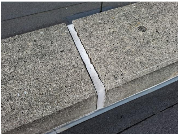
Elastiske fuger på betonelementer slipper
