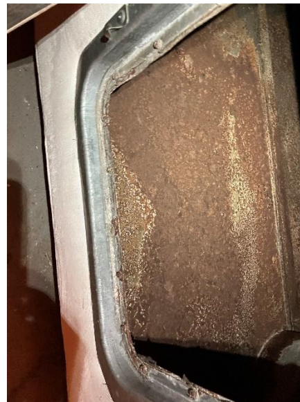
Anlæg U3A Kanaler meget angrebet af rust
