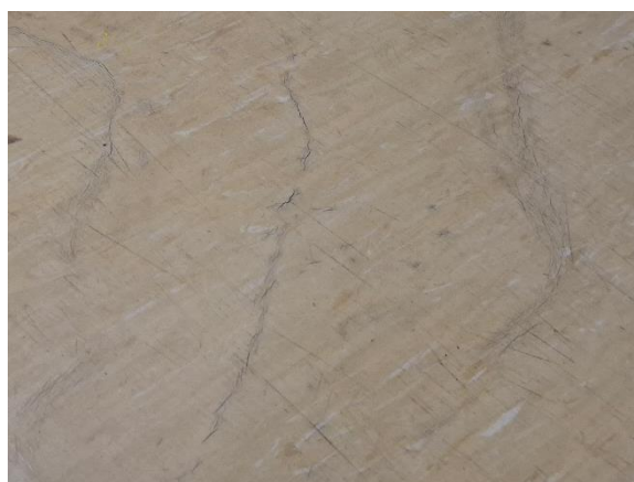
Linoleumsgulv i stue i oprindelig bygning med krakelering og revner.
