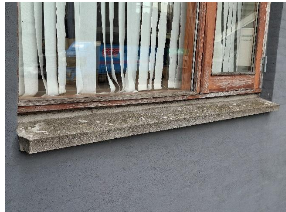
Oprindeligt vindue med afskallende maling.
