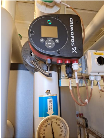
Cirkulationspumpe oprindelig bygning
