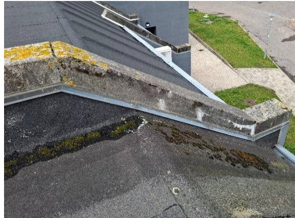
Mos- og algebegroninger og saltudfældning på betonelement.
