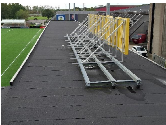
Tagbelægning på overdækning/gennemgang
