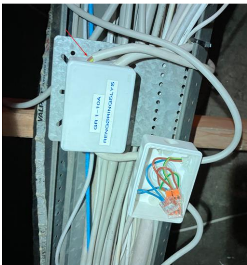
Kabling ikke korrekt aflastet og dåser ikke monteret
