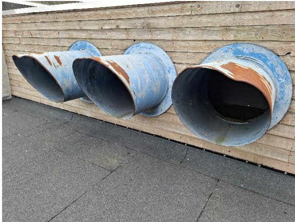
Maling nedbrudt og tæring af rør påbegyndt
