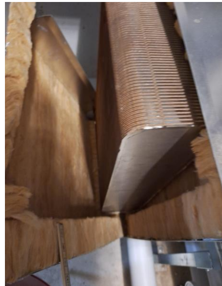
Isoleret veksler i oprindelig bygning
