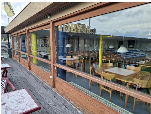
Vinduespartier i kantine er med opfugtet/rådnet træværk.
