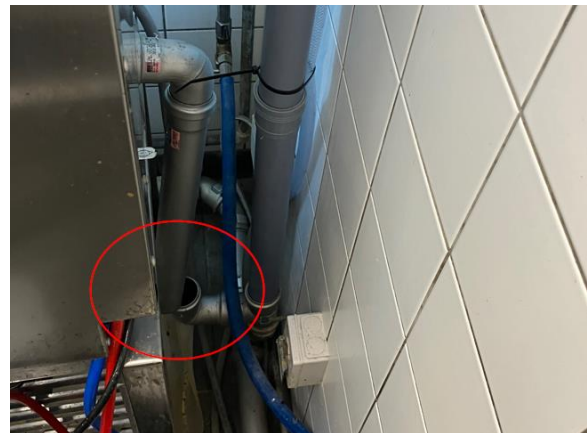
Kondensafløb "falder af hele tiden"
