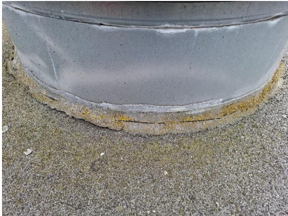
Mørnet tætning omkring gennemføring i ventilationskanal.
