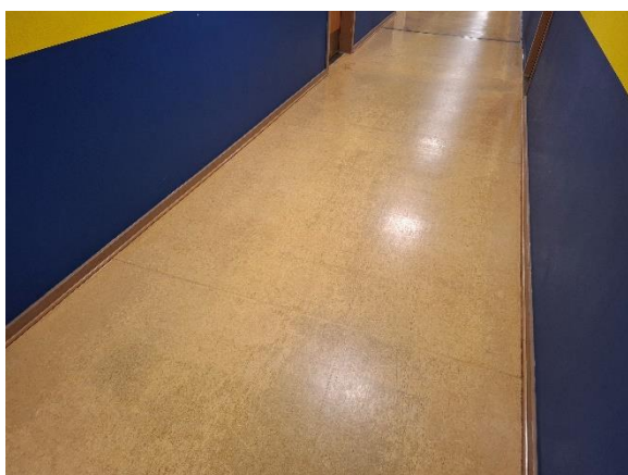
Linoleumsgulv i stue med slidte overflader i oprindelig bygning stuen.
