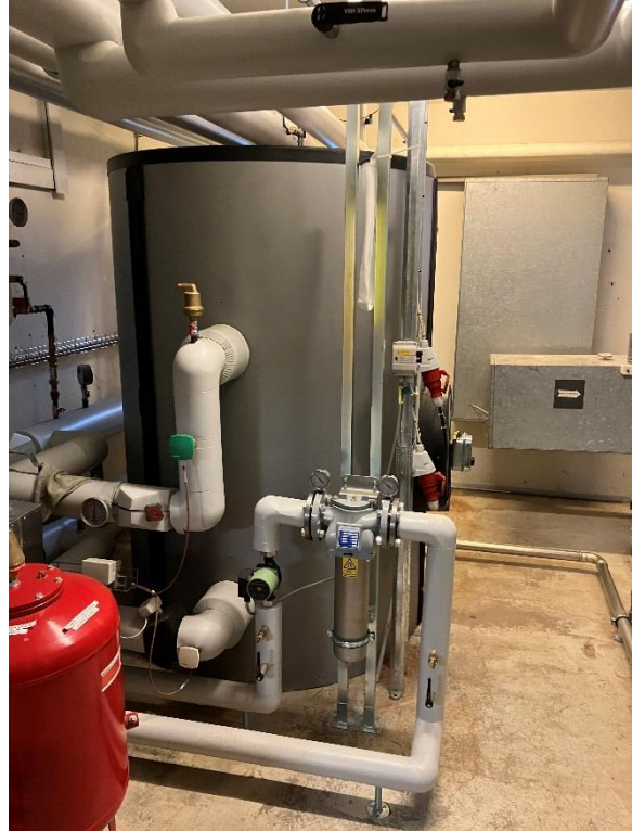
Ny varmtvandsbeholder og cirkulation
