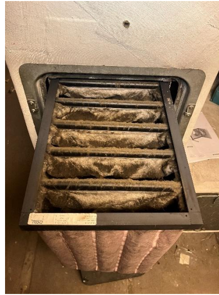
Anlæg U3A – filter møgbeskidt (Service 23/7-25)
