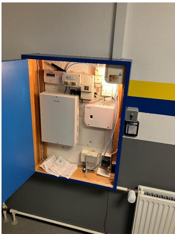
Skab med central og kodetastatur for alarm. Ældre knapper for forlænget drift af ventilation og ADK sidder tilbage.
