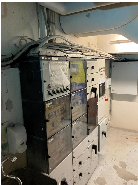
Ældre tavle med blandet installation. Overfyldt kabelbakke.
