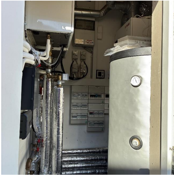
Varmtvandsbeholder til brugsvand
