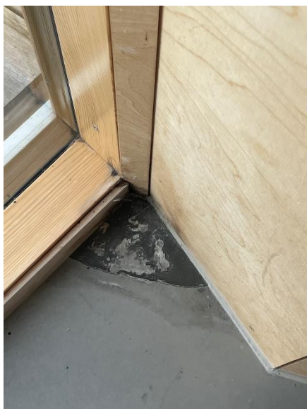
Vandskade ved vindue
