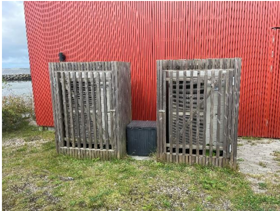
Inddækning ved varmepumper til bygningen. Ubehandlet træ
