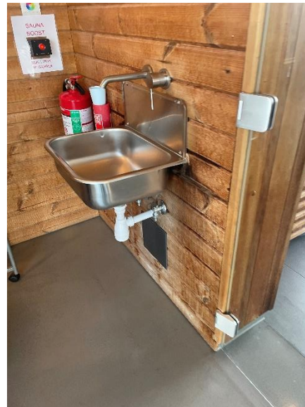
Plastik afløb under sink ved sauna
