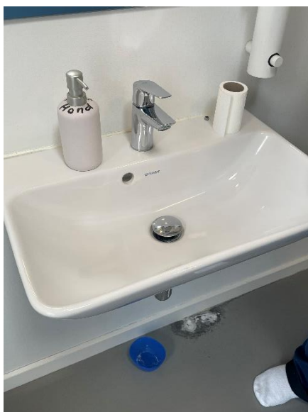
Håndvask på toilet
