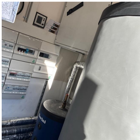
Eltavle set fra teknikrumsdør
