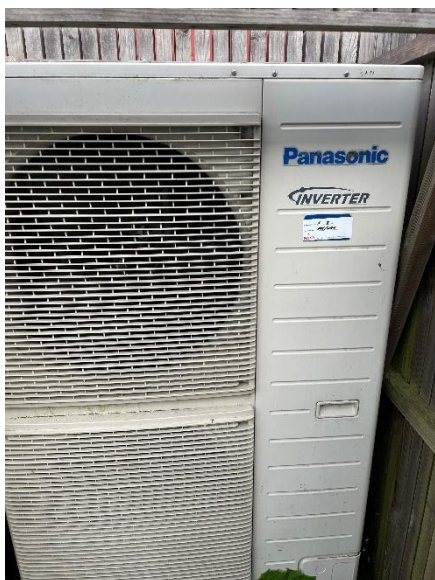
Luft til vand varmepumpe placeret udendørs
