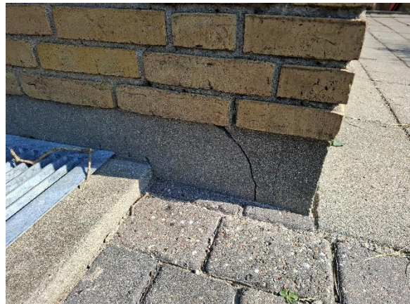
Revne i sokkel
