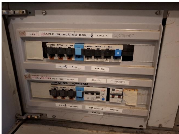
Nyere tavle i varmecentral
