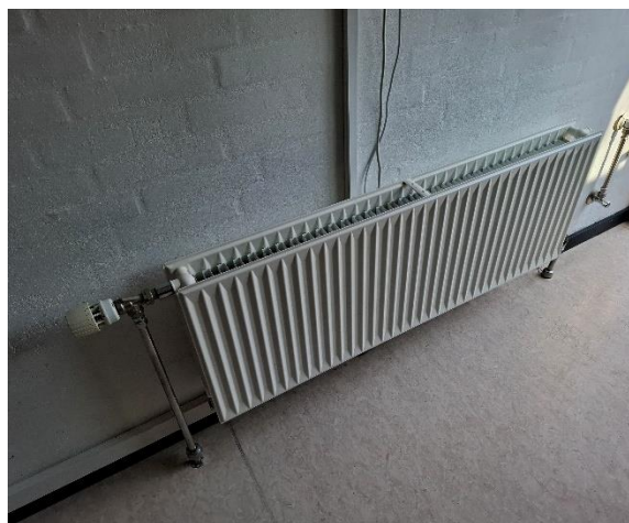
Oprindelig radiator med termostatventil
