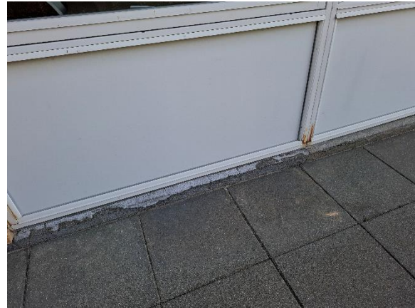
Nyere facadeparti med utætte fuger
