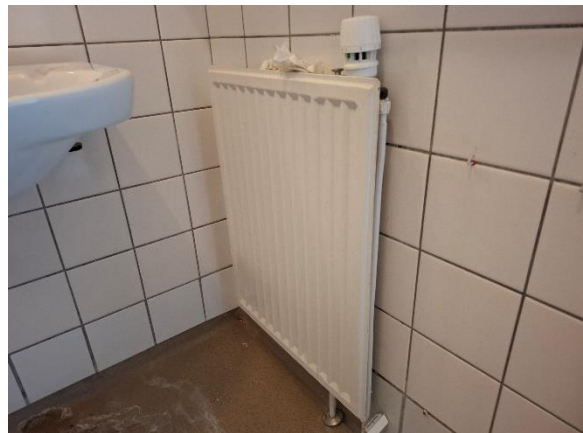
Radiator på badeværelse
