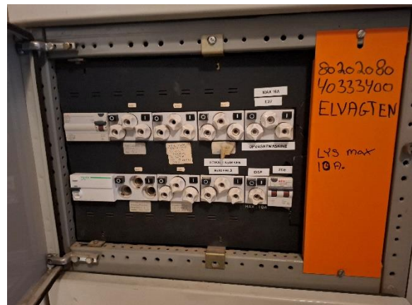
Ældre tavle i varmecentral, manglende sikringsskruer til pumpebrønd i tunnel/gennemgang under nordfløj.
