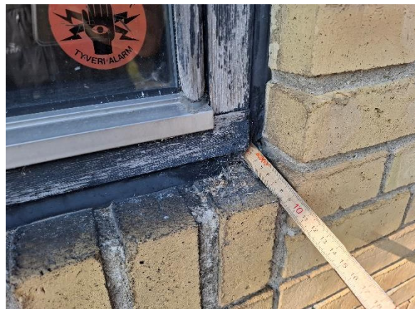
Nedslidt fuge på vindue
