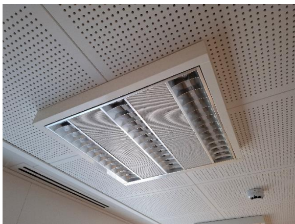
Armaturløs med lysstofrør
