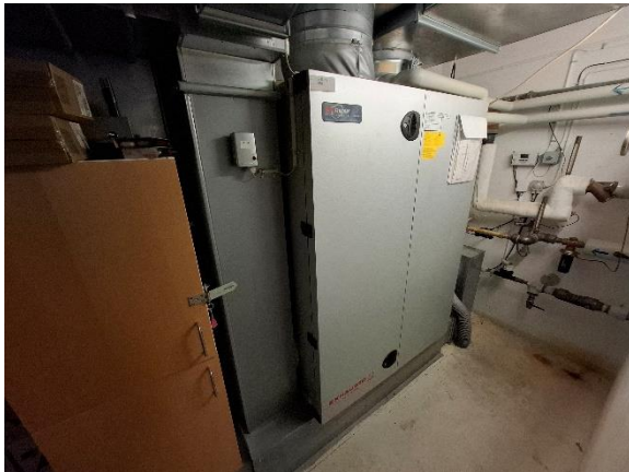
Anlæg 1 med krydsvarmeveksler placeret i kælder
