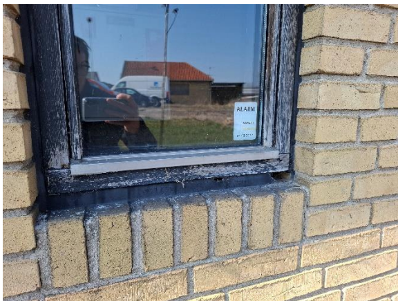
Trævinduer på udvendig facade med slidt træværk
