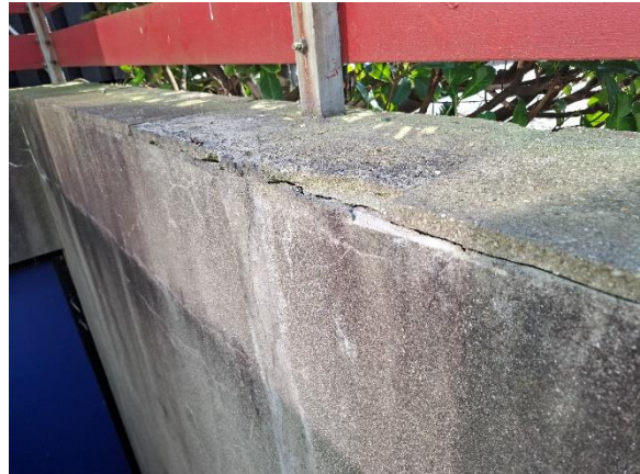
Afslag i overkant støttemur til kældertrappe
