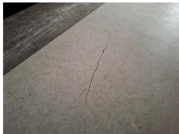
Revne i linoleum på kontor
