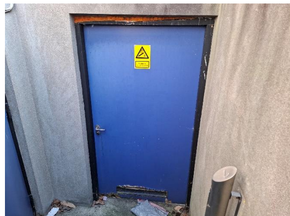
Dør til kælder med nedbrudt træ tætnet med skum.
