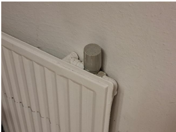
Termostatventil i kælder
