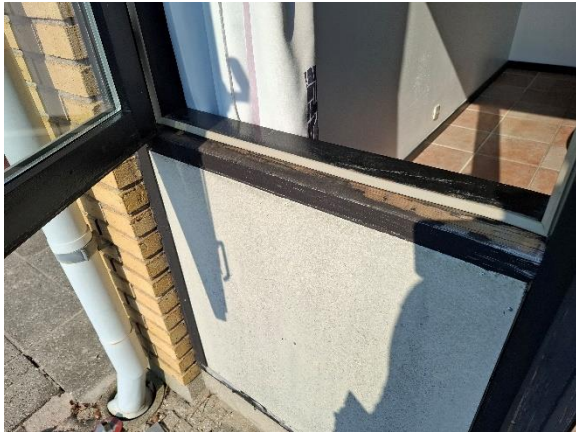
Afskallende maling på vindue mod gård
