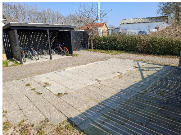
Flisebelægning ved cykelskur med huller
