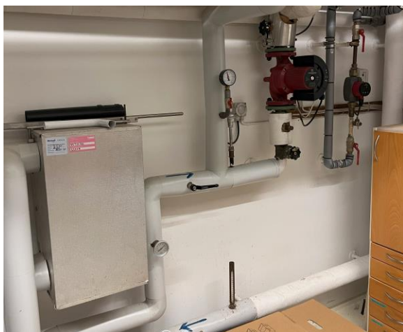
Varmeveksler og pumper
