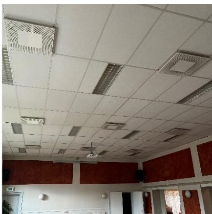
Belysning med ældre lysstofrør i store sal
