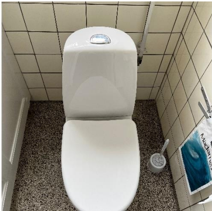
Toilet med to-skyl
