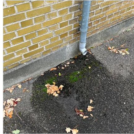
Manglende dræn eller nedløbsbrønd
