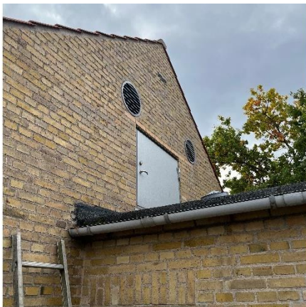
Indgang til ventilationsanlæg
