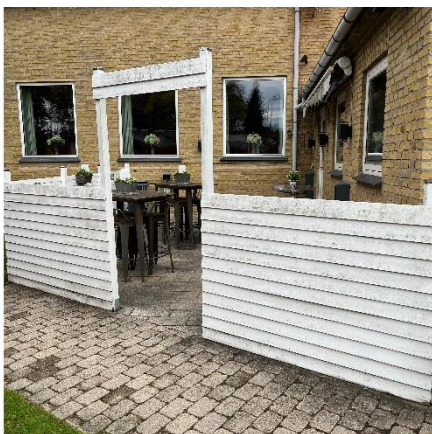
Ubehandlet rækværk til terrasse
