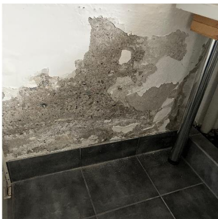
Afskallet puds på indvendig kælderfacade
