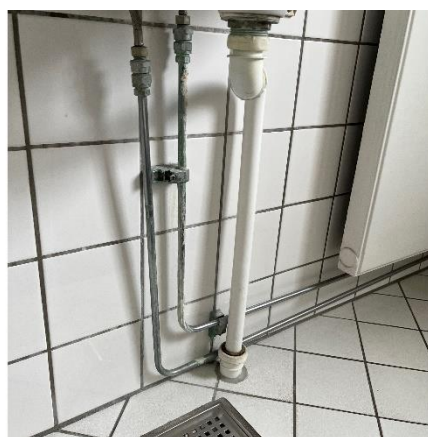
Utæt rørføring med begyndende tæring eller belægning
