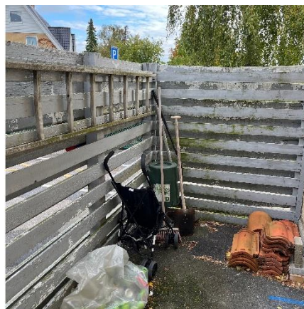
Ubehandlet rækværk ved indgang
