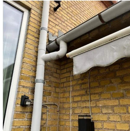
Tagrender og nedløbsrør i plast
