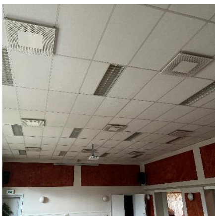
Belysning med ældre lysstofrør i store sal
