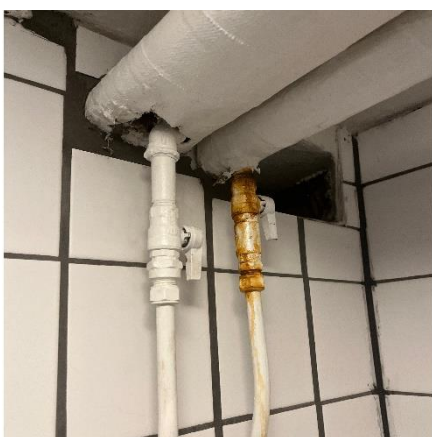
Tæret vandør i kælder
