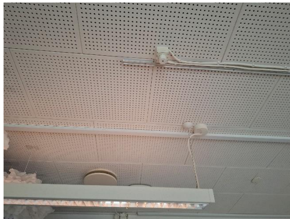
Armatur med lysstofrør
