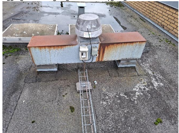
Bygning nord, mekanisk udsugning det store toiletrum
