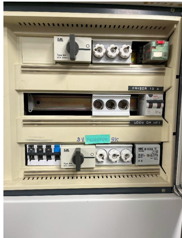
Tavle i kælder, der mangler afdækning, skruesikringer i en truppe samt opmærkning
