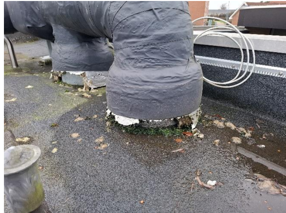
Våd oprevet isolering ved gennemføring i mellembygning
