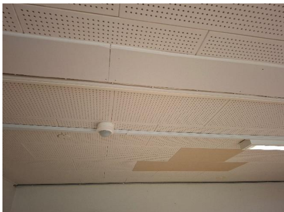
Akustikgipslofter i bygning nord med lapninger
