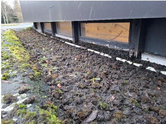
Bygning syd, ovenlys med råd i karme.
