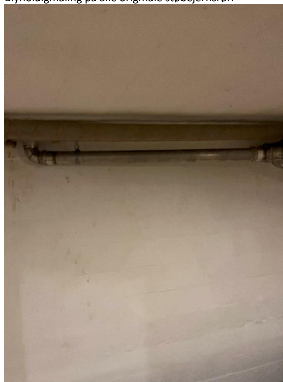
Bagfald på afløb.
