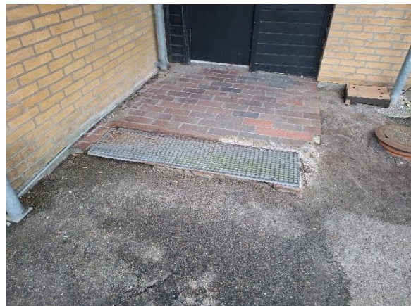
Belægninger ved dør til bygning syd
