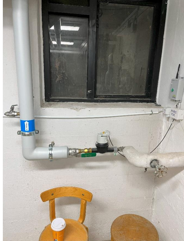
Stikledning med vandmåler.
