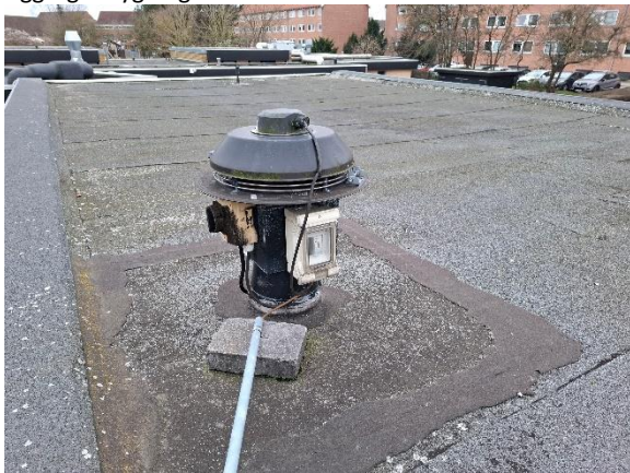
Bygning nord, mekanisk udsugning lille toiletrum
