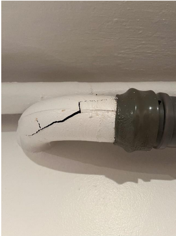
Bøjning på toilet i kælder er flækket helt igennem.
