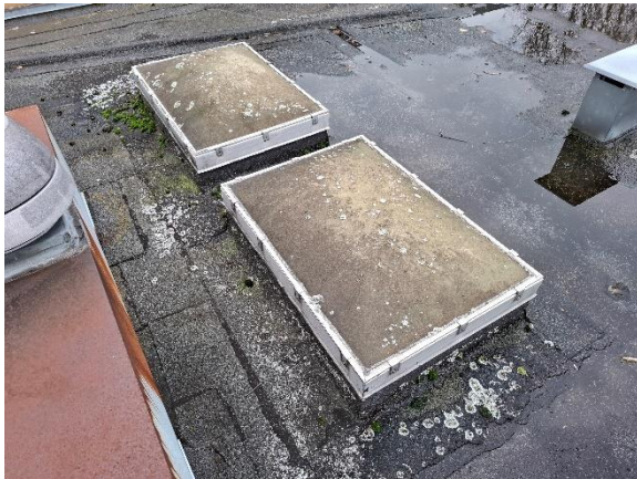
Ovenlys i bygning nord
