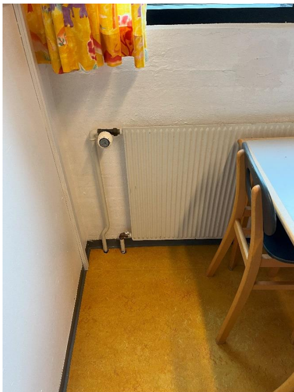
Radiator i nordlig bygning
