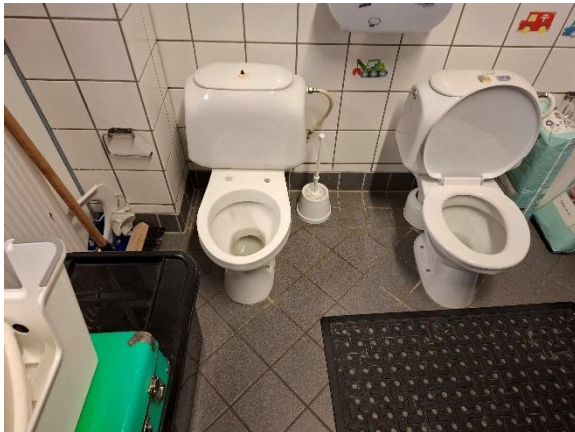
Toilet med manglende toiletbræt og ødelagt skyldknap.
