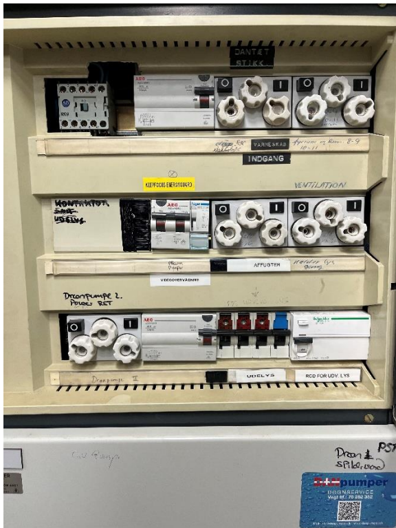
Tavle i kælder der mangler afdækning og opmærkning
