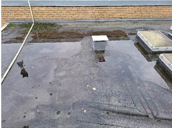
Større lunke på den gamle tagflade mod nord.
