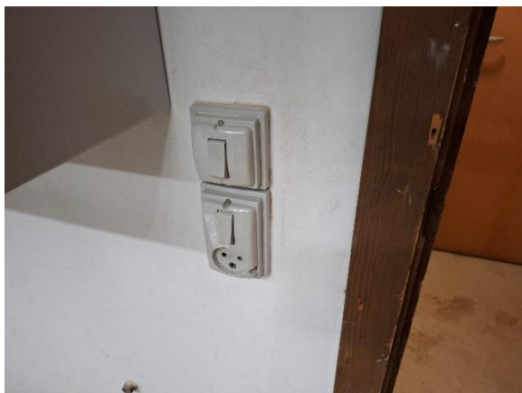
Ældre installation i kælder
