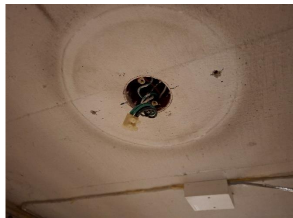
Manglende dæksel på lampeudtag i kælder.
