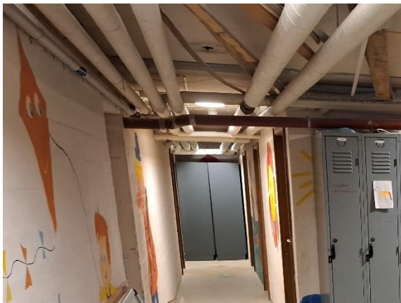
Vand og varmeinstallation i kælder, isolerede rør, ældre
