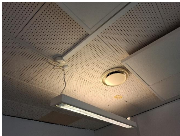
Lysarmaturer på stuerne, kanaler er brugt til føringsvej
