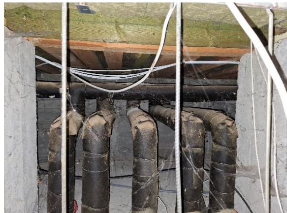
Isolerede vand og varmeinstallation i krybekælder.
