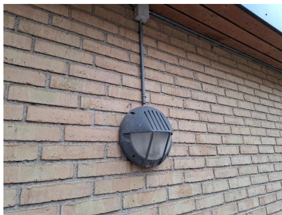
Udelys, ældre installation
