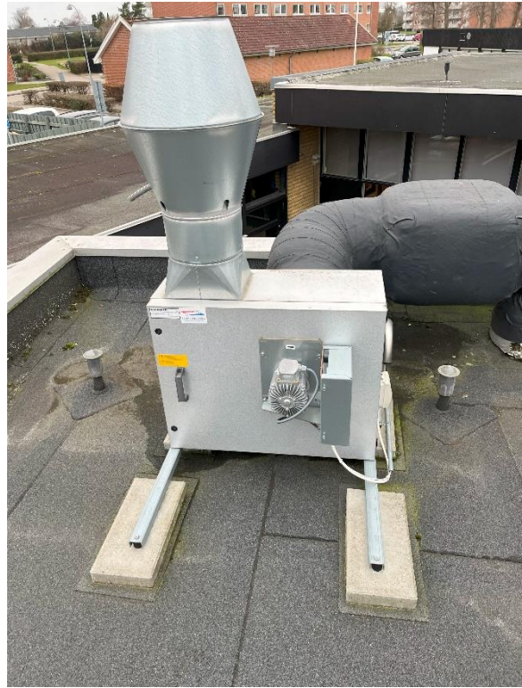
Aggregat til udsugning fra mellembygningen
