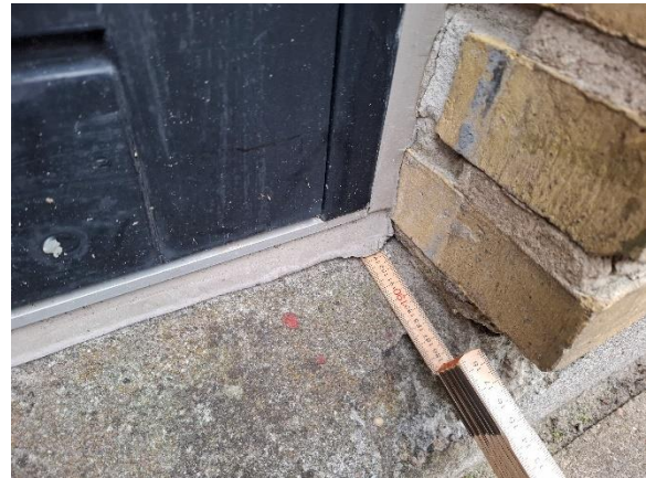
Bygning syd, dør mod syd med fugeslip
