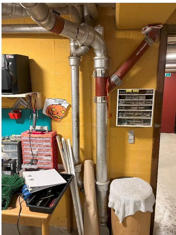
Slid og udbloomstring på støbejernsrør.
