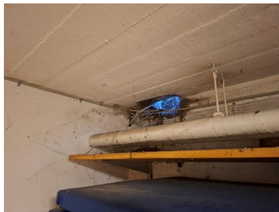
Ventilationsrist gennem sokkel
