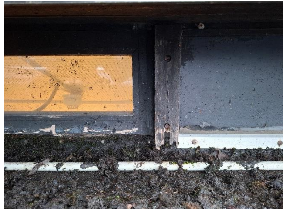
Bygning syd, ovenlys med råd i karme.
