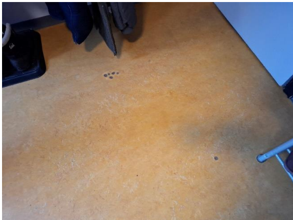
Linoleum med enkelte brugsspor
