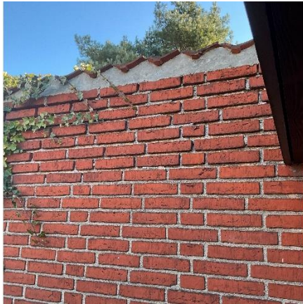
Udvaskede fuger i facade i udhus
