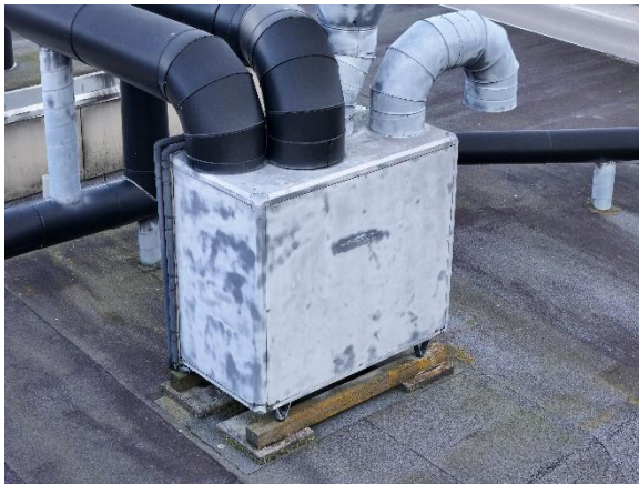
Ventilationsaggregatet set fra drone
