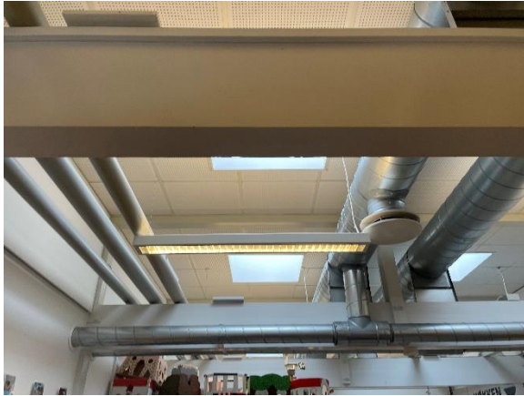
Ventilationsrør i bygningen samt indblæsningsarmatur
