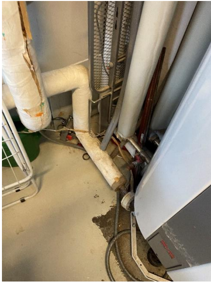
Malet betongulv med skader
