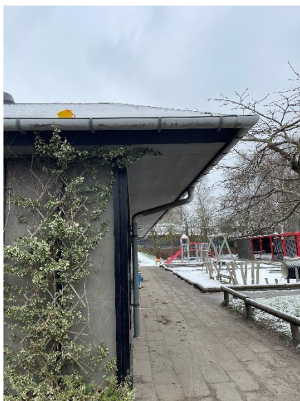
Flisebelægningen er ok men trænger til en gennemgang
