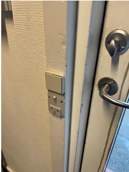
De fleste installationer er ældre placeret i dørgerigter
