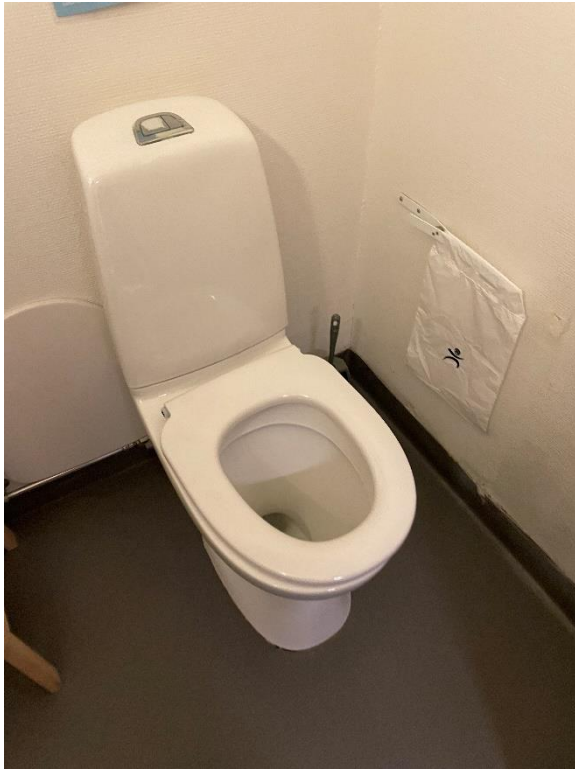
Toilet med 2-skyl, ældre model
