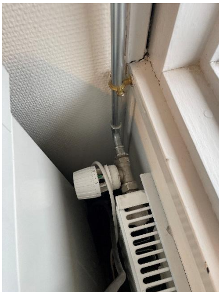
Termostatventil på alle radiatorer
