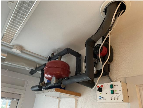
Varmeforsyning og ældre styring til ventilationsanlæg
