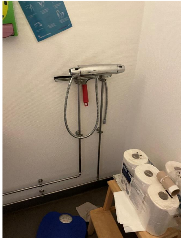
Brusefacilitet, ikke i brug og rummet heller ikke egnet til vådrum.
