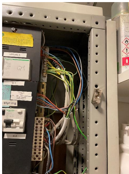
Kabel interiør i hovedtavle
