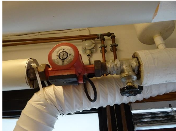
Varmefordelingspumpe, ældre trinstyret Grundfos. Fejlmonteret med klemkassen nedad.
