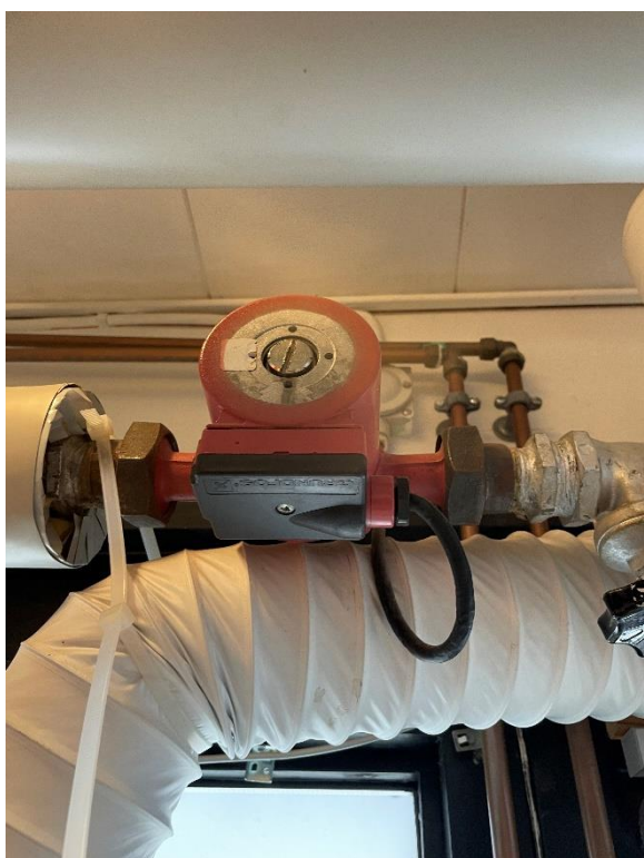
Ældre trinstyret pumpe
