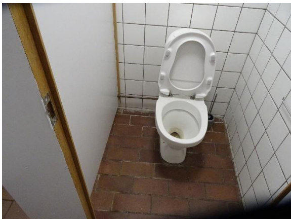
Vandinstallation på toilet
