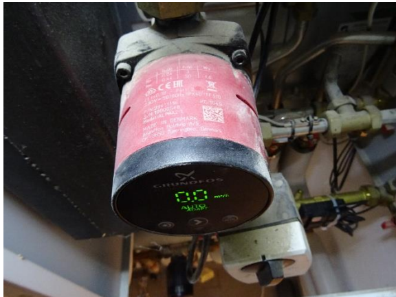
Varmefordelingspumpe i fjernvarmeunit fra 2019
