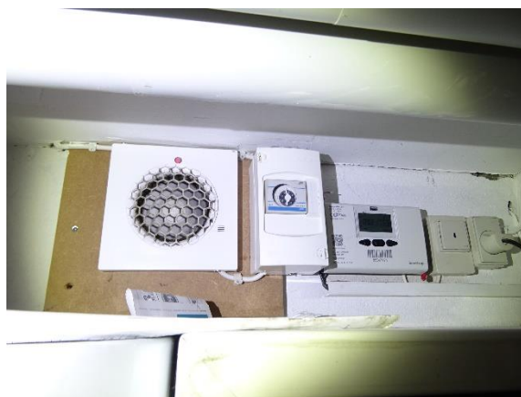
Ventilator i teknikrum
