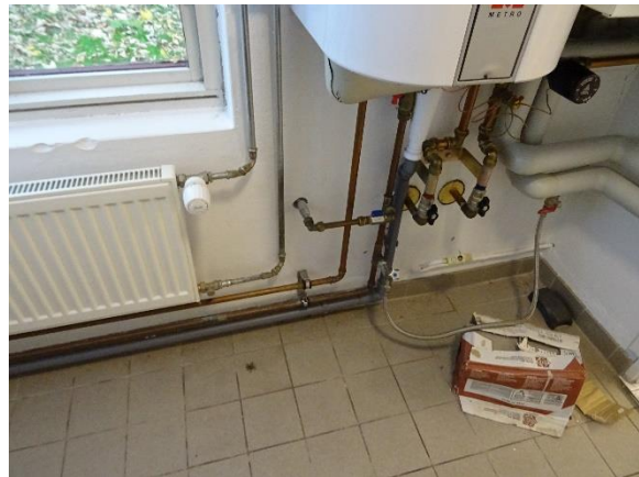
Vandinstallation under varmtvandsbeholdere
