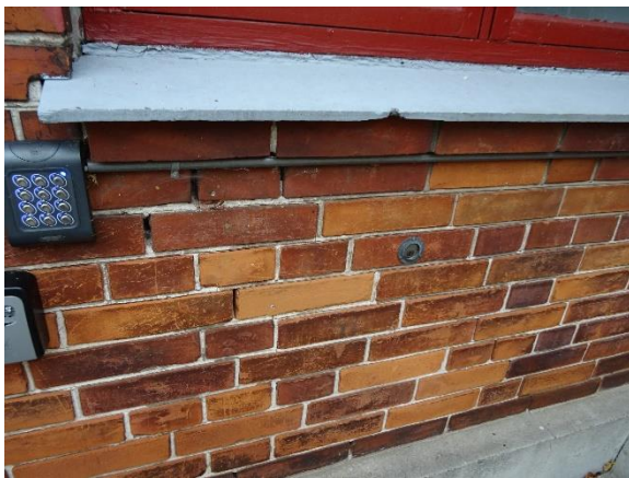
Mindre fugeskader på murværk
