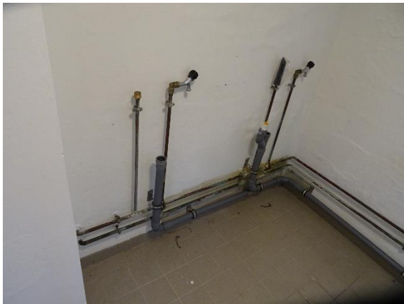
Vandrør i kobber, døde rør efter nedtagne vaske
