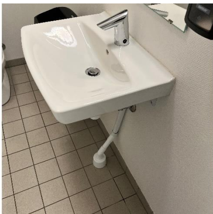
Afløbsrør i plast på toilet
