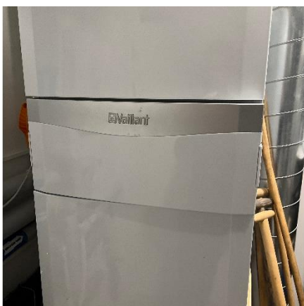
Varmepumpe placeret i teknikrum
