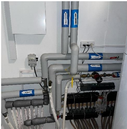
Brugsvandsrør i teknikrum
