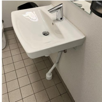
Klinkegulv på toilet
