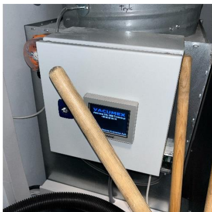
Automatik styring til ventilationsanlæg
