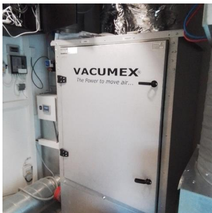
Ventilationsanlæg i teknikum
