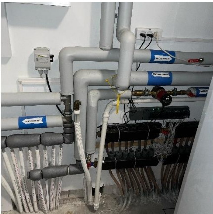
Brugsvands- og gulvvarme rør
