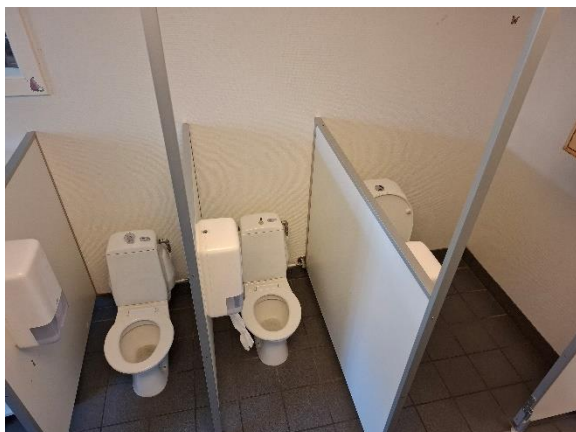
Ældre toiletter med 1 skyl
