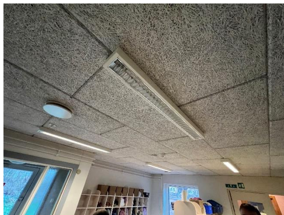
HF-armaturer med PIR sensorer.
