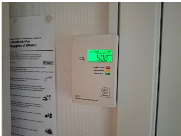
CO2 styring til ventilationen
