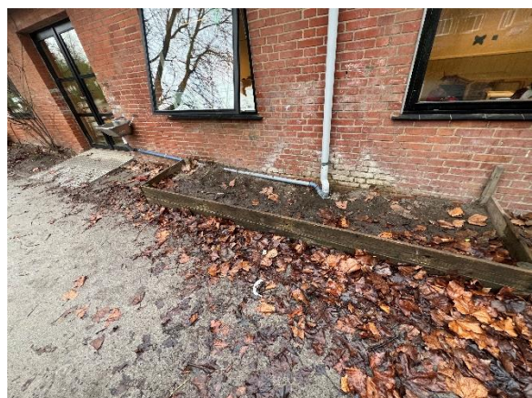
Terrænet er over fundamentet algevækst på teglstenen
