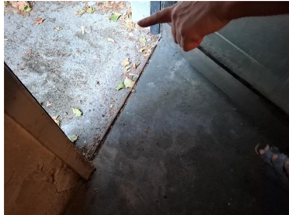
Vand trænger ind gennem kælderdoor til rampe på bygningens østside.
