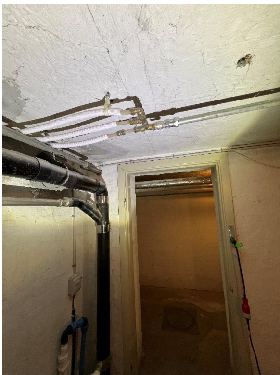
Installationer op hængt i "Plastik Strips"
