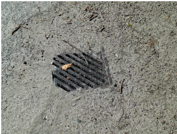
Løst materiale omkring brønde
