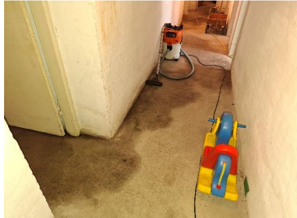
Vand i kælderen
