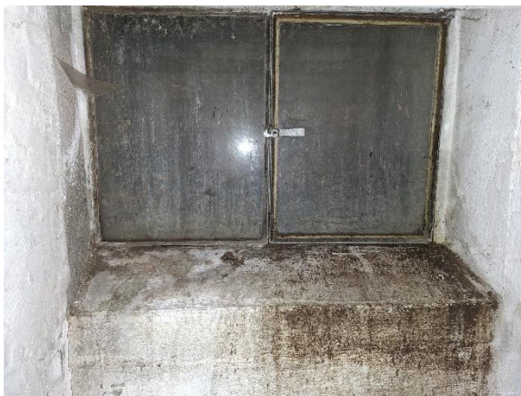
Overfladevand fra lyskasse fylder ind i kælder
