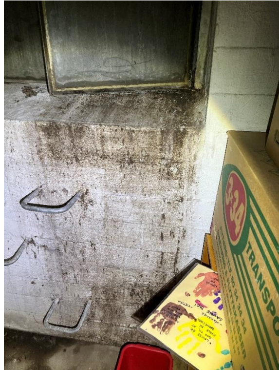
Vandindtrængning fra lyskasse, grundet stoppet afløb.
