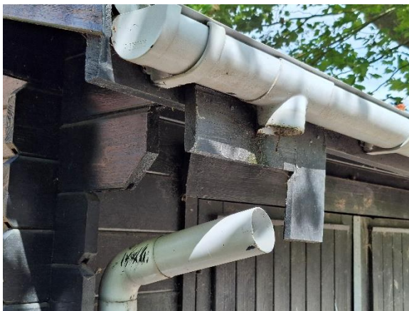
Defekt nedløb på skur, afvander direkte i jorden.
