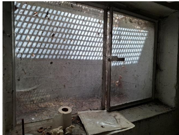
Kældervindue i varmecentral
