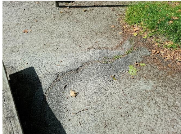
Beskadiget asfaltbelægning på legeplads
