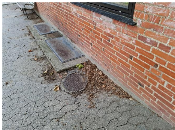
Blade og skidt i lavning mod kælderydervæg og lyskasser
