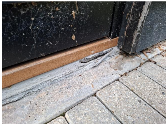
Mangelfuld fuge under dør mod øst.
