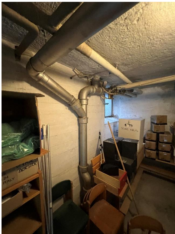
Støbejernsrør med blyholdig maling.
