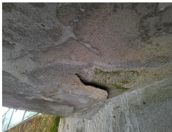
Fugt skader på dæk over kælderhals. salpeterudtræk i beton.
