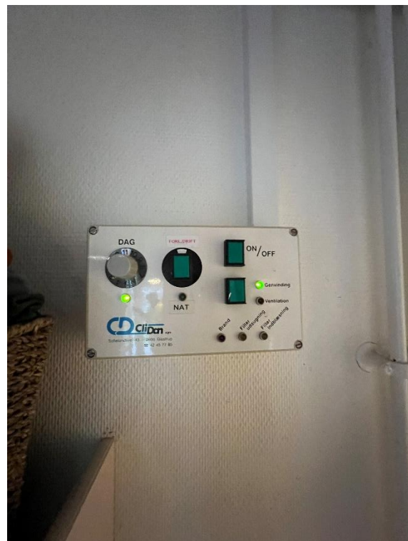
Ældre styring af ventilation
