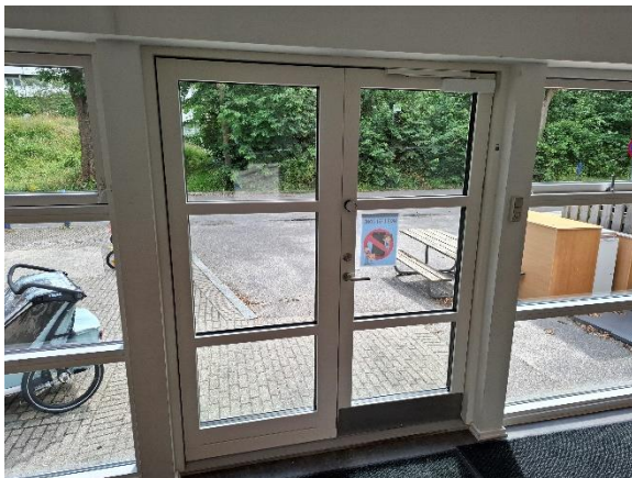
Hovedindgangsrør mellem bygning 4 og 5
