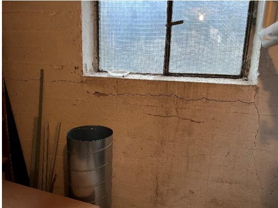
Revner i fundamentet under vinduer
