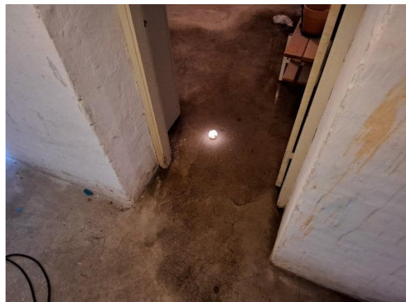
Vand i kælderen
