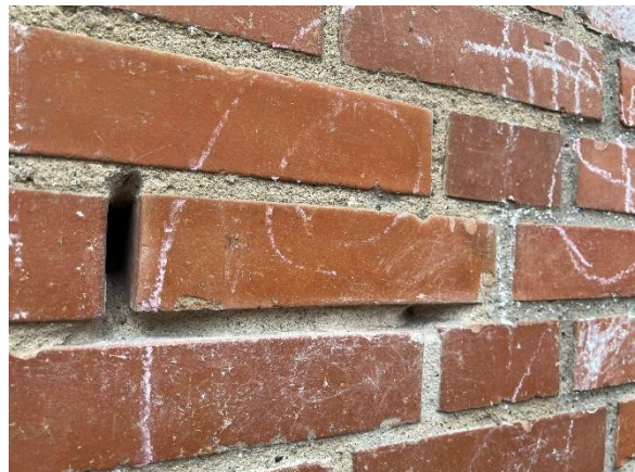
Enkelte fuger er kradset ud.
