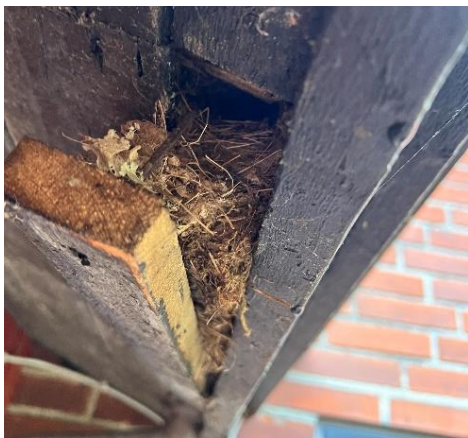
Udhængsbrædder nedfaldet og med fuglerede et enkelt sted.
