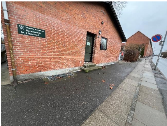
Fuger mod nord er delvist fuget om
