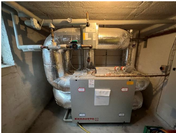
Ventilationsaggregat i kælder
