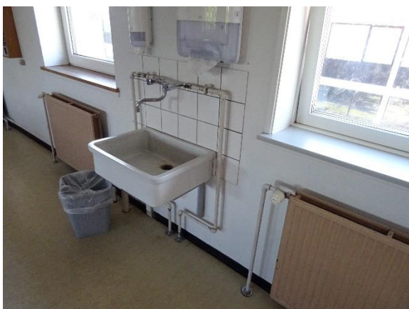
Udslagsvask med vandarmatur på gang
