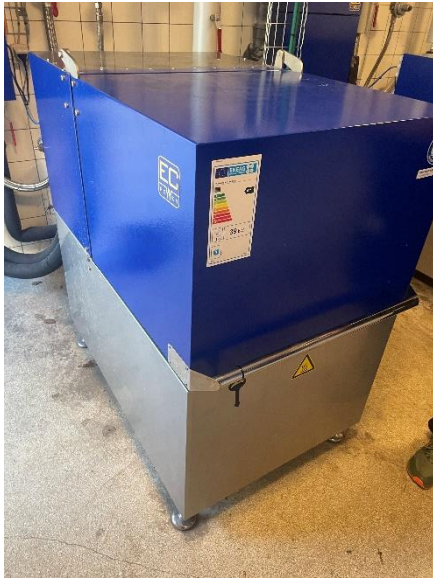
Gasgenerator til spidsbelastning
