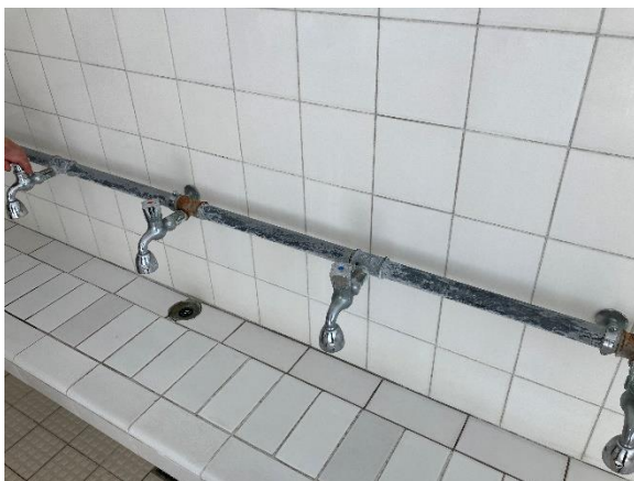
Vandrør med flere vandarmaturer på i omklædningen.
