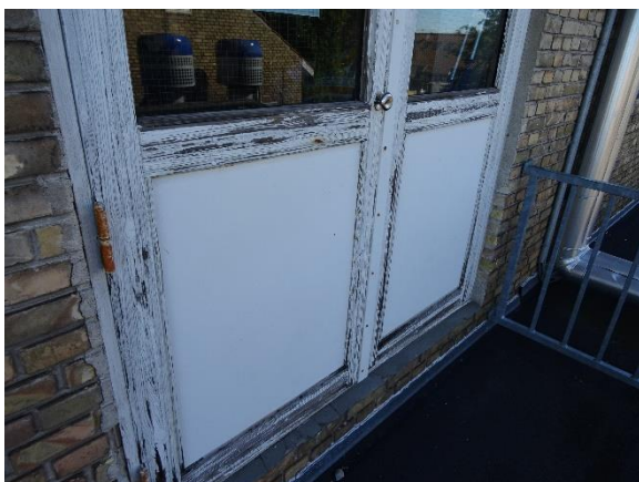
Nedslidt træ på udvendig dør
