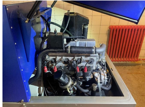
Gasgenerator til spidsbelastning
