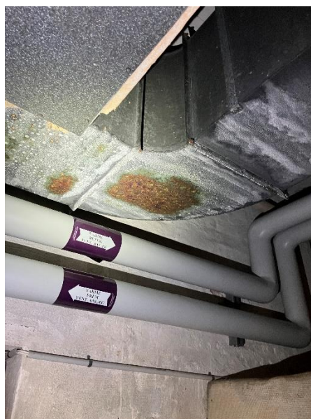
Tæring på ventilationskanal i kemi oplag.
