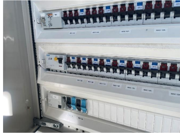
Ødelagt tavlefelts afdækning.
