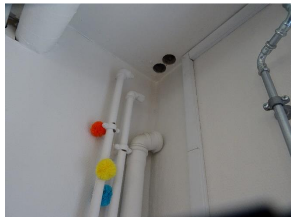
Afblændet vandrør i toiletrum
