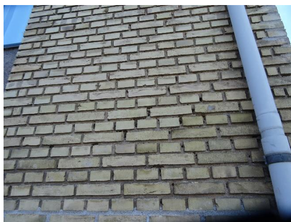
Slidte fuger i facade
