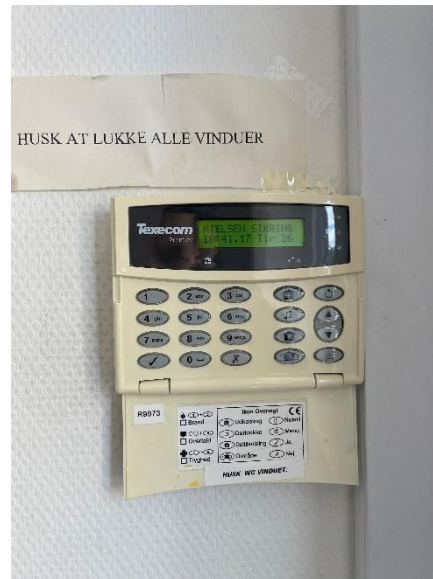
Alarmpanel ved hoveddør
