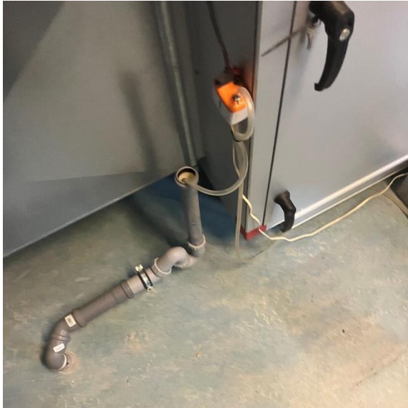
Kondensafløb ventilationsanlæg med pumpe
