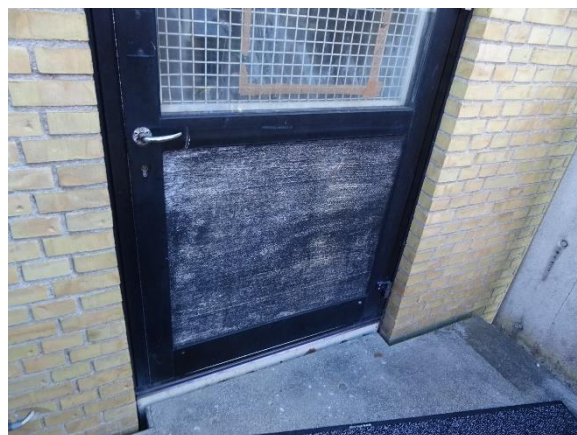
Nedslidt udvendig dør
