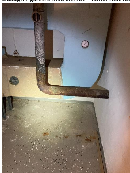
Gennemtæring umiddelbart nært forestående
