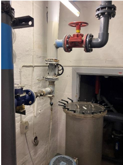
Vandinstallation i kælder ved teknisk personale område
