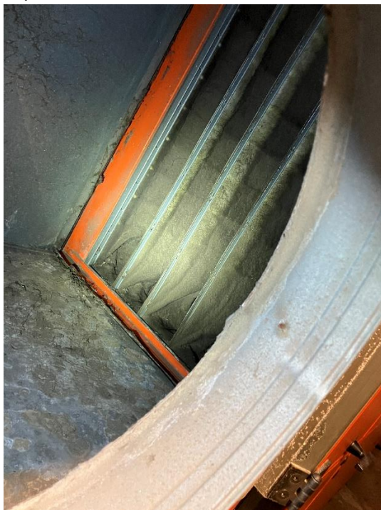
Indsugningsfiltre ikke skiftet
