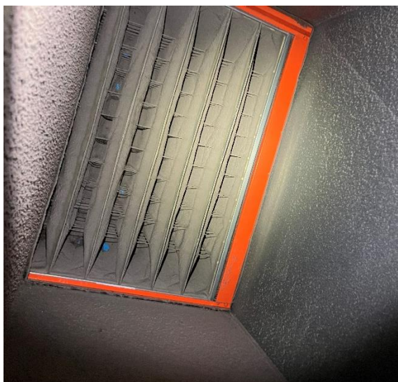
Udsugningsfiltre ikke skiftet – kanal helt lodden
