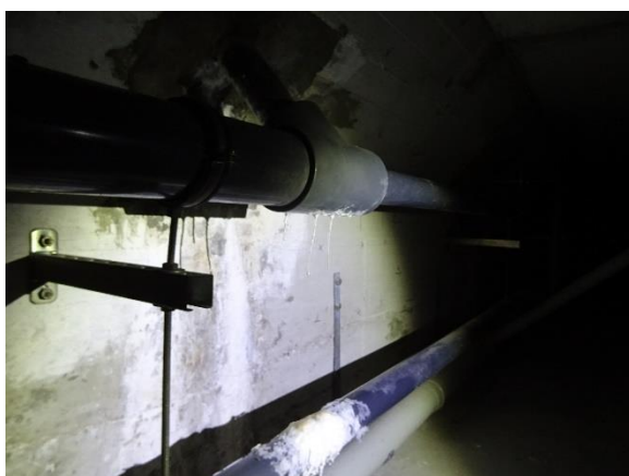
Utæt rørsamling til svømmebassin
