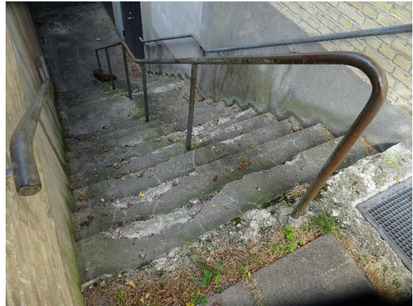
Betontrappe med mange skader mod vest
