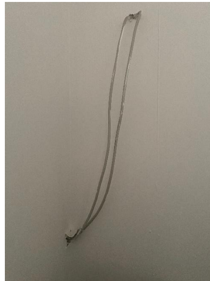
Ikke godkendt kabelføring. Mangler fastgørelse
