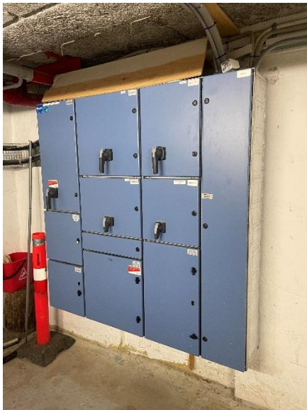
Hovedtavle i kælder.
