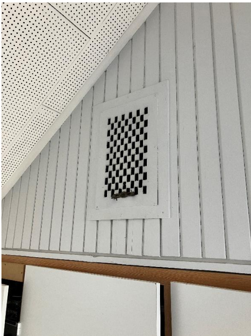
Naturlig ventileret flere steder. Her med rist
