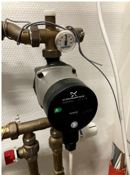
Pumpe på varme systemet
