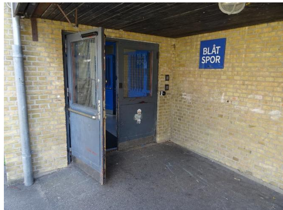
Ældre glasdør meget nedslidt i pladerne
