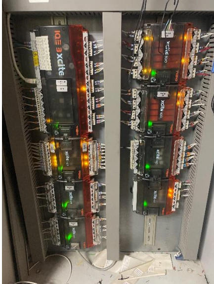
IQE3 Xcite styring af varme installation
