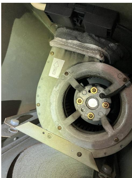
Ventilator i anlæg i kontor
