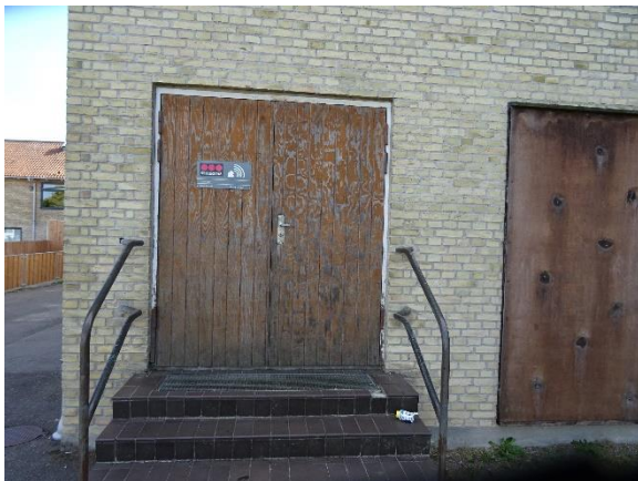
Ældre trædør meget nedslidt pga. manglende vedligehold
