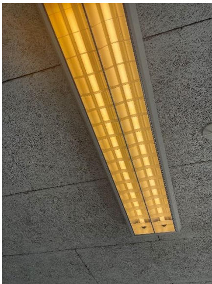
Belysningsarmatur der ikke er udskiftet til LED
