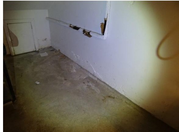
Kældergulv og væg af plade støbte beton, spor af opstigende fugt
