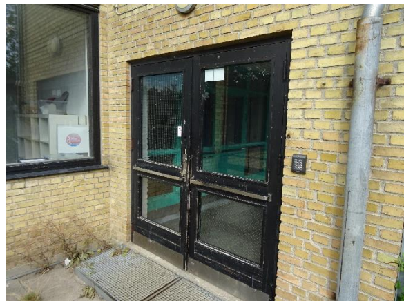
Ældre glasdør meget nedslidt i træet
