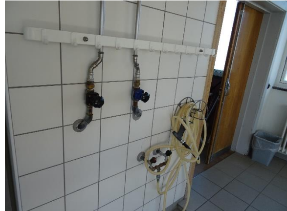
Flere dele af de synlige installationer er skiftet. Hvilket efterlader de skjulte hvor det er svært at vurdere tilstanden.
