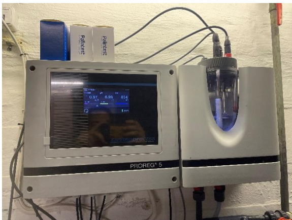
Doseringsanlæg fra ENVIRO PROCESS
