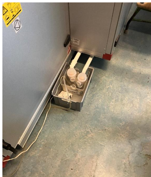
Kondensafløb på nyere installeret ventilationsanlæg – Her udført med elegant grå klodskasse tilpasset for installation som fælles opsamling.
