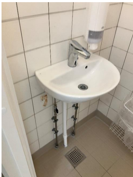
Håndvask med sensorstyring
