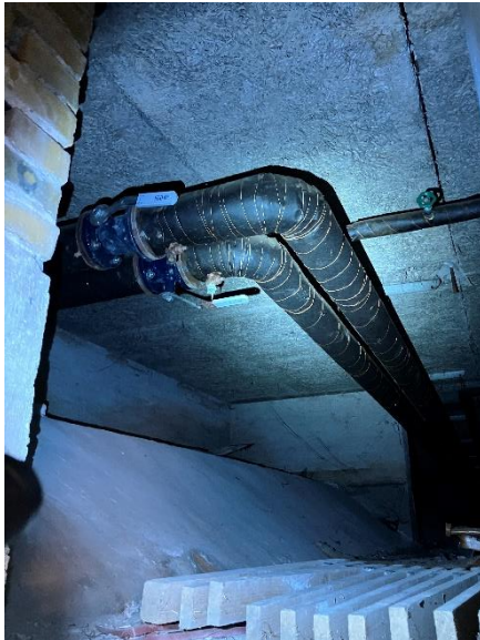
Krybekælder skakt set fra kælderlem. Ikke adgangsforhold der tillader isolering pga. højde og installationer.
