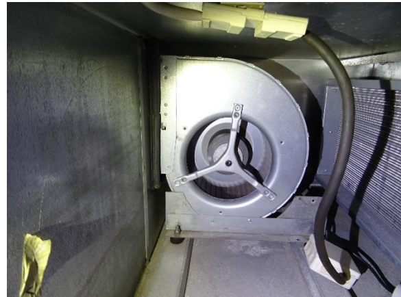
Ældre ventilator i anlæg på loft over lærerværelse
