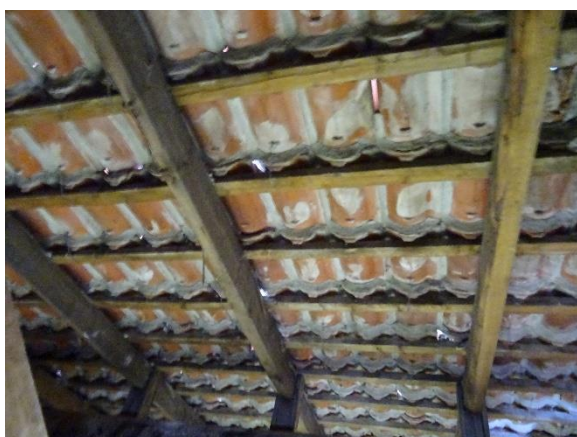
Understrygning over lærerværelse, trænger til udbedring
