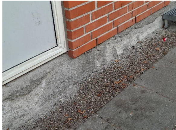
GM 5 – Sokkel på tilbygning mod nord
