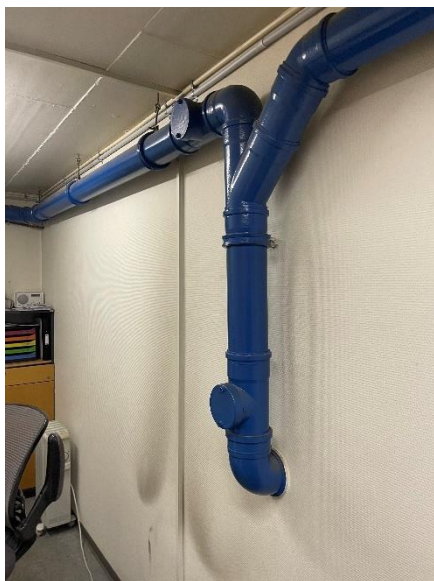
Afløbsrør i kælder i GM1 Det er ikke støbegodsrør
