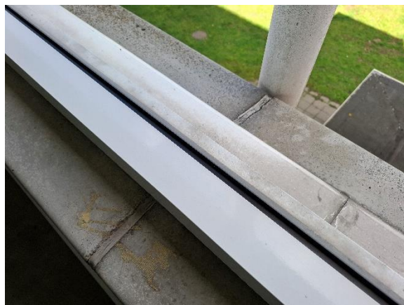
GM 1 – Facadepartier i alu mod nord. Fuge mellem sålbænke i beton slipper.
