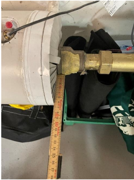
Isoleringstykkelsen på varmerørinstallation i varmecentralen GM1
