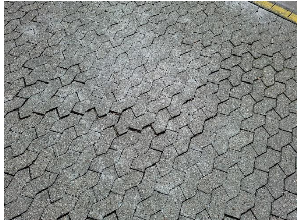
FS-sten ligger ujævnt enkelte steder
