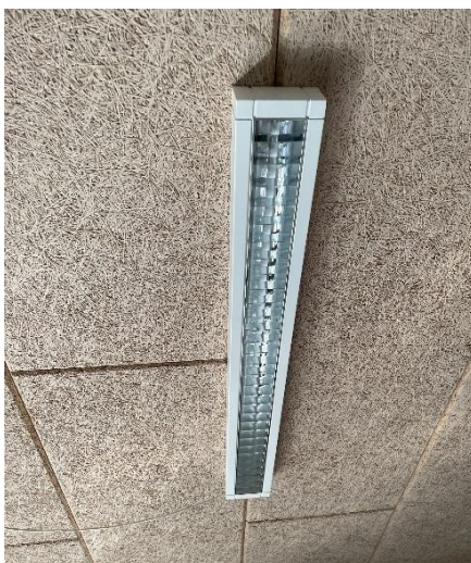
Belysningsarmatur i bygning GM5 spolerør
