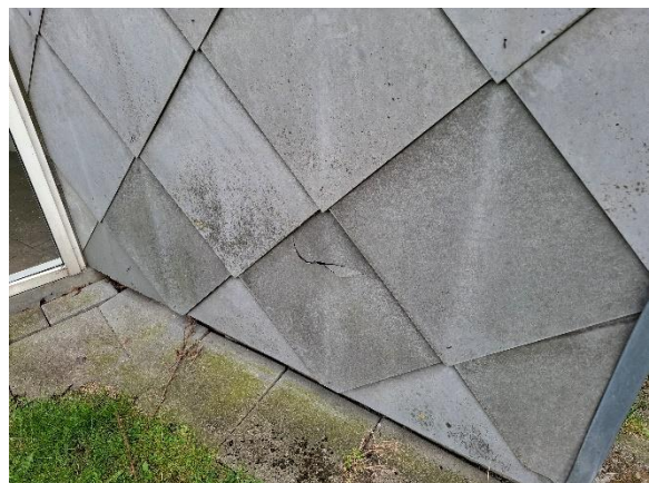
GM 1 – Knækket eternitplade på elevatortårn
