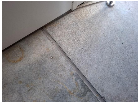
GM 1 – Gulv i svalegange. Elastiske fuger slipper
