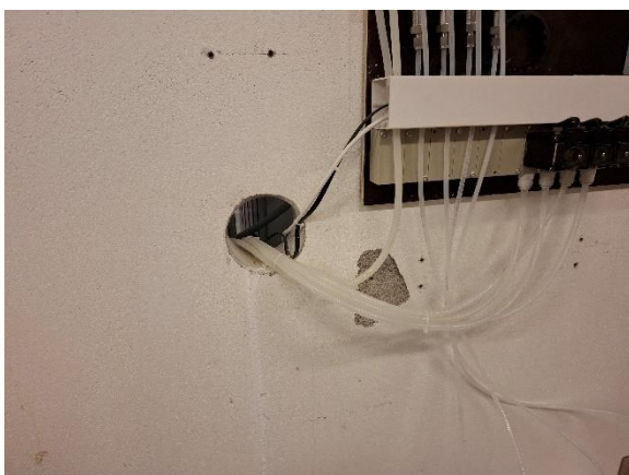
GM 5 – Gennemføringer i kælderen skal gennemgås ift. væggenes brandklassificering.
