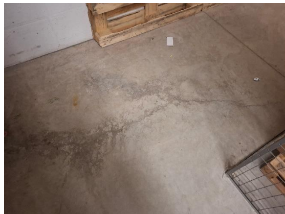
GM 1 – Revne i kældergulv
