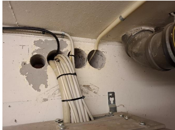
GM 1 – Gennemføringer i kælderen skal gennemgås ift. væggenes brandklassificering.
