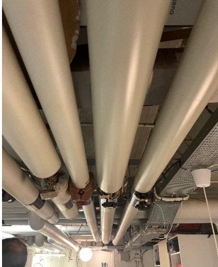
Rørføring under GM1
