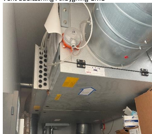
VE ventilation i tilbygningen
