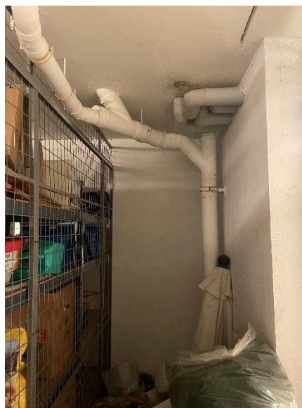
Afløbsrør i kælder GM5
