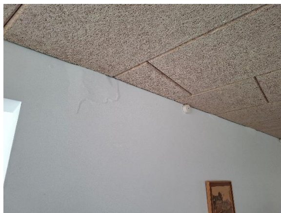
GM 5 – Loft i fælles opholdsrum. Der er udposninger i tapet på vægge flere steder umiddelbart under loft. Forholdet bør undersøges nærmere.
