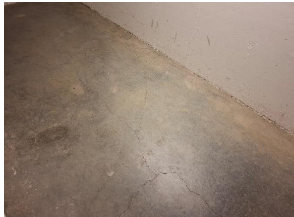
GM 5 – Revne i kældergulv
