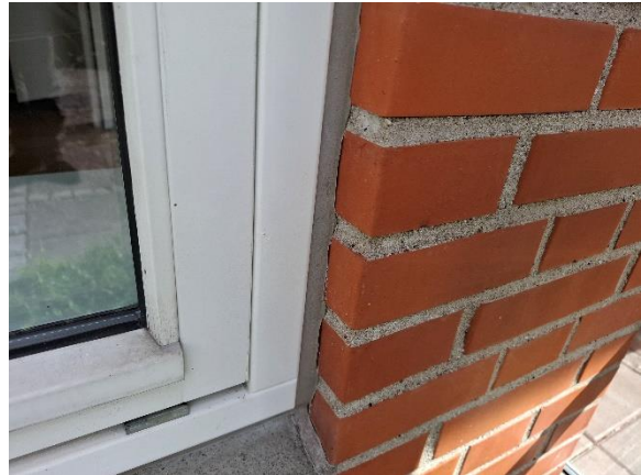
GM 5 – Fuge med manglende vedhæftning til murværk
