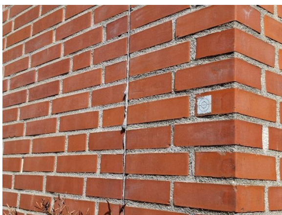
GM 1 – Dilatationsfuger har krakeleret overflade og er flere steder presset ud. Elasticiteten er begrænset.
