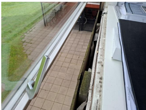
GM 1 – Manglende sålbænk og tilsætning omkring vinduer i tilbygning, 1. sal
