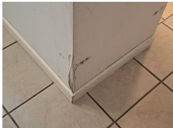
GM 1 – Gips hjørne i omklædningen i tilbygningen.
