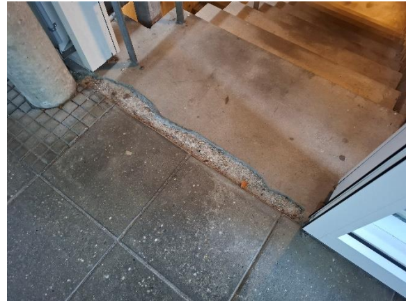
GM 1 – Betontrappe til kælder er med afskallende beton ved skydedør
