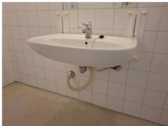
GM 1 – Håndvask og armatur i bolig
