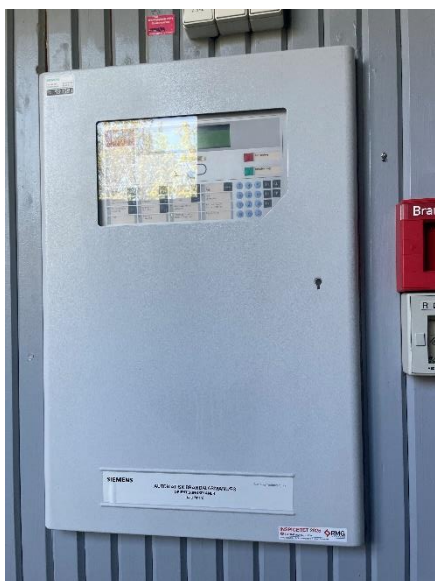
ABA central 2008 Siemens
