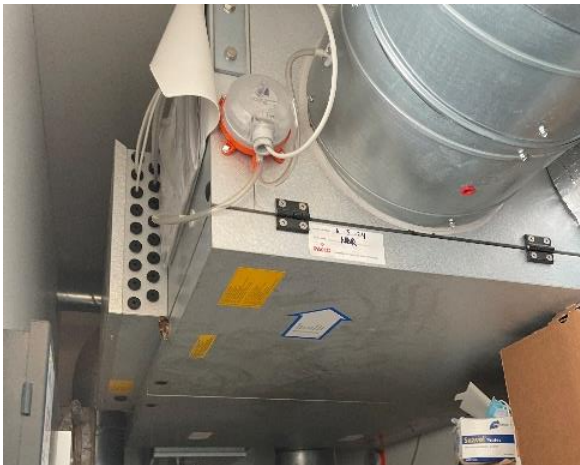
VE ventilation i tilbygningen
