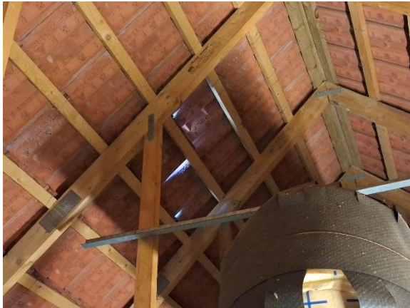
GM 1 – løse tagsten med manglende tæthed.
