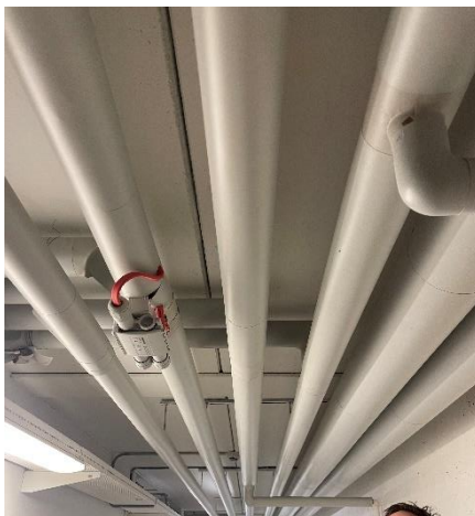
EL-tracing på varmerør med iso under gang GM5
