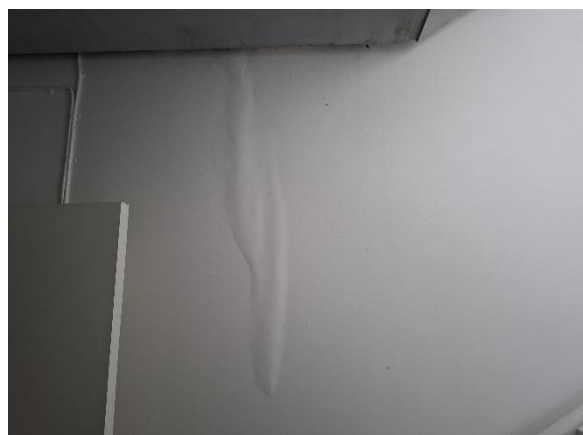
GM 5 – tapet med manglende vedhæftning i trappeopgang under indgangsdør mod vest kan skyldes opfugtning.
