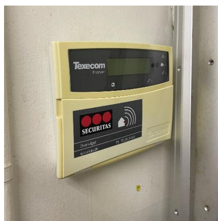
Ældre Texecom panel ved dør
