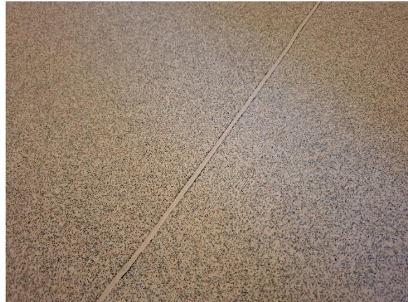
GM 1 – Vinylgulv i badeværelse i bolig. Svejsefuge trænger til udskiftning.
