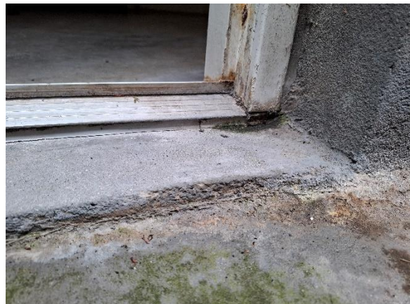
GM 5 – Nederste fuge slipper på yderdør i kælderskakt
