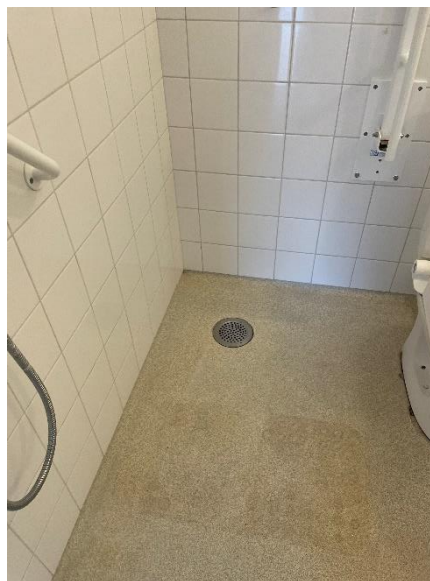
Afløb ved badeværelse i lejlighed GM1
