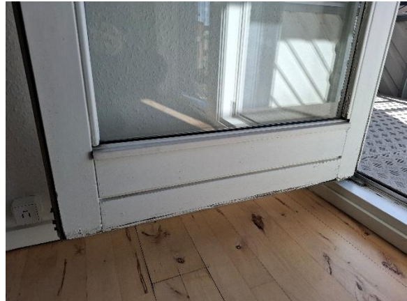
GM 1 – Dør til altan med afskallende maling nederst.
