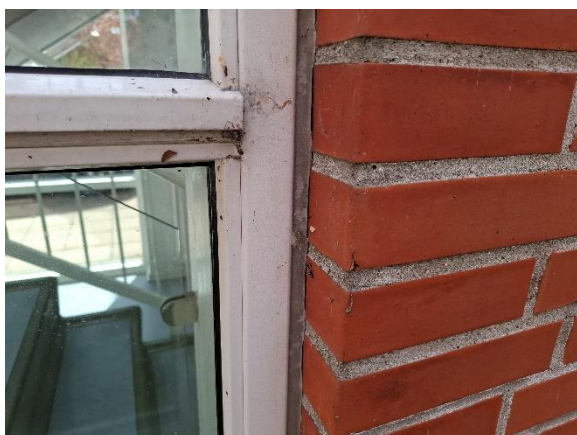
GM 5 – Fuge med manglende vedhæftning til murværk
