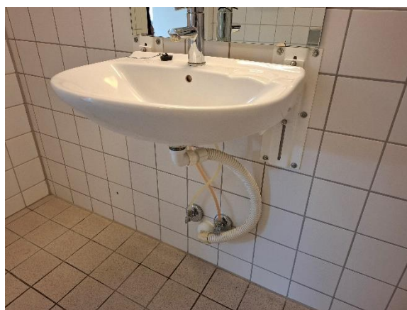
GM 1 – Håndvask og armatur i bolig
