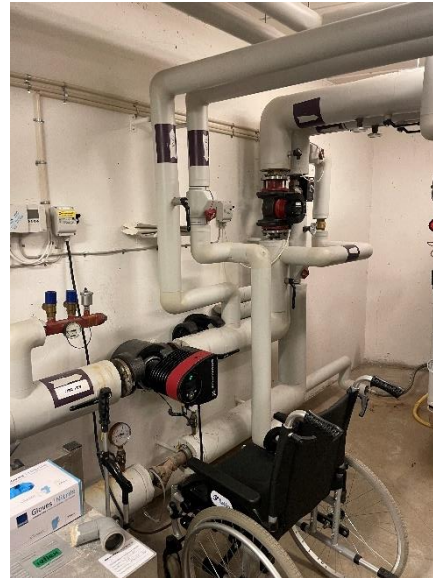
Varmecentral i kælder GM5
