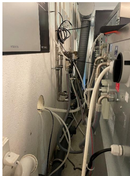
Vandinstallationer til vaskemaskiner i kælder GM5
