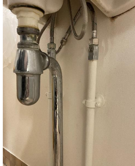
Vandlås og brugsvandsrør i kælderen GM1
