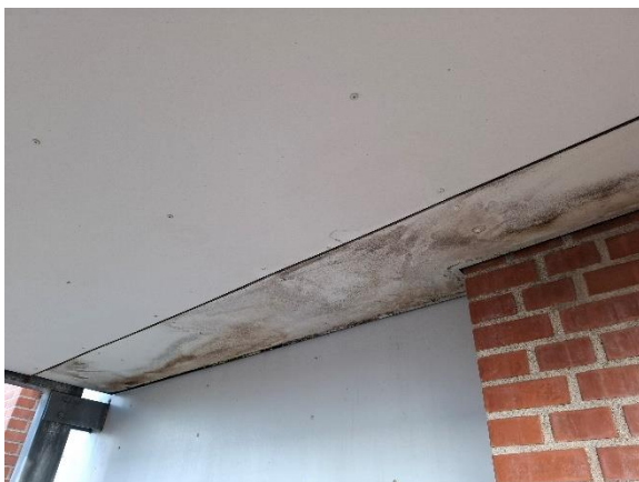
GM 1 – Misfarvninger på beklædning under altan
