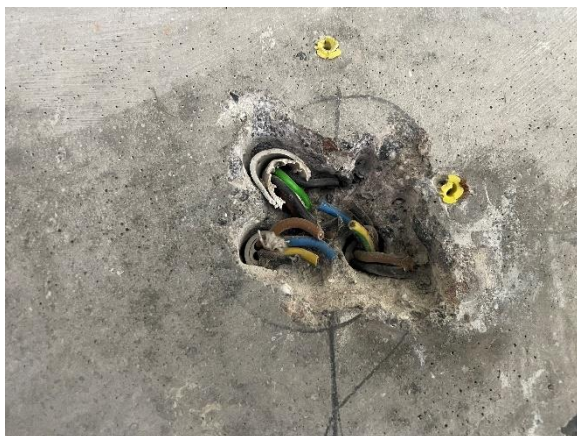
Eksempel på uafsluttet installationer ADVARELSE! Kan være under spænding
