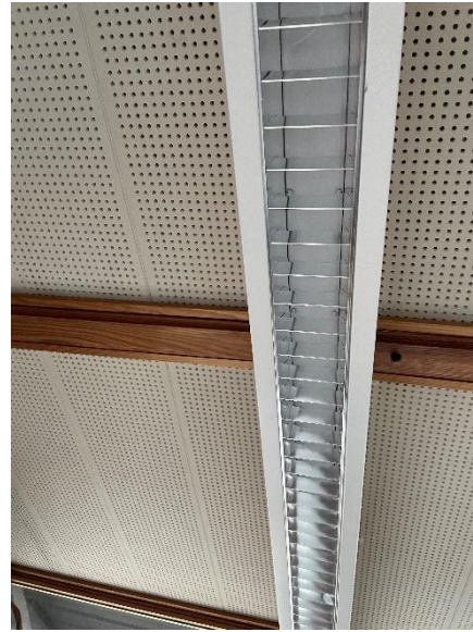
Ombygget LED armatur ældre del af bygningen
