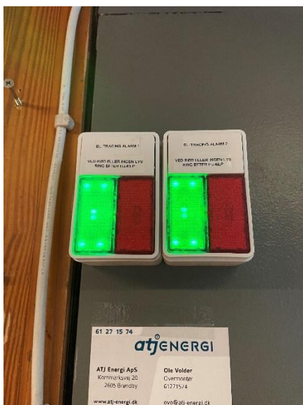
EL tracing alarm for problemvandør i ældre del af bygningen
