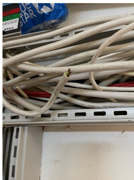
Uafsluttet kabel i depotrum
