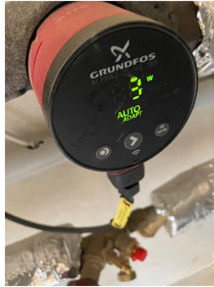
Pumpe til varmeinstallationen
