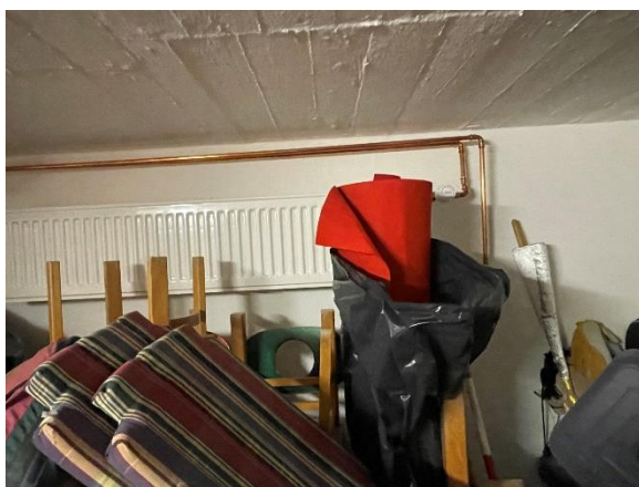
Radiator i kælder 2 strengs system med kobberør
