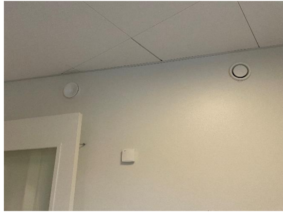
Indblæsning og udsugnings armaturer i den nyere bygning.
