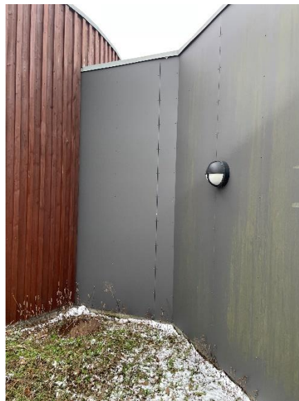
LED armatur udvendigt
