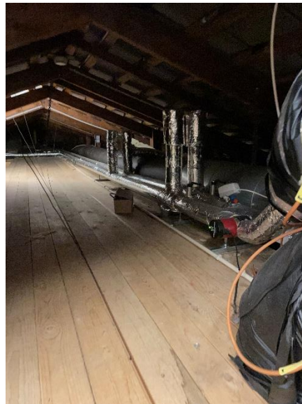
Del af kanal installation VE 02 til den ældre bygning på loft
