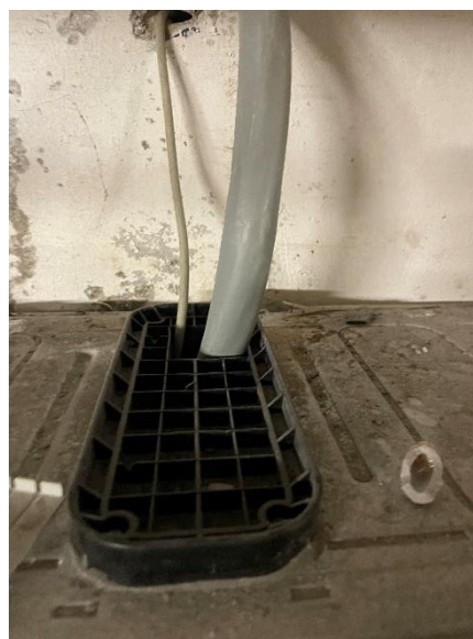
Uforseglet gennemføring i tavle i kælder
