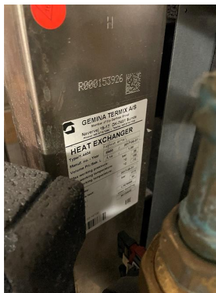
Mærkeplade varmeveksler i fjernvarmeunit
