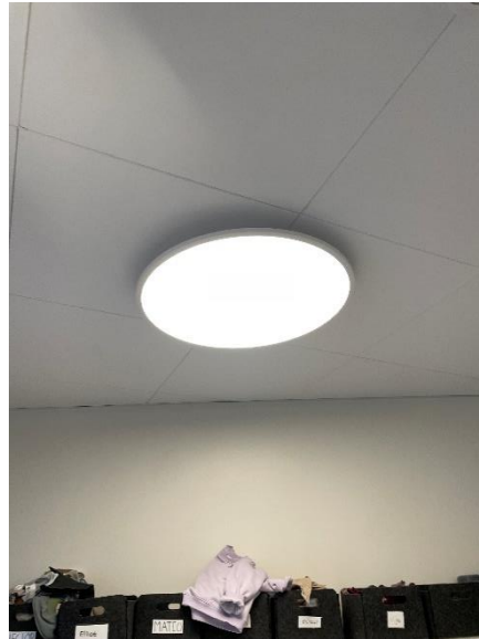
LED belysning i nyere del af bygningen
