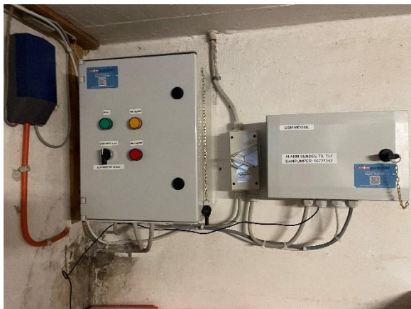
Pumpestyring i kælder
