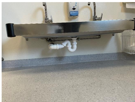
Børnehåndvask med afløb og vinyl gulv
