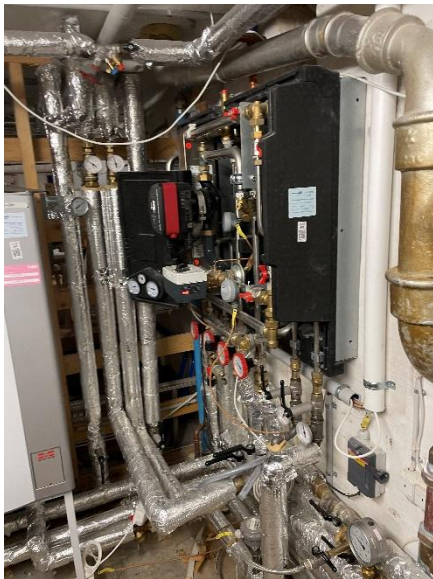
Varmecentralen i kælderen
