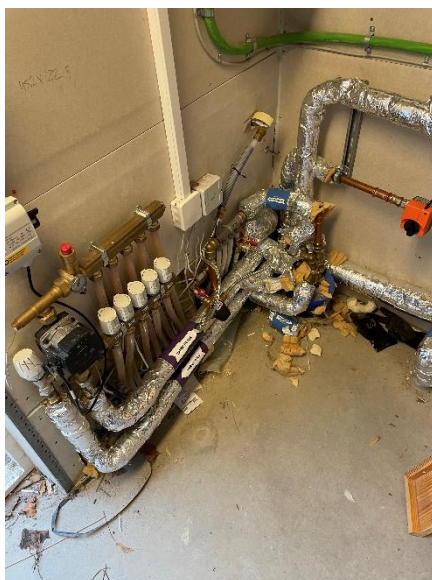
En af to gulvvarme anlæg placeret i det ene ventilationsrum
