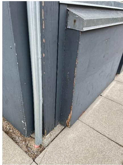
Flere slidskader på facaden.
