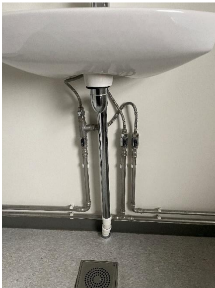
Rørinstallation under håndvask i nyere bygning udført i rustfrit stål
