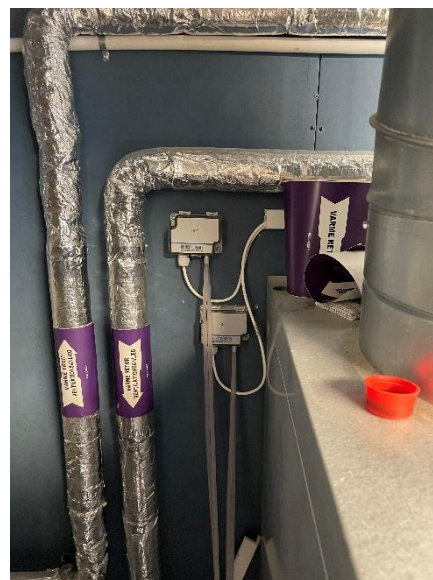
Isoleret rørinstallation til varmeventilation
