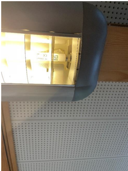
Lysstofrør armatur ældre del af bygningen
