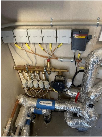
Isoleret brugsvandsrør ved gulvarmeanlæg i ventilationsrum
