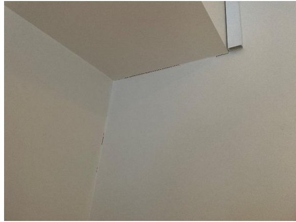
Revne i materialeovergang i den nyere bygning.
