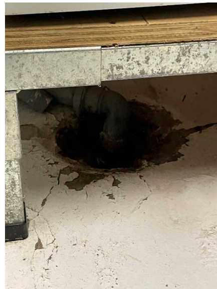
Afløb under vaskemaskine i depotrum
