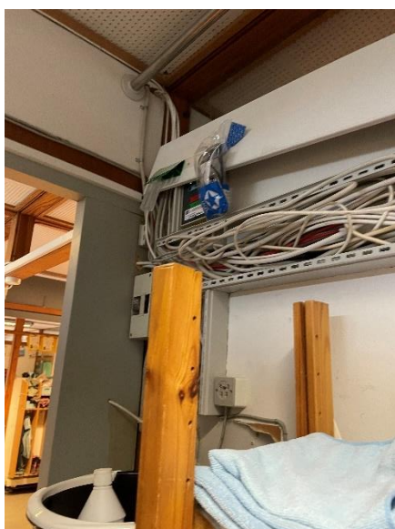
Åben kabelkanal i depotrum
