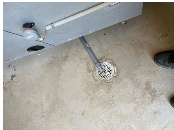
Afløb for ventilationsanlæg
