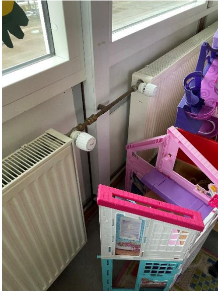
Radiator i parallel forbindelse i den ældre del af bygningen.
