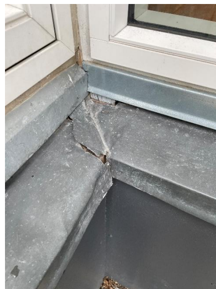
Skadet zink sålbænk på ældre bygning
