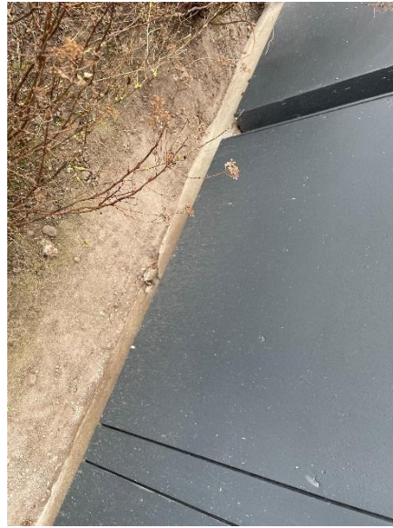
Skade på sokkelpuds, den oprindelige bygning
