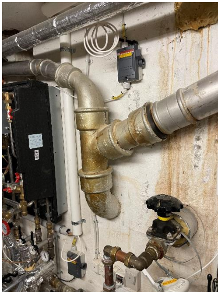
Blymalet faldstamme ved siden af varmecentral i kælder
