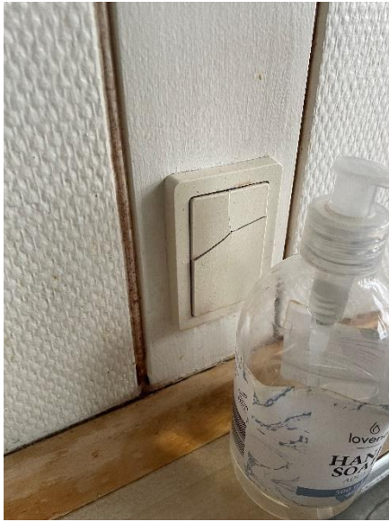
Knækket blænddæksel i den ældre del af bygningen
