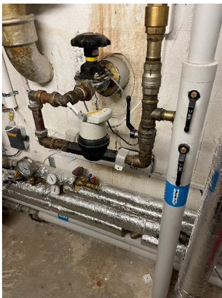
Forsyning af vand i kælderen
