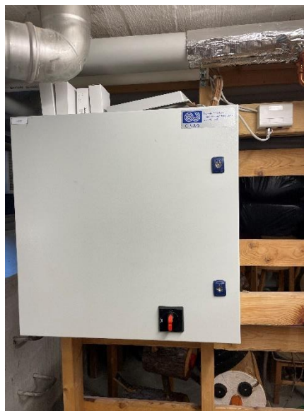
CTS styrings skab til vand/varmeinstallationer i kælderen
