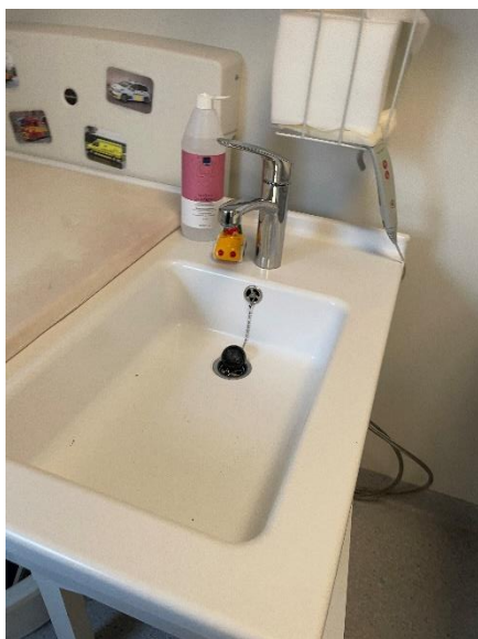
Håndvask i nyere bygning
