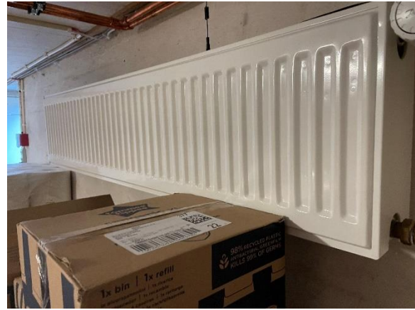
Radiator i kælder med termostat
