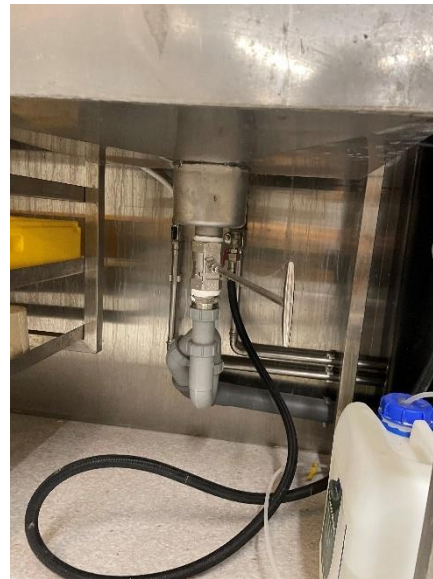
Afløb fra vask i produktionskøkken
