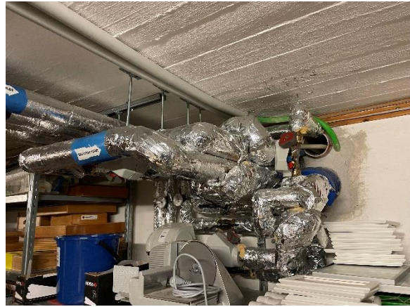
Isoleret brugsvandsrør i kælder
