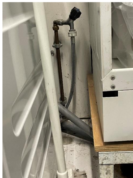
Udtag til vand for vaskemaskine i depotrum
