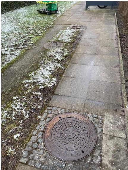
Kloakdæksler ved indgang
