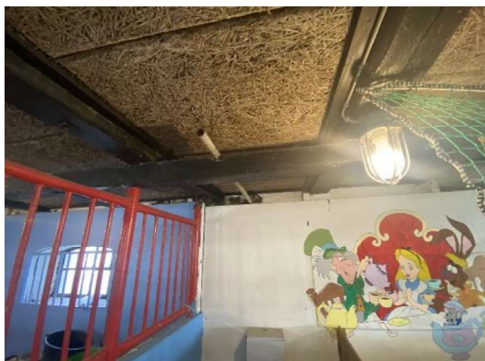
Rørføring i hestestald uden forbindelse
