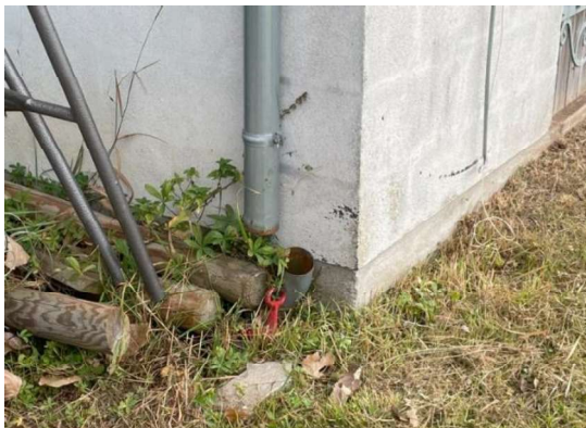
Defekt nedløbsrør ved smedjen.
