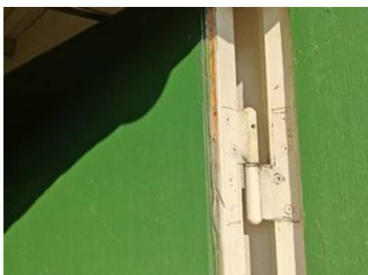
Ældre dør med ødelagt tætningsliste
