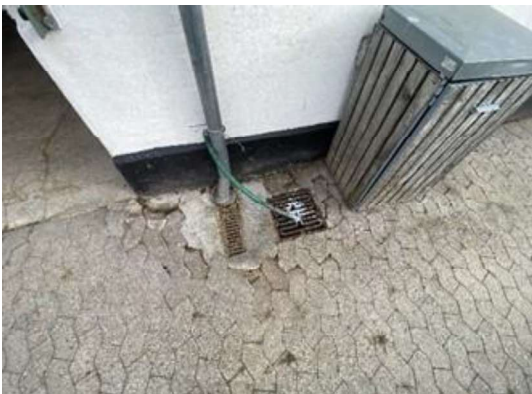
Ikke autoriseret afløb.
