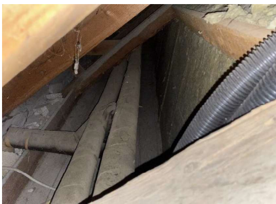
Ved kold skunkvæg er varmecentralrørene fremført. Rør er fra etablering af varmecentral.
