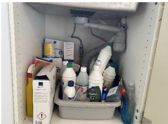
Afløb under håndvaske udført i plast.
