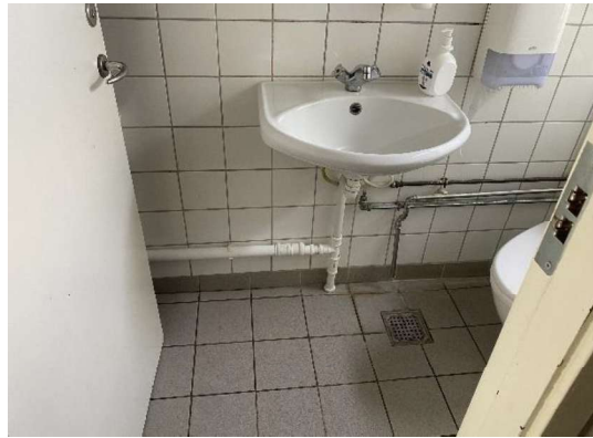
Koblingsledninger udført i kobber og rustfrie stålør
