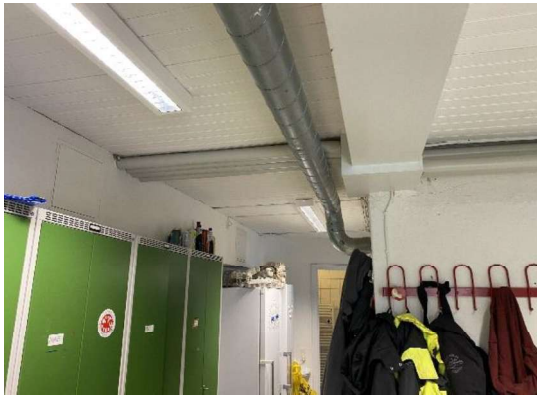
Udsugningskanal lang gang fra køkken
