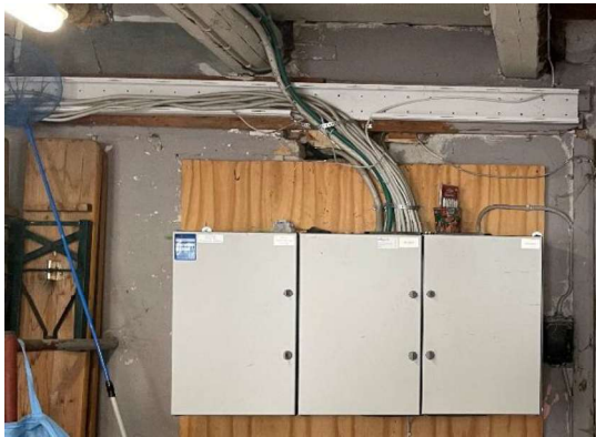
Nyere hovedtavle forkert tilsluttet.
