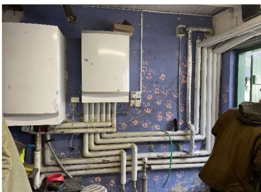
Varmecentral istandsat i nyere tid. Varmtvandsbeholder er fra 2020.
