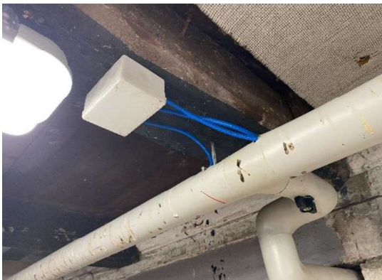
Varmekabler til frostsikring
