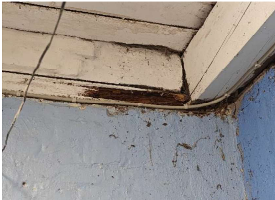
Bjælke med råd i sadelrummet
