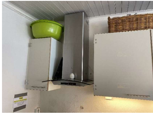
Udsugningssystem i køkkener, emhætte.
