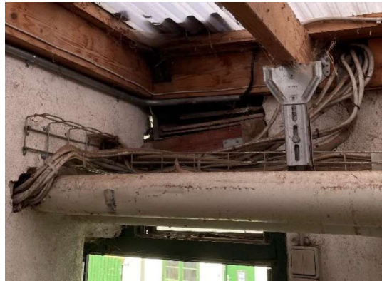
Hovedføringsvej forkert udført.
