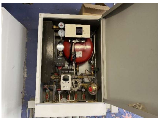
Varmecentral er udført som Gemina-Termix unit, med nyere rørføring, pumper etc.
