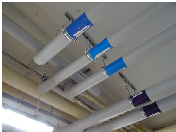
Fordelingsrør i varmecentral
