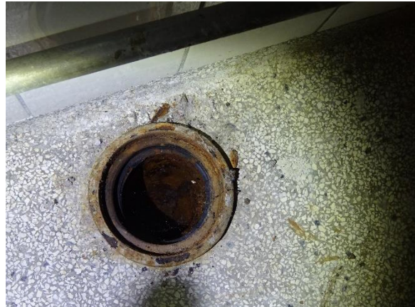
Afløb fra nedlagt toilet, død ende
