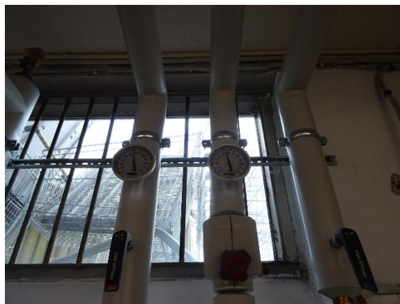
Vindue i varmecentral med termorude
