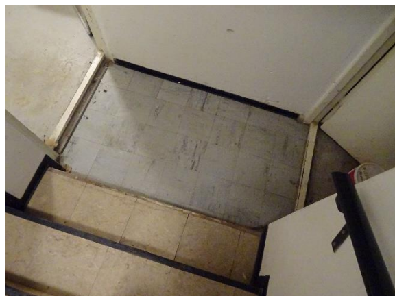
Vinyl ved foden af kældetrappe
