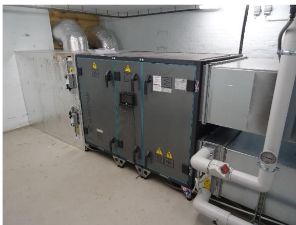
Ventilationsanlæg i kælder
