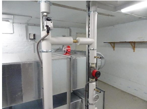
Blandeanlæg for ventilation varmeplate
