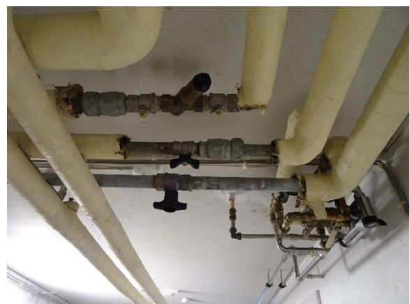
Uisolerede rør efter reparation
