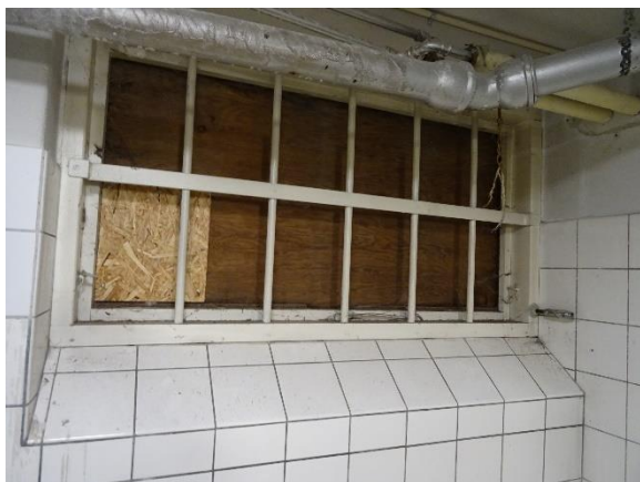
Kældervindue blændet med træplade
