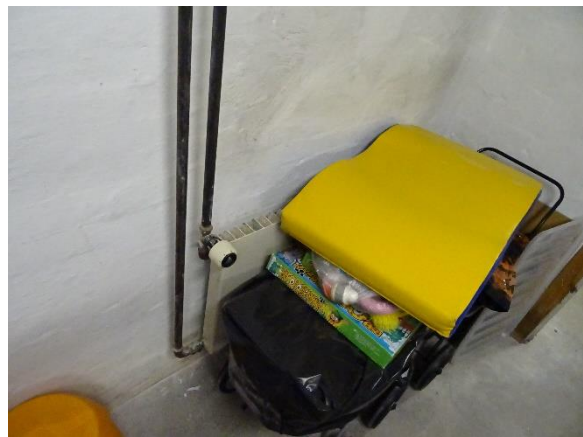
Nyere generation, men stadig ældre radiator i kælder
