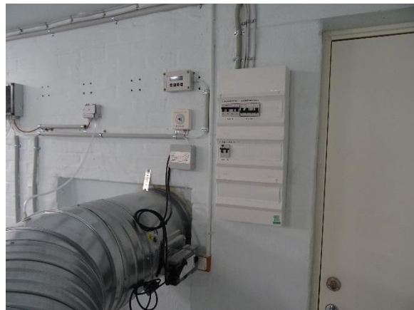
Undertavle til ventilationsanlæg
