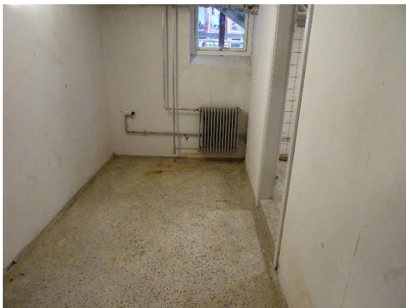
Radiator fra opførelsen i kælder
