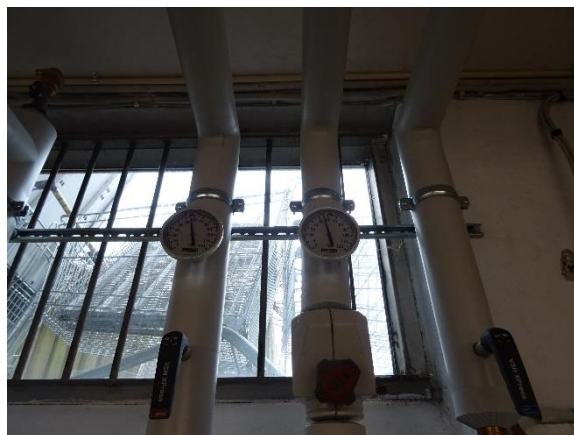
Termorude i kælder
