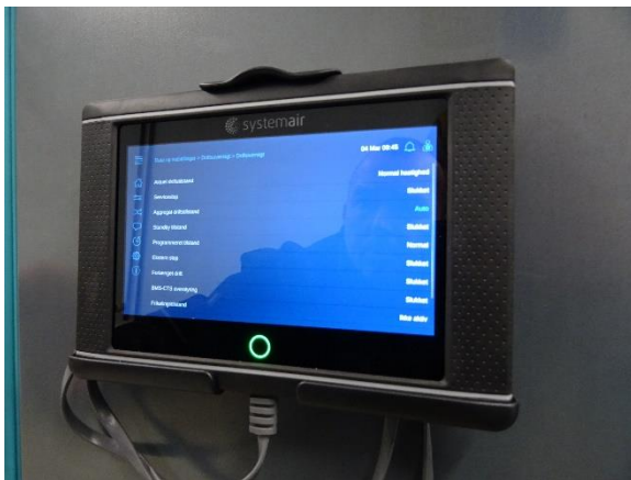
Håndterminal for ventilation, der ikke er fjernopkoblet
