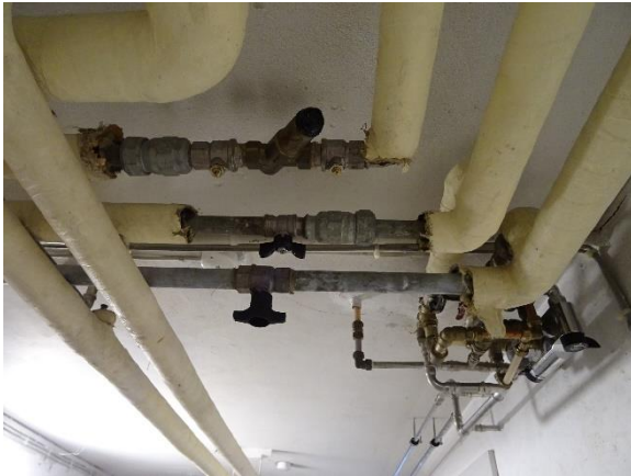
Hovedfordeling i kælder
