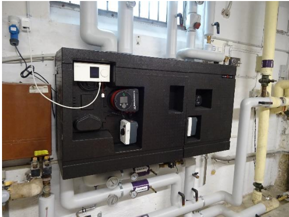
Nyt fjernvarmeunit med styring
