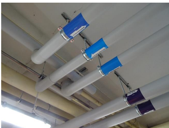
Isolerede vandør i varmecentral
