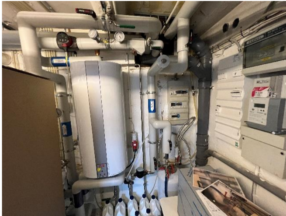
Fjernvarmefordeling og varmtvandsbeholder
