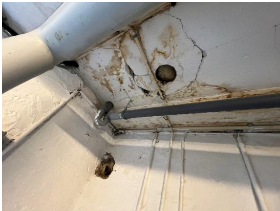
Fugt skader i loft
