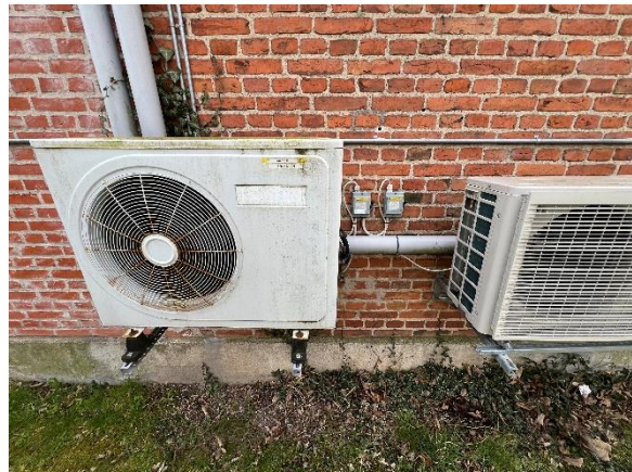
Varmepumpe anlæg 5. R22 anlæg
