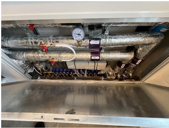
Gulvvarmeshunte i nyrenoveret bygning
