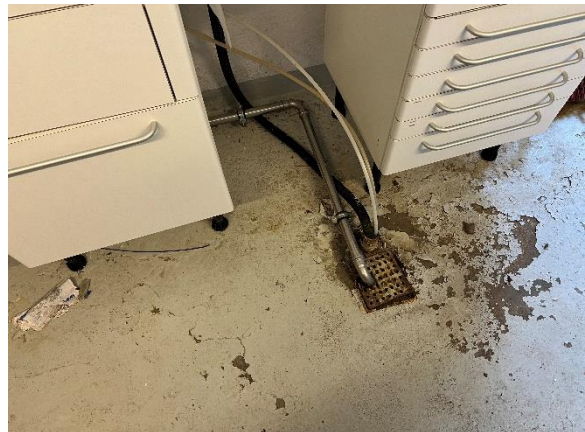
Afskalninger af maling på gulv
