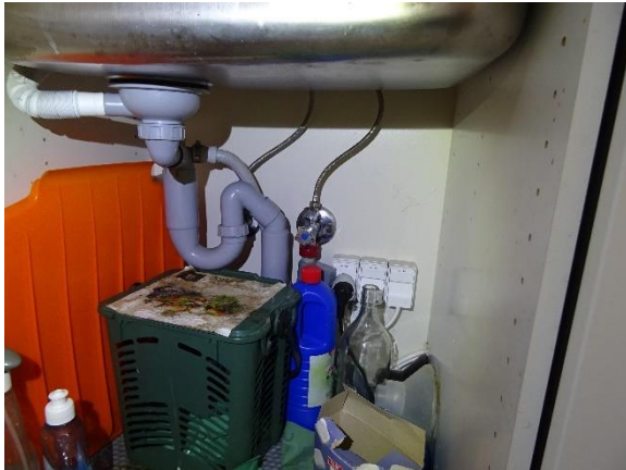
Plast afløb under køkkenvask
