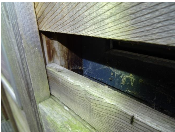
Opfugtning pga. manglende fald og ventilering
