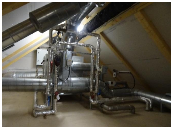
Aggregat og blandesløjfe over formidlingsbygning
