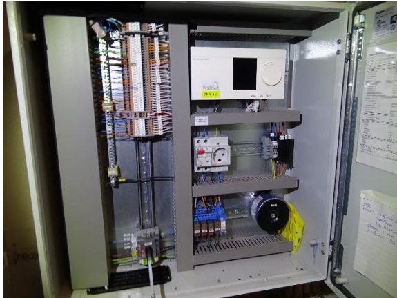
Danfoss ECL varme / ventilation styring
