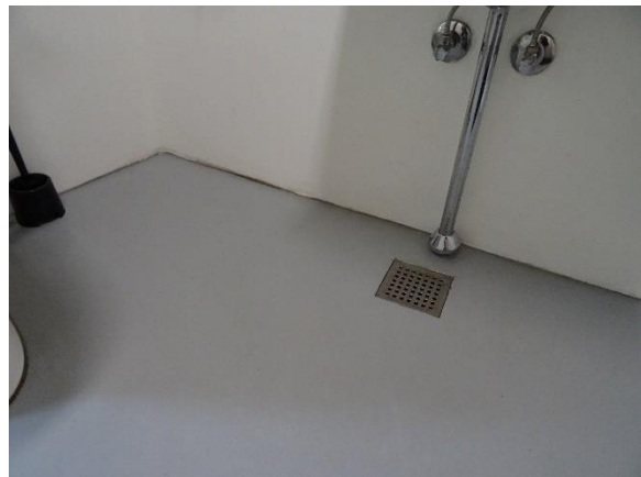
Begyndende fugtskader pga. manglende hulkehl
