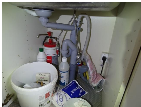
Plast afløb under køkkenvask
