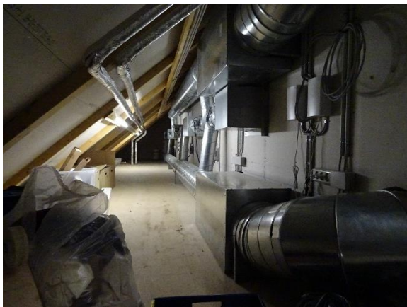
Kanaler på loft
