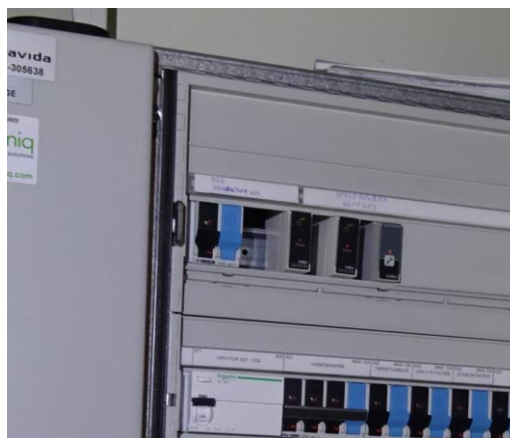
Enkelte manglende afdækninger i formidlingsbygning.
