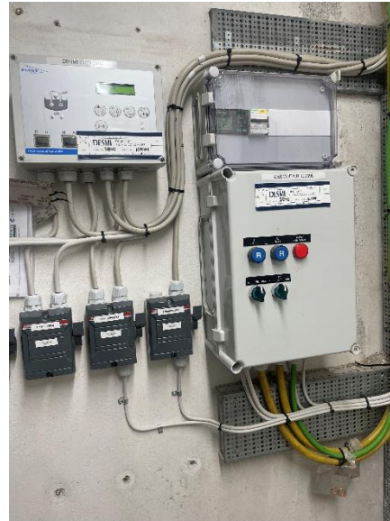
Pumpestyring i kælder
