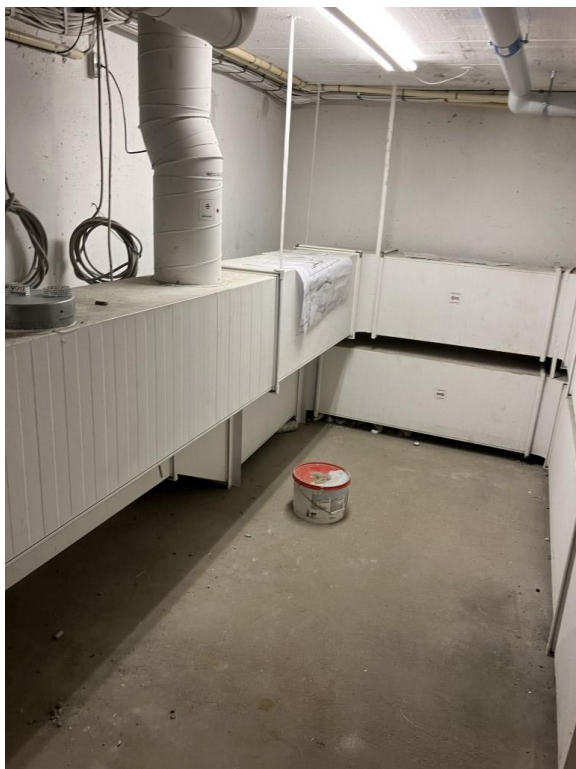
Kanaler i kælder
