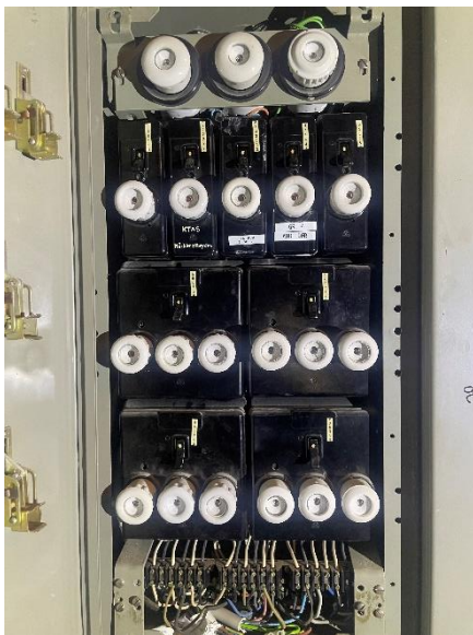
Hovedtavle med materiel fra bygningens opførelse
