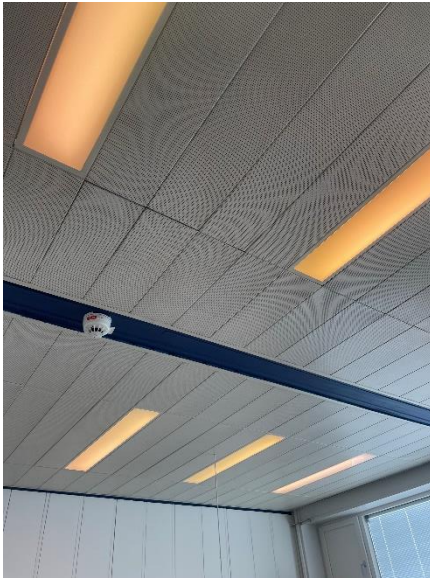
Eksempel på belysning i bygningen som ikke er udskiftet til LED
