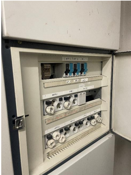
Fordelings avle i kælderen årgang 1970-80
