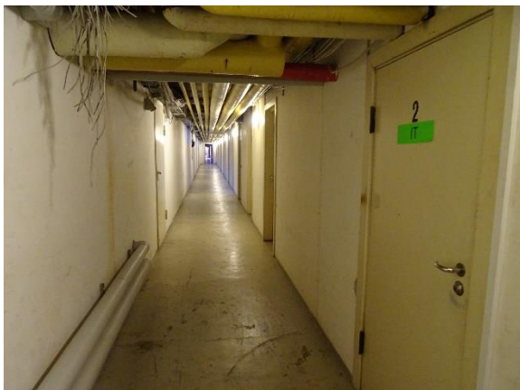
Vestlig ende af kælder med overvejende installationer
