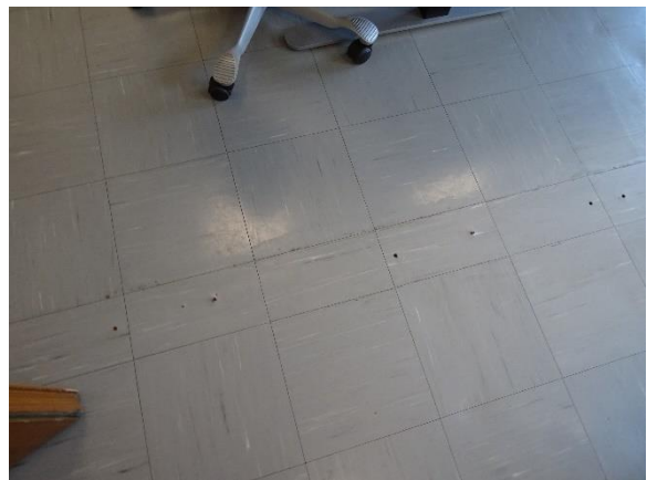
Vinylfliser med huller fra tidligere skillevæg
