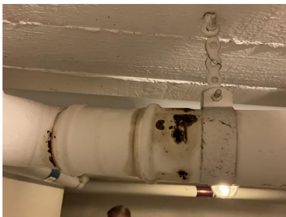
Tæring på støbejern
