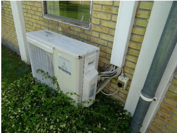
Ældre varmepumpe designet til R22 kølemiddel men påfyldt R407C
