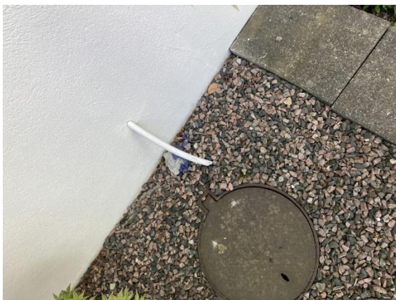
Kabel udfor køkken mangler afdækning for mekanisk beskyttelse
