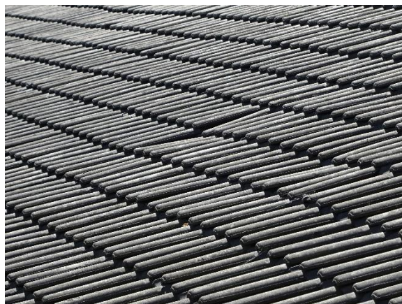
Sammensynkning evt. pga. nedbrudte lægter
