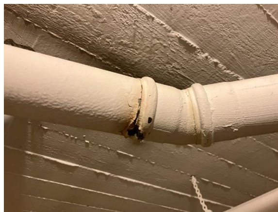
Tæring på støbejern
