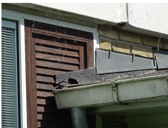
Fuge over løskant er helt væk og tagkant fra forbindelsesgang er ikke tilpasset vindue og trækrude. Tagpap går op over trækrude og løskant er fræset delvist ind i karmen
