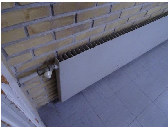
Radiator med ventil fra opførelsen
