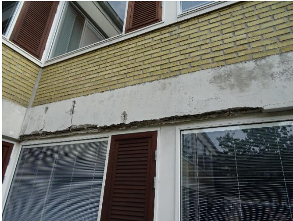
Eksempel på større betonskade i gård mod gang 8
