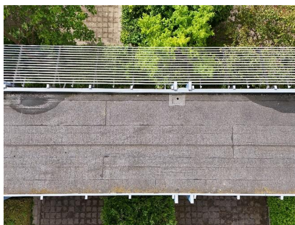
Tagpap over forbindelsesgang er tæt på nedslidt
