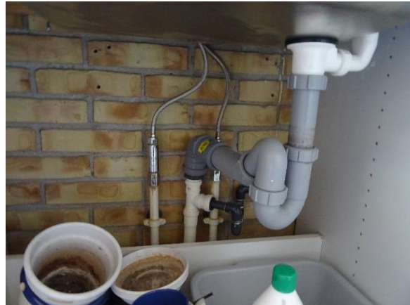
Ældre rør under køkkenvask
