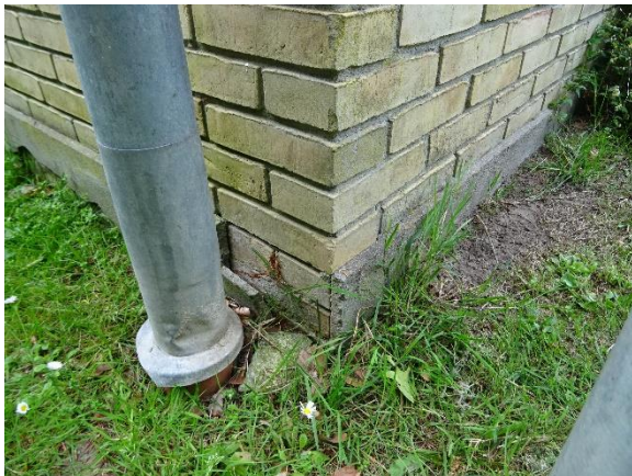
Sokkel i pudset murværk,, mursten er blotlagt
