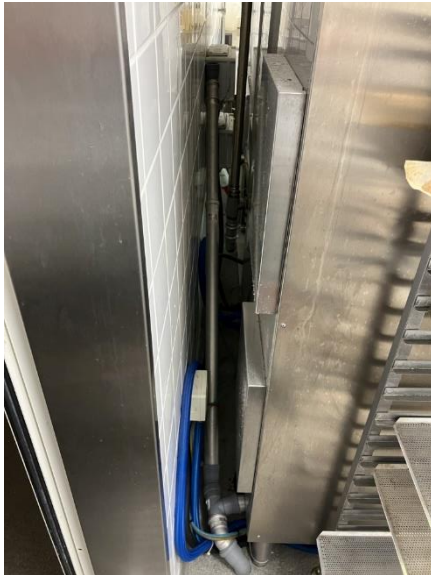
Kondensafløb ikke tilsluttet på bagside af dampovn
