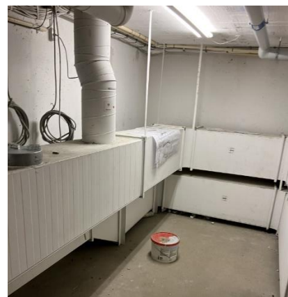
U-isolerede kanaler i uopvarmet kælder.
