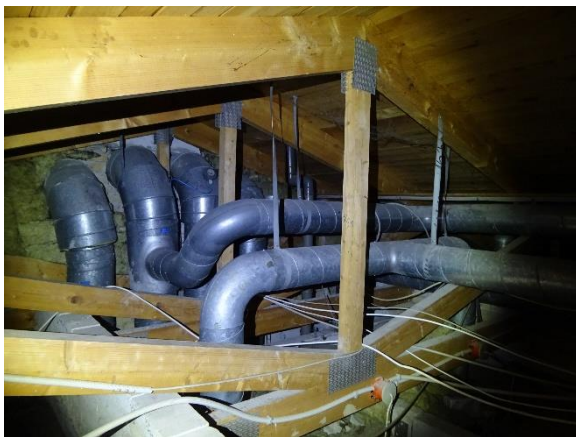
Kanaler på loft uden isolering
