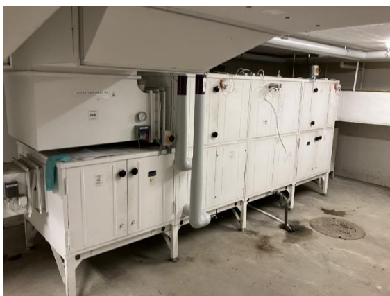
Ældre anlæg i kælder
