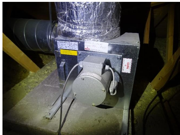
En af flere +20 år gamle ventilatorer på loft over 1. sal
