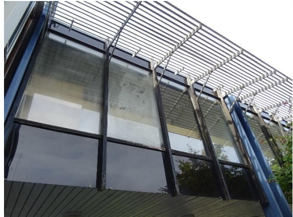
Termoruder i forbindelsesgang, flere er punkteret
