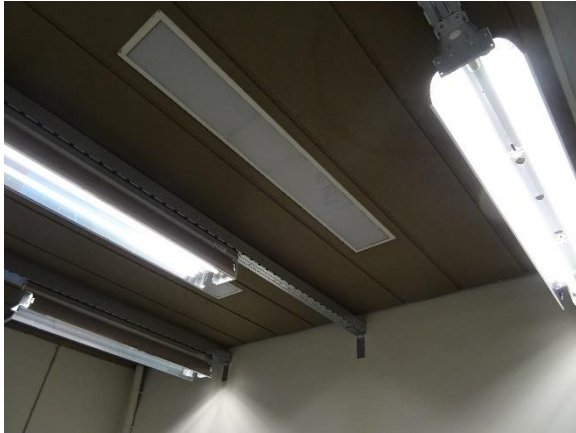
Armaturer i køkken/printerrum, ikke skiftet
