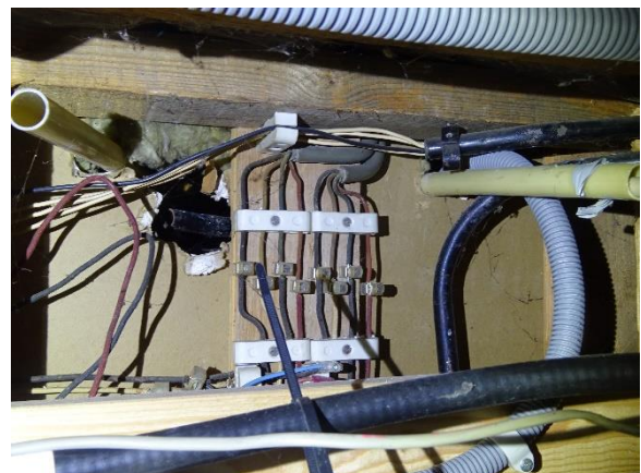
Åben samling af ledninger over nedsænket loft.
