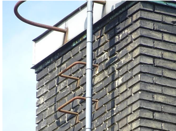
Begyndende skader på murværket
