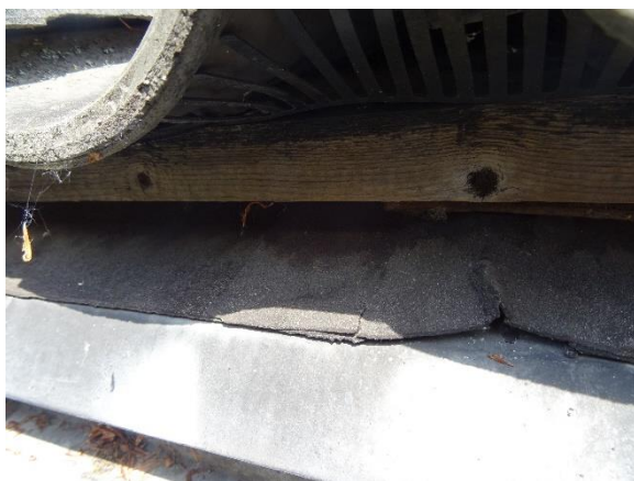
Undertag i tagpap på brædder er helt mørt og kan splittes med fingrene
