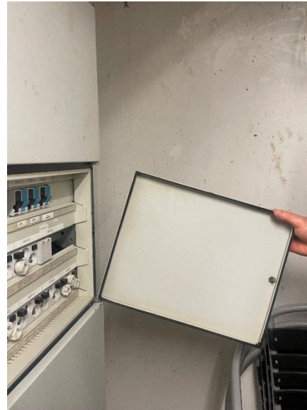
Fordelingstavle i kælderen skadet låge
