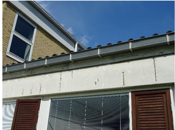
Eksempel på betonskade under udvikling. Armering har ligget meget tæt på overfladen.
