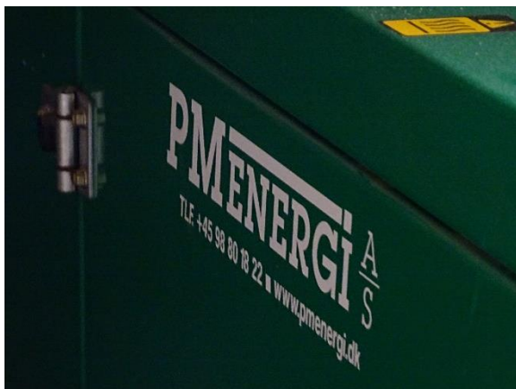
Fabrikat på nødstrømsgenerator. Rum aflukket.
