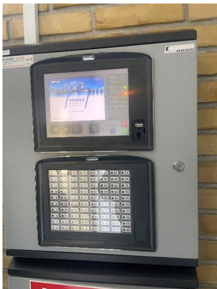
Hoved ABA central placeret i gang mod nord facaden
