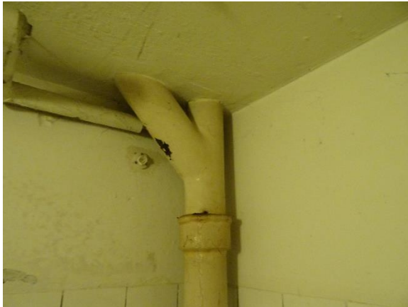
Ældre støbejernsfaldstamme i kælder
