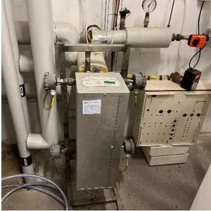
Varmeveksler i teknikrum
