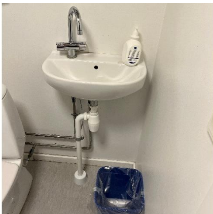
Brugsvandsrør under vask udført i rustfrit stål
