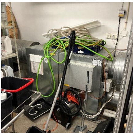
Ventilationsanlæg i kælder
