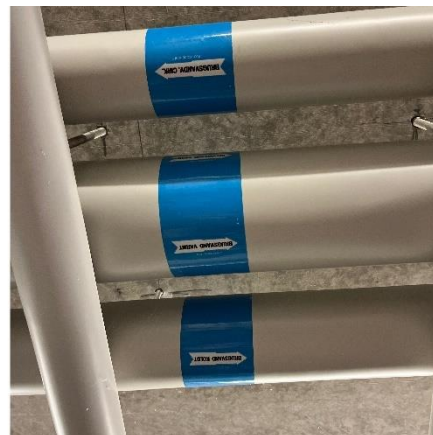
Rørisolering af brugsvandsinstallationer
