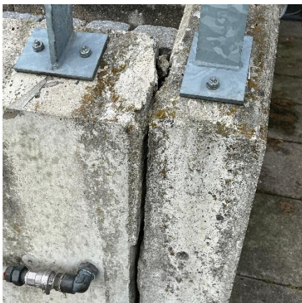
Revnet betonkonstruktion i samling mellem tribunefacade og endevæg ud mod fodboldbane
