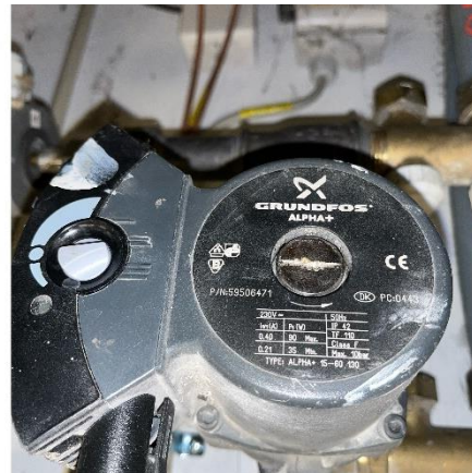
Fordelingspumpe til gulvvarme
