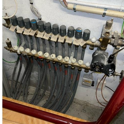
Fordelerrør til gulvvarme i kælder
