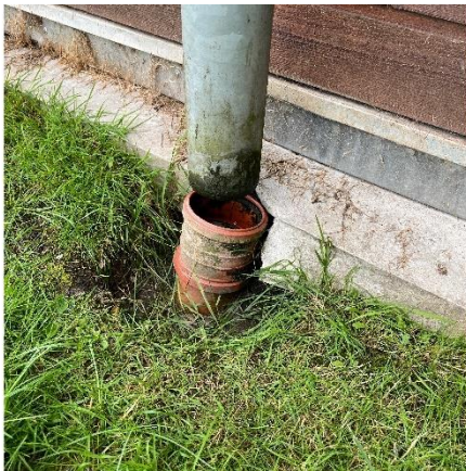
Nedløbsrør ikke tilsluttet korrekt
