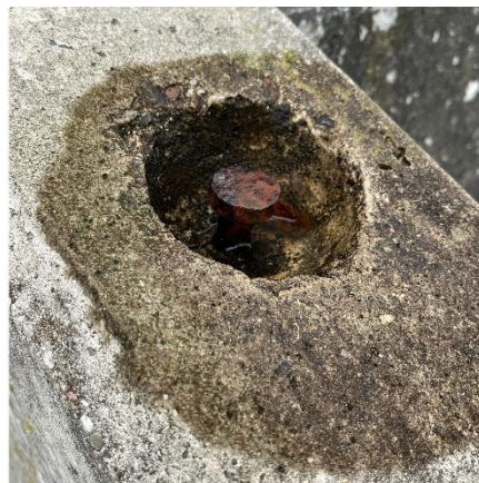
Manglende støbt metalbolt/armeringsjern i endevæg
