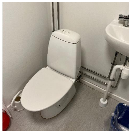
Toilet med to-skyl
