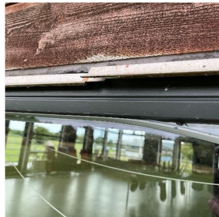
Tætningsliste og vandnæse sluppet
