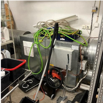
Ventilationsanlæg i kælder
