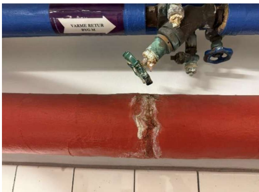
Defekt og utæt ventil
