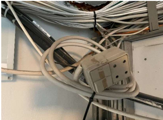
Der er store mangler på ordentlige føringsveje, og flere ulovlige installationer.
