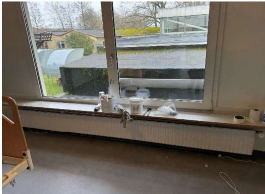
Radiator under vindue i bolig
