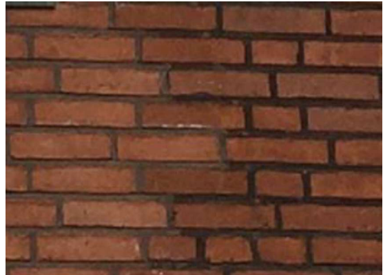
Fuger er forvitret
