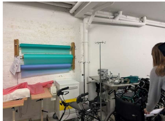
Afløb i støbejern og plast i kælder
