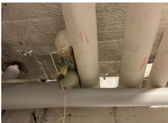
Tæring ved ventil.
