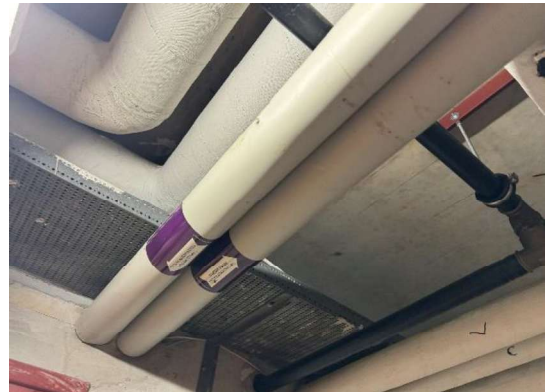
Rørføring i kælder med nyere isolering
