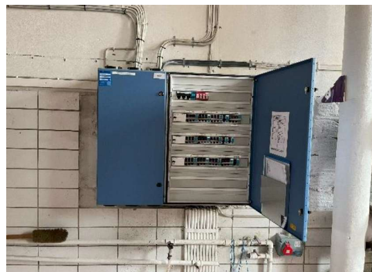
Ejendomstavle i varmecentralen, med tilpassede installationer.
