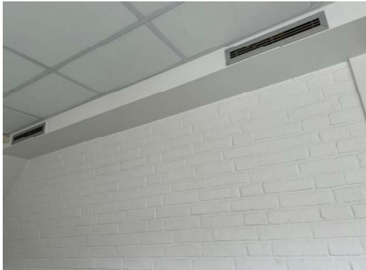
Ventilation i kontorrum.
