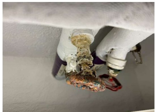
Defekt og utæt ventil
