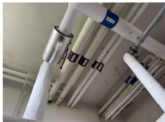
Rørføring i varmecentral med ældre isolering.
