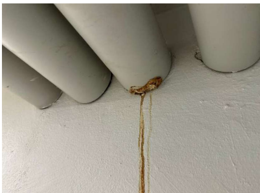
Tæring på vandrør
