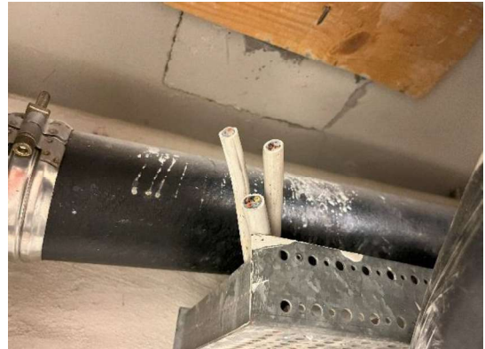
Død installation i kælderen, som skal fjernes.
