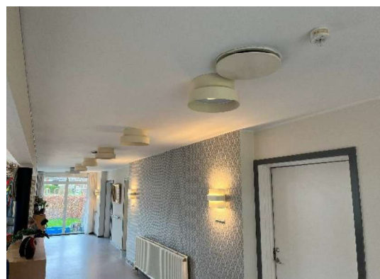
Generelt ser installationerne ud til at i rimelig stand, men der bør udføres forbedringer på lysinstallationerne.
