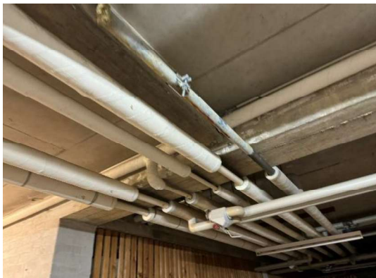
Ældre rørføring i kælder
