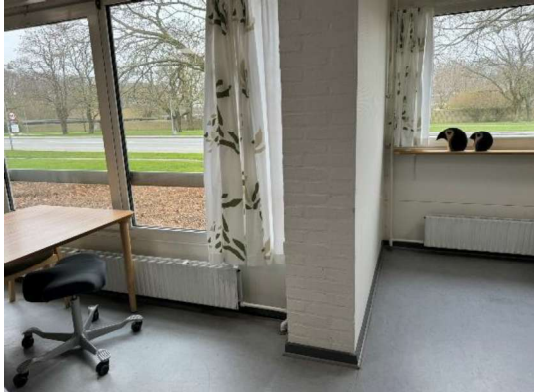
Radiatorer under vinduer
