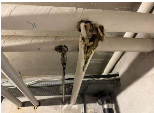
Tæring på galvaniserede rør og ved overgang til afgrening i rustfrie rør.
