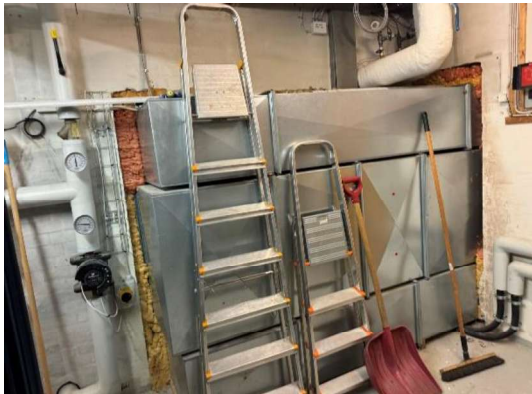
Ventilationsaggregat i kælder, utidssvarende.
