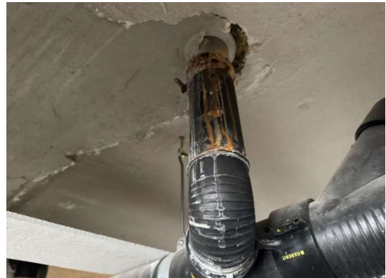
Afløb i plast med utæthed.
