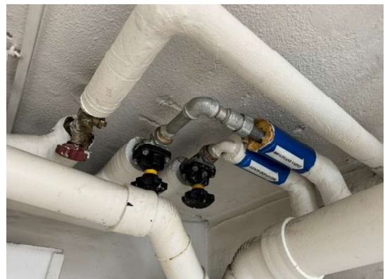
Rørføring i kælder
