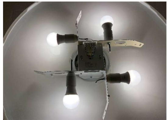
Belysningsarmatur fra 2010 med E27 fatninger.
