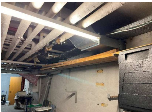
Belysningsarmaturer fra ca. 2010 med lysrør, som skal udskiftes.
