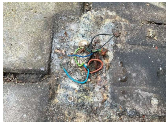
Installation ved indgangs port/låge skal fjernes straks . Det er uforsvarligt med sådan en installation hvor alle folk går ind til bygningerne.
