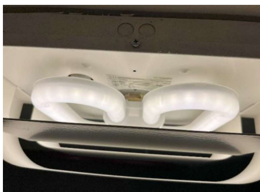
Ældre væglampe med 2D PL-rør, som skal udskiftes.
