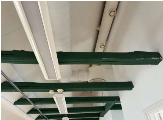
Ventilation i kontorrum.
