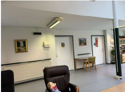
Radiator i opholdsrum.
