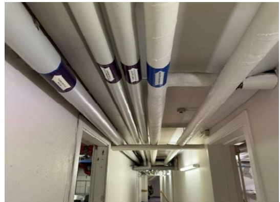
Rørføring i kælder med nyere isolering
