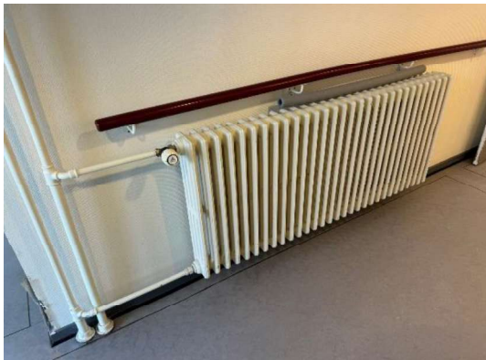
Original støbejerns radiator
