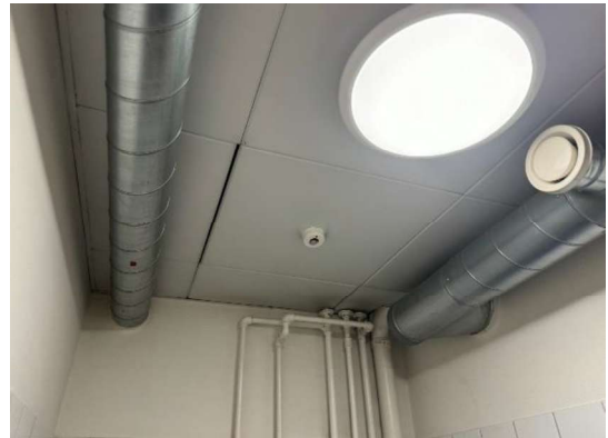
Mekanisk udsugning i rengøringsrum
