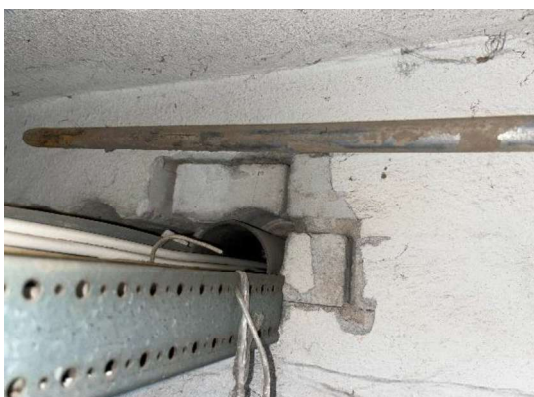
Manglende brandlukning, set flere steder.
