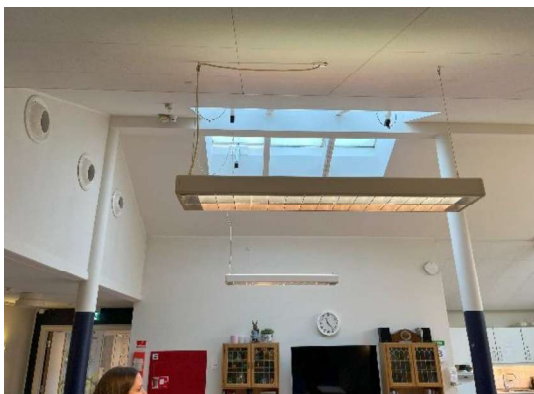
Eksisterende belysningsarmaturer med ældre lyskilder.
