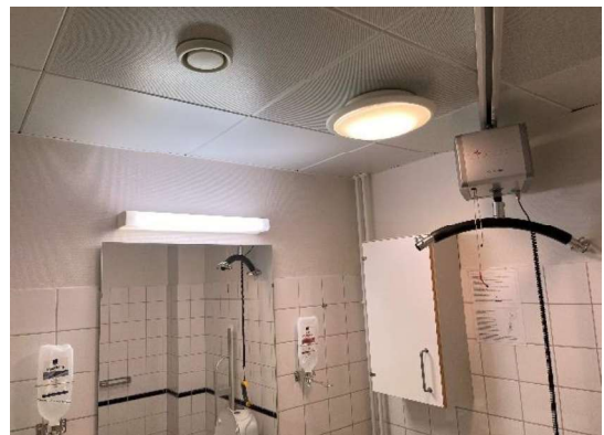
Elinstallationer og belysningsarmaturer fra en af de seneste renoveringer. Alle belysningsarmaturer med PL-rør og lysrør skal udskiftes.
