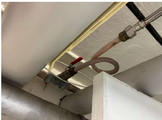
Ionfælde ved overgang til rustfrie rør.
