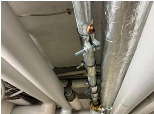
Adskillige reparationsklemmer på rørstrækning.
