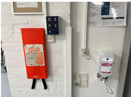
Nyere installationer fra den seneste renovering.
