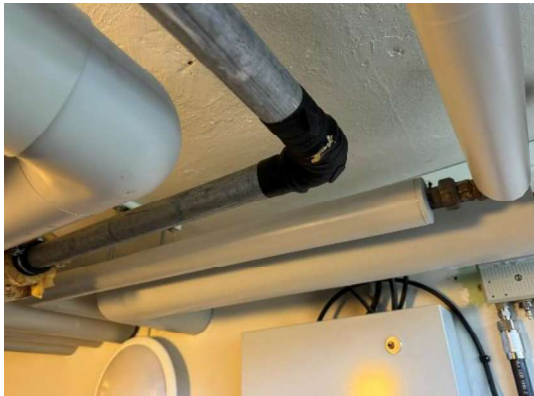
Blotlagt rørstykke i kælder i galvaniseret rør.
