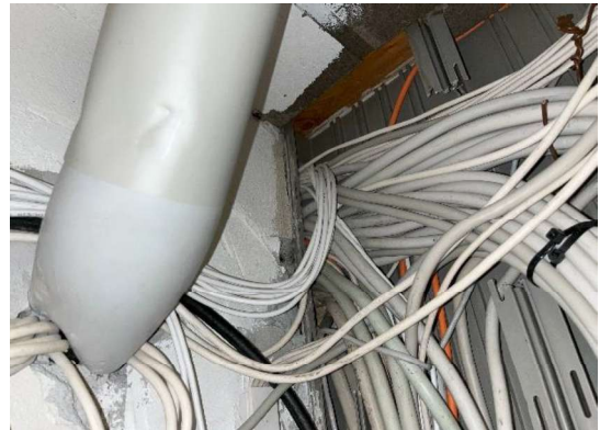
Der er store mangler på ordentlige føringsveje, og flere ulovlige installationer.
