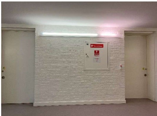
Belysningsarmaturer fra 2010 med lysrør, som skal udskiftes.
