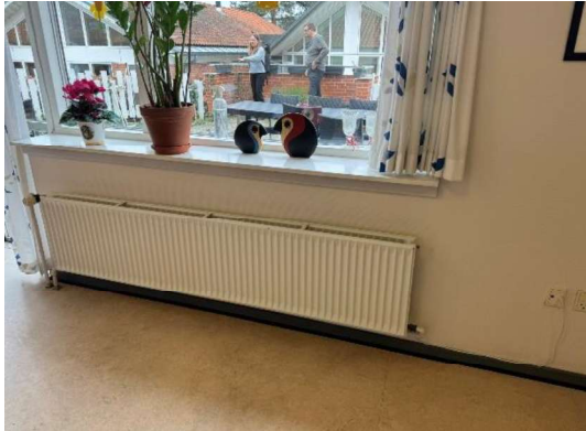
Radiatorer placeret langs yderfacaden under vinduer
