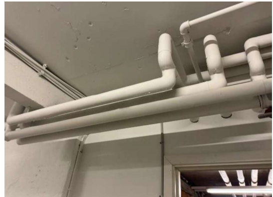
Rørføring i kælder
