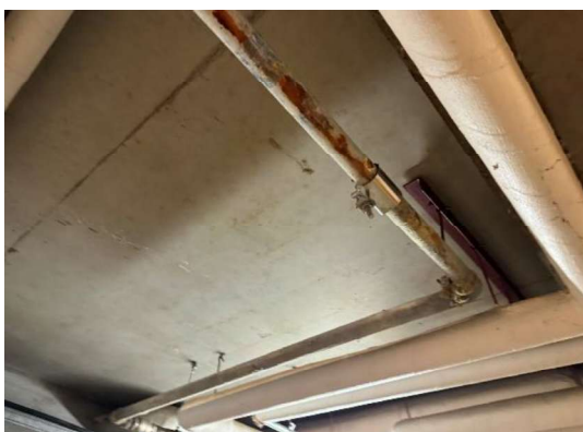
Reparationsklemme på vandrør i kælder
