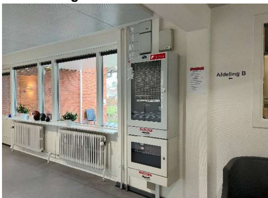
Gammelt ABA-anlæg, som bør udskiftes.
