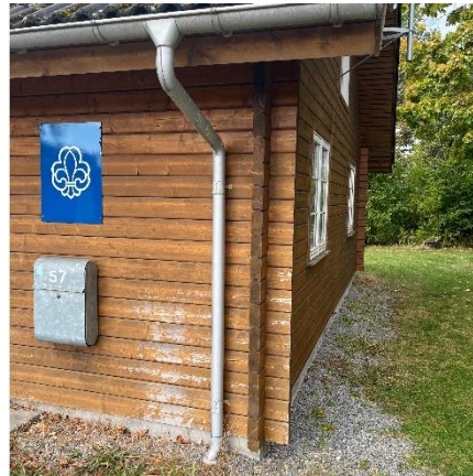
Manglende vedligehold af facade
