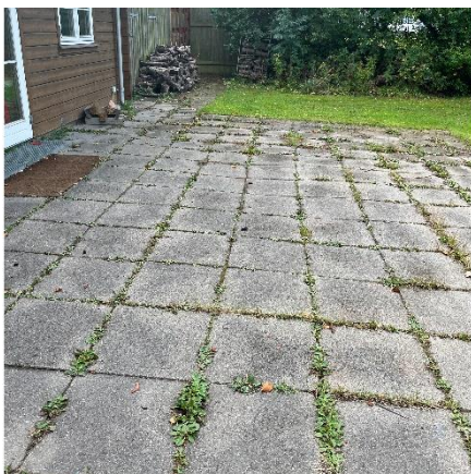
Ujævne og sunket flisebelægning på terrasse
