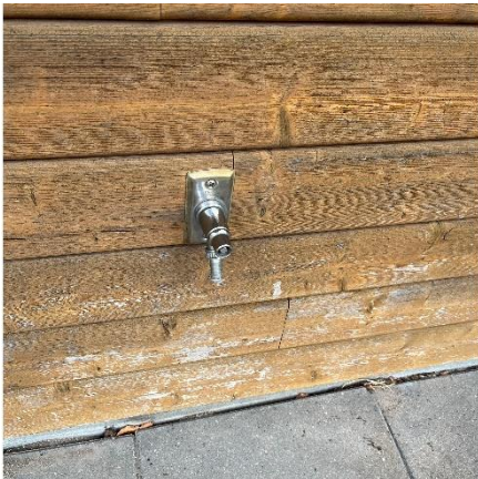
Oliebehandlet træfacade ikke vedligeholdt
