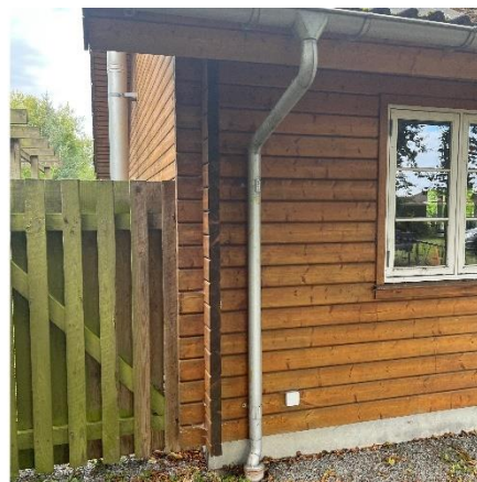
Tagrender og nedløbsrør med aluzink
