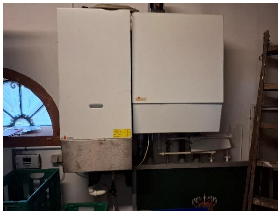
Varmtvandsbeholder og fjernvarmeunit bygning 3
