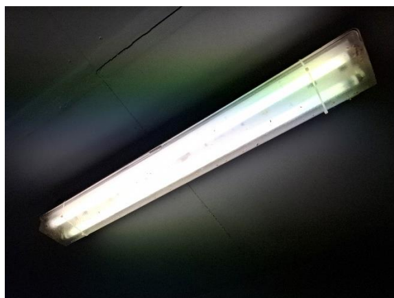
HF-armatur i depot, bygning 2
