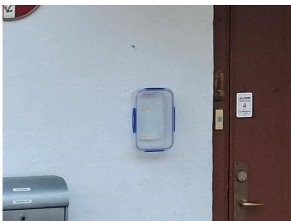
Alarmpanel fra Ajax i bygning 2
