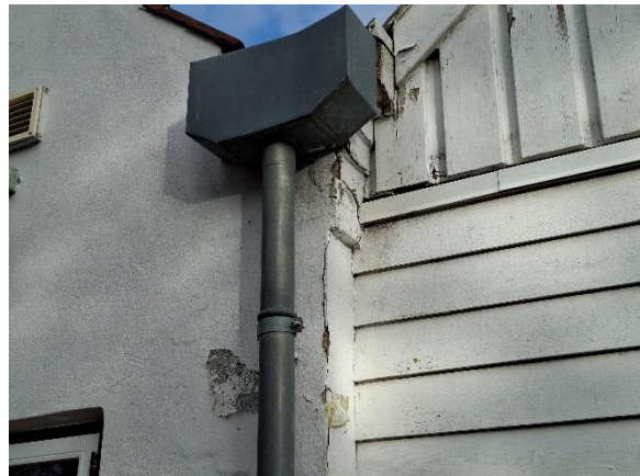
Skotrende ved mellembbygning er med utæthed og følgeskader.
