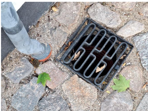
Nyere rist til sandfangsbrønd.
