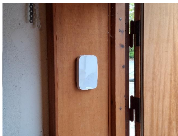
Alarmpanel fra Ajax i bygning 3
