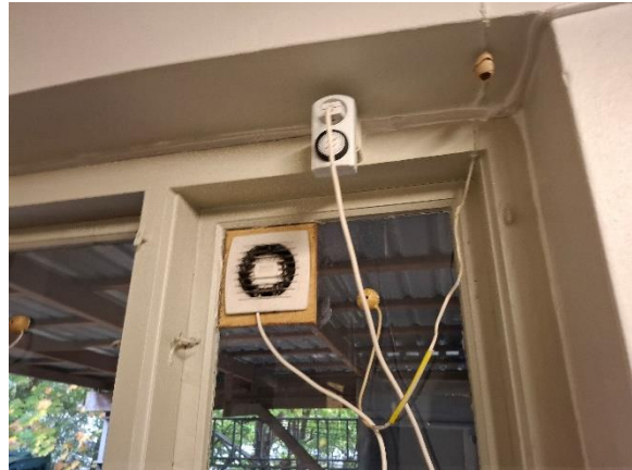
Ventilator i køkken bygning 2
