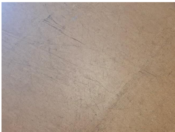
Linoleumsgulve i bygning 3 er slidt.
