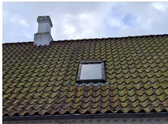
Enkelte tegl er knækket.
