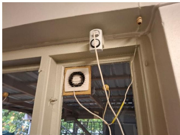
Ventilator i køkken bygning 2
