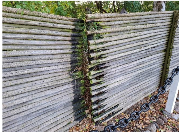
Raftehegn er faldet sammen og med brandskade ved parkeringspladsen mod øst.
