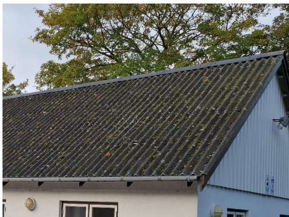
Eternittag med mos og algebegroninger på bygning 3.
