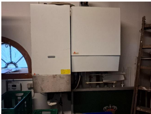
Varmtvandsbeholder og fjernvarmeunit bygning 3
