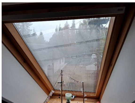
Ovenlysvindue med punkteret rude
