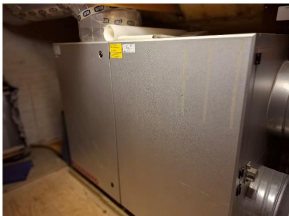
Ventilationsanlæg i bygning 2
