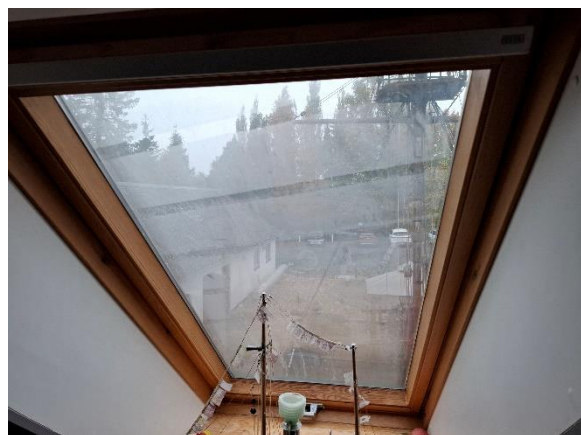
Ovenlysvindue med punkteret rude
