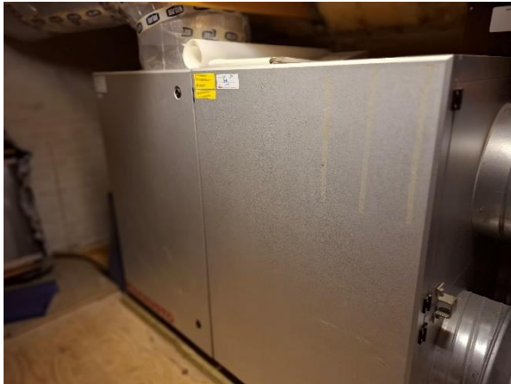
Ventilationsanlæg i bygning 2
