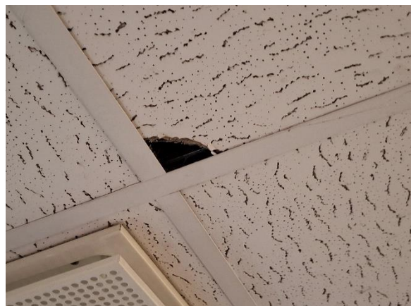
Systemloft. Enkelte plader er med skader.
