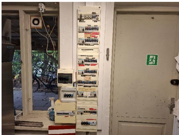
Tavle i køkken, bygning 2
