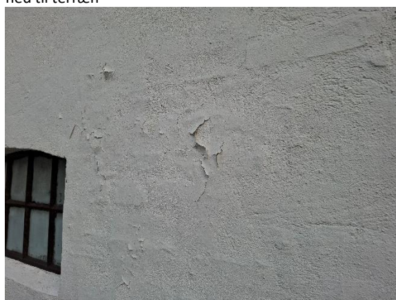
Afskallende maling på facade på bygning 3
