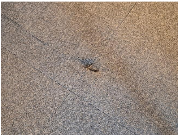
Tæppefliser med skade
