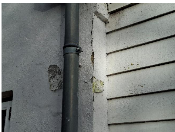
Skadet puds ved fugtskade mod syd
