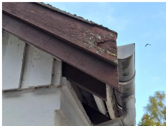
Begyndende råd i vindskede på bygning 3
