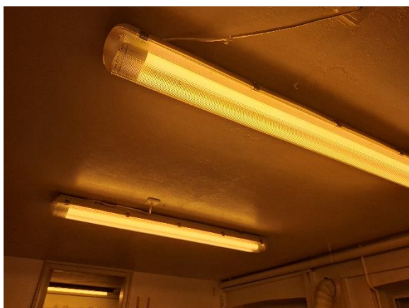
HF-armaturer i køkken, bygning 2
