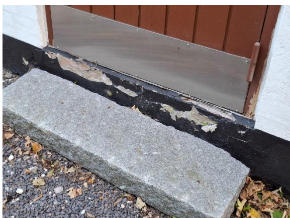
Afslag på sokkel under dør på bygning 3
