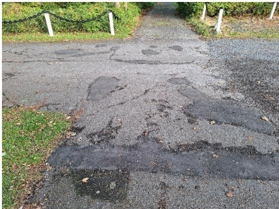
Belægning ved indkørsel med revnedannelser og lapning efter huller
