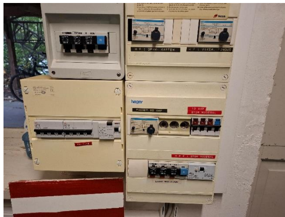
Der mangler skruesikringer i gammel gruppeafbryder.
