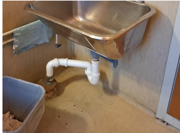
Afløbsinstallation i badeværelse i bygning 2
