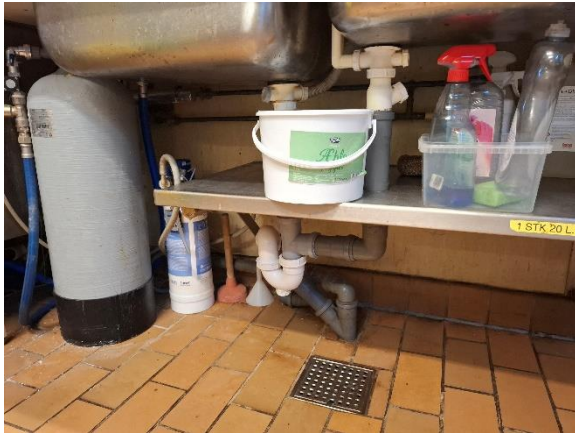
Afløbsinstallation i køkken bygning 2
