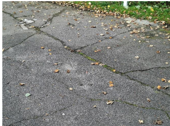
Asfaltbelægning mod vest med revnedannelser.
