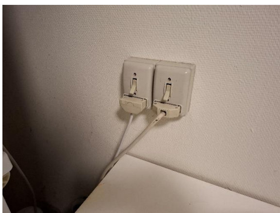
Ældre installation i vaskerum
