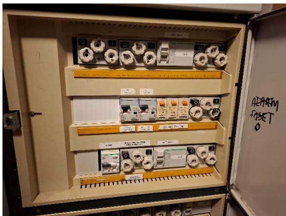
Tavle i teknikrum, afdækning mangelfuld
