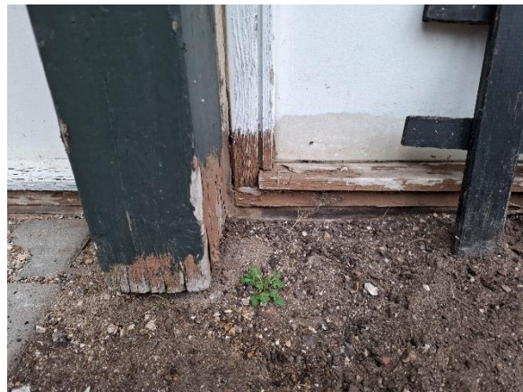
Let facade hvor der vurderes at have været et bed eller anden belægning.
