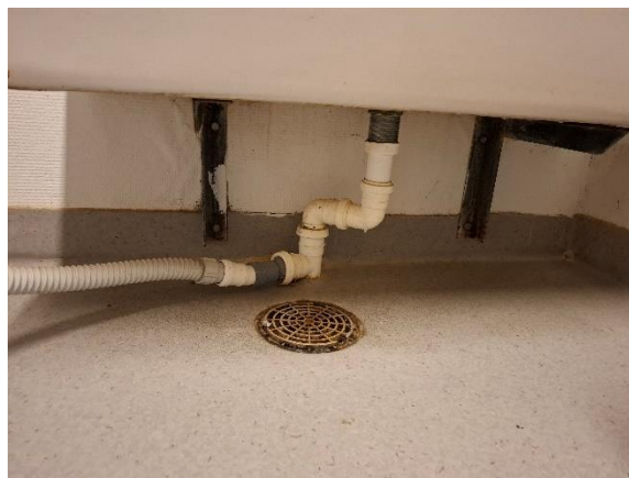
Afløbsinstallation på håndvask i børnetoilet.
