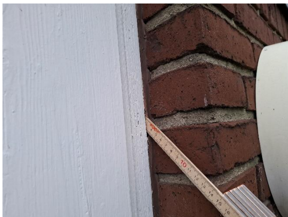
Fugeslip på oprindelig dør
