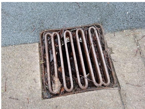
Brønde mangler generelt oprensning
