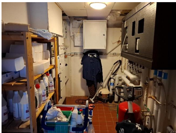
Teknikrum med CTS og pumpestyring
