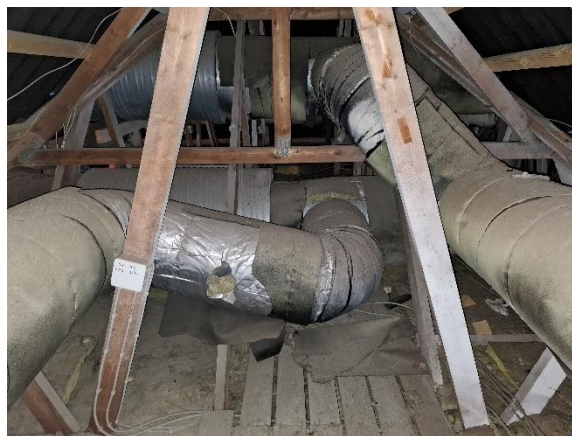
Kanaler i loftrum
