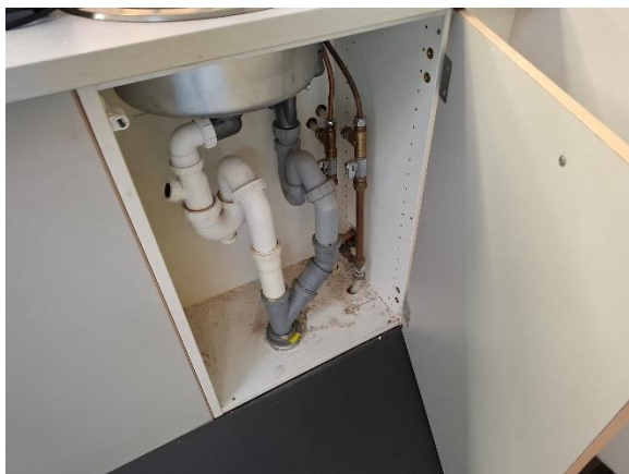
Afløbsinstallation i produktionskøkken
