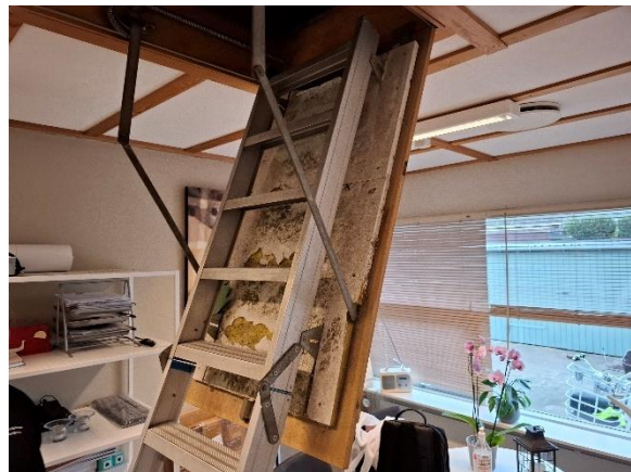
Adgangslem til loftrum i kontor
