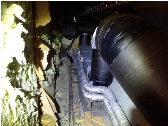
Uisolerede rør i skunk og nedtrådt isolering
