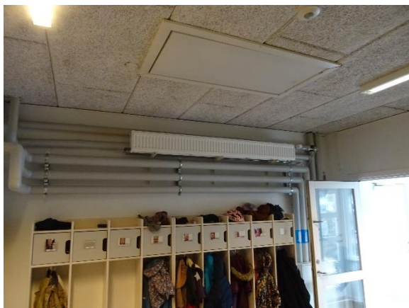
Rør fra rørkanal til rørkasse under loft, nordlig bygning
