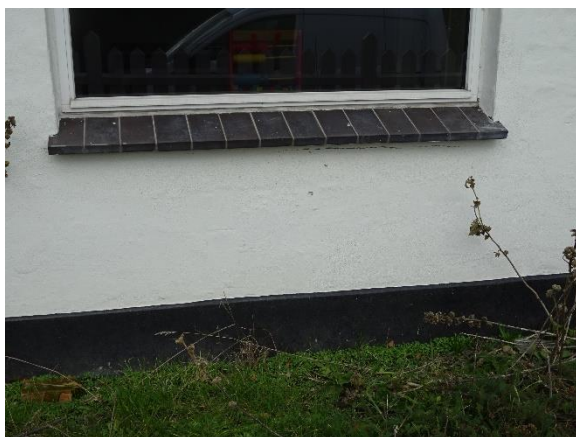
Brystning med fine revner i puds og maling
