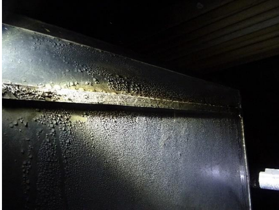
Anlæg er ikke i drift så undersiden er fyldt med kondens
