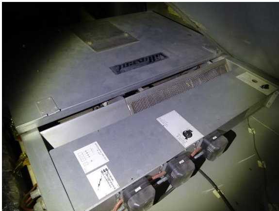
Ventilationsaggregat på loft
