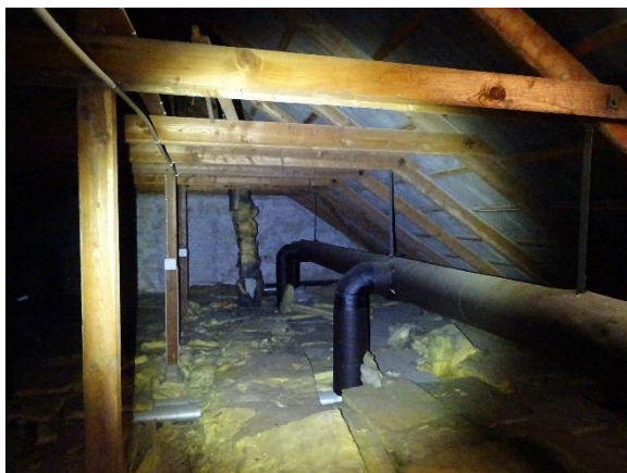
Ventilationskanaler på loft isoleret med 30-40 mm lamel-måtte
