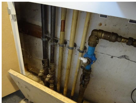
Rør fra rørkanal under gulv til rørkasse under loft, sydlig bygning. Uisolerede rør, skal konstateres hvor store yderligere stræk der er uisoleret.
