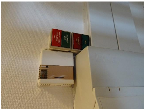
Ikke fungerende ventilationsstyring
