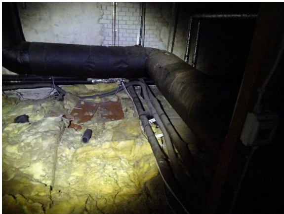
Varmerør på loft, sydfløj
