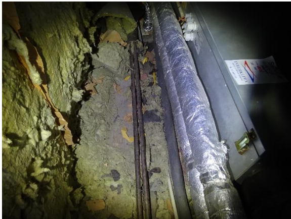
Uisolerede varmerør i skunk på nedtrådt isolering
