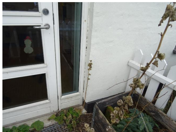
Nedslidt fuge, sideparti ved dør
