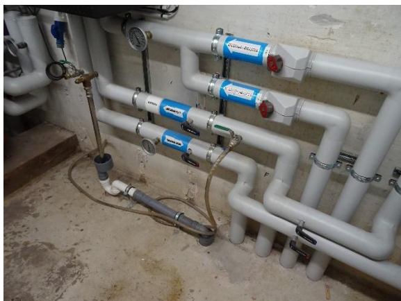
Varmt vand og cirkulation i varmecentral
