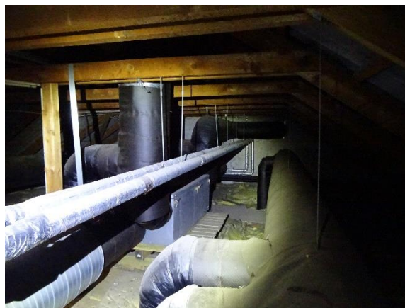
Varmerør på loft til ventilationsvarmeffekte
