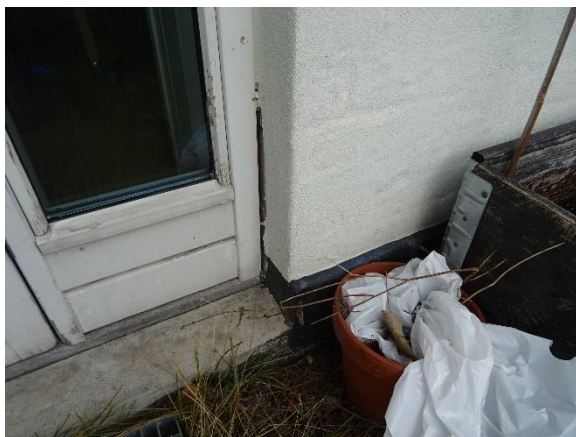
Helt nedslidt fuge omkring dør
