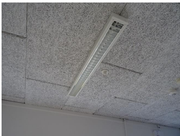
Armatur med lysstofrør, 28 W
