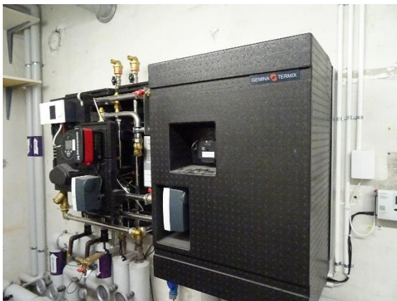
Fjernvarmeunit med indbygget Danfoss ECL styring med fjernadgang
