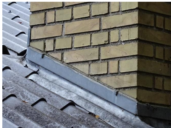
Mindre fugeskader på skorsten og fuge over løskant slipper i kanten
