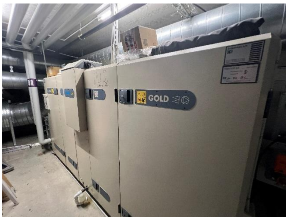
Swegon Gold anlæg i bygning fra 2010
