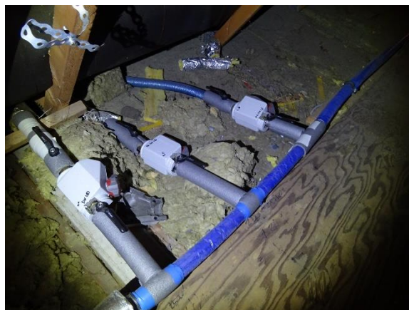
Varmerør i loftrum
