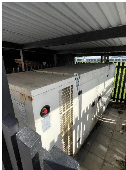
Nødstrømsgenerator foran nr. 32 til nr. 30-32
