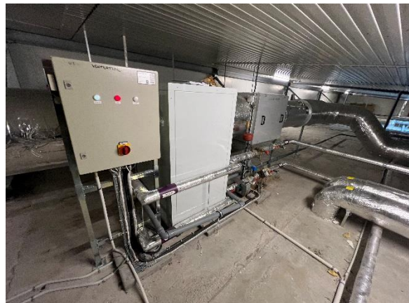
Udsugningsanlæg på loft nr. 32
