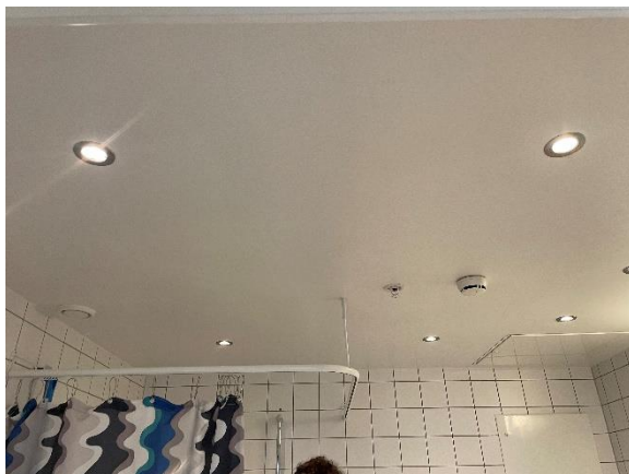
Toilet belysning i lejlighed byg. 32
