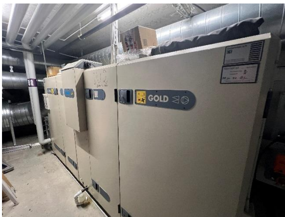
Swegon anlæg i bygning fra 2010
