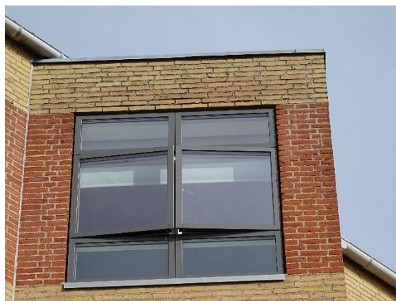
Fuger over vindue er udvaskede og elastisk fuge er hærdet
