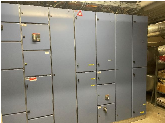
Hovedfordelingstavle i kælderen under nr. 32
