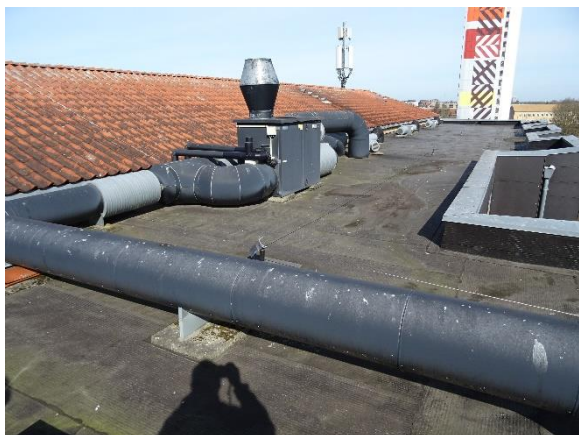
Anlæg og kanaler på tag af bygning fra 2006
