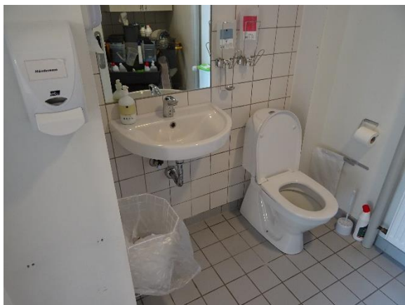
Toilet i nr. 32
