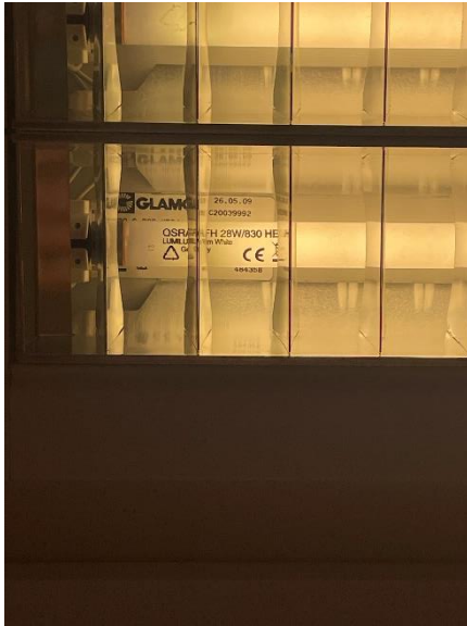
Lysstofrørs armaturer med udfaset lyskilde
