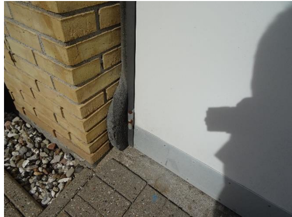
Ekspanderende fugebånd arbejder og skal eftergås
