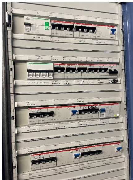
Billede af grupper i hovedfordelingstavle. Opmærkning er ikke entydigt
