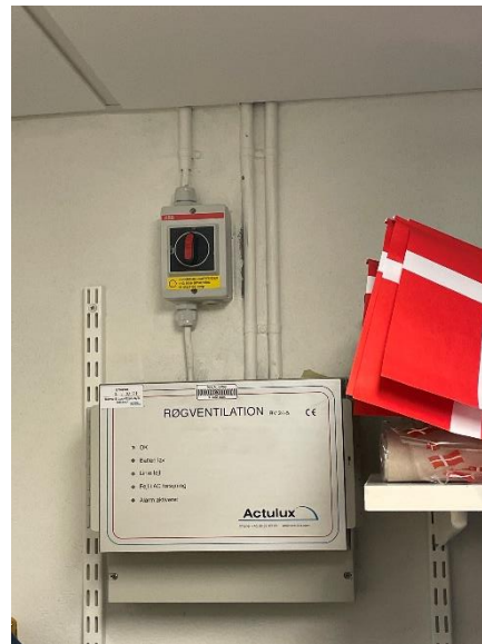
Røgventilation teknikkab i kælderen
