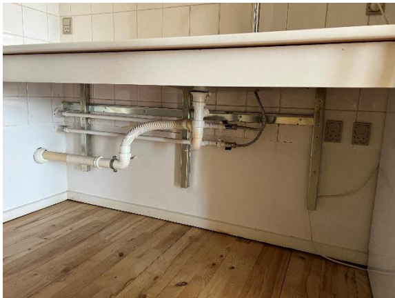
Lejligheds køkken afløbsinstallationer nr. 30. Går til lukket skakt
