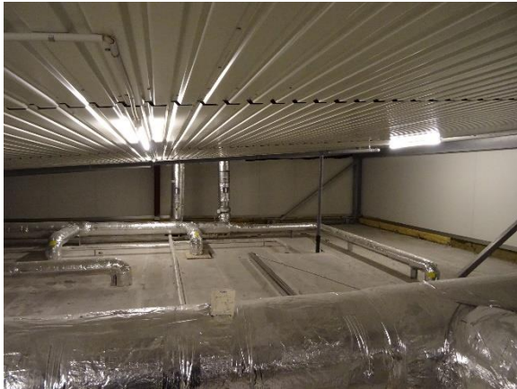
Ventilationskanaler i tagrum
