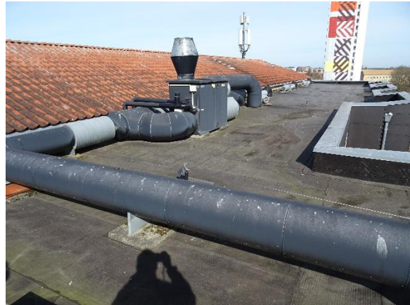
Ventilationsanlæg på tag
