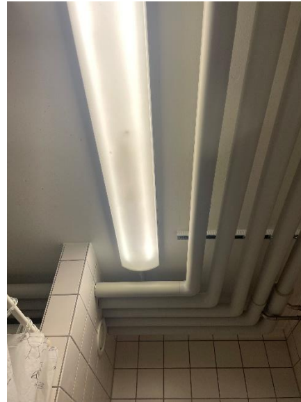
Spolerørsarmatur i omklædning i kælder
