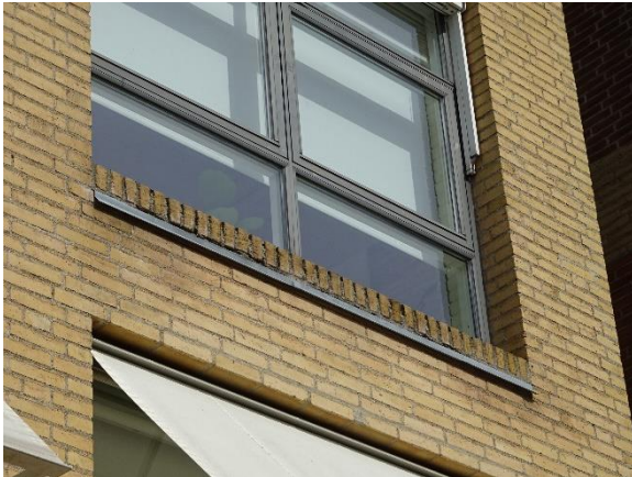
Rulleskifte sålbænk i kantstillede mursten med slidte fuger
