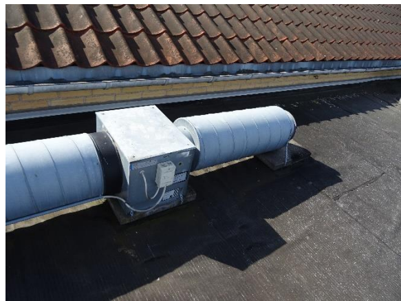
Udsugningsanlæg på tag
