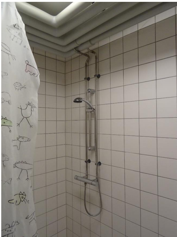
Bruser i nr. 32 kælder, forsyning med rustfrie rør
