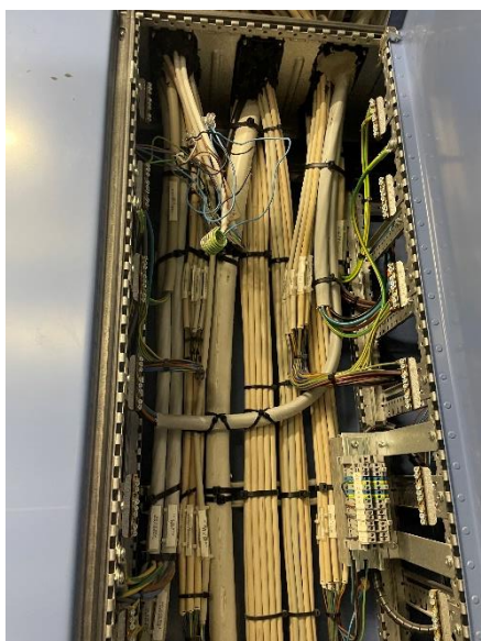
Løse ledninger kabelfelt i hovedfordelingstavle
