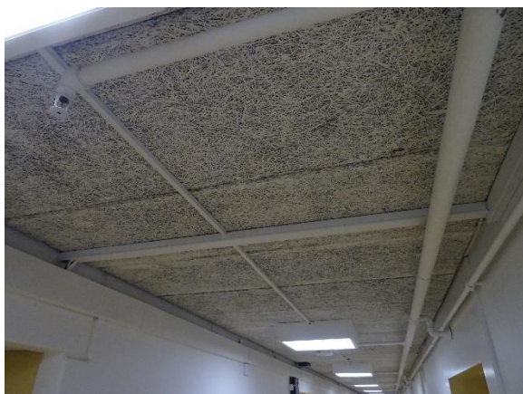
Gang i nr. 30 med synlige sprinklerrør under loft. Afgrenninger til værelser gennem væg.
