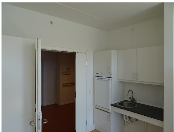
Vægsprinkler over dør på værelse i nr. 32
