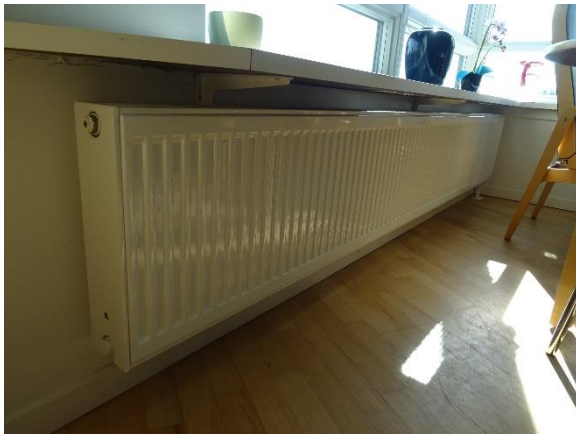
Radiator i bygning fra 2010
