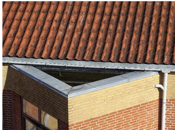
Derbigum tagdug på karnap. Står vandfyldt pga. stoppet afløb
