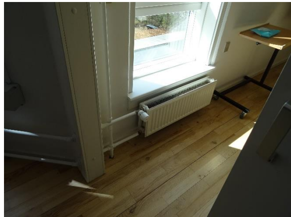
Varmeanlæg i bygning fra 1988
