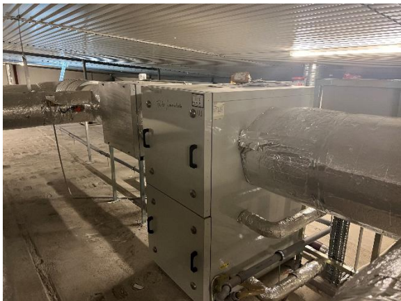
Udsugningsanlæg på loft nr. 32
