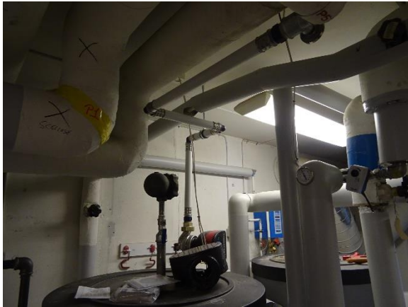
Uisolerede alupex rør og pumpe i varmecentral
