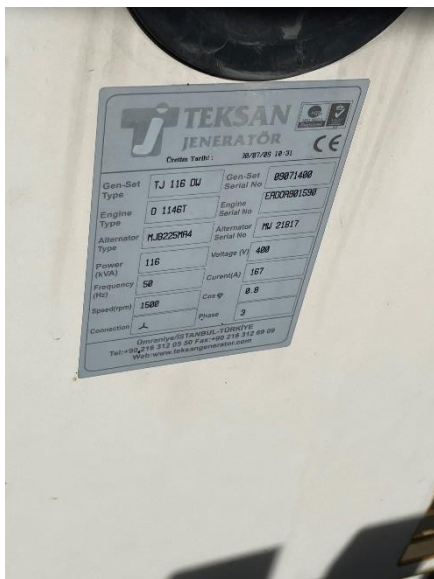
Nødstrømsgenerator foran nr. 32 til nr. 30-32
