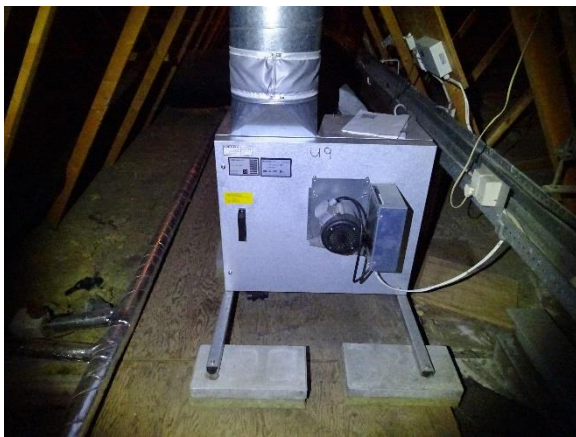
Boksventilator i tagrum fra 2016
