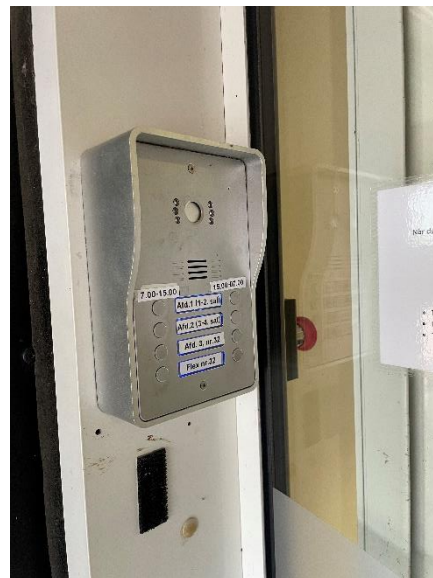
Telefonanlæg til afdelinger i de to bygninger
