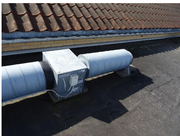
Udsugningsanlæg på tag, skønnet fra 2006
