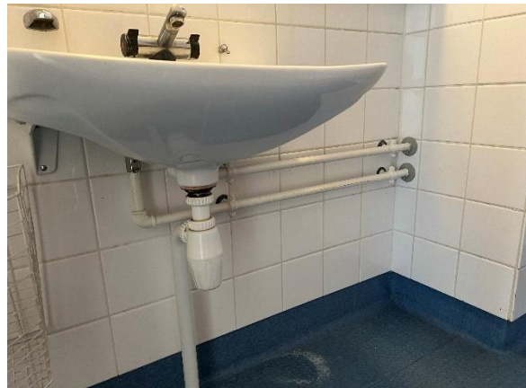
Lejligheds håndvask på toilet, installationer nr. 30
