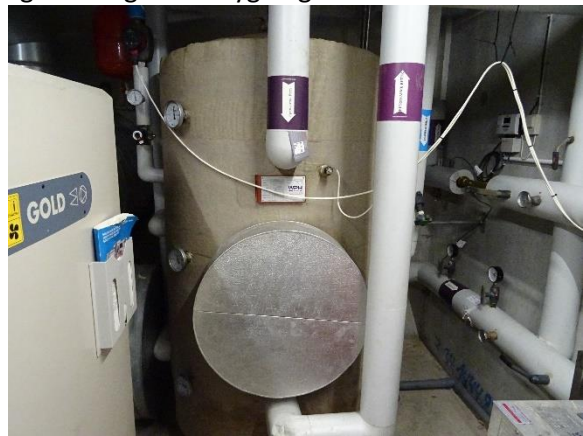
Varmtvandsbeholder 2008 i nr. 32
