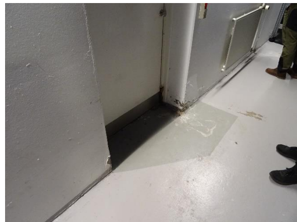
Fugtproblem ved oprindelig kælderyrddør der nu er inde-liggende
