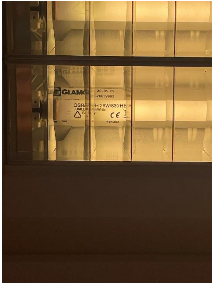
Der er spolerør og ældre belysning i dele af nr. 30 samt i kælderen under nr. 30-32
