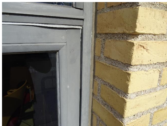
Maling, tætningslister m.m. er tæt på nedslidt, men ved vedligehold straks kan levetiden forlænges
