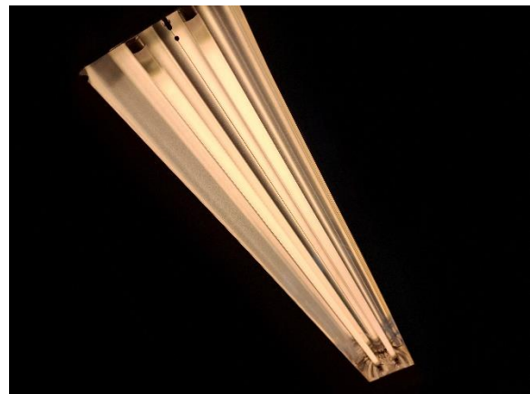
Belysning i bygning 1
