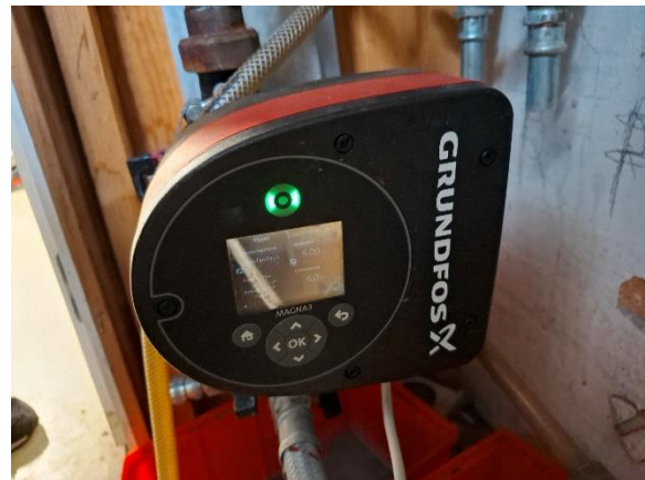
Varmefordelingspumpe til bygning 1
