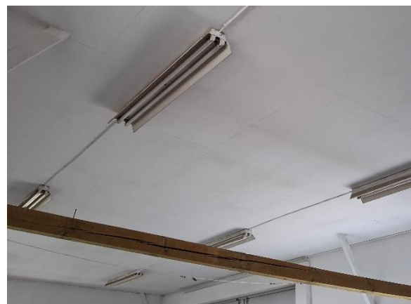
Belysning i bygning 2
