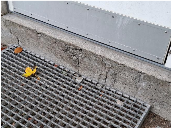
Bygning 3 – sokkel er krakeleret under dør.
