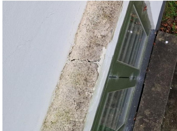
Bygning 1 – Gesimser er revnet flere steder.
