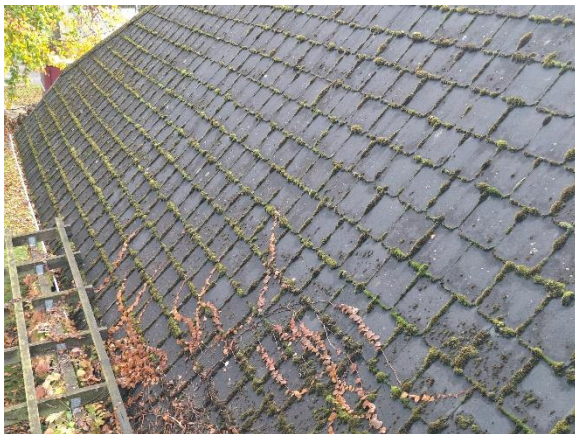
Tagbelægning med mosbegroninger på bygning 1 mod nord.
