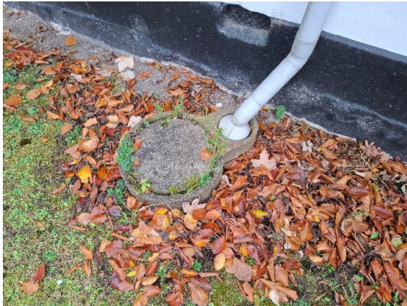
Sandfangsbrønd ved nedløb.
