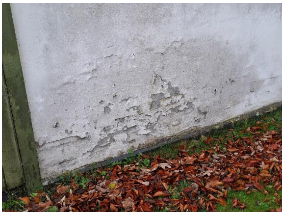
Bygning 2 – Facade mod nord er opfugtet og med afskallende puds og maling i hjørne mod tilbygning.
