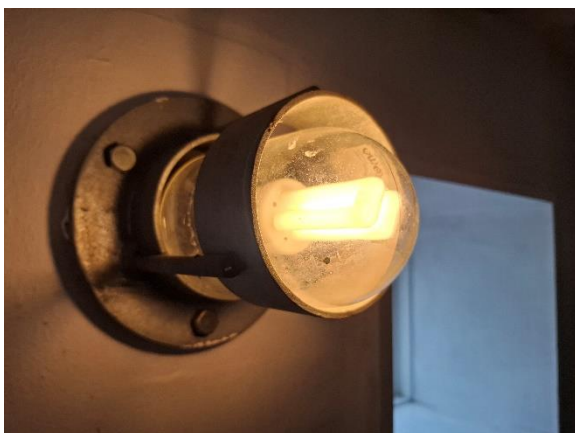
Belysning i bygning 1
