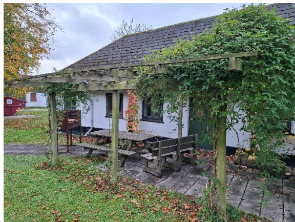
Flisebelægning på terrasse og espalier med algebegroninger.
