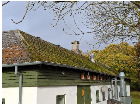
Tagbelægning med mosbegroninger på bygning 1 mod øst.
