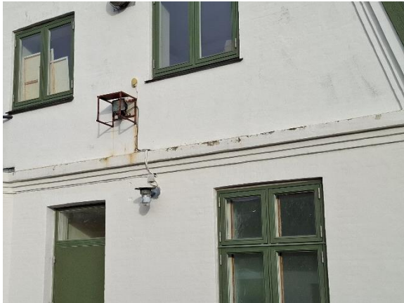
Bygning 1 – Maling er skallet af på alle gesimser.
