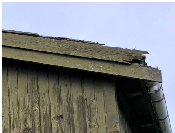
Vindskede på bygning 2 mod syd er rådnet.
