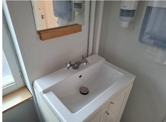
Håndvaskarmatur med 2 greb i hovedbygningen
