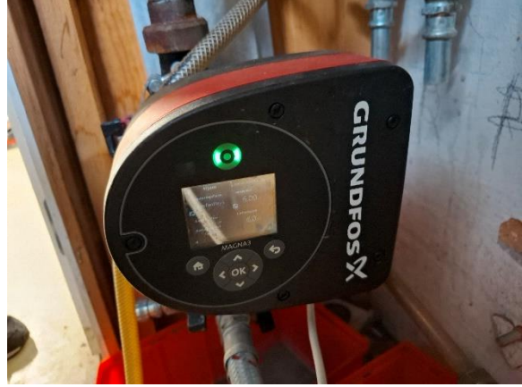
Varmefordelingspumpe til bygning 1
