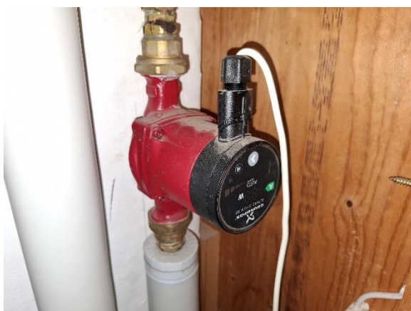
Cirkulationspumpen til varmt brugsvand den er fra 2011 vender på hovedet, hvilket pumpen ikke kan tåle.
