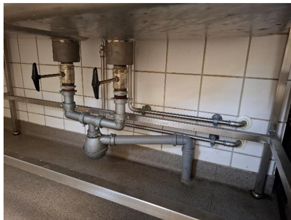
Afløbsinstallation i køkken
