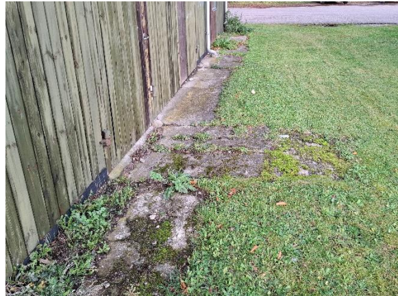
Begroninger i revner på støbt belægning øst for bygning 2.
