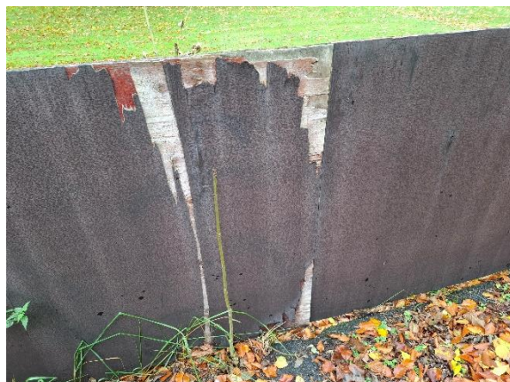
Bander til boldbane er med råd og delaminering i top og bund af støbepladerne
