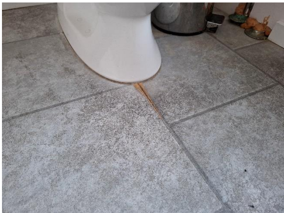
Bygning 1 – Vinylgulv er gået op ved toilet.
