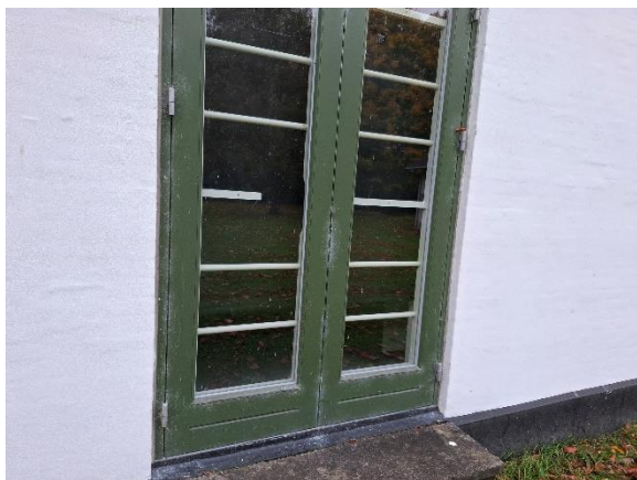
Bygning 1 – Terrassedør til undervisningslokale.
