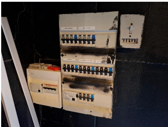
Tavle i bygning 3
