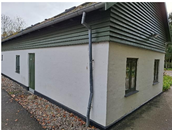
Skadet nedløb i gård på bygning 1
