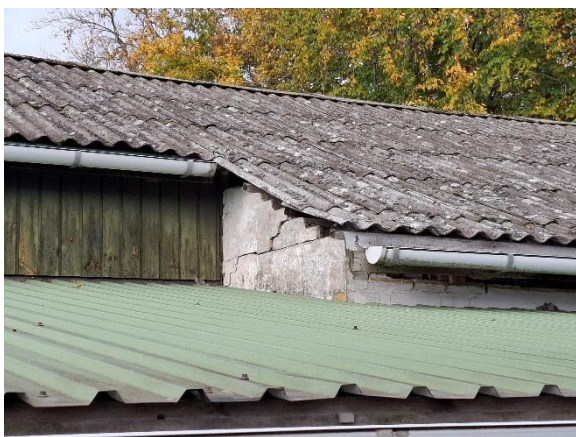
Manglende afslutning og vindskede på bygning 2.
