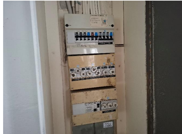
Tavle i bygning 2
