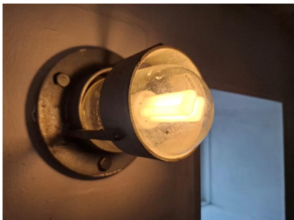
Belysning i bygning 1
