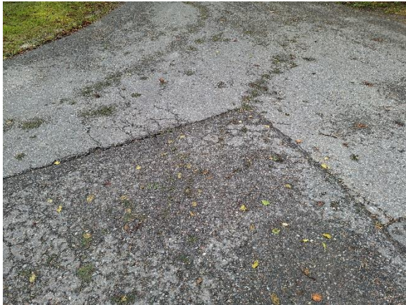
Begyndende revnedannelser og krakeleringer på asfaltbelægninger.
