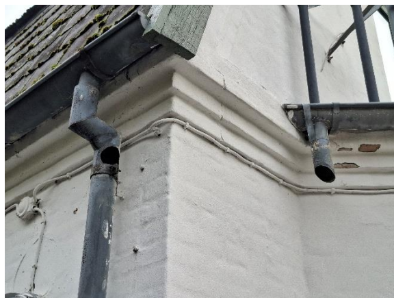
Manglende tilslutning fra balkonnedløb til tagnedløb.
