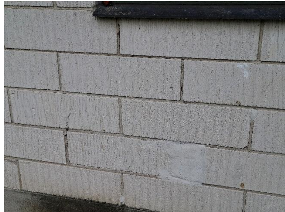
Bygning 3 – gasbetonblokke er med revner og der er udført flere reparationer.
