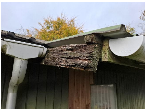
Vindskede på tilbygningen til bygning 2 er helt rådnet.
