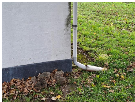
Kloakrør synligt over jord. Røret nedbrydes af direkte sollys.
