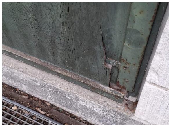
Bygning 3 – Skadet dørblad er udskiftningsklar.
