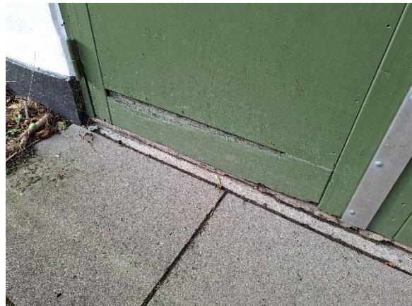
Bygning 1 – Yderdør til værksted er med råd nederst i rammen.
