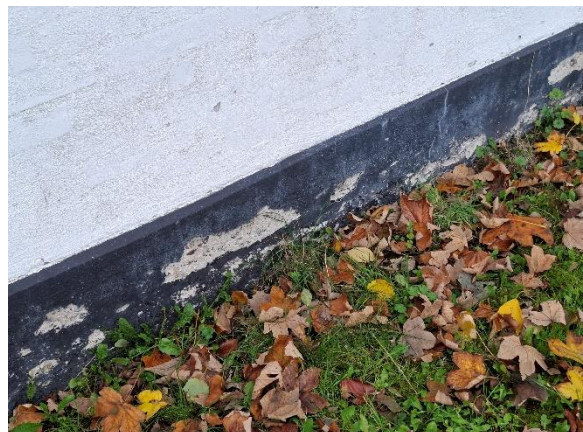
Bygning 2 – Sokkel er med afskallende puds
