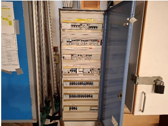
Tavle i bygning 1
