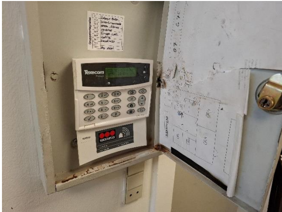
AIA-anlæg i bygning 1
