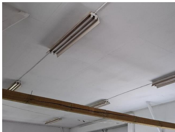
Belysning i bygning 2
