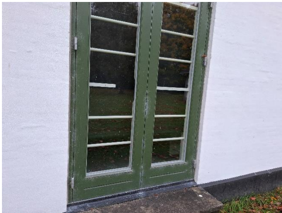
Bygning 1 – Terrassedør til undervisningslokale.
