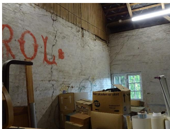
Sætningsrevne i lade
