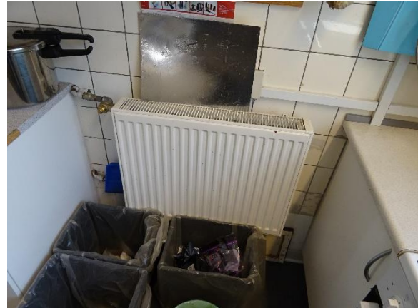
Radiator i køkken i flygtningebolig, termostat afmonteret
