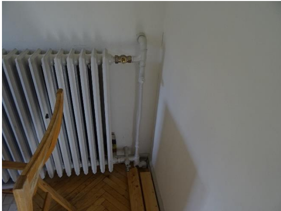
Søjleradiator i hovedhus, termostat afmonteret
