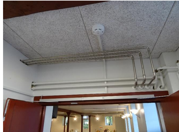
Vandforsyning til køkken selskabslokale, bemærk at varmtvandsrør er uisolerede
