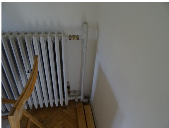
Enkelte radiatorer uden termostatventil
