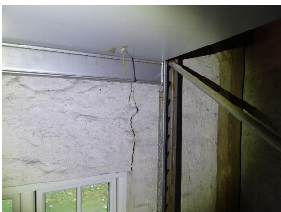
Sætningsrevne i lade
