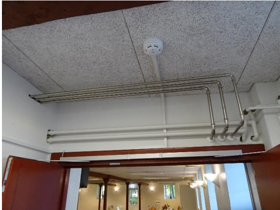
Varmtvandsrør til selskabslokale
