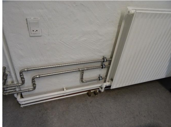
Varmtvandsrør hvor cirkulation ender i selskabslokalet
