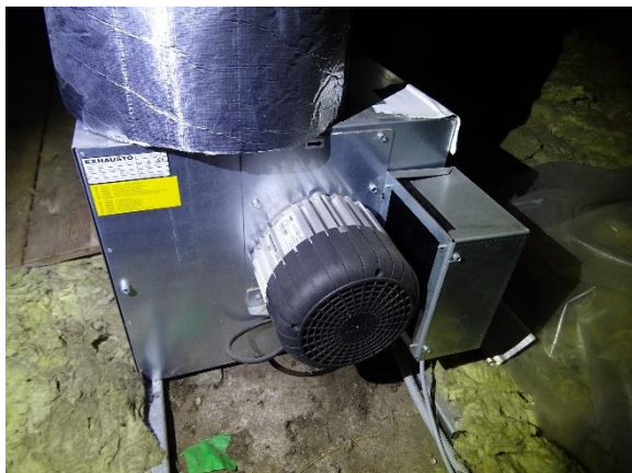
Boksventilator, udsugning fra selskabslokale
