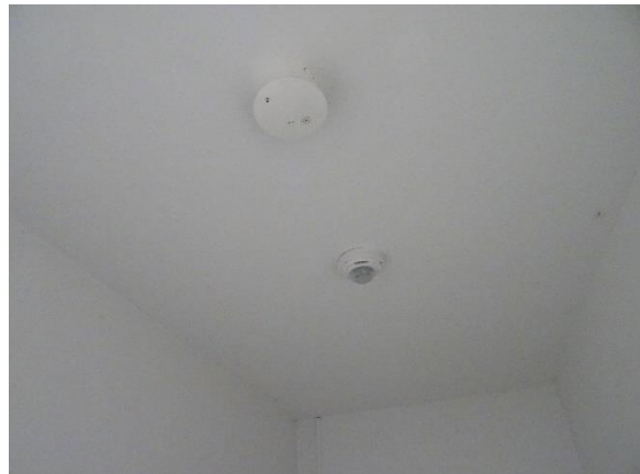
Røgalarm og bevægelsesmelder
