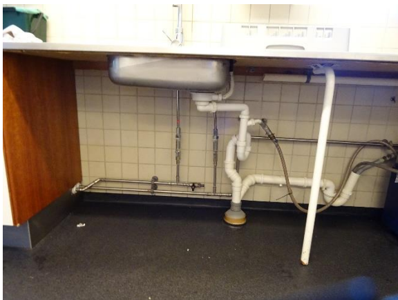
Afløb under køkkenvask ved selskabslokale
