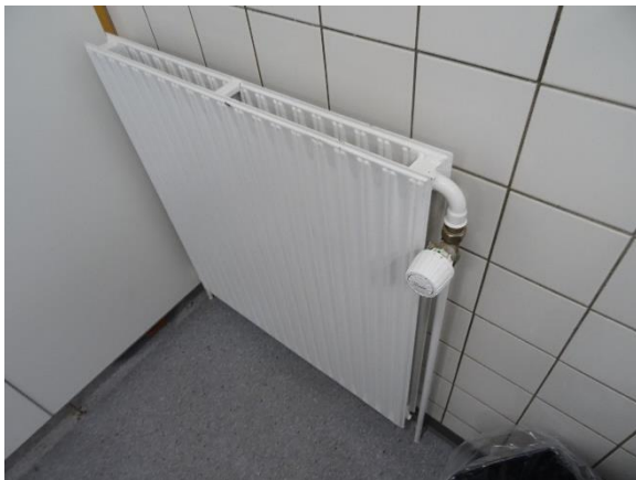
Radiator i køkken
