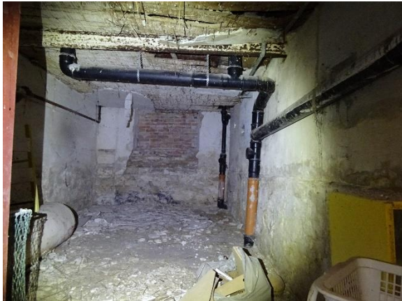
Afløbsledninger i kælder under hovedhuset
