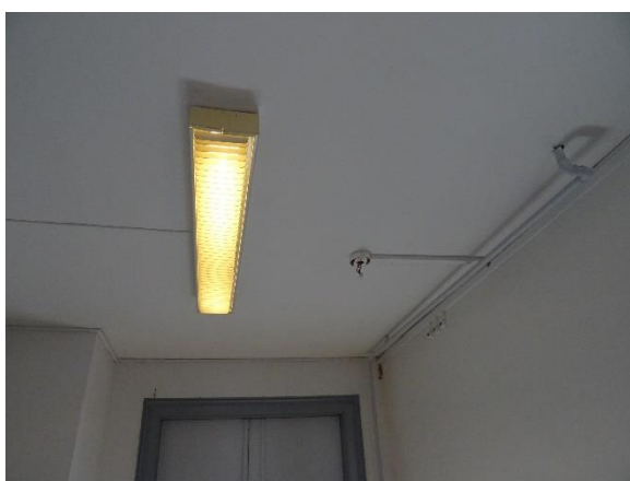
Ældre armatur med lysstofrør
