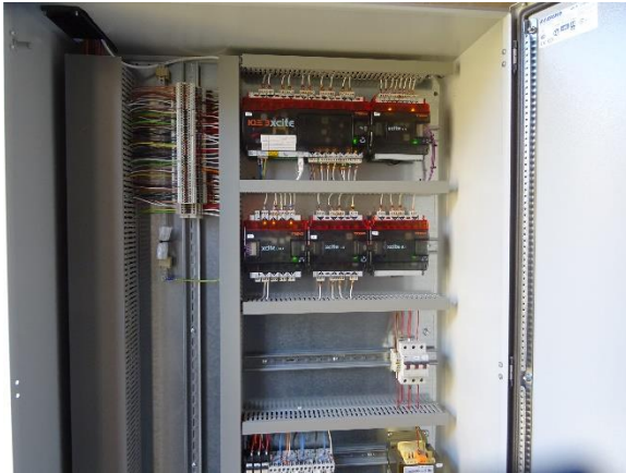
CTS for varmeanlæg
