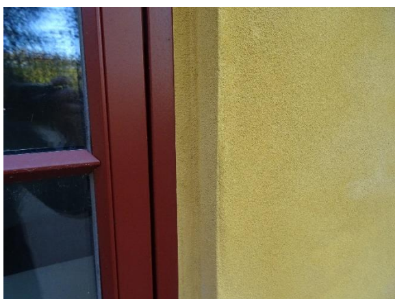
Mørtelfuge omkring vindue
