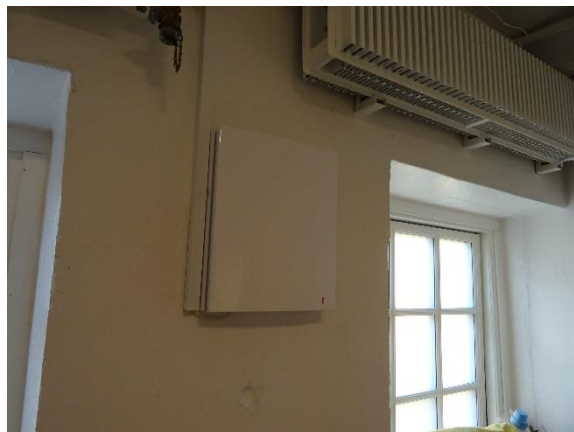
DUKA ventilator i væg på toilet og i bad
