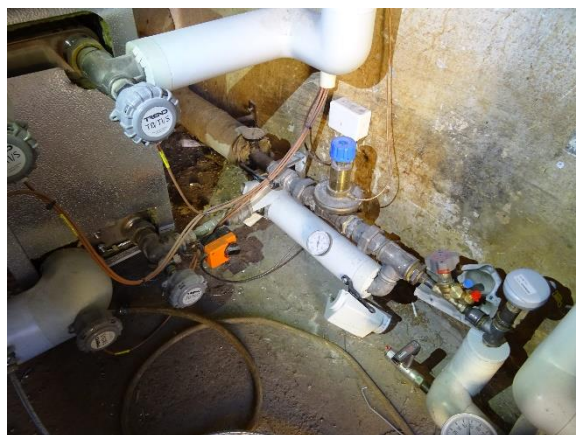
Enkelte dele af rør i varmecentral er uisoleret
