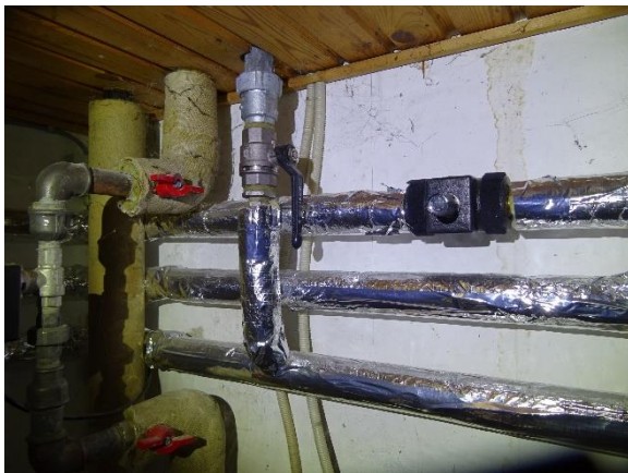
Varmtvandsrør i trappeopgang, isoleret
