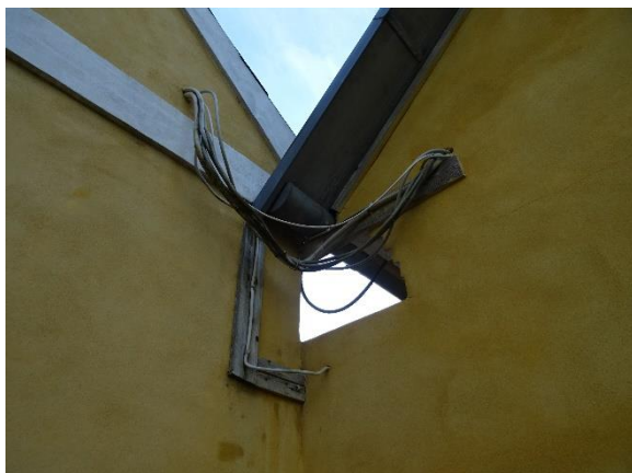
Uacceptabel måde at føre kabler mellem længer
