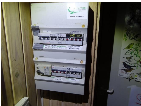
Tavle med tape afdækning og ældre HPDI relæ
