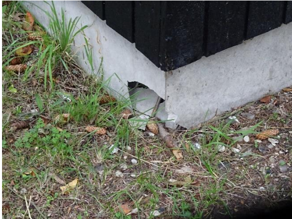
Sokkel i eternitplade, skade
