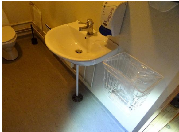
Håndvask med et-grebs armatur, Fritidshuset
