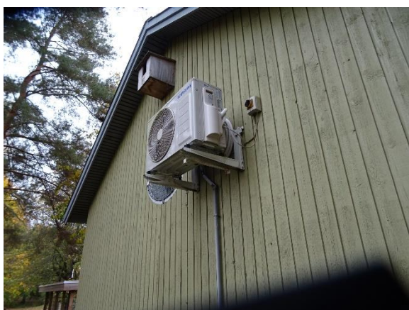
Varmepumpe fra 2023 på sydgavl
