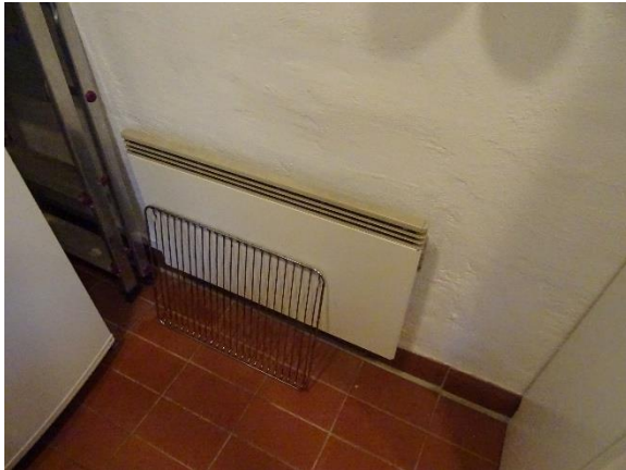
Elradiator med egen termostat
