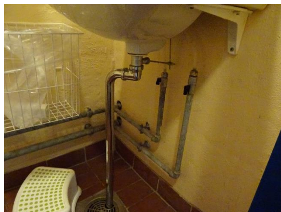
Afløbsrør og gulvafløb under håndvask i krom
