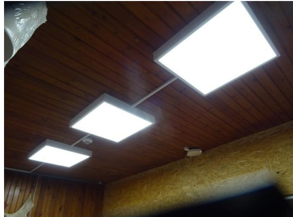
LED paneler på kontor
