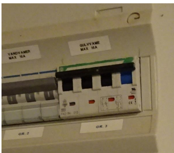
Gulvvarme ifølge el-tavle
