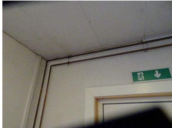
Vandrør på væggen i køkken
