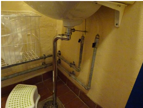
Vandrør af galvaniseret stål under håndvask med afgrening til køkken
