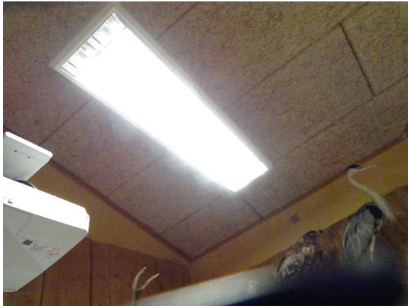
Lyskilder, rør skiftet til LED
