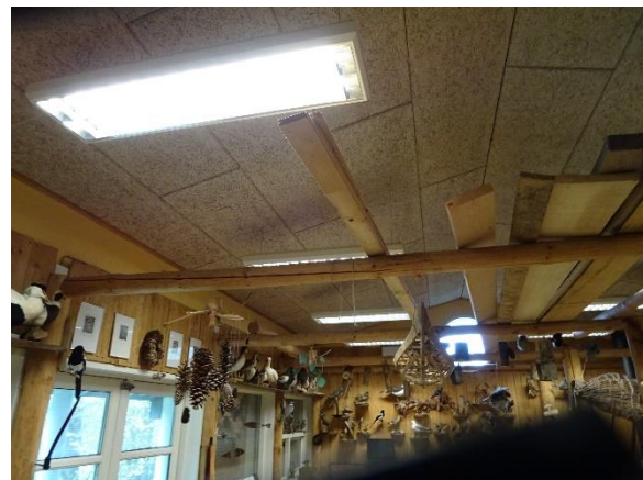
Lys undervisning, LED rør i ældre armaturer
