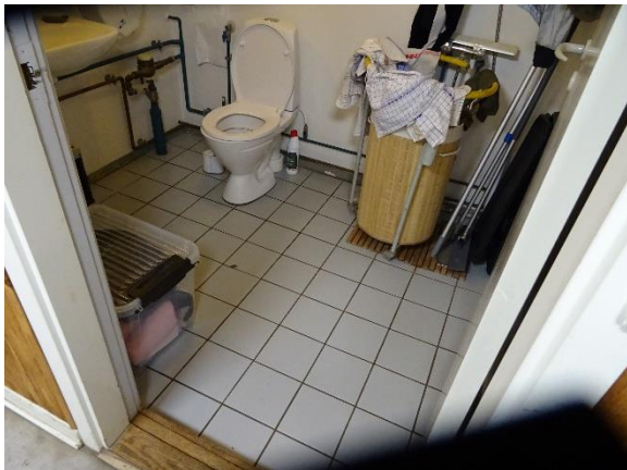
Toilet på HC toilet
