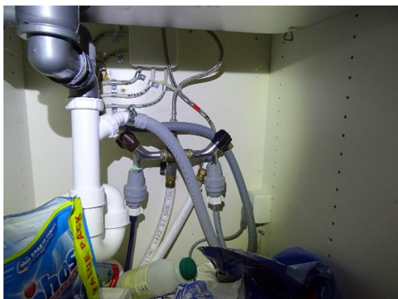
Afløbsrør under køkkenvask i vaskerum
