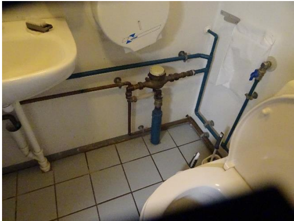
Vandstik på toilet
