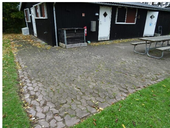
Mindre lunker i SF-stenene
